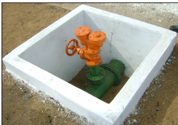
Foto 36 – Caixa da ventosa sem grade de proteção.
