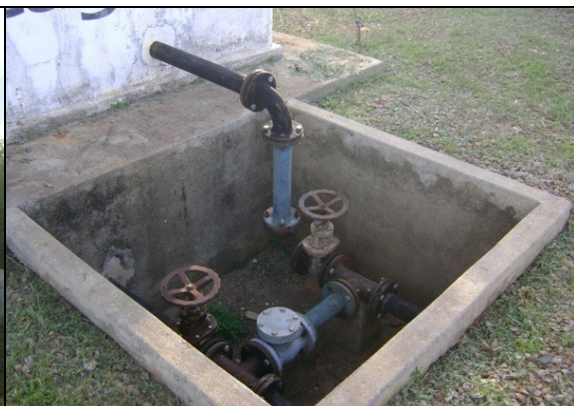
Foto 21 – Caixa do registro sem tampa de proteção.
