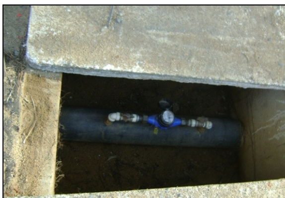
Foto 38 – Medidor proporcional instalado na entrada da rede (ETA).
