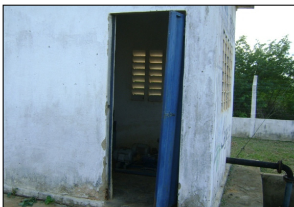
Foto 22 – Casa da EE-03 com porta quebrada.
