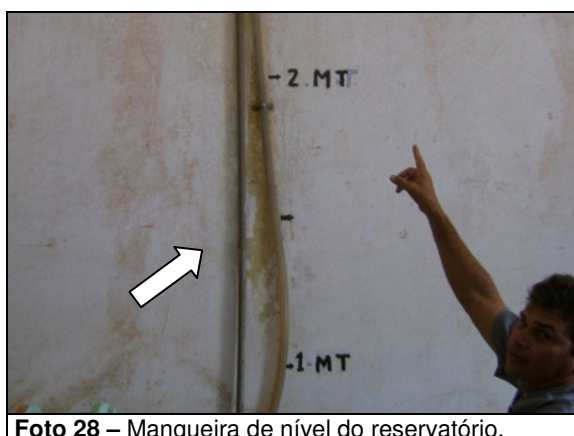
Foto 28 – Mangueira de nível do reservatório.
