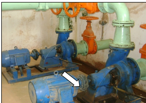
Foto 18 – Bomba da EE-02 com vazamento (ETA).
