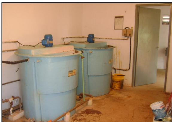
Foto 10 – Tanques dosadores da casa de química.
