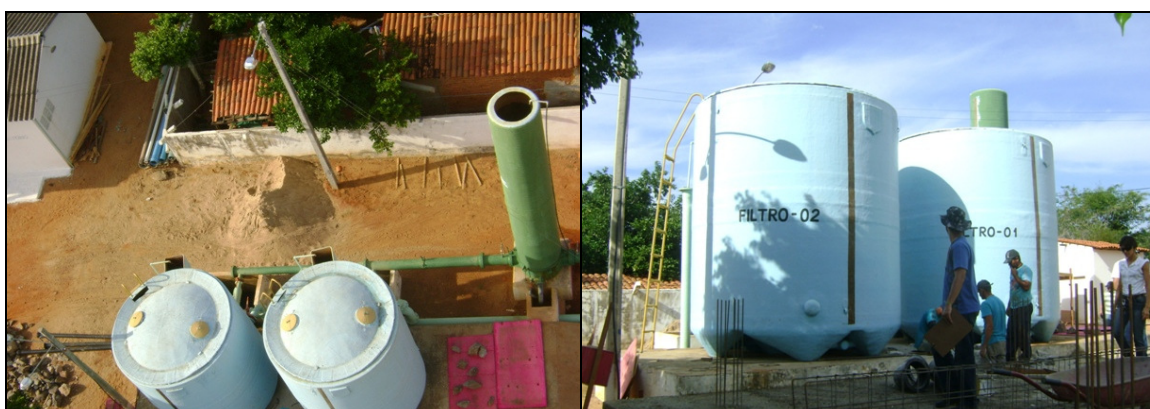
Foto 7 e 8 – Filtros e torre de nível da ETA.
