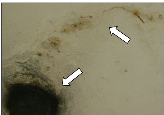
Foto 33 – Infiltração na laje de fundo do REL-01 e oxidação no tubo.
