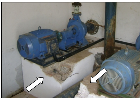
Foto 16 – Bases dos motores quebradas (Captação).
