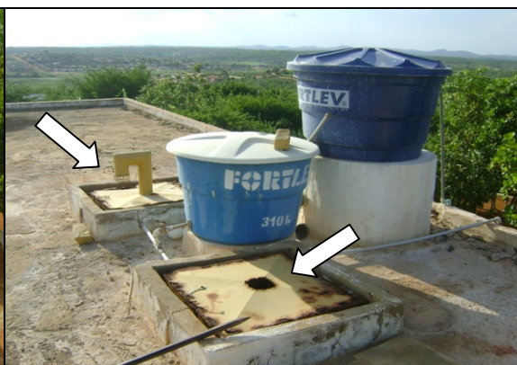
Foto 25 – Tampas do RAP-01 oxidadas e sem tubo de ventilação.
