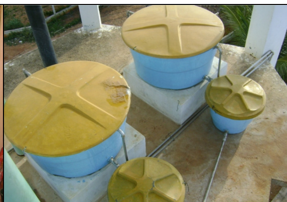
Foto 11 – Dosadores instalados no REL-01.
