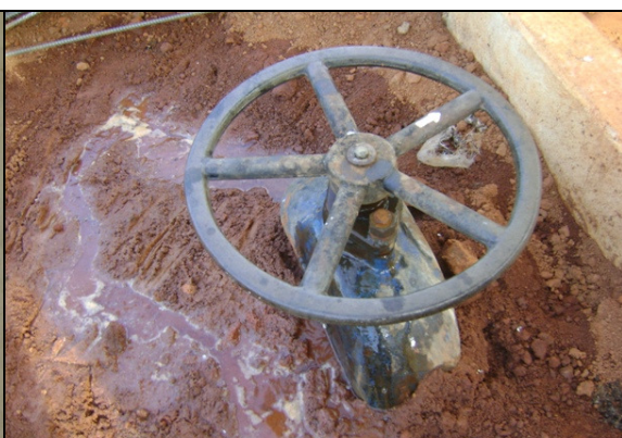
Foto 34 – Vazamento no registro.
