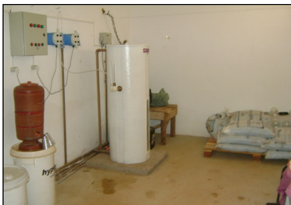
Foto 12 – Equipamento de flúor e estrado de madeira com produto químico.
