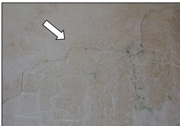
Foto 26 – Reboco da parede do RAP-01 danificado.
