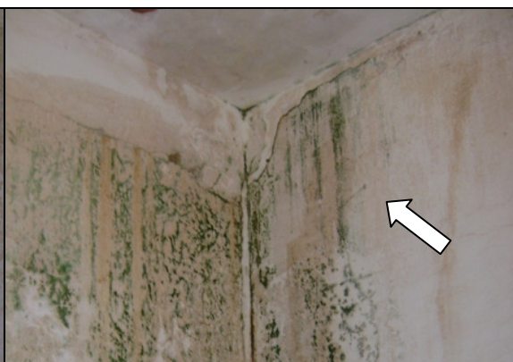
Foto 27 – Infiltração na junção das paredes do RAP-01.
