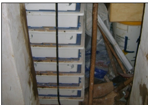
Foto 45 e 46 – Materiais estocados de forma inadequada.
