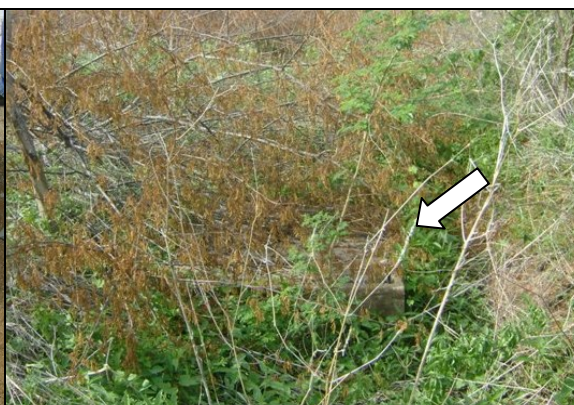
Foto 37 – Caixa de ventosa, danificada e encoberta pela vegetação.
