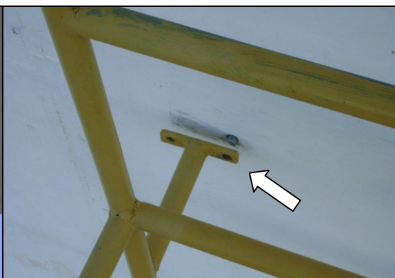
Foto 32 – Chumbadores danificados na escada.
