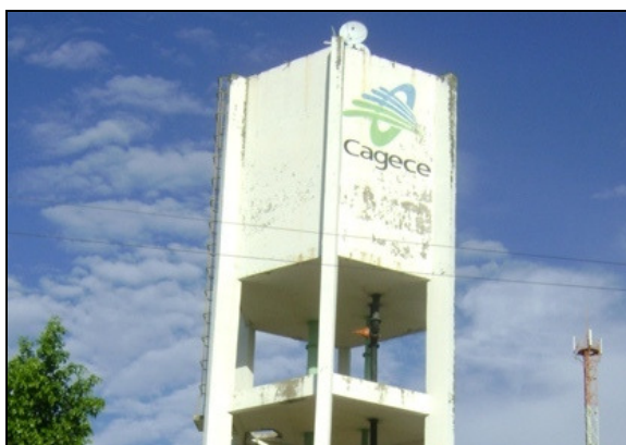
Foto 29 – REL-01 com pintura e identificação deterioradas e sem guarda-corpo.
