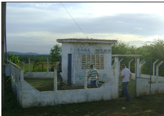
Foto 20 – EE-03 com pintura e identificação deterioradas.
