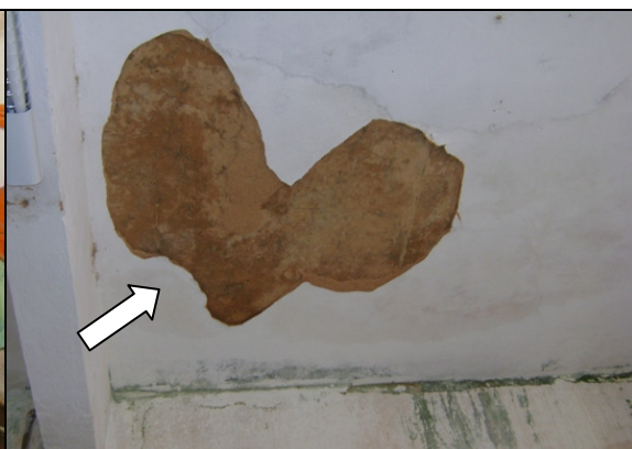
Foto 19 – Revestimento danificado (ETA).
