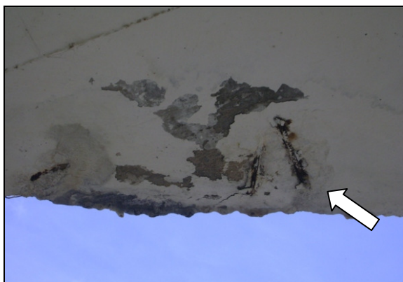
Foto 31 – Armadura exposta na laje de fundo do REL-01.
