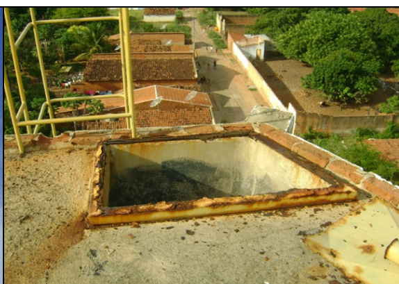
Foto 30 – Reservatório sem tampa e sem tubo de ventilação.
