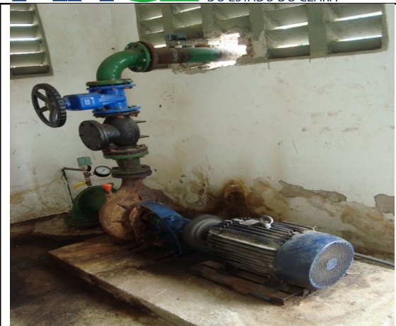
Foto 14 – EEAB-01 sem bomba reserva
