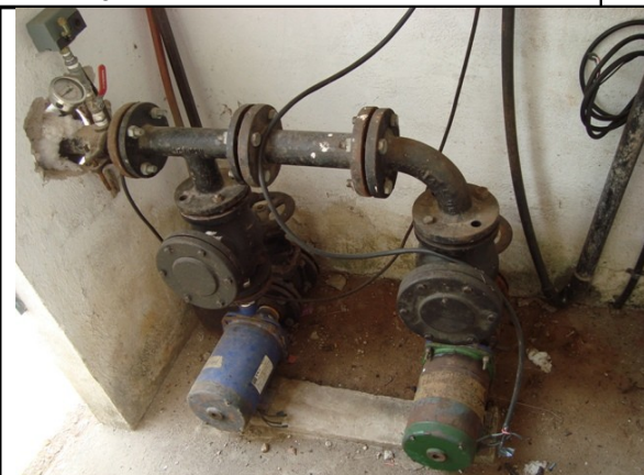
Foto 20 – Conjuntos moto-bomba da EEAT-02
