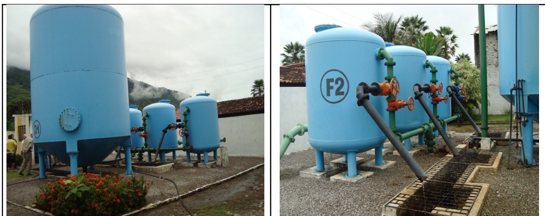
Fotos 03 e 04 – O decantador e os três filtros identificados
