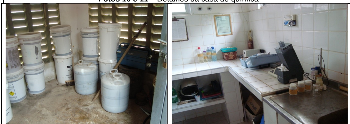
Foto 12 – Armazenamento inadequado de produtos químicos
