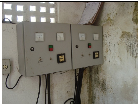
Foto 21 – Quadro de comando da EEAT-02
