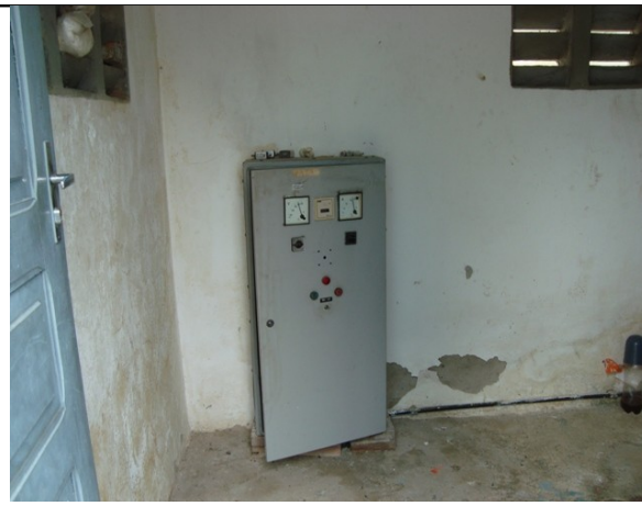
Foto 15 – Quadro de comando da EEAB-01
