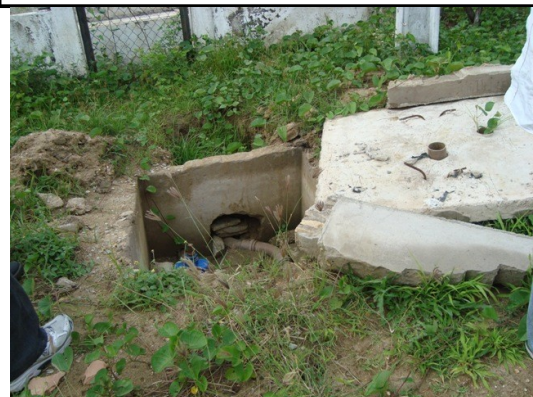
Foto 18 – Caixa danificada na área da EEAT-01
