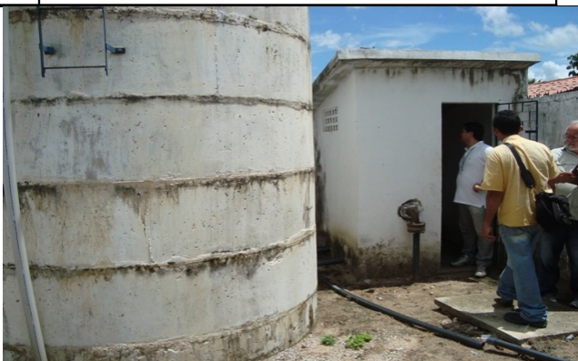
Foto 19 – Vista externa da EEAT-02
