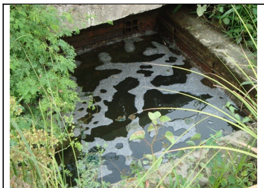
Foto 22 – Caixa de proteção danificada
