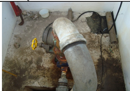
Foto 17 – EEAT-01 sem bomba reserva
