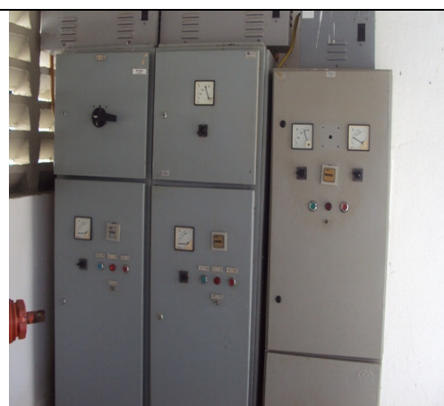
Foto 21 – Quadros elétricos da EEAT-02 e EECS-01
