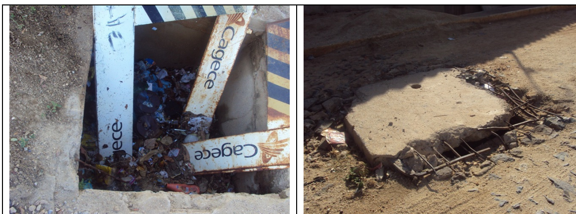
Fotos 30 e 31 – Lixo e caixas de proteção danificadas
