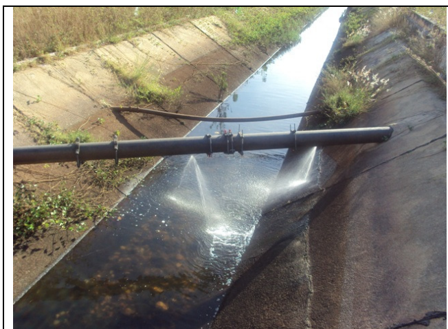
Foto 29 – Vazamento na adutora de água tratada
