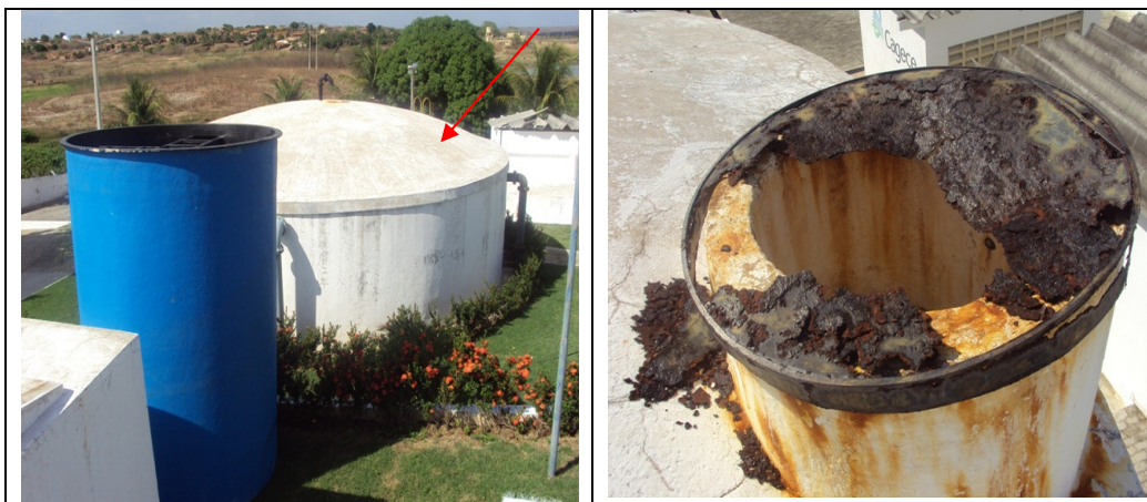
Fotos 22 e 23 – Vista do RAP-01 e a abertura de inspeção sem tampa
