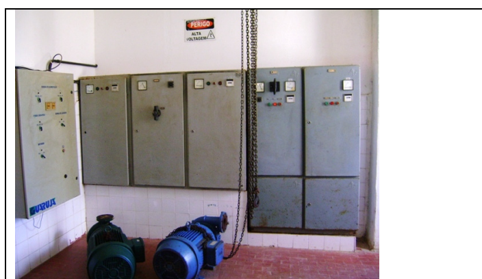
Foto 21 – Quadro de comando da EEAT-01 e EELF-01
