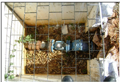
Foto 36 – Macromedidor na saída do RAP-01
