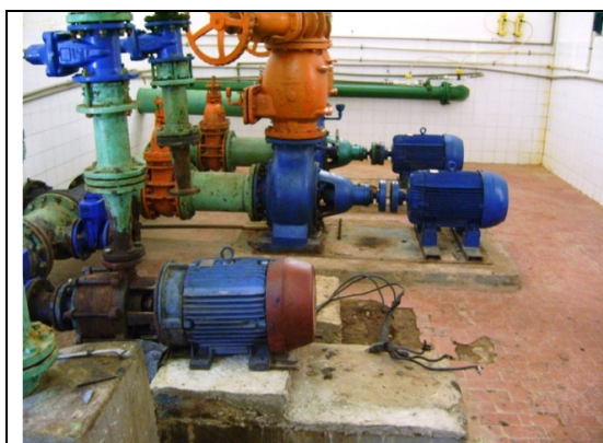
Foto 19 – Vista da EEAT-01 e EELF-01 ao fundo
