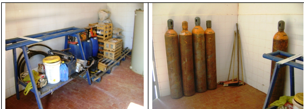
Fotos 8 e 9 – Armazenamento inadequado de produtos químicos
