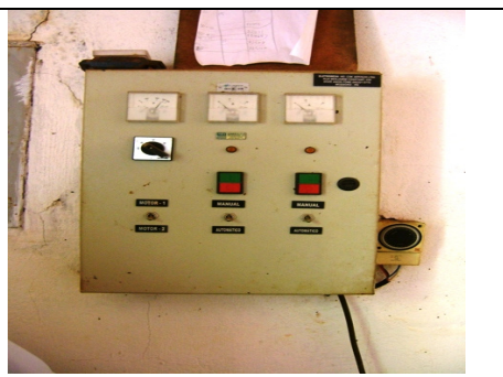
Foto 25 – Quadro de comando do booster da Vila Saraiva
