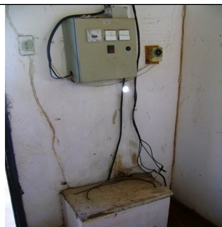
Foto 18 – Quadro de comando da EECS-01
