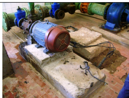
Foto 20 – Detalhe da EEAT-01 sem conjunto moto-bomba reserva
