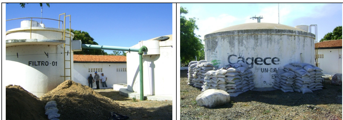
Fotos 6 e 7 – Material filtrante junto ao Filtro e RAP-01
