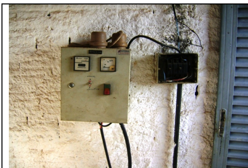
Foto 24 – Quadro de comando do booster da Vila Campos
