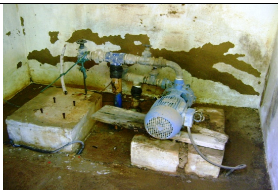
Foto 23 – Booster da Vila Saraiva
