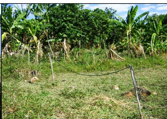
Foto 4 – Fiação exposta sobre o solo
