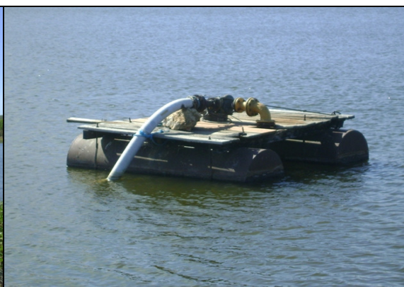
Foto 2 – Flutuante da captação
