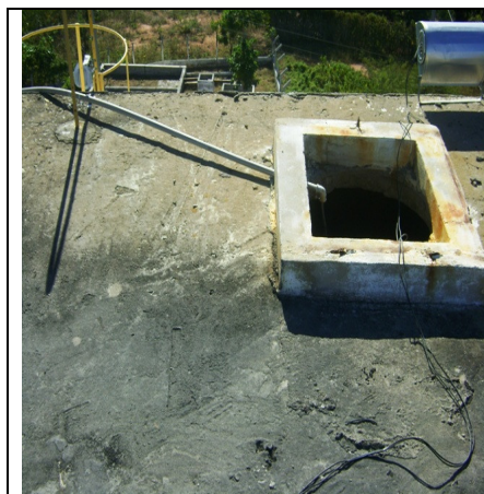
Foto 31 – Ausência de tampa no REL-01
