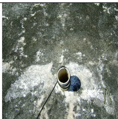
Foto 25 – RAP-01 – tubulação de ventilação inadequada
