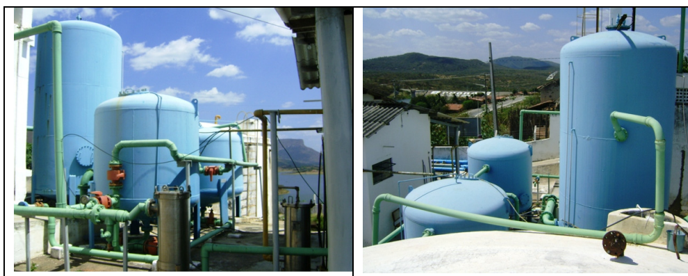
Fotos 10 e 11 – Vistas frontal e superior dos filtros e do floco-decantador
