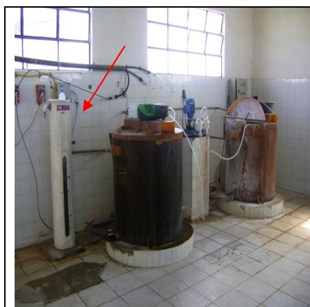
Foto 13 – Tanques de dosagem e sistema de fluoretação
