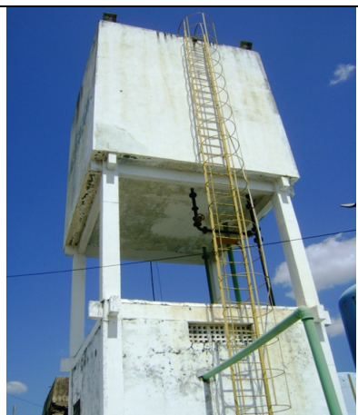
Foto 30 – REL-01 – sinais de vazamento
