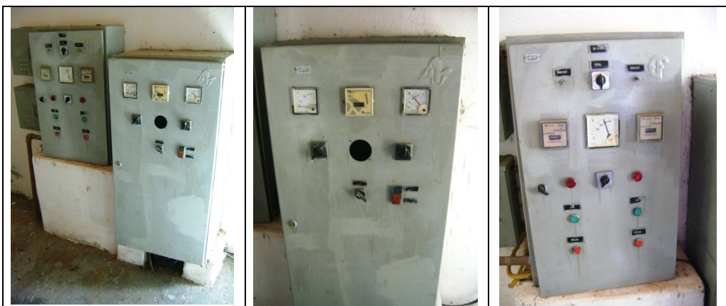
Fotos 21, 22 e 23 – Quadros de comando da EEAT-01, EELF-01 e EECS-01
