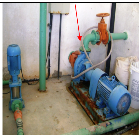
Foto 20 - EELF-01 – ausência de conjunto motor-bomba reserva
