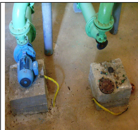
Foto 19 - EEAT-01 – ausência de conjunto motor-bomba reserva
