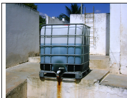
Foto 12 – Armazenamento inadequado de produto químico
