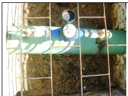
Foto 32 – Medidor proporcional na entrada do REL-01
