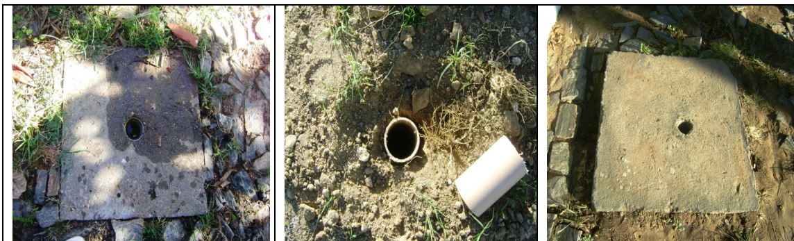
Fotos 33, 34 e 35 – Registros de descarga nas Ruas Joaquim Moreira, Cel. João Paracampas e N. Sra de Fátima
