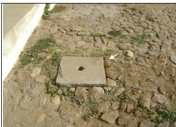
Foto 40 – Registro de descarga localizado na Rua Elias de Sá Novais.
