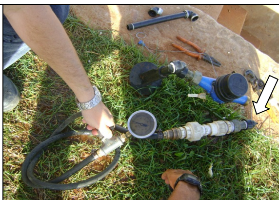
Foto 45 – Medição de pressão na Rua Maria Vilauba Viana, nº 19, Centro, antes do hidrômetro.
