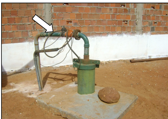
Foto 5 – PT-02: Fiação exposta.
