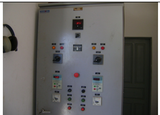
Foto 23 – EEAT-01: Quadro de comando.
