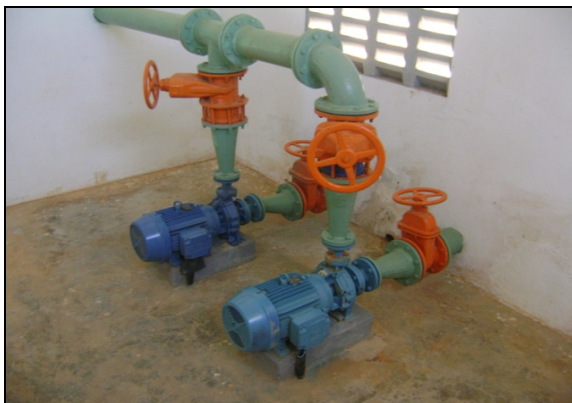
Foto 22 – EEAT-01: Conjunto moto-bomba.
