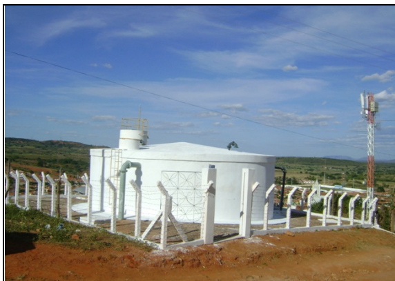
Foto 24 – RAP-01: Ausência de identificação.
