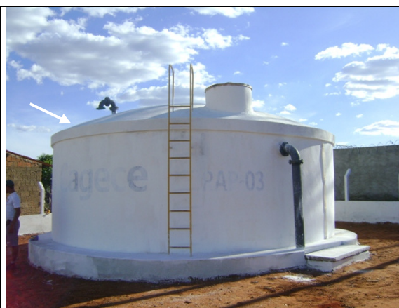
Foto 31 – RAP-03: Identificação apagada.
