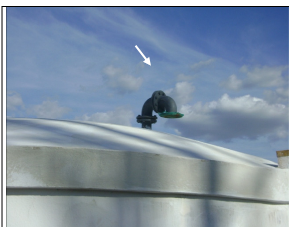
Foto 32 – RAP-03: Tubulação de ventilação adequada.
