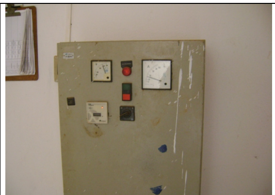
Foto 4 – PT-02: Quadro de comando
