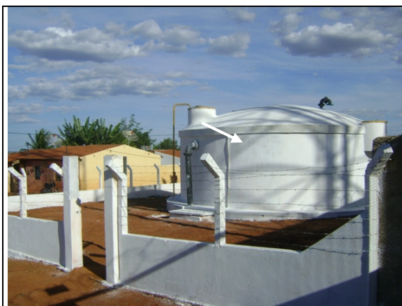
Foto 30 – RAP-03: Identificação apagada.
