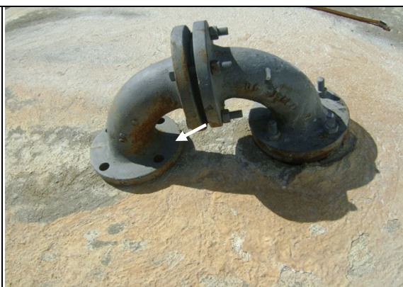
Foto 28 – RAP-02: Tubulação de ventilação inadequada.
