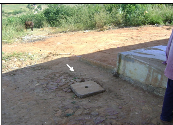
Foto 39 – Registro de descarga localizado na Rua Bela Vista.
