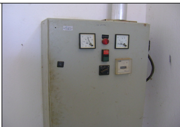
Foto 2 – Quadro de comando do PT-01.
