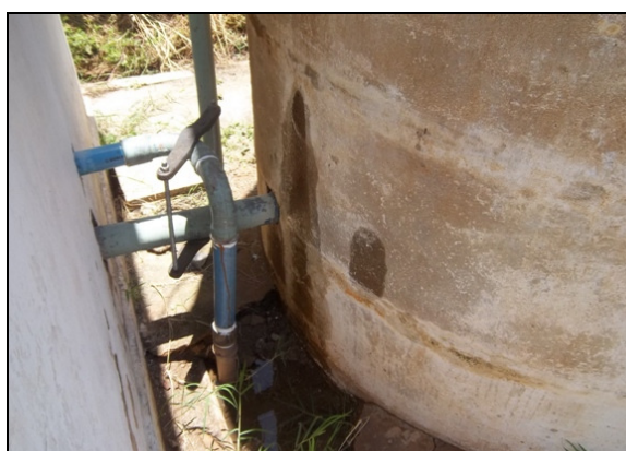
Foto 54 – Infiltração na parede do RAP-04.
