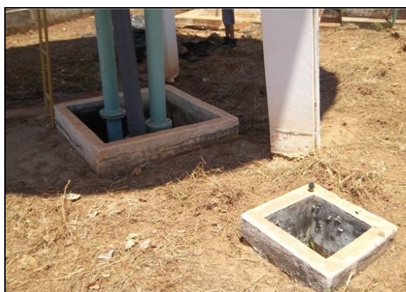
Foto 61 – Caixas de registro e de tubulações, do REL-02, sem tampas de proteção.
