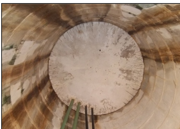
Foto 64 – Infiltração na laje do REL-03.
