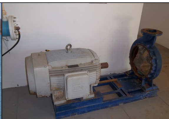
Foto 23 – Bomba reserva da EE-01.
