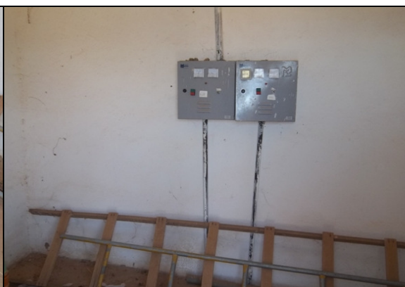
Foto 34 – Quadro de comando da EE-04.
