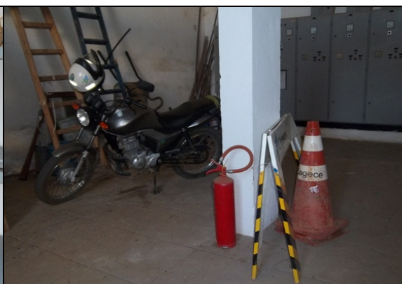
Foto 91 – Extintor de incêndio do almoxarifado.
