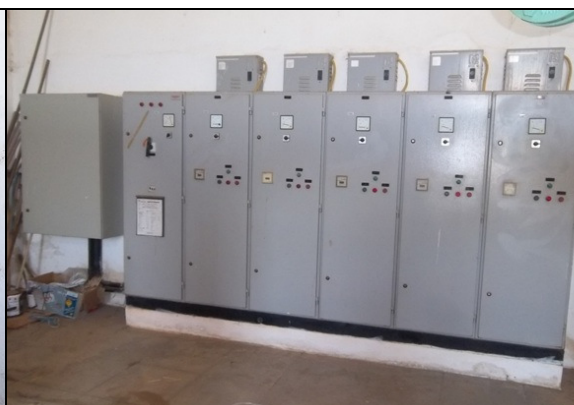
Foto 30 – Quadro de comando da EE-03.
