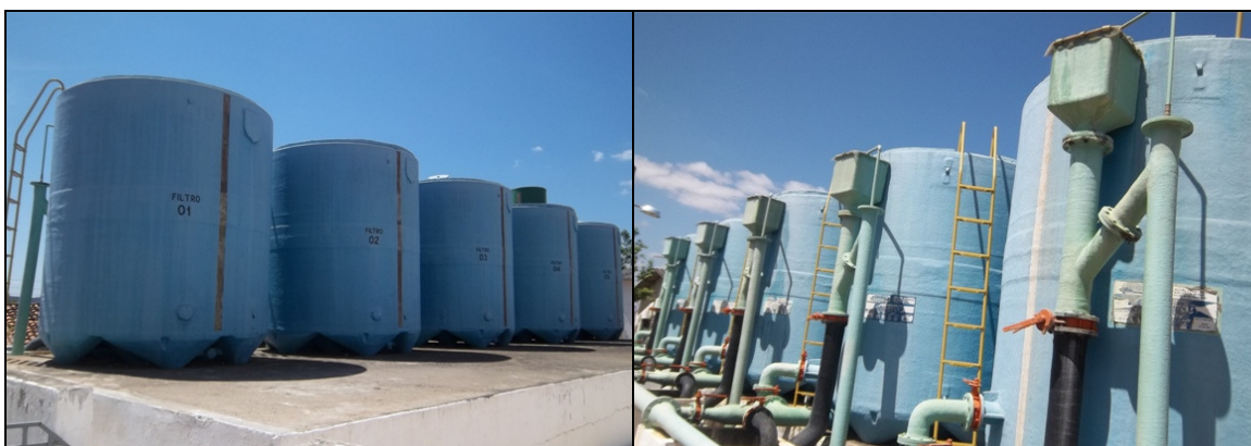
Foto 3 e 4 – Vistas dos filtros.
