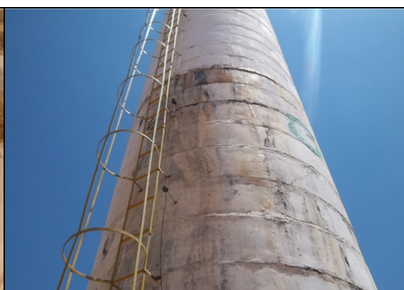
Foto 65 – Pintura deteriorada do REL-03.
