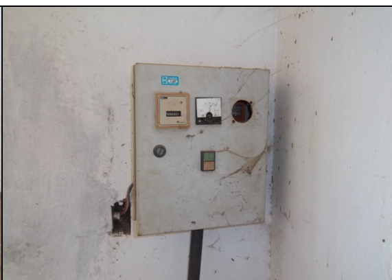
Foto 41 – Quadro de comando da EE-06.
