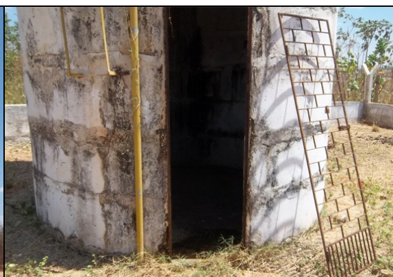
Foto 63 – Portão de acesso do REL-03 sem fixação.
