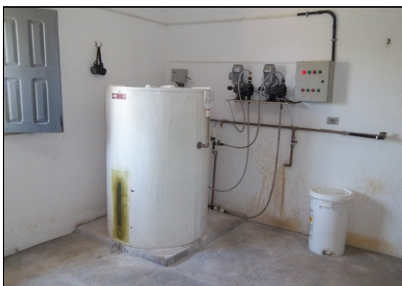
Foto 13 – Dosador de flúor.
