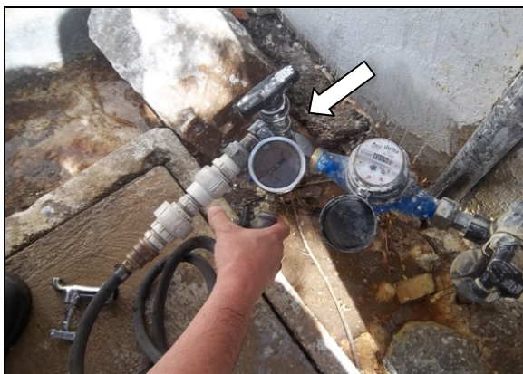
Foto 78 – Medição de pressão sem hidrômetro, na Av. Vicente Alves Costa, 620 - Centro.
