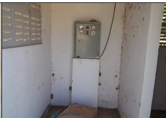
Foto 38 – Quadro de comando da EE-05.
