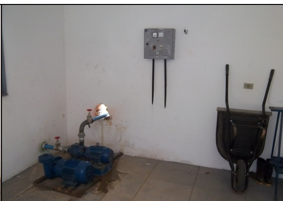
Foto 44 – Quadro de comando da EE-07.
