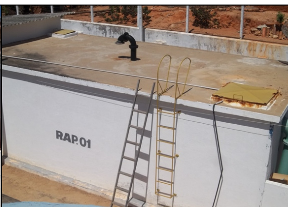
Foto 46 – Tubulação de ventilação e tampas de inspeção do RAP-01.
