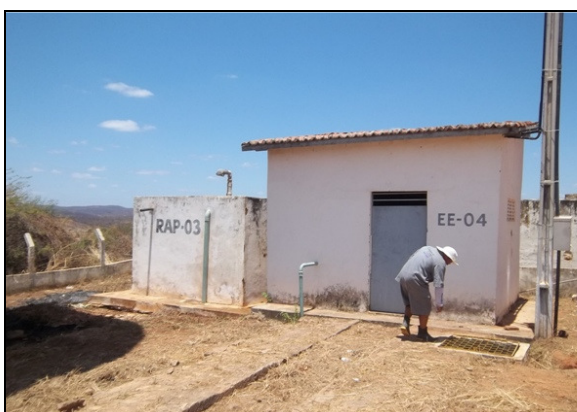
Foto 35 – Prédio de abrigo do quadro da EE-04.
