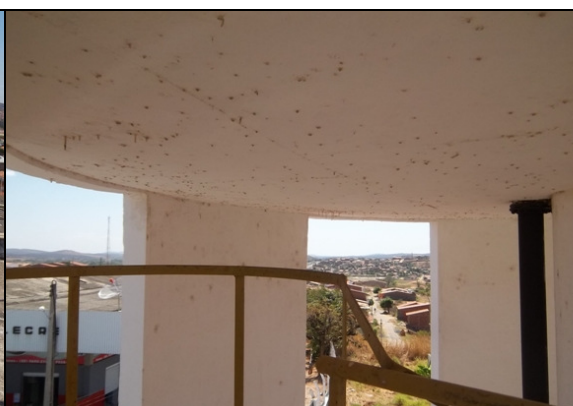
Foto 58 – Infiltração na laje do REL-01.
