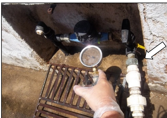
Foto 82 – Medição de pressão sem hidrômetro, na Vila Cacilda, 193 - Betânia.
