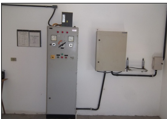
Foto 24 – Quadro de comando da EE-01.
