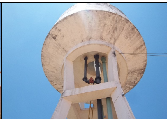
Foto 60 – Pintura deteriorada do REL-02.
