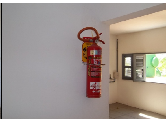
Foto 14 – Extintor de incêndio da casa de química.
