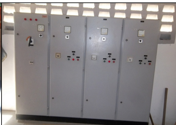
Foto 27 – Quadros de comando da EE-02.
