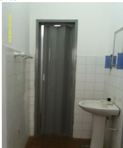
Foto 60 – Instalações sanitárias disponíveis para funcionários e usuários.
