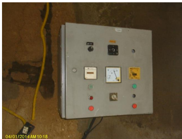
Foto 6 – PA-02: quadro de comando.
