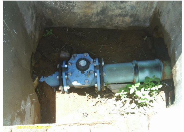
Foto 31 – Macromedidor de água bruta na entrada do REL-01.
