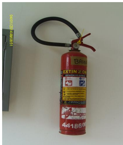
Foto 61 – Exintor de incêndio da casa de química está dentro do prazo, com data de vencimento em set/2014.
