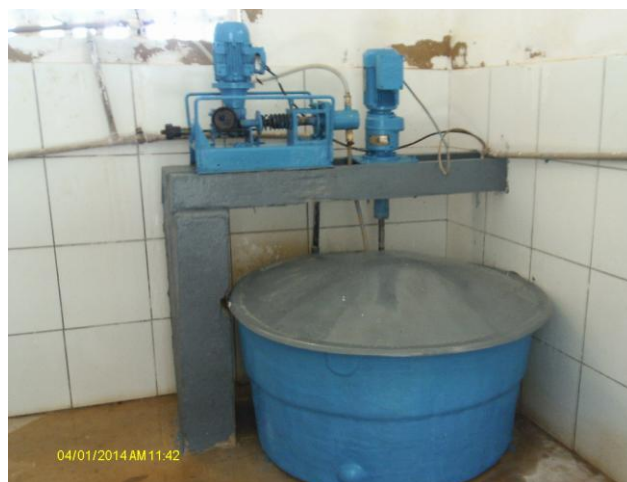
Foto 16 – Bomba dosadora de cloro.
