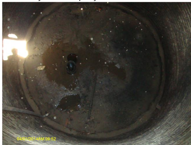
Foto 3 – PA-01 (desativado): vista interna sem cobertura.
