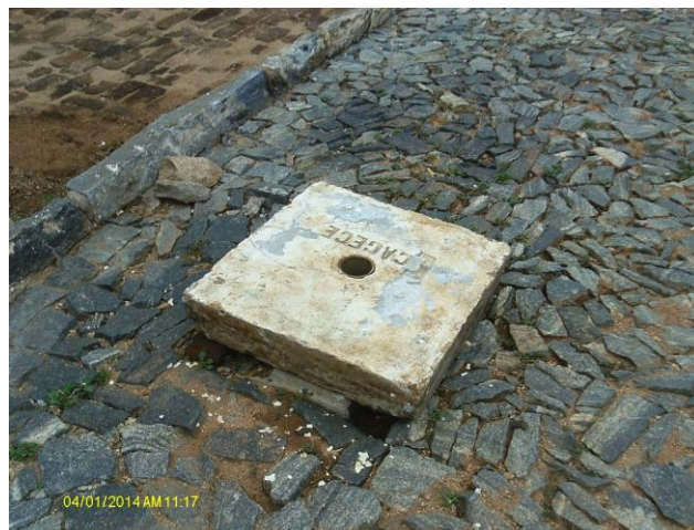
Foto 53 – Registro de descarga na Rua João Nunes, nº 26.
