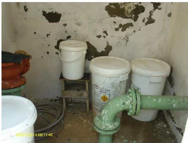
Foto 19 – Armazenamentos de produtos químicos.
