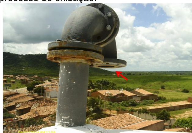
Foto 40 – REL-01: ausência de tela de vedação na tubulação de ventilação.
