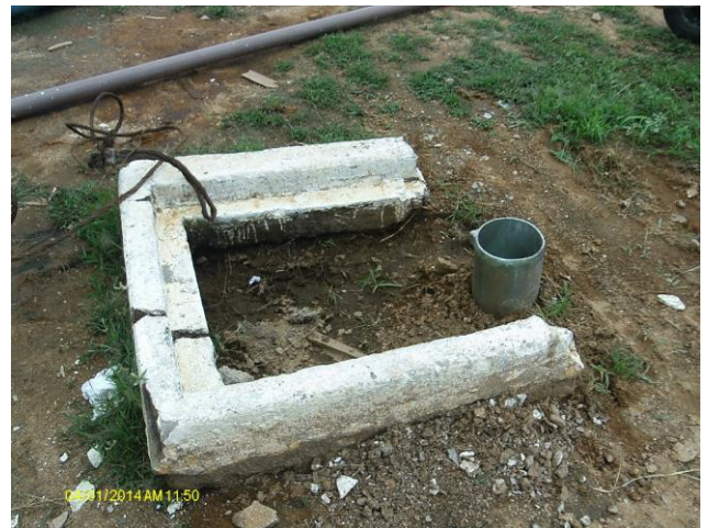
Foto 33 – Caixa de registro na área do REL-01 sem tampa ou grade de proteção.
