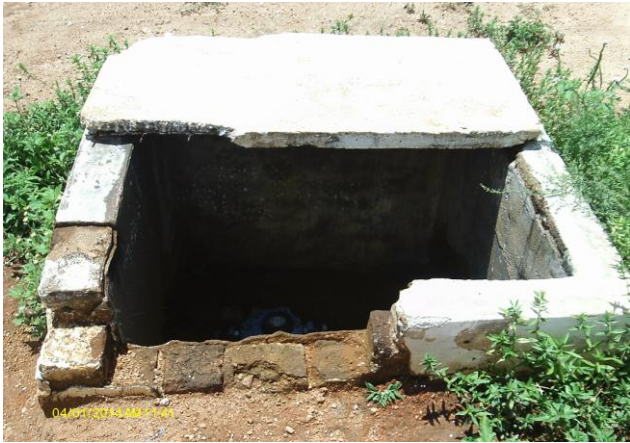
Foto 30 – Caixa do macromedidor instalada na adutora de água bruta na área do REL-01, com tampa de proteção danificada.
