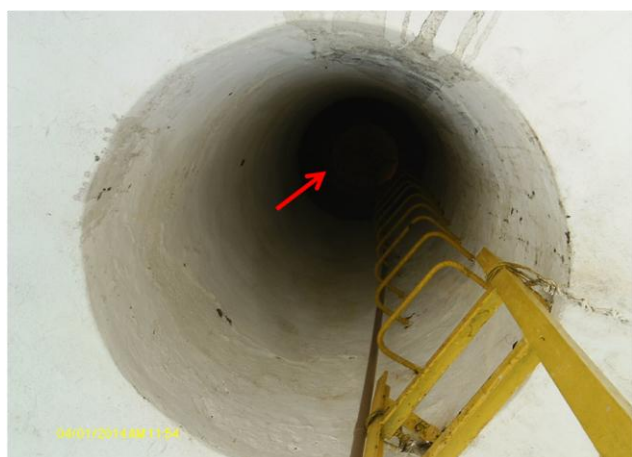
Foto 39 – Tampa de inspeção do REL-01.
