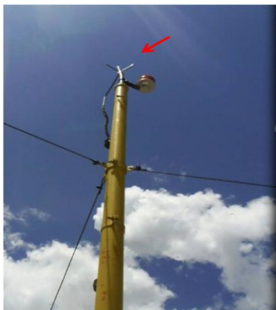
Foto 41 – REL-01: sinalizador noturno (sem funcionamento) e para-raios.
