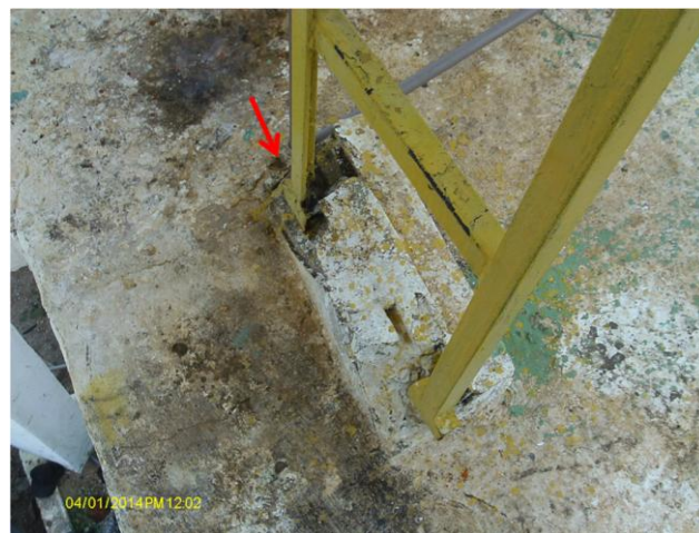
Foto 38 – Fixação da escada do REL-01 em processo de oxidação.
