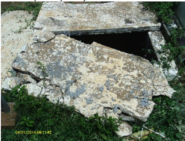
Foto 32 – Caixa de inspeção na área do REL-01 com tampa danificada.
