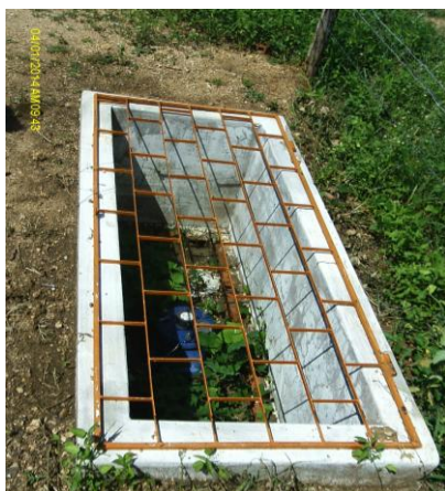
Foto 28 – Macromedidor de água bruta parado na saída do PA-01 (desativado).
