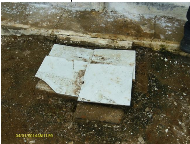
Foto 34 – Caixa de inspeção na área do REL-01 sem tampa ou grade de proteção.
