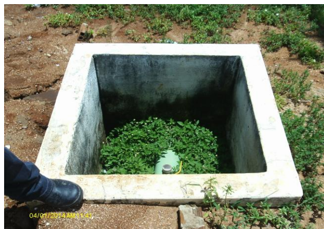
Foto 29 – Caixa de instalação pitométrica instalada na entrada da área do tratamento, sem tampa ou grade de proteção.
