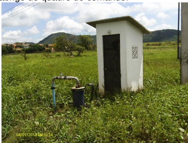
Foto 11 – PT-02: poço e casa de abrigo do quadro de comando.
