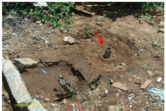
Foto 51 – Registro de descarga na Rua Júlio Vicente de Andrade, nº 154.
