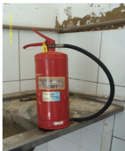
Foto 18 – Exintor de incêndio da casa de química com validade vencida em abril/2013.
