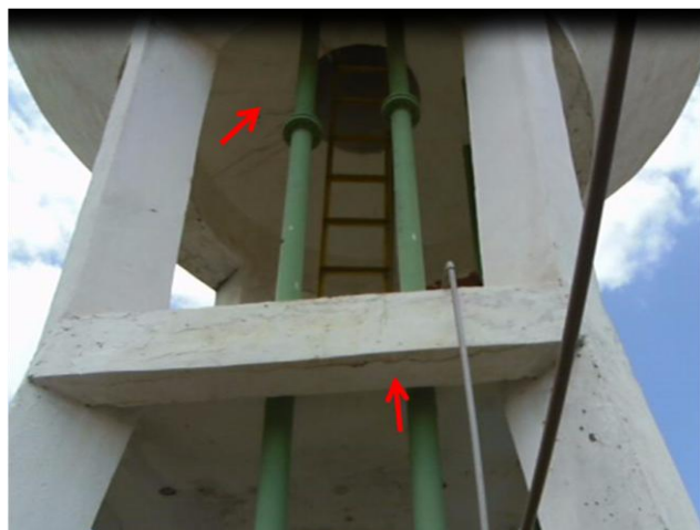
Foto 37 – Estrutura do REL-01 deteriorada.
