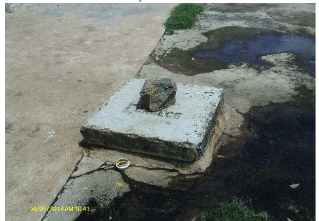
Foto 49 – Registro de descarga na Rua Coronel Francisco Luís, nº 500, saída para Santa Helena.
