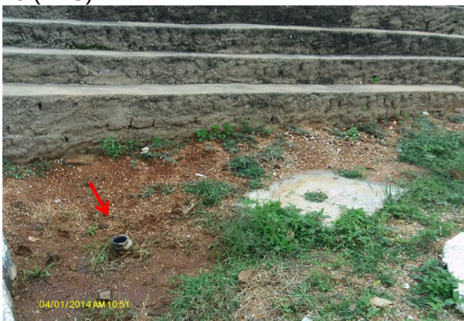
Foto 50 – Registro de descarga na Rua Professor Luís Alves da Costa, nº 191.
