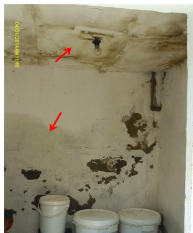
Foto 20 – Armazenamentos de produtos químicos com infiltrações.
