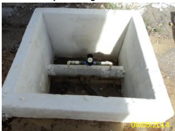
Foto 48 – AAT: medidor proporcional na saída da EEAT-01 sem tampa ou grade de proteção.
