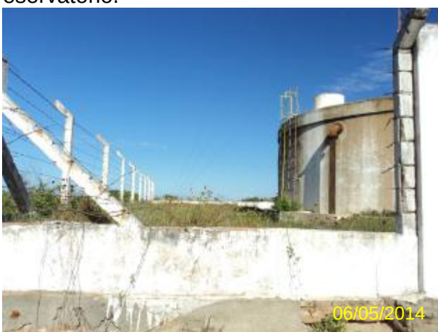
Foto 60 – RAP-02: ausência de delimitação.
