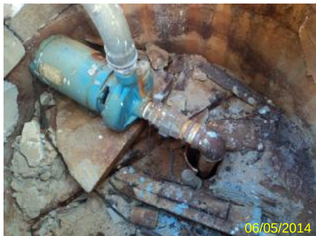
Foto 8 – PT-03: laje de proteção deteriorada.
