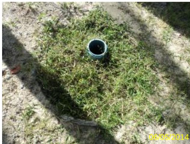
Foto 24 – Poço desativado 2: condições inadequadas de proteção.
