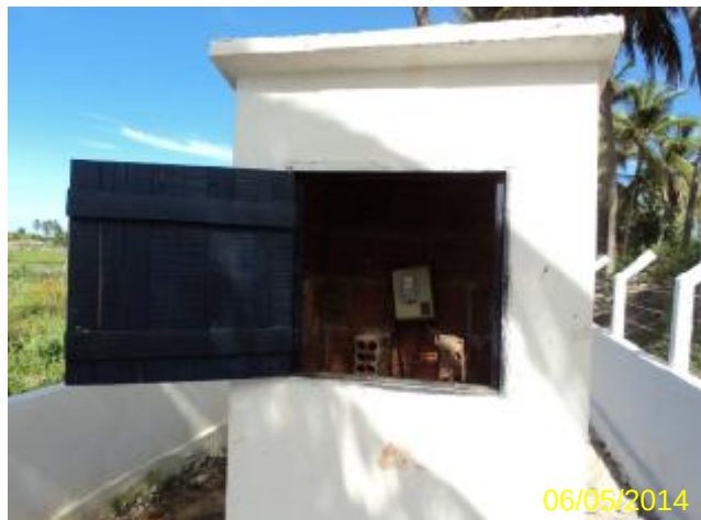
Foto 12 – PT-04: quadro de comando.
