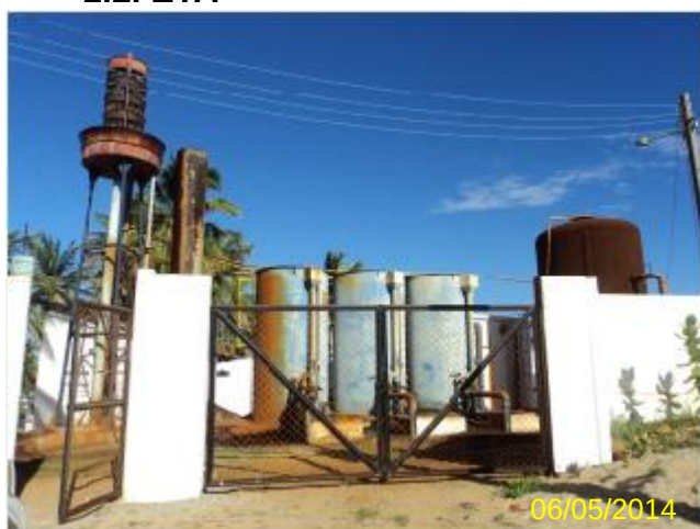
Foto 26 – ETA: área de acesso e ausência de identificação.
