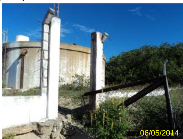
Foto 59 – RAP-02: ausência de delimitação.
