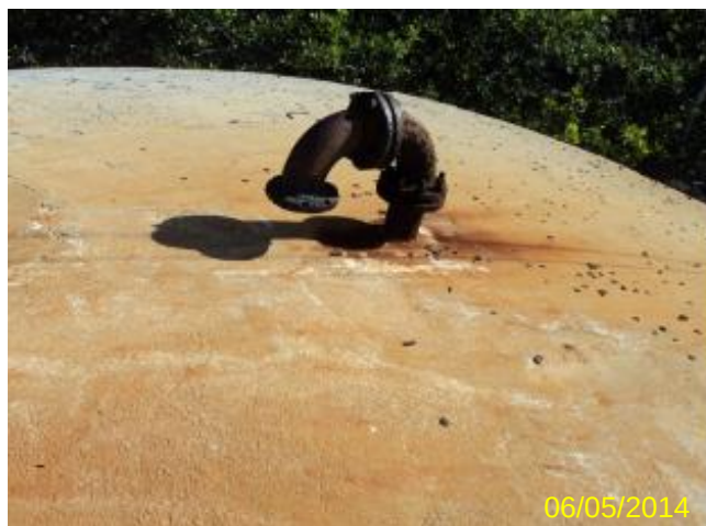
Foto 63 – RAP-02: tubulação de ventilação sem tela de proteção.
