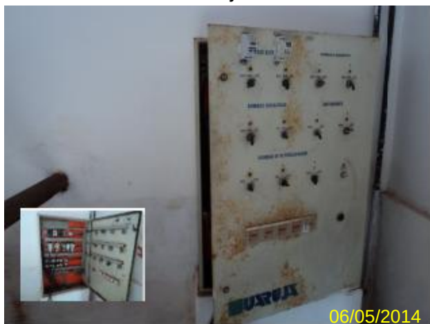
Foto 53 – EEAT-01 e EELF-01: quadro de comando.
