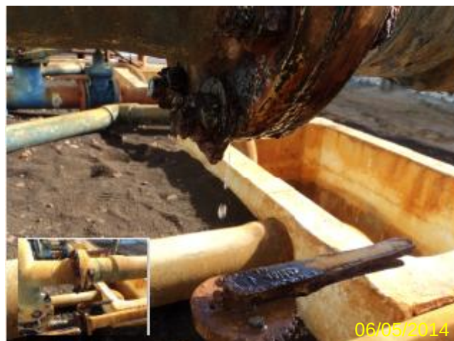
Foto 35 – Filtro 02: tubulação em processo de corrosão e com vazamento.
