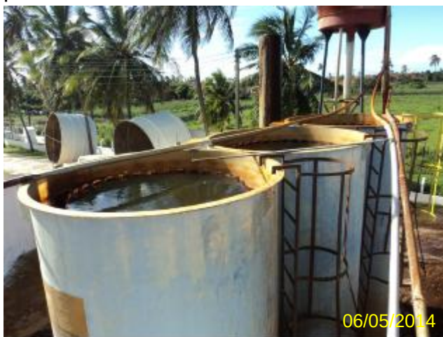
Foto 32 – Filtração: ausência de tampas.
