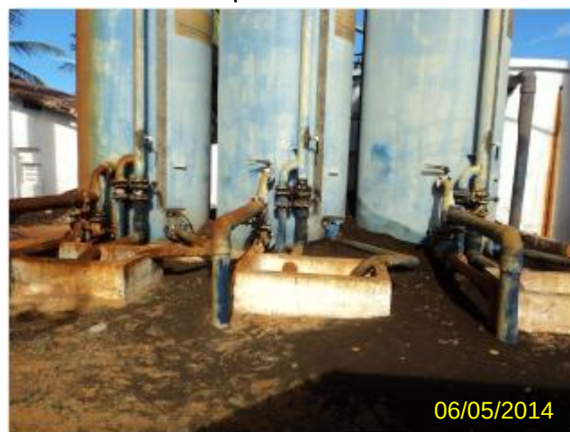
Foto 33 – Filtração: tubulações e registros.
