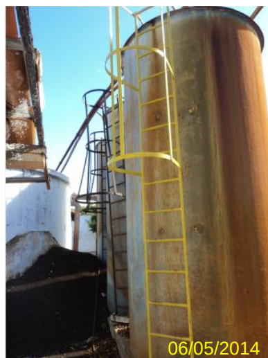
Foto 31 – Filtração: escadas de acesso dos filtros 02 e 03 em processo de corrosão.
