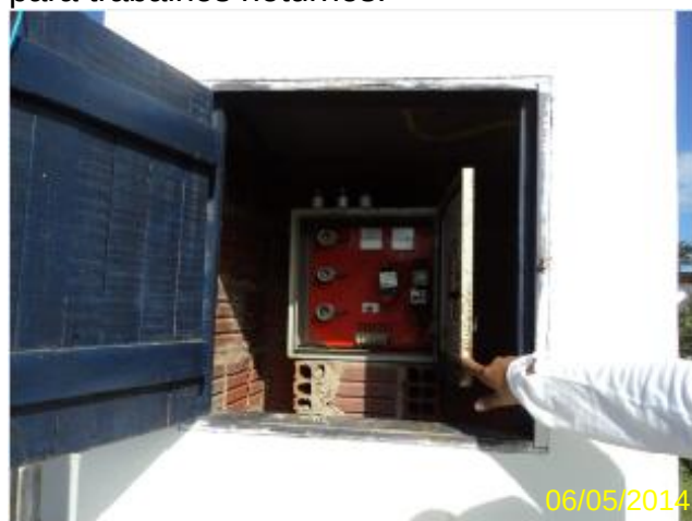
Foto 4 – PT-01: quadro de comando.
