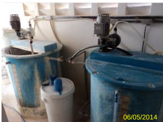
Foto 38 – Casa de química: tanques de fluor e cloro.
