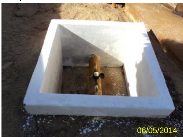
Foto 50 – AAT: medidor proporcional na saída da EELF-01 sem tampa ou grade de proteção.
