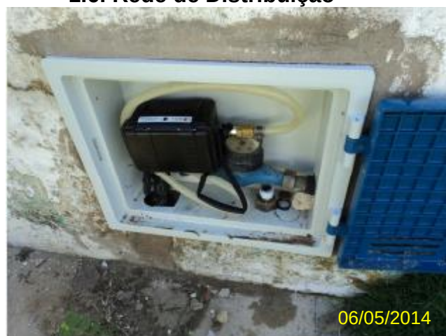
Foto 65 – RDA: medição contínua de pressão.
