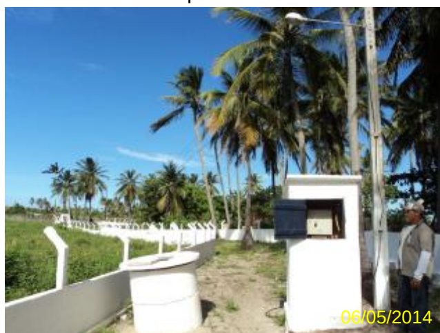
Foto 14 – PT-05: vista geral – ausência de identificação e iluminação para trabalhos noturnos.
