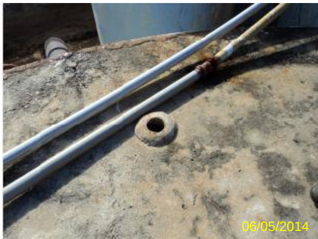
Foto 56 – RAP-01: tubulações de ventilação.
