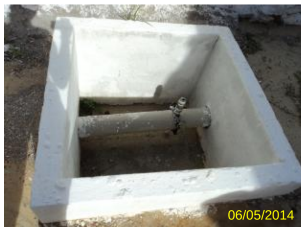
Foto 49 – AAT: estação pitométrica sem tampa ou grade de proteção.
