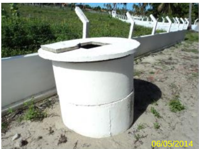
Foto 15 – PT-05: proteção do poço.
