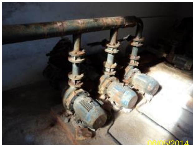
Foto 52 – EELF-01: conjunto moto-bomba.
