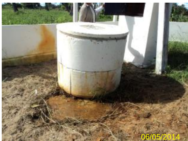
Foto 19 – PT-06: proteção do poço.
