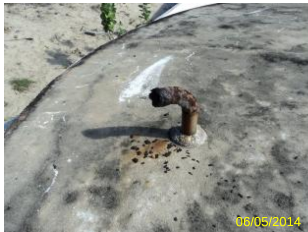
Foto 57 – RAP-01: tubulação de ventilação em processo de corrosão e sem tela de proteção.
