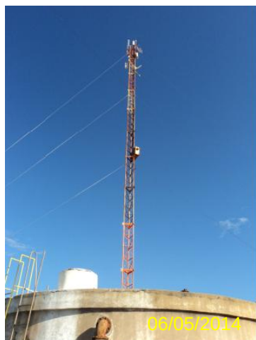
Foto 64 – RAP-02: torre de comunicação instalada na parte superior do reservatório.
