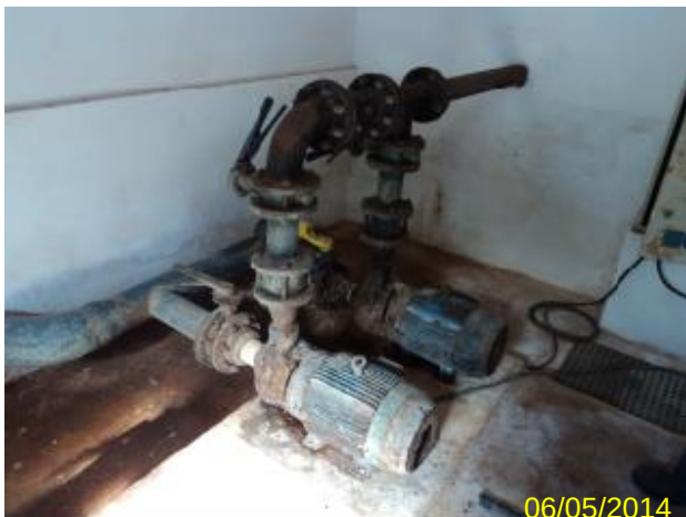
Foto 51 – EEAT-01: conjunto moto-bomba.
