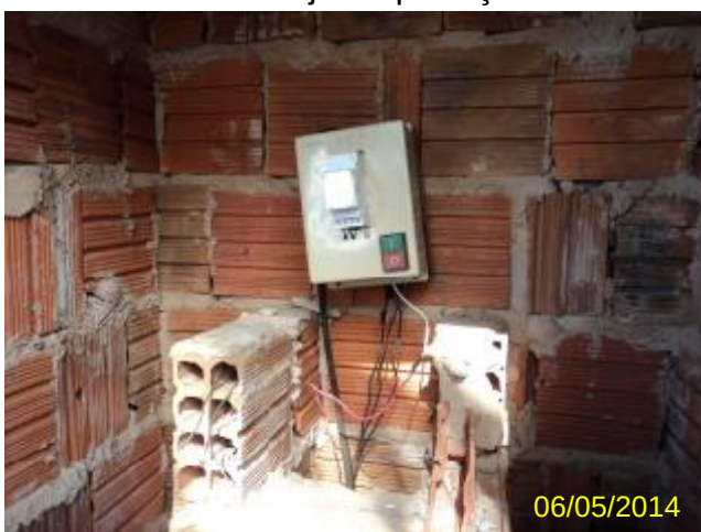
Foto 13 – PT-04: quadro de comando.
