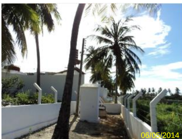
Foto 10 – PT-04: área de acesso e ausência de identificação.
