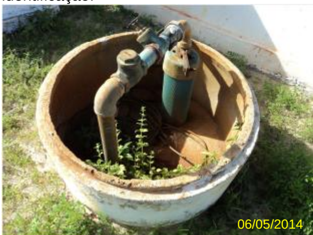
Foto 3 – PT-01: poço inoperante devido a bomba.
