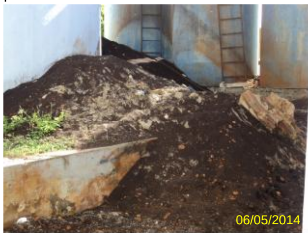
Foto 45 – ETA: material proveniente da troca do leito filtrante.
