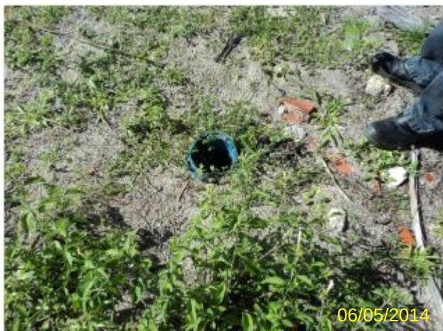
Foto 23 – Poço desativado 1: condições inadequadas de proteção.
