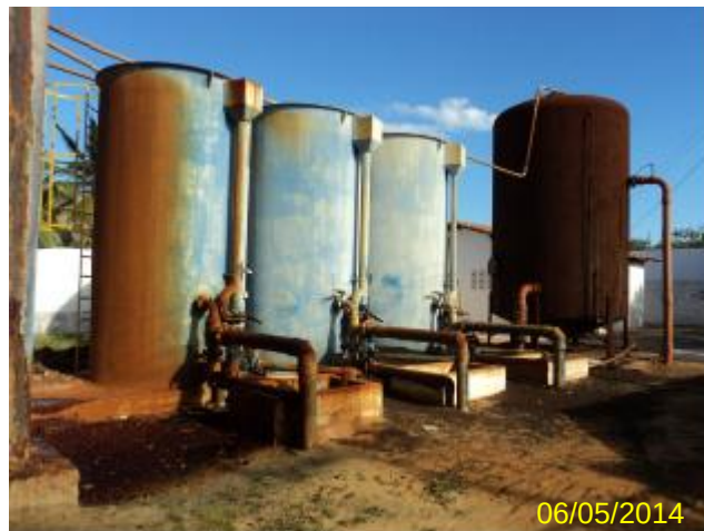
Foto 29 – Decantação e Filtração: vista geral.
