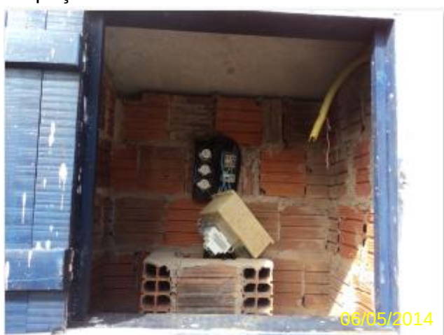
Foto 22 – PT-06: quadro de comando.
