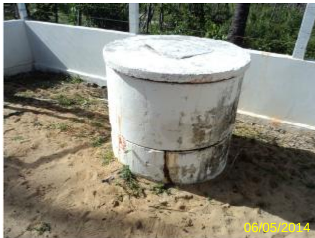
Foto 6 – PT-02: proteção do poço.
