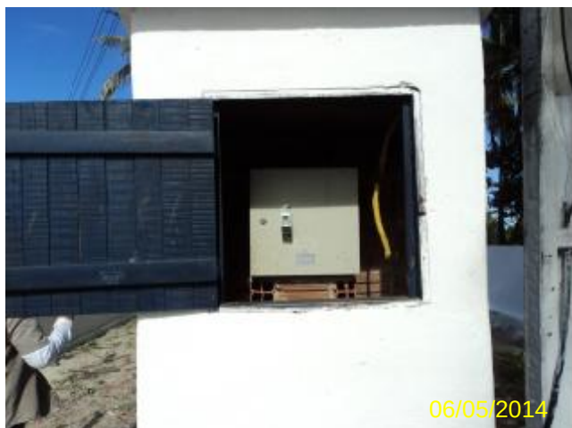
Foto 17 – PT-05: quadro de comando.
