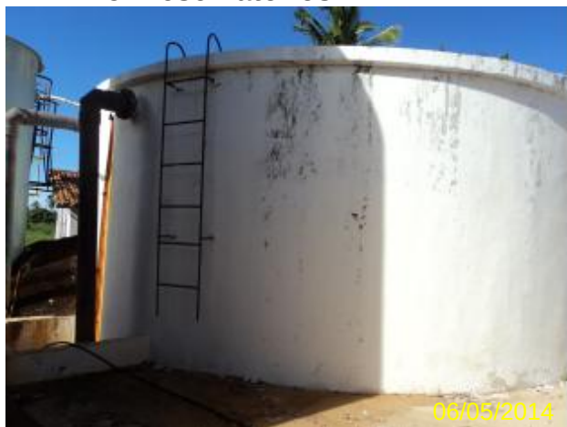
Foto 54 – RAP-01: medidor de nível, escada de acesso e ausência de identificação.
