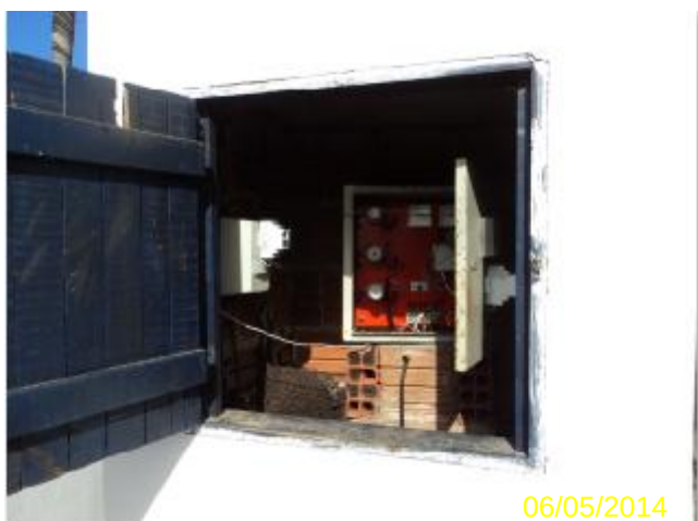
Foto 9 – PT-02 e PT-03: quadro de comando.
