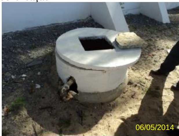
Foto 7 – PT-03: proteção do poço.
