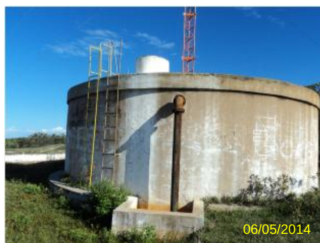
Foto 61 – RAP-02: escada de acesso, pintura deteriorada e ausência de identificação.
