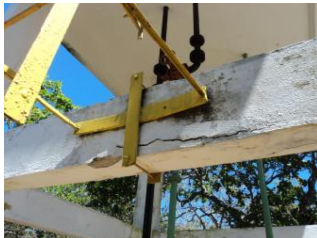
Foto 23 – REL-03: estrutura de fixação da escada danificada.
