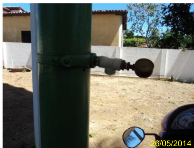
Foto 15 – REL-02: medidor de nível.
