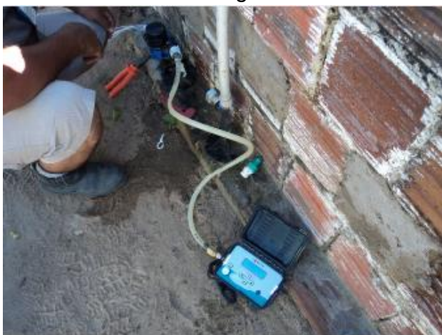
Foto 31 – RDA: medição instantânea de pressão na R. Pergentino Sampaio, SMS1.
