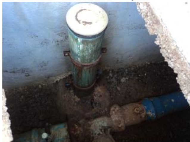
Foto 19 – REL-02: clorador de pastilha.
