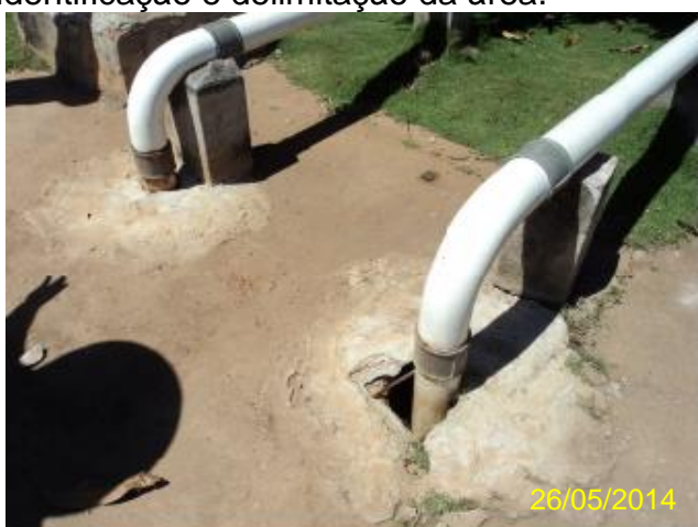
Foto 8 – REN-01: entrada da tubulação da adutora no reservatório inadequada.
