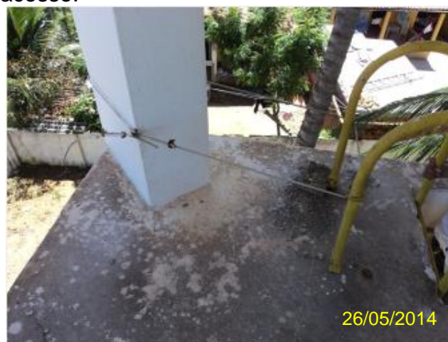
Foto 13 – REL-02: segundo nível de escada com fixação improvisada.
