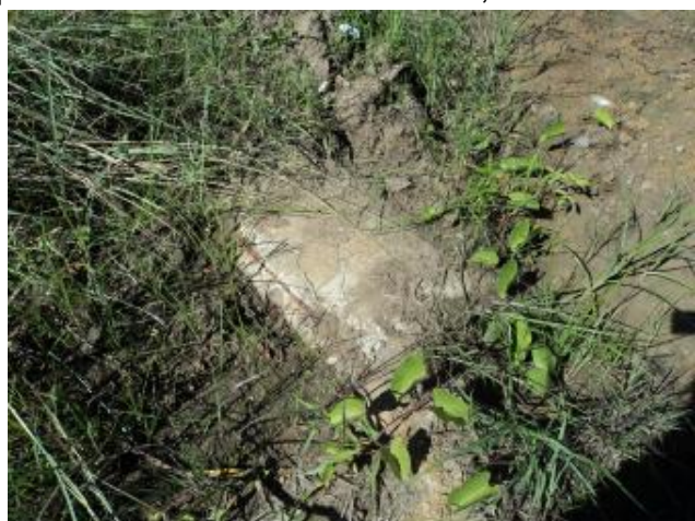
Foto 37 – RDA: registro de descarga na Av. Porfírio de Araújo – saída para São Luiz do Curu.
