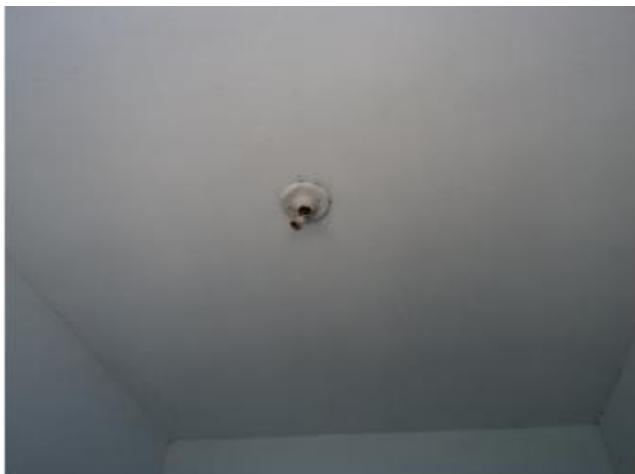
Foto 5 – EEAT-02: ausência de iluminação.
