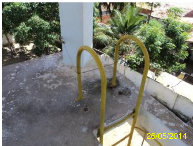
Foto 12 – REL-02: segundo nível de escada com fixação improvisada na coluna do reservatório.
