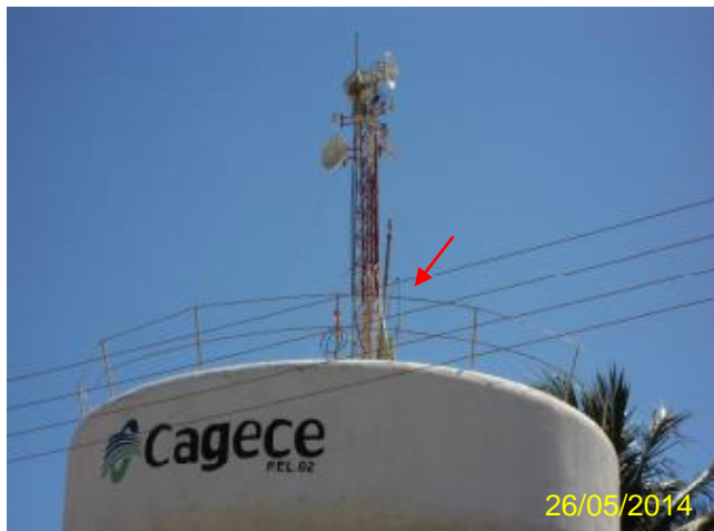
Foto 16 – REL-02: guarda-corpo na laje de cobertura e para-raio caído.
