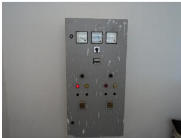
Foto 4 – EEAT-02: quadro de comando.
