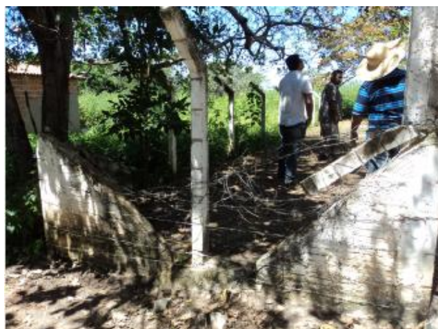
Foto 21 – REL-03: cerca danificada.
