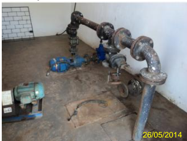
Foto 3 – EEAT-02: conjunto moto-bomba.
