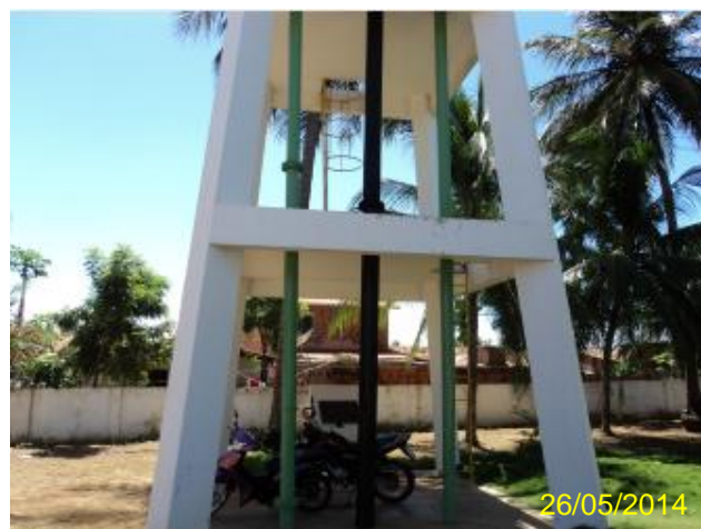
Foto 11 – REL-02: tubulações e escadas de acesso.
