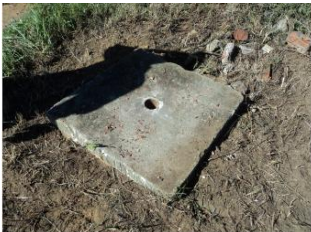
Foto 39 – RDA: registro de descarga na Av. Porfírio de Araújo – saída para Fortaleza.
