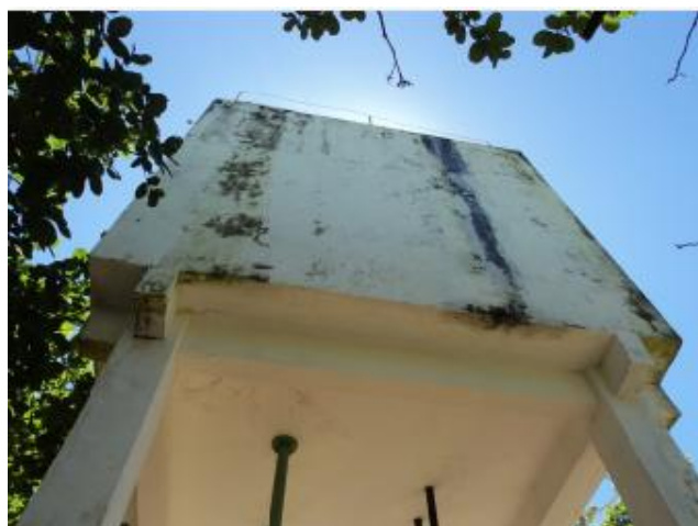
Foto 25 – REL-03: pintura deteriorada.
