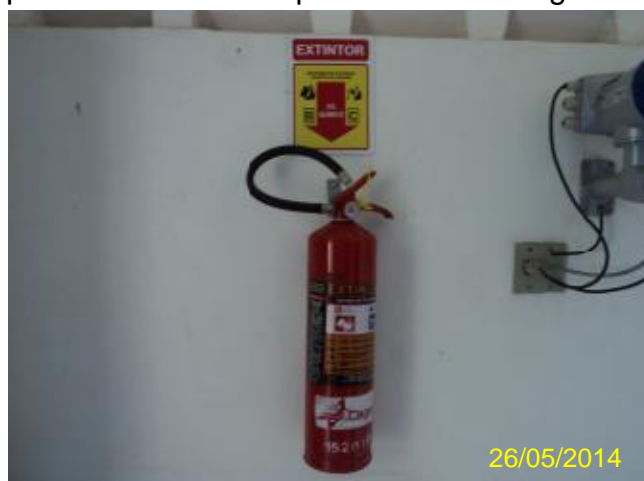
Foto 47 – Almojarifado: extintor de incêndio dentro do prazo de validade.
