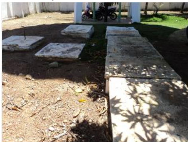
Foto 18 – REL-02: caixas de inspeção com tampas.
