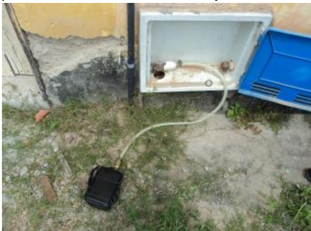
Foto 36 – RDA: medição contínua de pressão na Av. Porfírio de Araújo.
