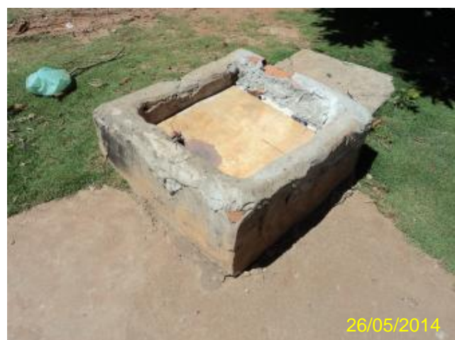
Foto 9 – REN-01: tampa de inspeção inadequada.
