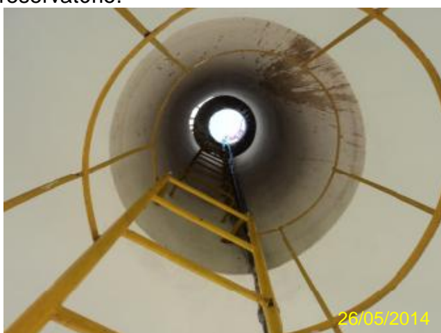
Foto 14 – REL-02: ausência de tampa de inspeção.
