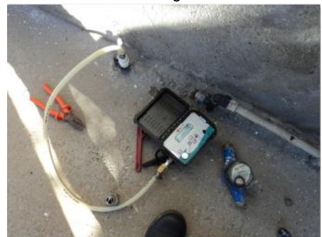
Foto 32 – RDA: medição instantânea de pressão na Av. Porfírio de Araújo – saída para São Luiz do Curu.
