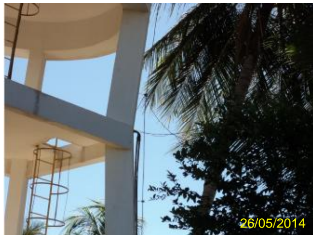
Foto 17 – REL-02: fiação da torre de transmissão no isolamento do para-raio.
