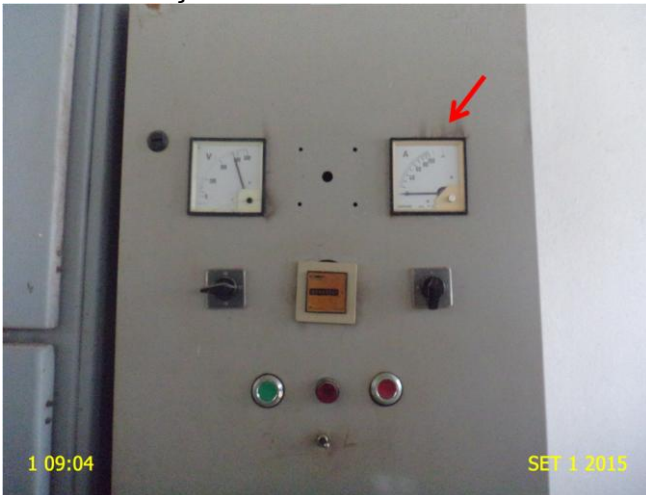
Foto 10 – EECS-01: amperímetro com defeito.
