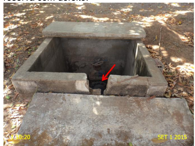
Foto 13 – REL-02: ausência de tampa e caixa de inspeção danificada.
