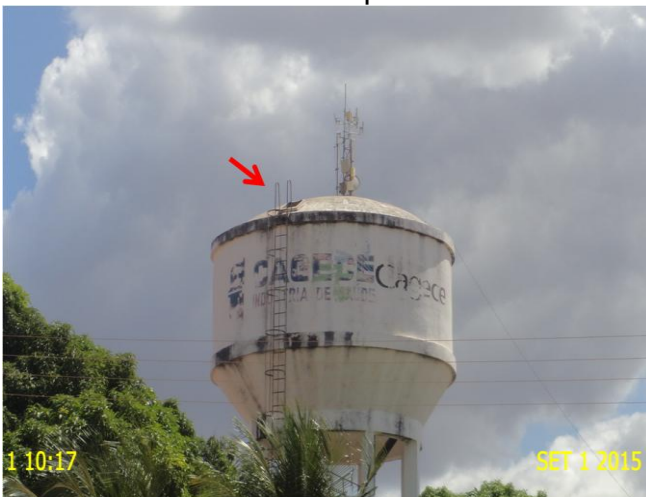
Foto 4 – REL-02: ausência de tampa, de sinalizador noturno e pintura deteriorada.
