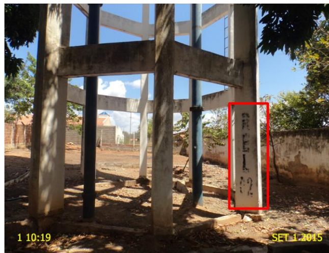
Foto 15 – REL-02: identificação pouco visível.
