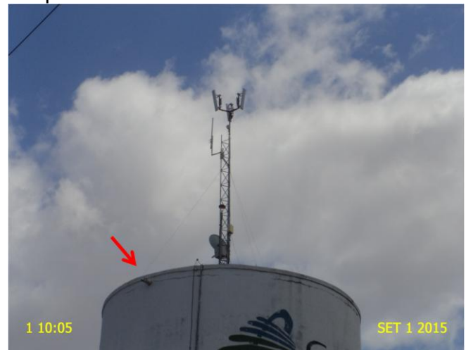
Foto 5 – REL-01: ausência de sinalizador noturno e de guarda-corpos.
