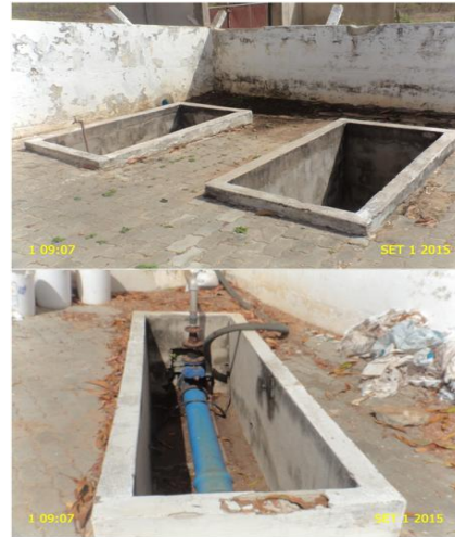
Foto 9 – ETA: caixas de inspeção sem tampa ou grade de proteção.
