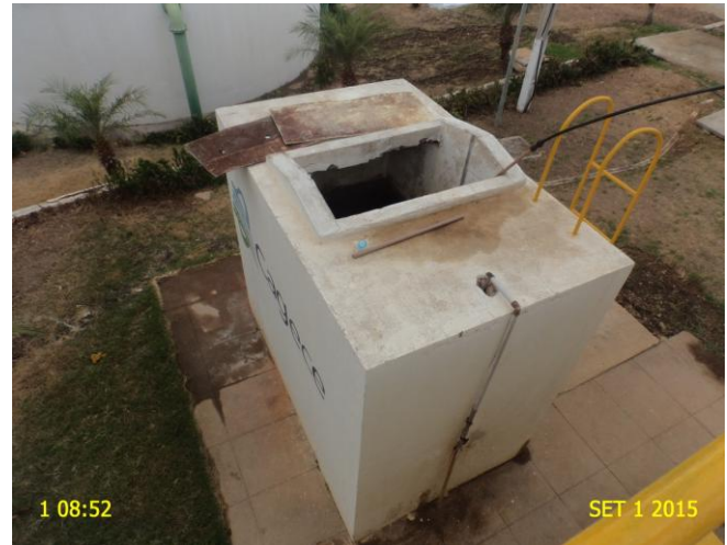
Foto 3 – Caixa de contato: ausência de tampa.
