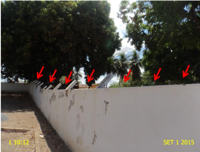
Foto 14 – REL-01: cerca danificada.
