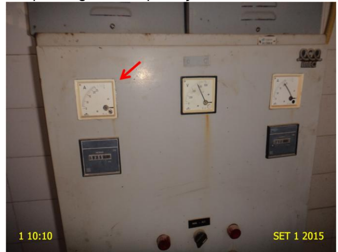
Foto 11 – EEAT-03: amperímetro da bomba reserva com defeito.
