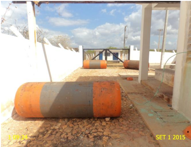
Foto 2 – ETA: cilindros de cloro gasoso instalado de forma inadequada.
