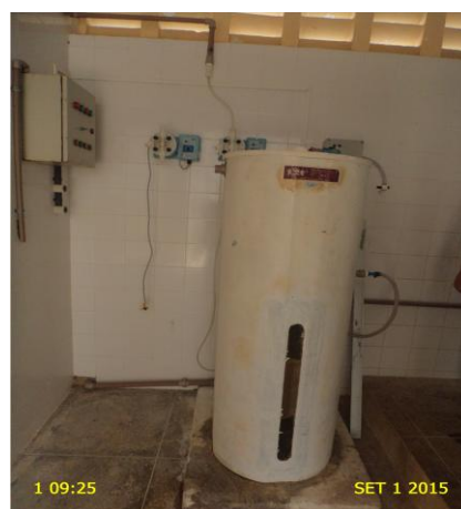
Foto 7 – Casa de química: dosador de flúor com defeito.
