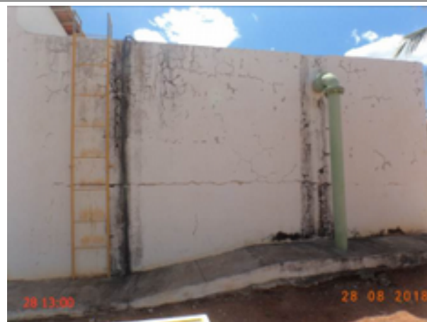
Foto 18 - Reservatório: RAP-02 com pintura deteriorada e sem identificação.
