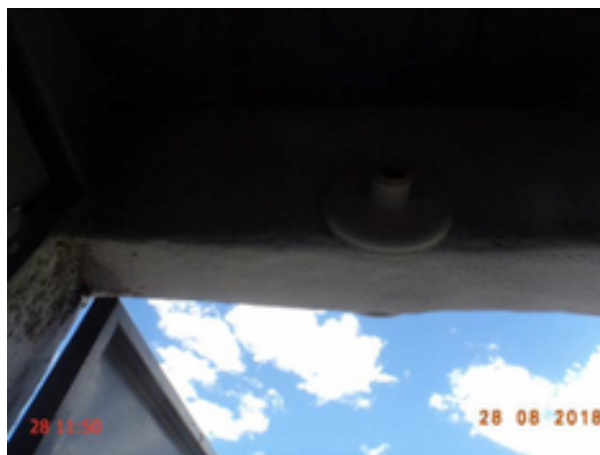
Foto 4 – casa de abrigo PT-02: sem lâmpada na área interna.
