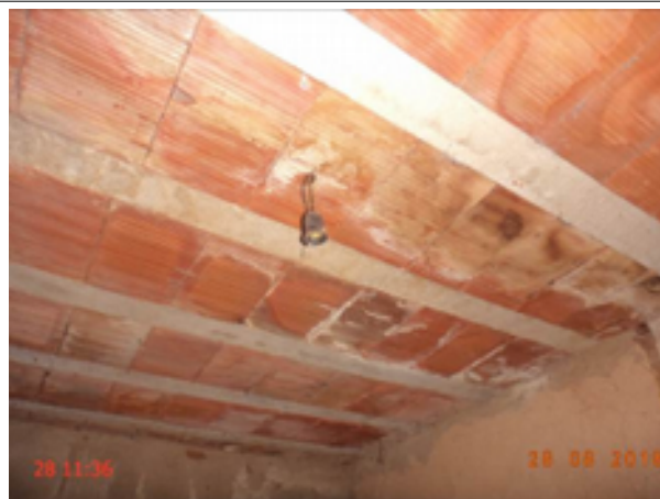
Foto 6 - Captação Subterrânea: casa de abrigo do quadro de comando do PT – 03 está sem lâmpada na área interna.
