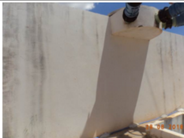
Foto 17 – Reservatório: RAP-01 com pintura deteriorada e sem identificação.
