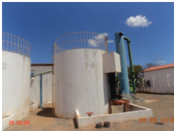
Foto 26 – Filtração: filtro F-01 com a identificação pouco visível e pintura deteriorada.
