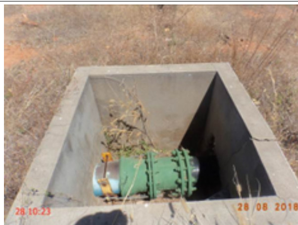
Foto 23 – Captação Superficial: caixa de passagem sem tampa ou grade de proteção na área captação superficial.
