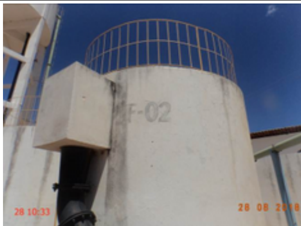
Foto 27 - Filtração: filtro F-02 com a identificação pouco visível e pintura deteriorada.
