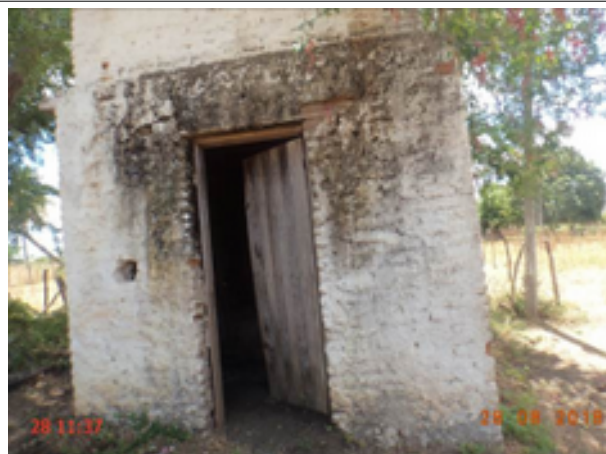
Foto 5 Captação Subterrânea: casa de abrigo do quadro de comando do PT – 03 sem identificação, com pintura deteriorada e sem lâmpada na área externa.
