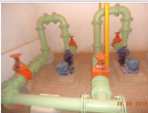
Foto 9 - Elevatórias: EEAT-03 sem identificação.
