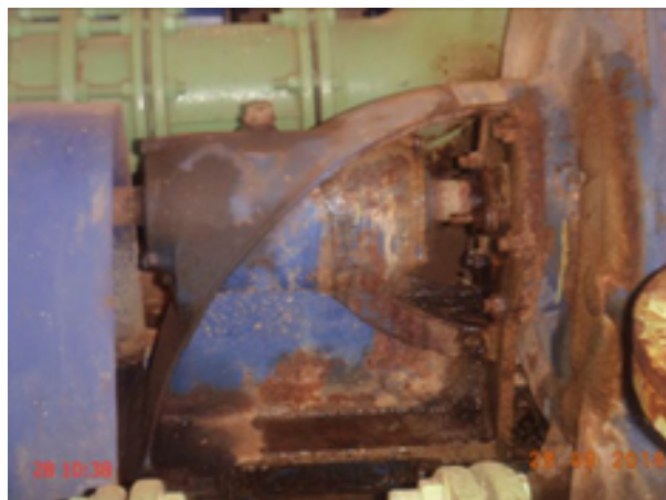
Foto 13 – Elevatórias: vazamento na gaxeta da bomba da EEAT-01.
