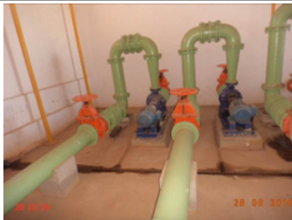
Foto 8 - Elevatórias: EEAT-02 sem identificação.
