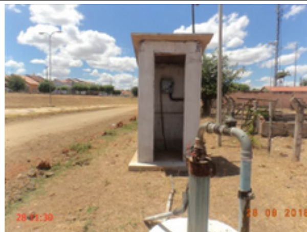
Foto 28 – Captação Subterrânea: PT-06 sem identificação e a casa de abrigo do quadro de comando está sem porta.
