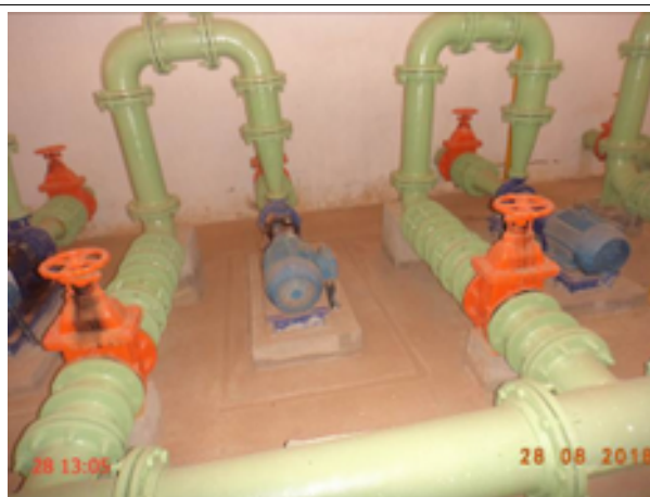
Foto 10 - Elevatórias: EEAT-04 sem identificação.
