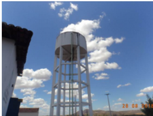
Foto 20 - Reservatório: REL-02 com pintura deteriorada e sem identificação.
