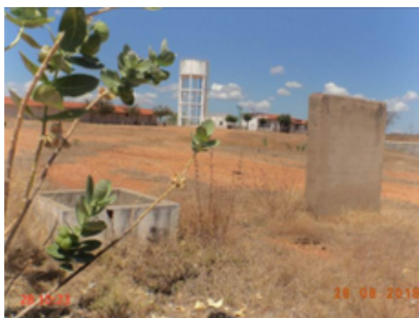
Foto 37 – Captação Superficial: Ausência de identificação de que aquela área é destinada ao abastecimento público.
