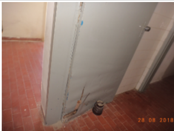
Foto 29 – Comercial: a porta da loja de atendimento da Cagece está deteriorada.
