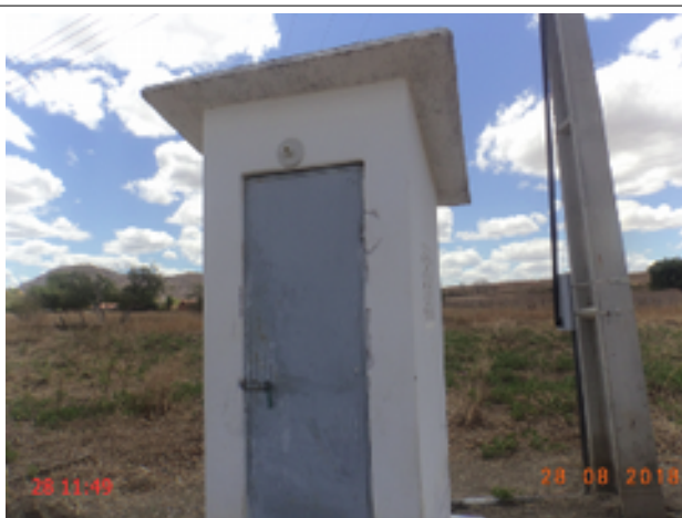
Foto 3 – casa de abrigo PT-02: sem lâmpada na área externa.
