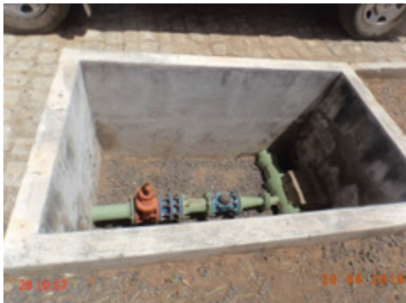
Foto 25 – ETA: caixa de passagem do macromedidor sem tampa ou grade de proteção.
