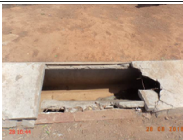
Foto 22 – ETA: canaleta com laje danificada na área da ETA.
