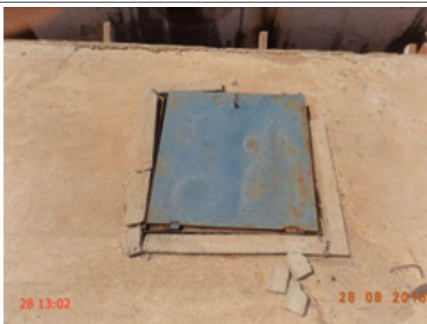
Foto 15 – Reservatórios: tampa de inspeção do reservatório RAP-02 em processo de corrosão.
