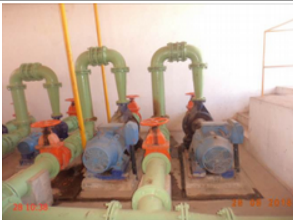
Foto 7 – Elevatórias: EEAT-01 sem identificação.
