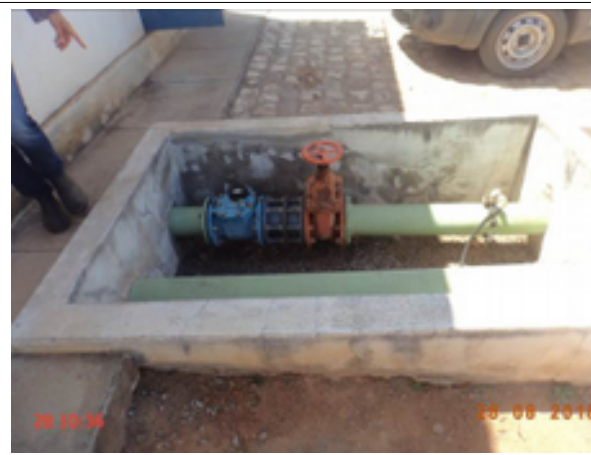
Foto 24 - ETA: caixa de passagem do macromedidor sem tampa ou grade de proteção.
