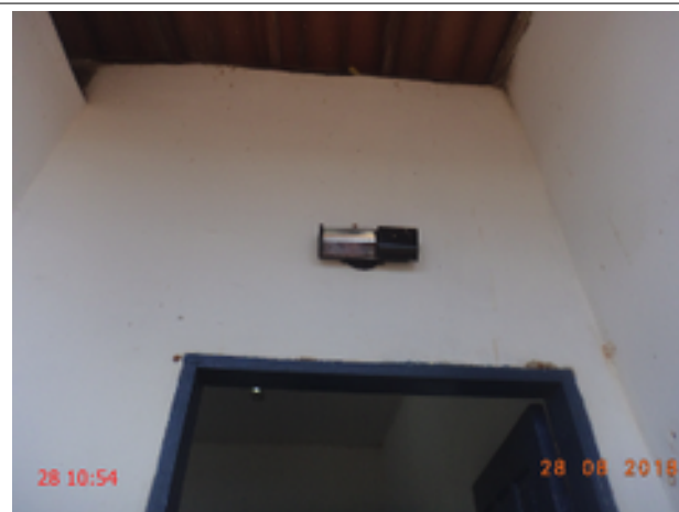
Foto 16 – ETA: laboratório não está identificado.
