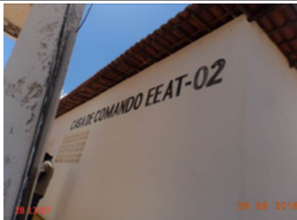
Foto 12 – Elevatórias: casa de abrigo das elevatórias EEAT -03, EEAT-04 e EEAT-05 está com a identificação incorreta.
