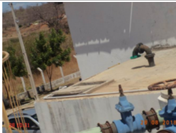
Foto 14 – Reservatórios: tampa de inspeção do reservatório RAP-01 está aberta.
