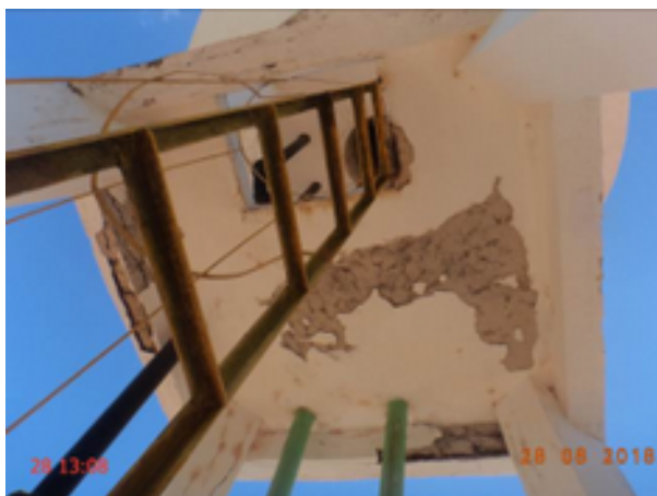
Foto 19 - Reservatório: REL-01 com pintura e estrutura deteriorada e armadura exposta.
