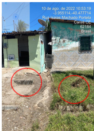
Foto 14 - Rede/esgoto: ligações na rede de esgoto sem a mesma está interligada a CAGECE.
