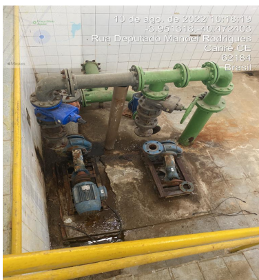
Foto 2 - EEAT-01: ausência de bomba reserva.
