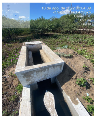
Foto 6 - ETE: disposição inadequada dos resíduos.
