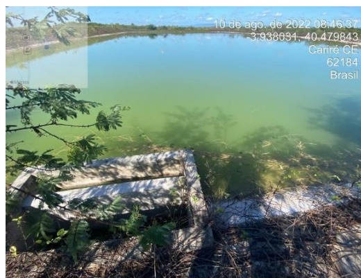
Foto 11 - ETE: mau funcionamento da caixa de saída da LM - 02 .
