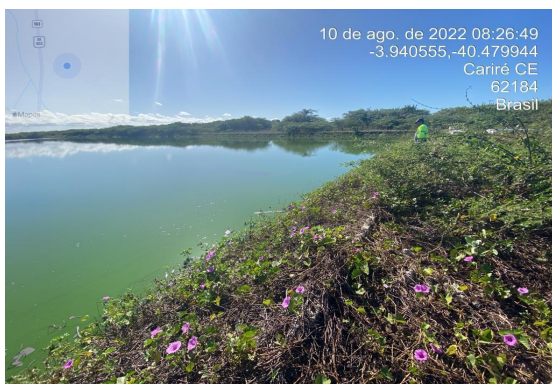
Foto 12 - ETE: obstrução da saída esquerda da lagoa facultativa, ocasionando acúmulo de sobrenadantes.
