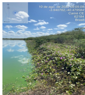
Foto 7 - ETE: lateral da lagoa facultativa tomada pela vegetação.
