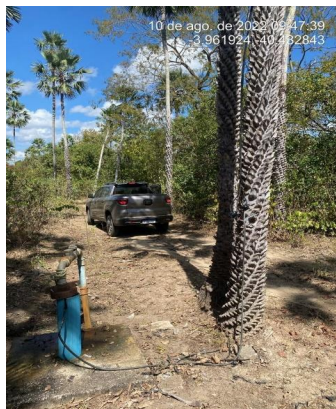
Foto 4 - Captação: objeto de vandalismo.
