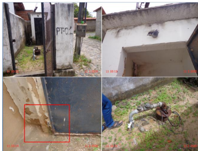
Foto 2 – PT-03: identificado como PT-01, ausência de iluminação, portão sem fixação e ausência de laje de proteção.
