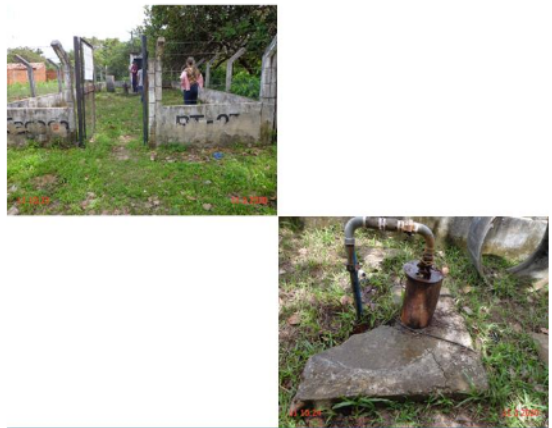
Foto 7 – PT-07: identificação pouco visível, pintura deteriorada, laje de proteção danificada.
