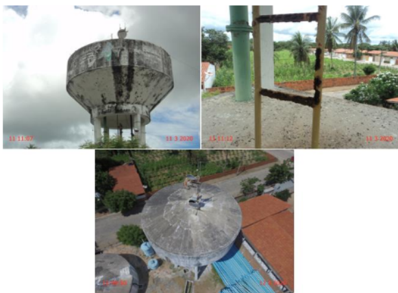
Foto 5 – REL-01: pintura deteriorada, identificação pouco visível, escada em processo de corrosão, abertura de inspeção sem tampa.
