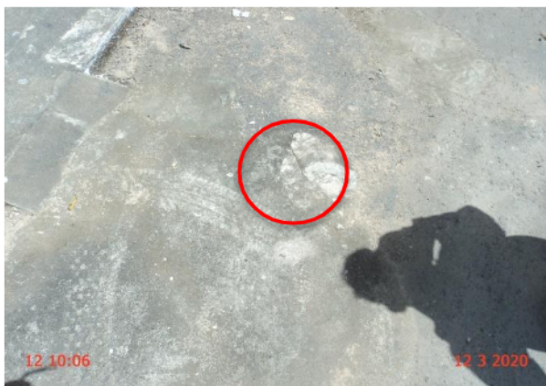
Foto 10 – RDA: registro de descarga soterrado, localizado no endereço Rua Duca Silveira.
