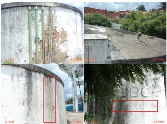
Foto 8 – RAP-01: pintura deteriorada, tubulação de ventilação em processo de corrosão, ausência de tela de proteção na tubulação de ventilação, mangueira de nível opaca e identificação pouco visível.
