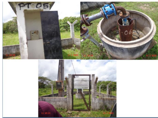
Foto 4 – PT-06: identificado como PT-05, ausência de tampa, pintura deteriorada e portão sem fixação.
