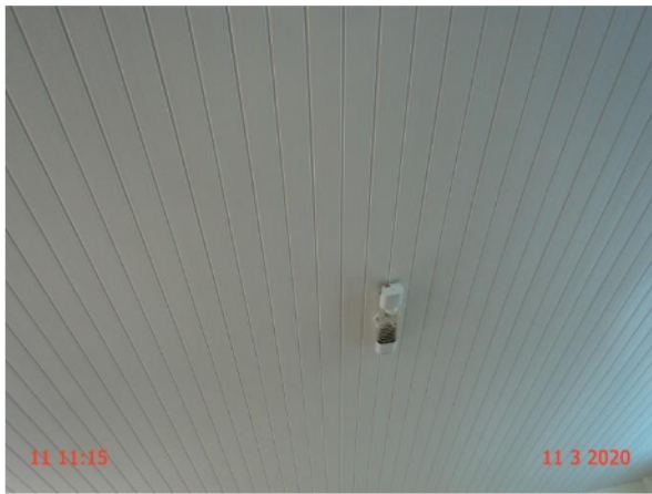
Foto 6 – Laboratório: ausência de iluminação.
