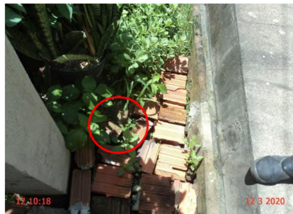
Foto 13 – RDA: registro de descarga soterrado, localizado no endereço Rua João Muniz.
