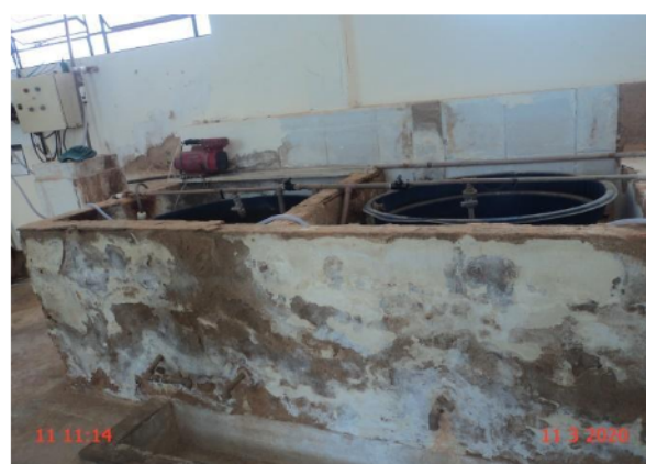
Foto 15 – Casa de Química: tanque de dosagem com estrutura deteriorada.
