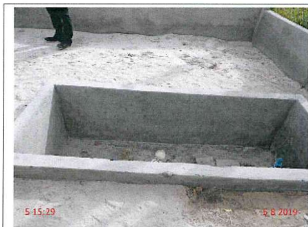
Foto 2 – PT-07: Ausência de tampa ou grade na caixa do macromedidor.
