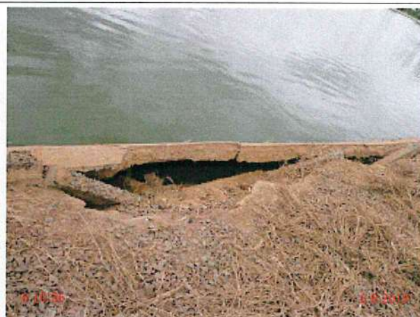
Foto 5 – Lagoa Facultativa: Placas do talude desmoronando.
