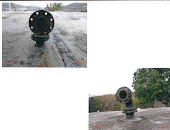
Foto 3 – RAP-02: Tubulação de ventilação inadequada.
