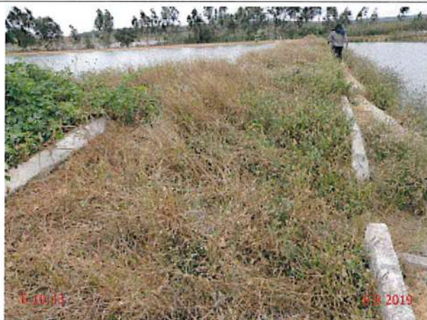
Foto 4 – Lagoa de Maturação: excesso de vegetação nos taludes.
