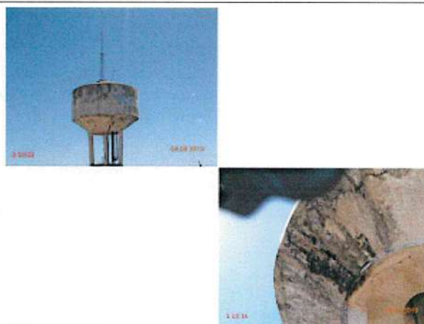
Foto 15 – REL-01: presença de infiltração.
