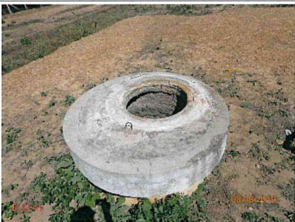
Foto 20 – ETE: Poço de visita sem tampa.
