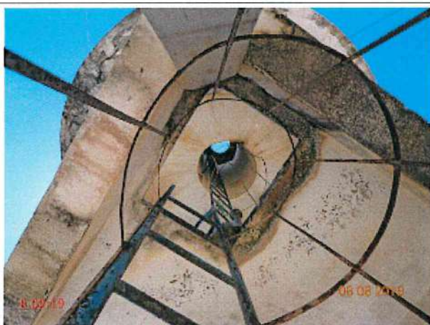
Foto 4 – REL-01: Ausência de tampa de inspeção.
