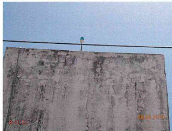
Foto 7 – REL-03: Ausência de guarda corpo.
