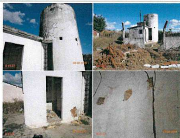
Foto 13 – PT-01: casa de abrigo deteriorada.
