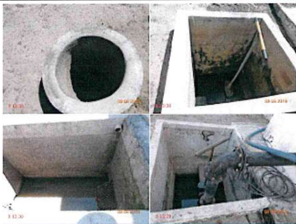
Foto 10 – EEE-01: Ausência de tampa na caixa do registro de entrada, caixa de passagem, gradeamento e poço de sucção.
