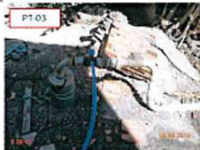
Foto 6 – PT-01 e PT-03 ausência de laje de proteção.
