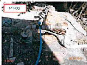
Foto 18 – PT-01 e PT-03 ausência de identificação.
