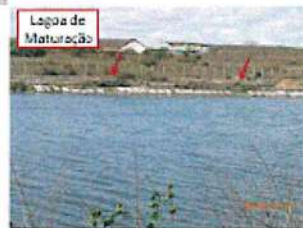
Foto 17 – ETE: Placas danificadas das lagoas facultativas e de Maturação.
