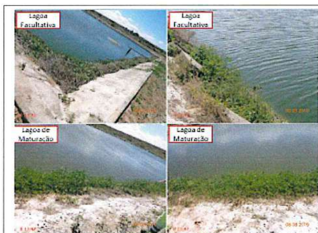
Foto 8 – ETE: Excesso de vegetação nas placas das lagoas facultativa e de Maturação.
