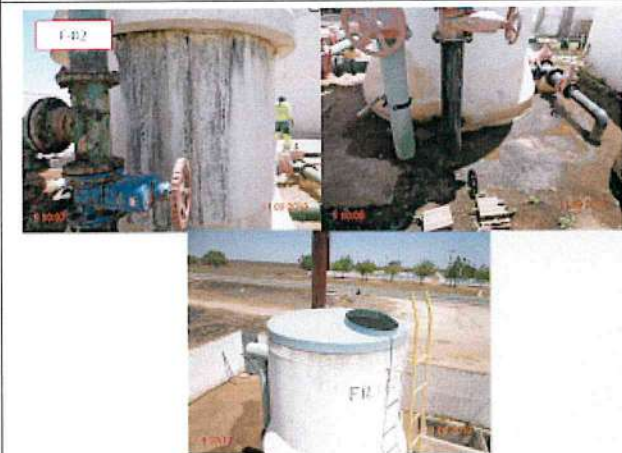
Foto 14 – F-02 (Jardim de São José): Sinais de infiltração, registro não veda e calha sem tampa.
