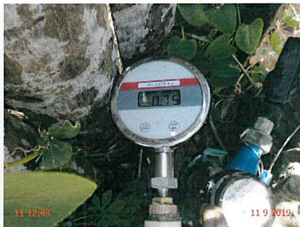
Foto 4 – RDA (São João de Deus): pressão instantânea fora da faixa de 10 a 50 mca na Rua Padre Marcondes, 2777.
