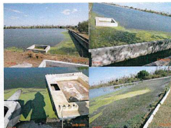
Foto 53 – Lagoa de Maturação (1) (Sede): presença de sobrenadantes.
