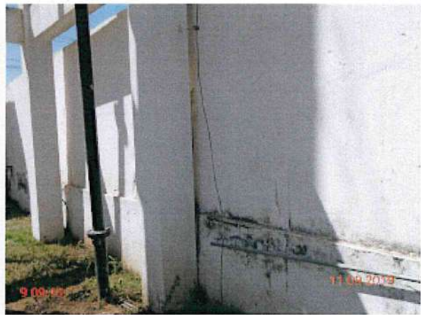
Foto 47 – REL-01 (Flores): para-raio sem proteção mecânica.
