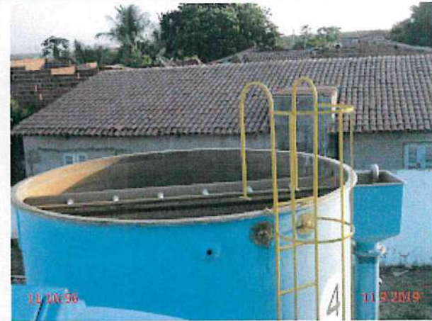
Foto 15 – F-04 (Sede): ausência de tampa.
