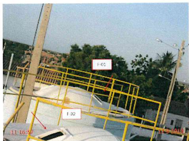
Foto 42 – F-01, F-02 (Sede): abertura de inspeção sem tampa.
