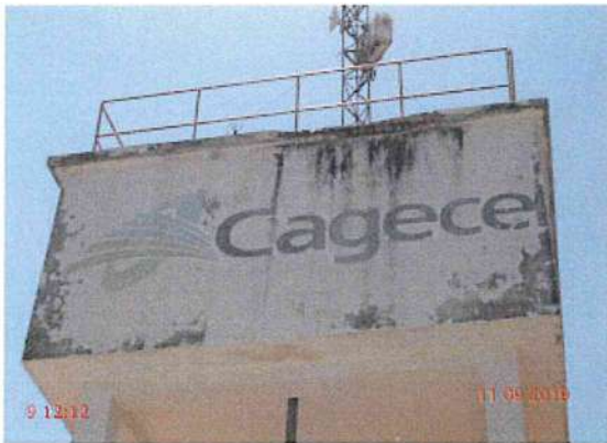
Foto 18 – REL-01 (São João de Deus): pintura e estrutura deteriorada, ausência de sinalização noturna.
