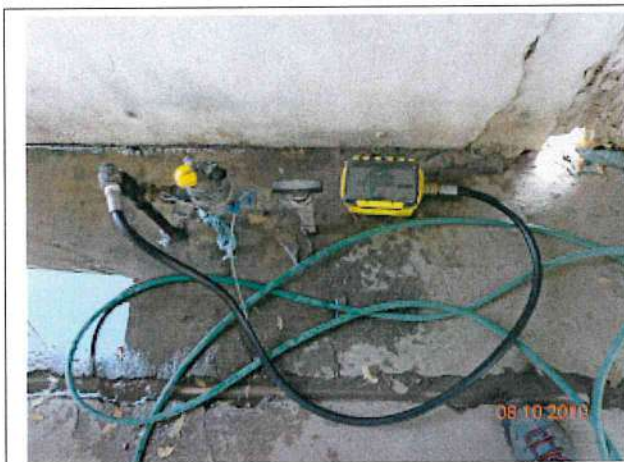
Foto 1 – RDA (São João de Deus): pressão datalogger fora da faixa de 10 a 50 mca na Rua Padre Agostinho, 2580.
