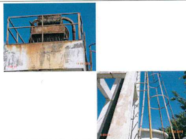
Foto 60 – ETA (Flores): Aerador em processo de corrosão, guarda-corpo em processo de corrosão e pintura deteriorada.
