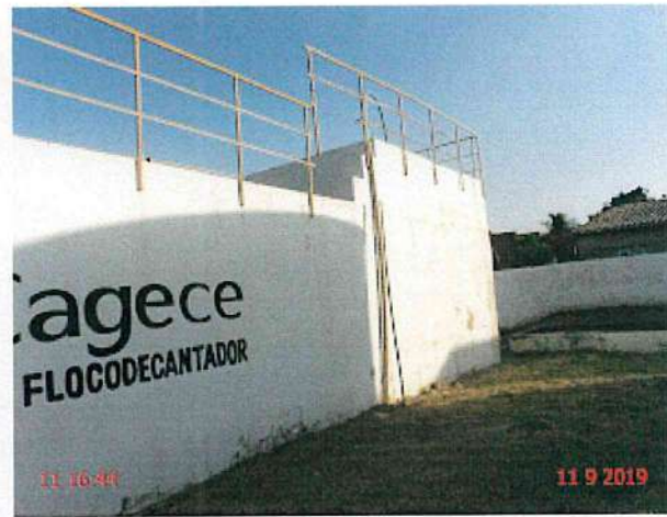
Foto 35 – FDC-02 (Sede) pintura deteriorada.
