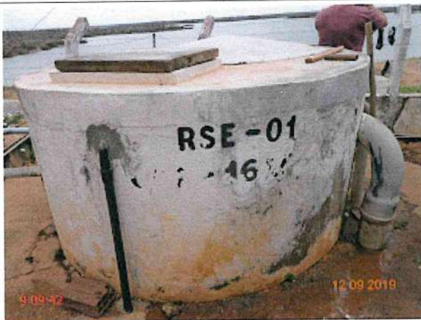
Foto 56 – RSE-01 (Bonhu): Pintura deteriorada.
