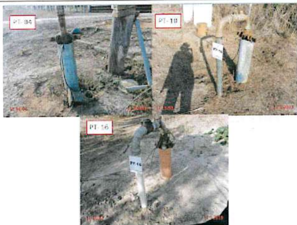
Foto 22 – PT-04, PT-10, PT-16 (Sede): ausência de laje e tampa.
