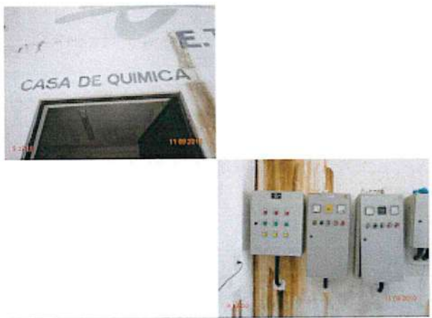
Foto 40 – Casa de química (São João de Deus): pintura deteriorada e PT-01 quadro de comando com defeito.
