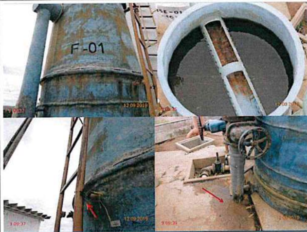
Foto 12 – F-01 (Bonhu): Pintura deteriorada, ausência de tampa, escada quebrada e registro não veda.
