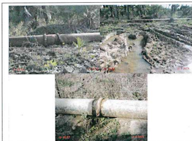
Foto 28 –AAB (Sede): vazamentos na adutora.
