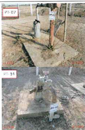
Foto 24 – PT-07 e PT-14 (Sede): ausência de tampas.
