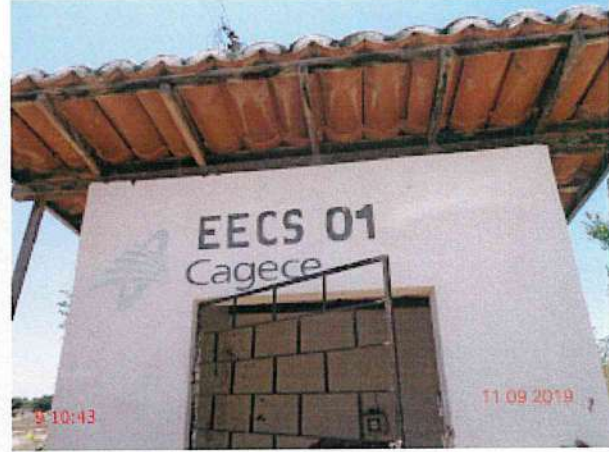
Foto 77 – PT-02 (Jardim de São José): identificação incorreta.
