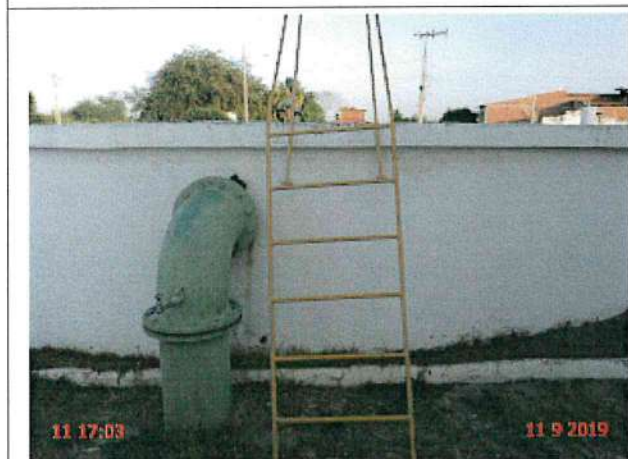
Foto 30 – RSE-01 (Sede): escada solta.
