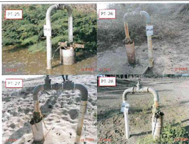
Foto 26 – PT-25, PT-26, PT-27, PT-28 (Sede): ausência de tampas.
