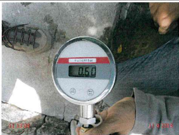
Foto 5 – RDA (São João de Deus): pressão instantânea fora da faixa de 10 a 50 mca na Rua do Araújo, S/N.
