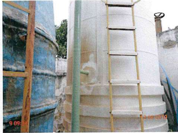
Foto 33 – Floccodecantador (Bonhu): Pintura deteriorada.
