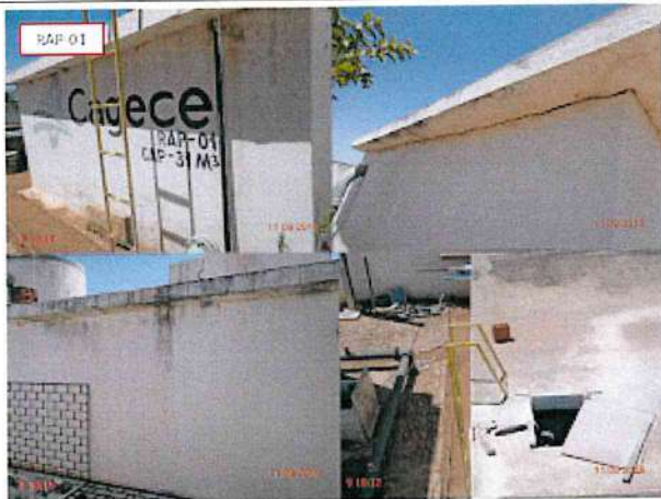
Foto 50 – RAP 01 (Jardim de São José): Pintura deteriorada, rachaduras na estrutura e laje de inspeção aberta.
