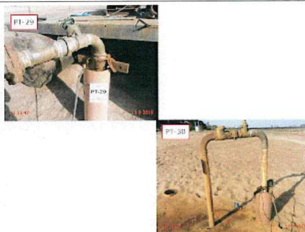
Foto 27 - PT-29, PT-30 (Sede): ausência de tampas.
