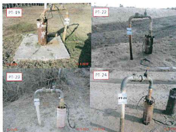
Foto 25 – PT-19, PT-22, PT-23, PT-24 (Sede): ausência de tampas.
