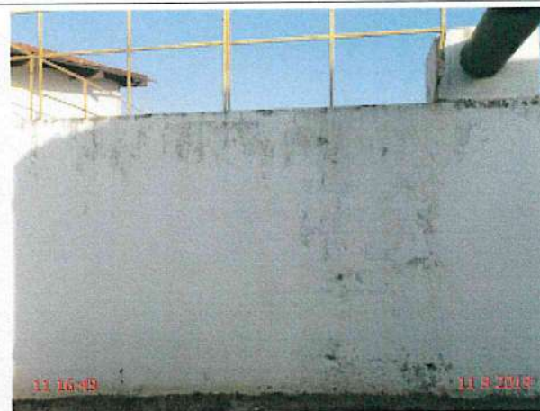
Foto 59 – PR-01 (Sede): ausência de identificação
