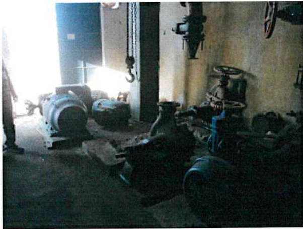
Foto 38 – EEAB-01 (Sede): ausência de iluminação.
