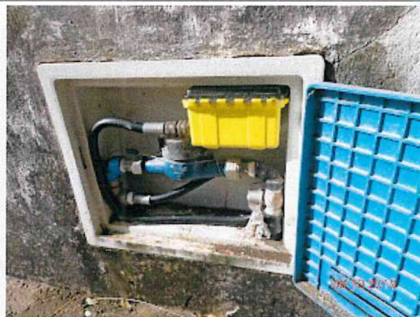
Foto 6 – RDA (Jardim de São José): pressão datalogger fora da faixa de 10 a 50 mca na Rua Firmino Estácio Sobrinho, 290.
