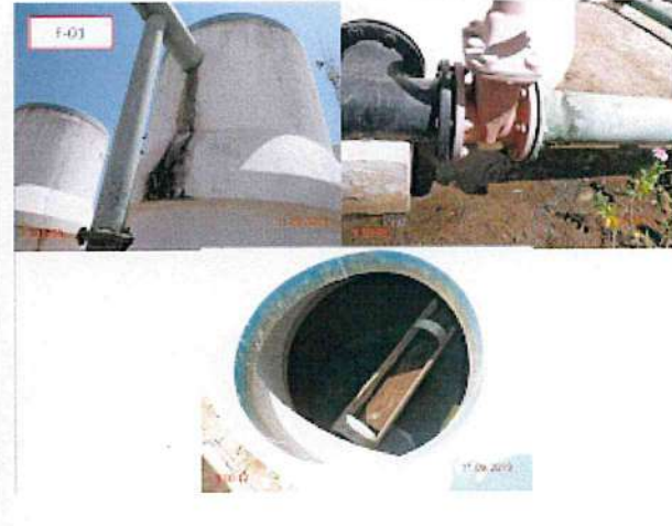
Foto 13 – F-01 (Jardim de São José): pintura deteriorada, sinais de infiltração, registro não veda e calha sem tampa.
