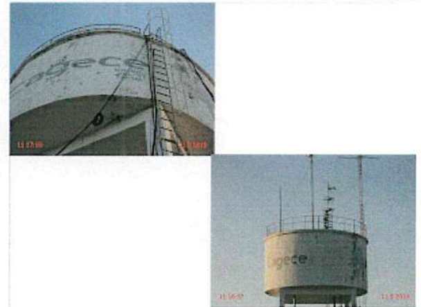
Foto 19 – REL-01 (Sede): ausência de sinalização noturna e pintura deteriorada.
