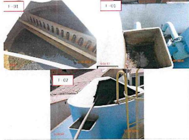
Foto 41 – F-01 e F-02 (Flores): ausência de tampas na laje de inspeção e calhas..
