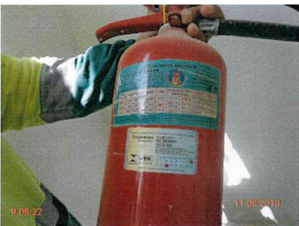
Foto 48 – Escritório/Loja de Atendimento (Flores): Extintor com recarga vencida.
