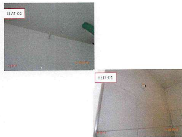
Foto 37 – EEAT-01 e EELF-01 (Jardim de São José) Elevatórias: ausência de iluminação
