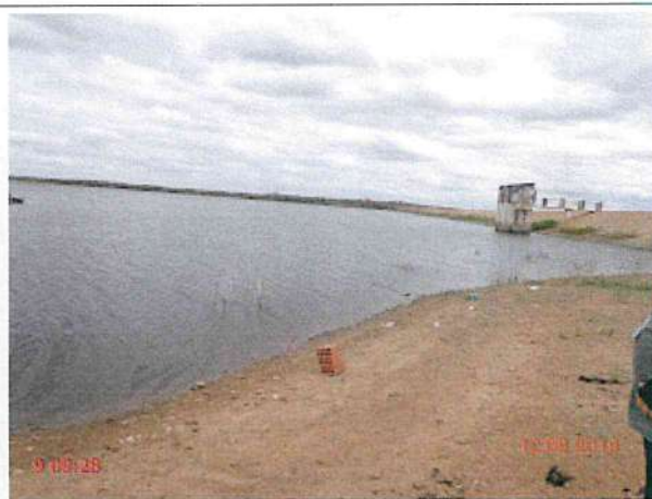
Foto 31 – EECS-01 (Bonhu): ausência de identificação.
