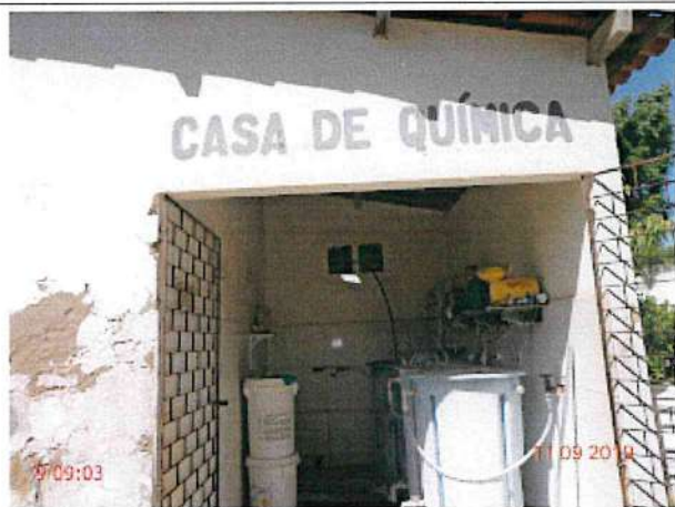
Foto 64 – Casa de química (Flores): Pintura deteriorada.
