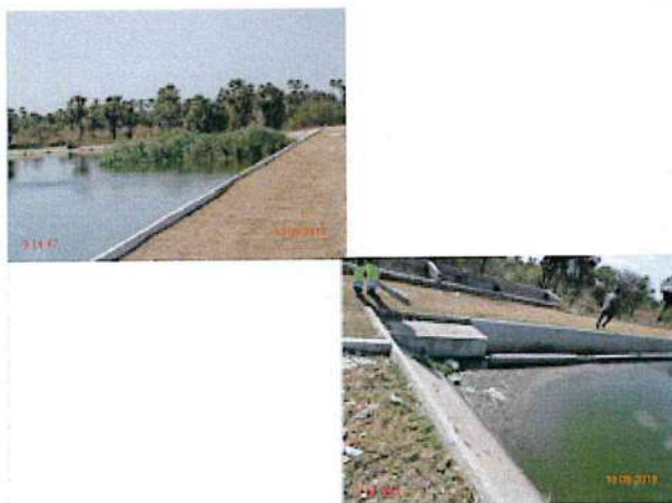
Foto 52 – Lagoa Facultativa (Sede): excesso de vegetação e presença de sobrenadantes.
