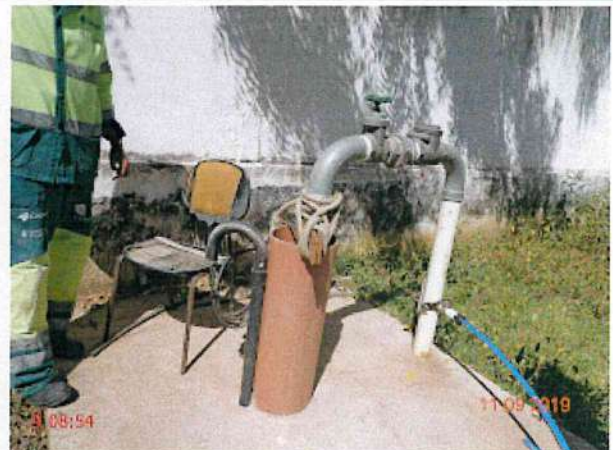
Foto 21 – PT-03 (Flores): ausência de tampa e identificação.
