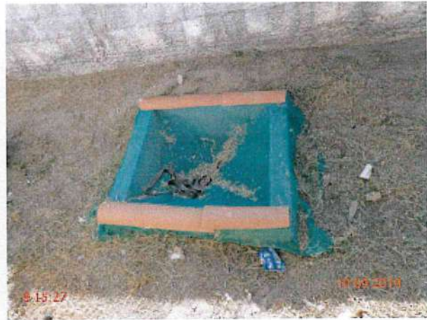
Foto 39 –EEE-06 (Sede): caixa de passagem sem tampa ou grade de proteção.
