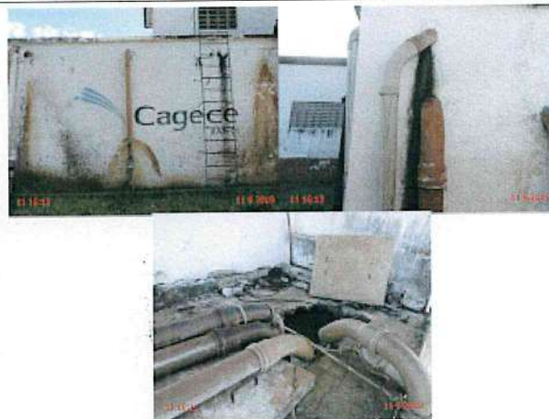
Foto 51 – RAP-01 (Sede): pintura deteriorada, sinais de infiltração, abertura de inspeção aberta.
