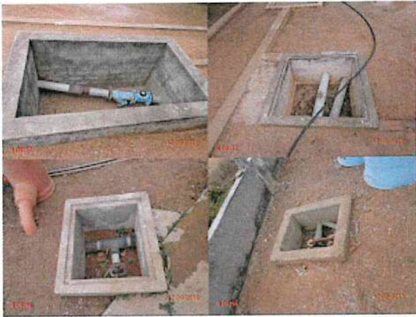
Foto 32 – ETA (Bonhu): Caixas sem tampa ou grade de proteção.
