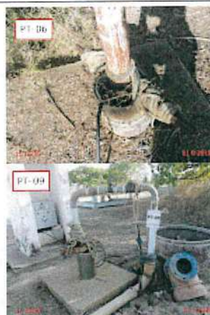
Foto 23 – PT-06 e PT-09 (Sede): ausência de tampas.
