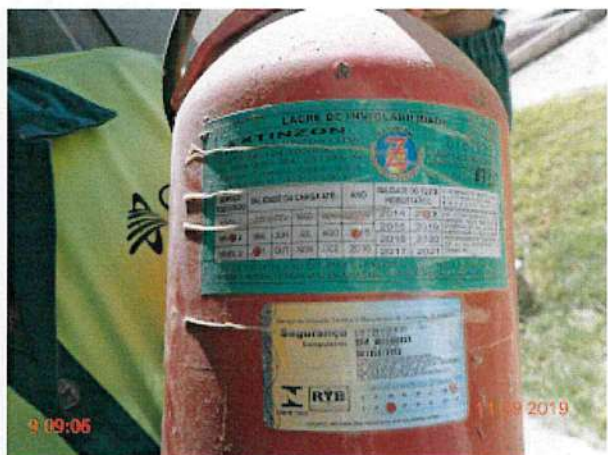
Foto 49 – EEAT-01 (Flores): Extintor com recarga vencida.
