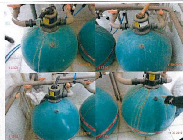
Foto 61 – Filtros (São João de Deus): ausência de identificação nos filtro FP-01, FP-02, FP-03 e FP-04.
