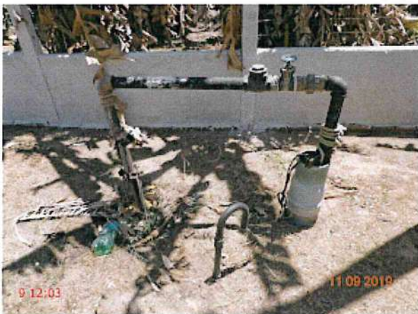
Foto 20 – PT-02 (São João de Deus): ausência de identificação, laje e tampa.
