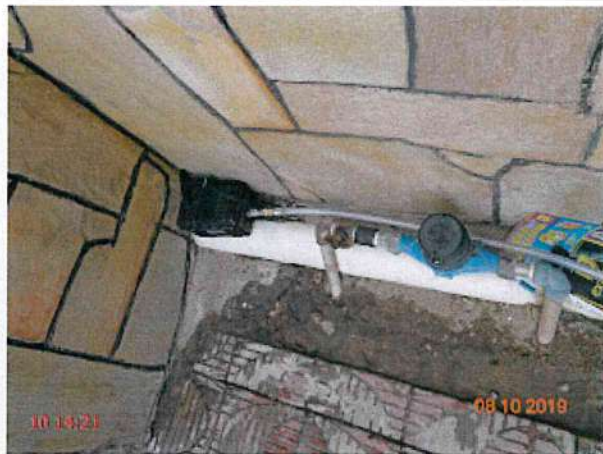
Foto 8 – RDA (Sede): pressão datalogger fora da faixa de 10 a 50 mca na Rua Nicanor Baltazar, 28.
