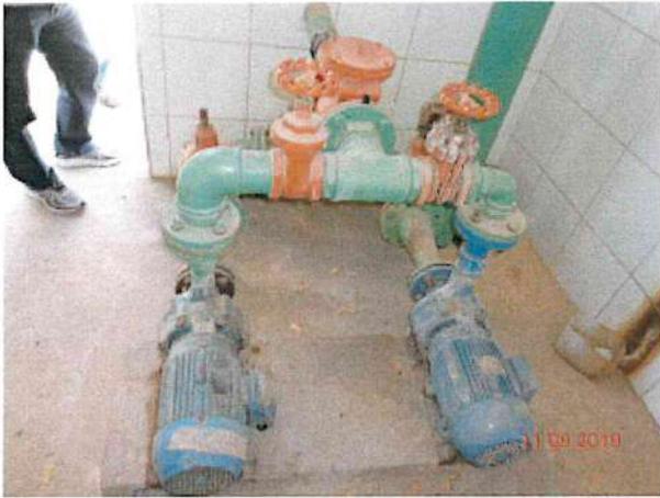
Foto 16 – EEAT-01 (Jardim de São José): ausência de bomba reserva.
