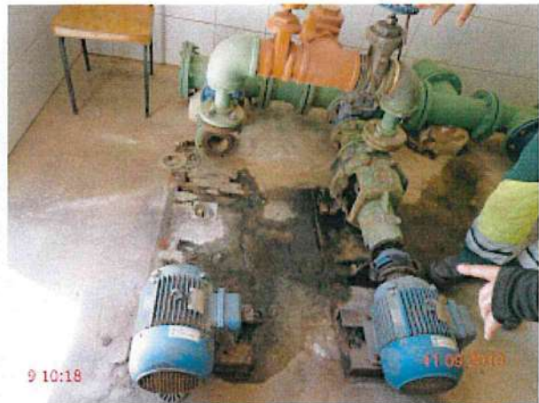
Foto 17 – EEAT-02 (Jardim de São José): ausência de bomba reserva.
