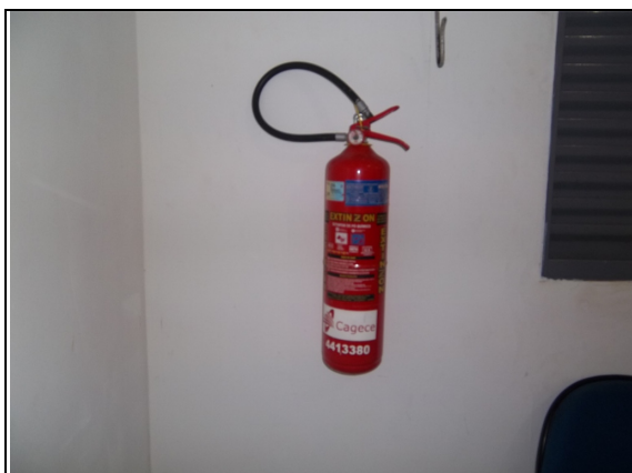
Foto 77 – Extintor de incêndio do escritório/atendimento/almoxarifado do SAA de Pentecoste.
