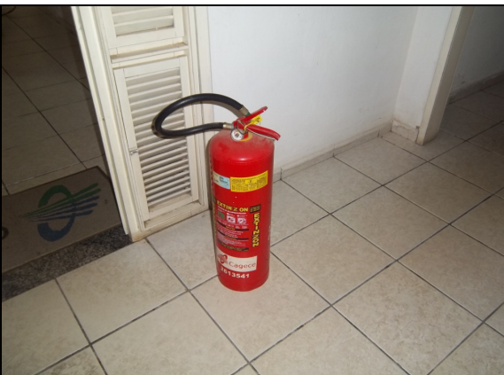
Foto 11 – Extintor de incêndio do escritório operacional do SAA de Itapipoca.
