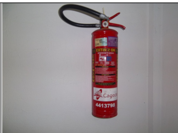
Foto 19 – Extintor de incêndio da loja de atendimento do SAA de Itapipoca.
