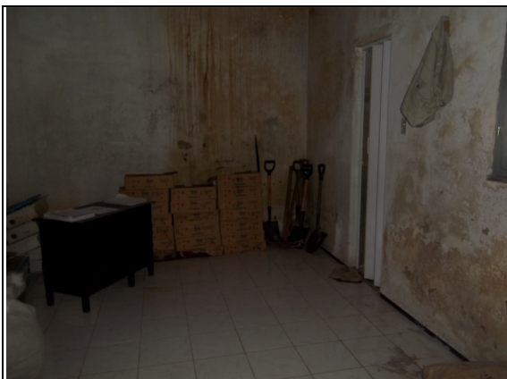
Foto 48 – Pintura deteriorada – almoxarifado e escritório do SAA de Uruburetama.
