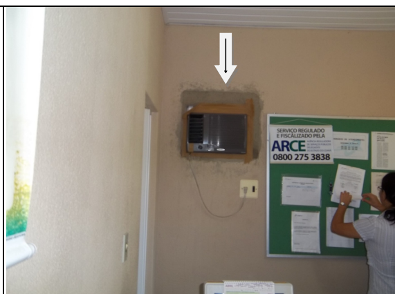
Foto 35 – Pintura deteriorada na parede do ar condicionado do escritório/atendimento do SAA de Miraíma.
