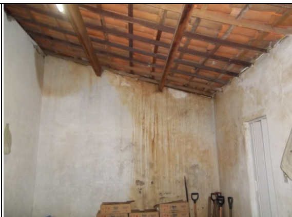
Foto 49 – Sinais de infiltração de água pela cumeeira – sala do fundo do escritório do SAA de Uruburetama.
