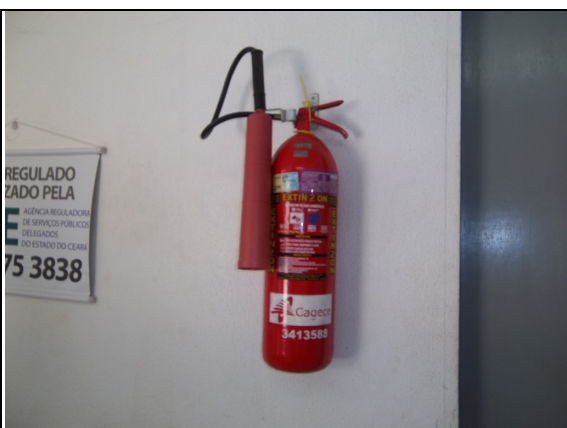
Foto 47 – Extintor de incêndio – escritório/atendimento/almoxarifado do SAA de Uruburetama.
