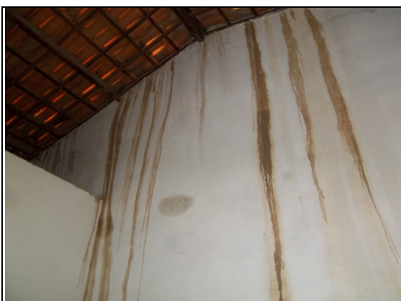
Foto 50 – Sinais de infiltração de água pela cumeeira – almoxarifado do SAA de Uruburetama.
