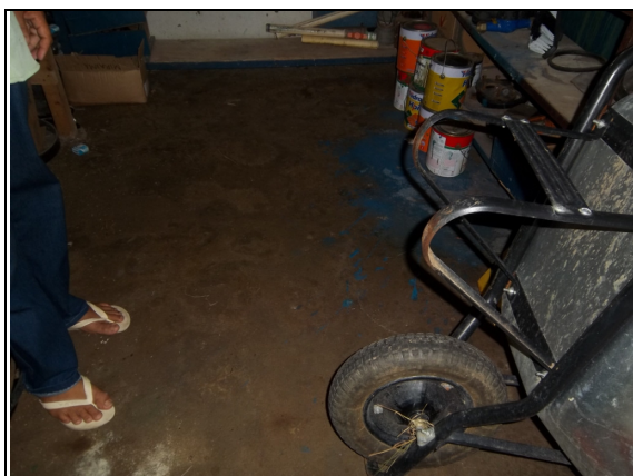
Foto 36 – Piso do almoxarifado, com sinais de infiltração de água, do SAA de Miraíma.
