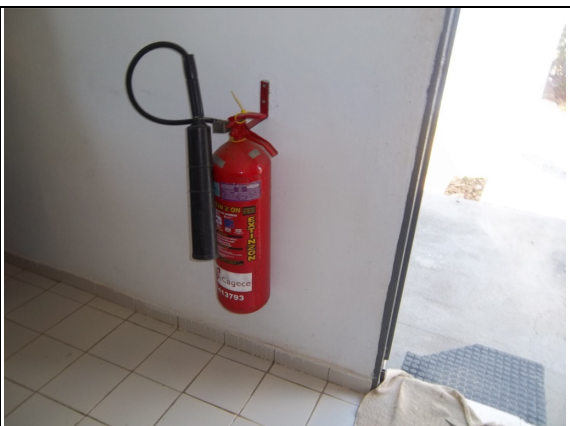
Foto 64 – Extintor de incêndio – escritório/atendimento almoxarifado do SAA de General Sampaio.
