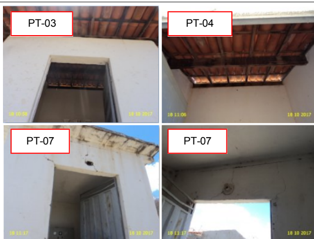
Foto 14 – PT-03, PT-04 e PT-07: ausência de iluminação.
