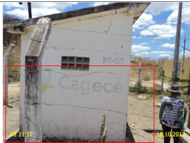
Foto 26 – PT-07: cerca danificada.
