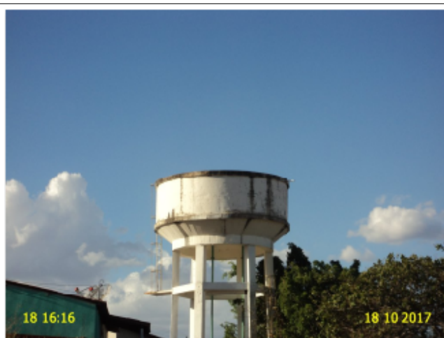
Foto 12 – REL-01: ausência de guarda corpos, para raios e sinalização noturna.
