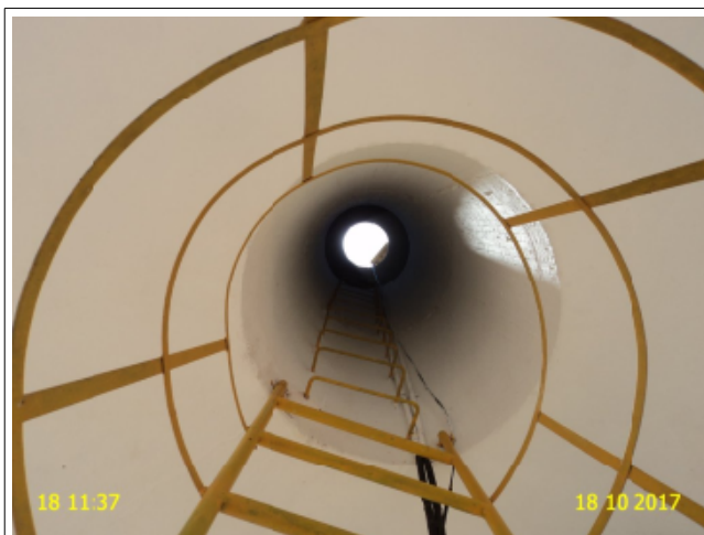
Foto 10 – REL-02: ausência de tampa de inspeção.
