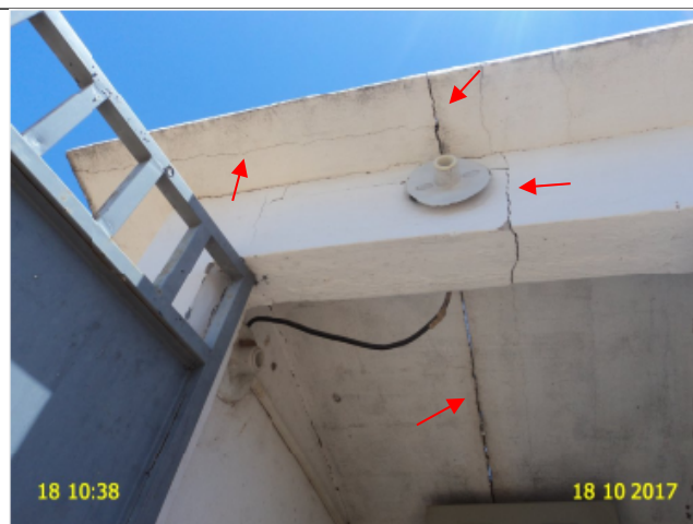
Foto 24 – PT-09: casa de abrigo com rachaduras.
