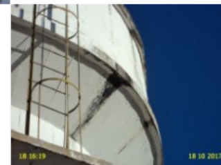
Foto 32 – REL-01: pintura deteriorada e sinais de vazamento.
