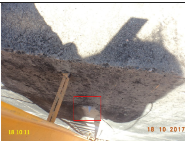
Foto 35 – REL-03: tubulação de ventilação quebrada e sem tela de proteção.
