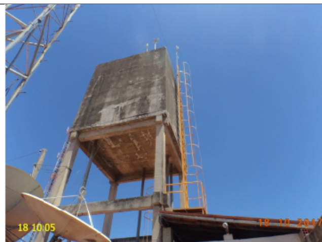
Foto 34 – REL-03: guarda-corpos com dimensionamento inadequado para garantir a segurança.
