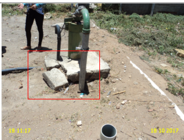
Foto 29 – PT-07: laje de proteção deteriorada.
