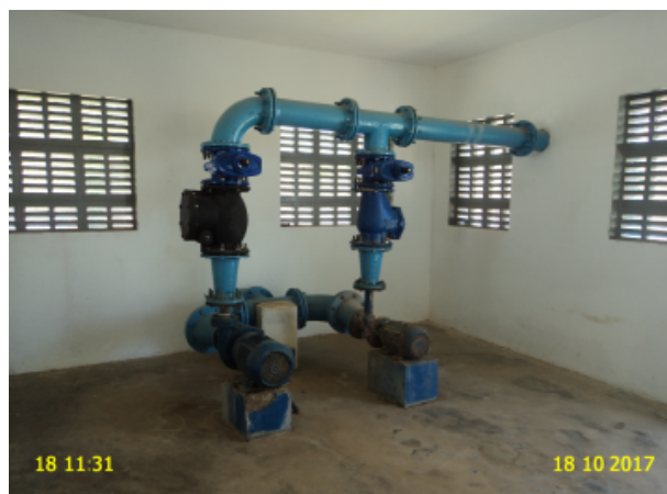
Foto 36 – EEAT-01: ausência de identificação.
