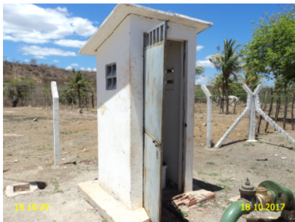
Foto 27 – PT-08: ausência de identificação.
