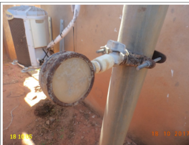
Foto 11 – REL-03: medidor de nível quebrado.
