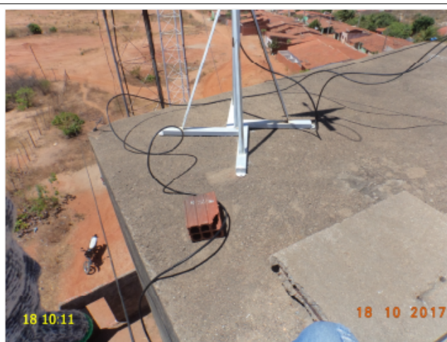
Foto 13 – REL-03: ausência de guarda-corpos na laje de cobertura.
