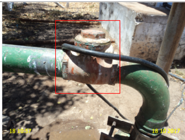
Foto 22 – PT-03: vazamento na tubulação.
