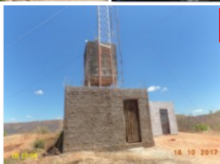
Foto 33 – RAP-02 e REL-03: pintura deteriorada.
