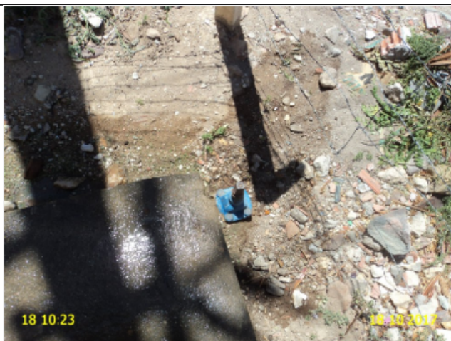
Foto 31 – RAP-02 e EEAT-02: registro sem caixa.
