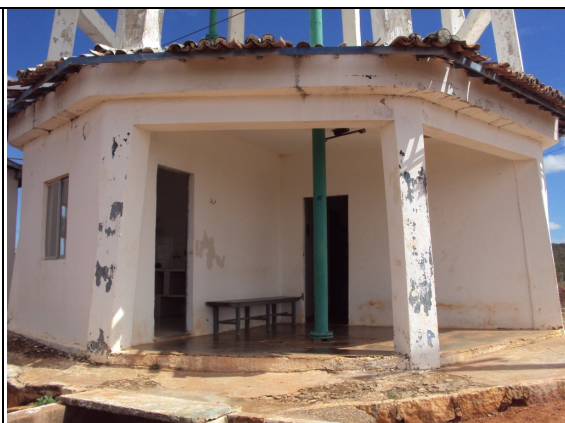
Foto 60 – Pintura e beiral deteriorado do escritório/atendimento/almoxarifado do SAA de Mangabeira.
