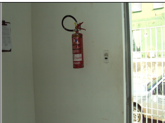
Foto 88 – Extintor de incêndio do escritório/atendimento do SAA de Farias Brito.
