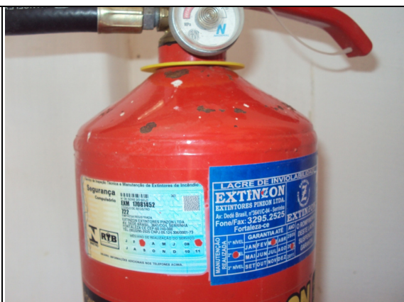
Foto 50 – Extintor de incêndio, dentro do prazo de validade, do SAA de Mangabeira.
