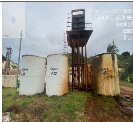
Foto 4 - Filtros ETA: Pintura deteriorada.
