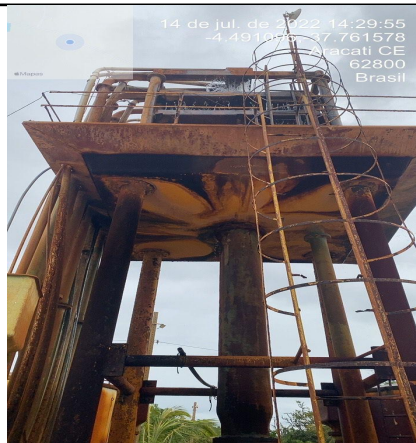
Foto 2 - Aerador: estrutura oxidada.
