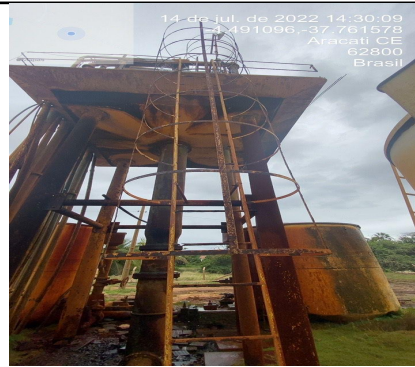
Foto 6 - Filtros ETA: Pintura deteriorada.
