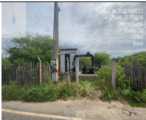
Foto 3 - EERD-04: Ausência de isolamento.
