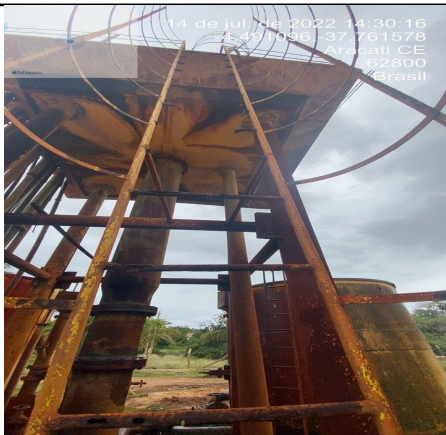
Foto 1 - Aerador: escada danificada e corroída.
