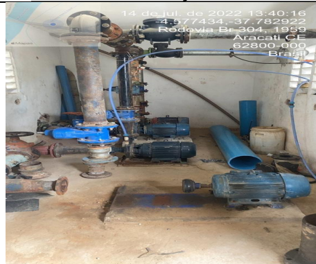
Foto 10 - EERD-02: Bomba reserva não .
