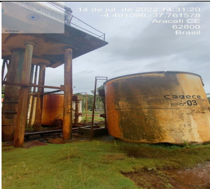
Foto 5 - Filtros ETA: Pintura deteriorada.
