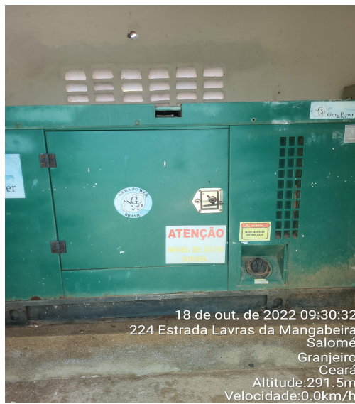
Foto 12 - ETE: gerador sem funcionar.
