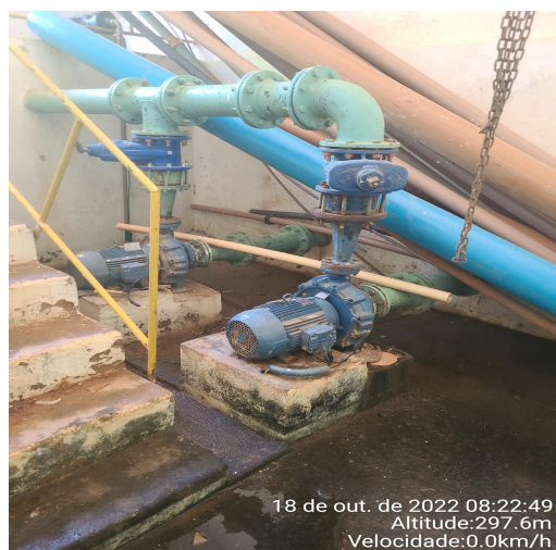
Foto 3 - EEAT-01: área alagada.
