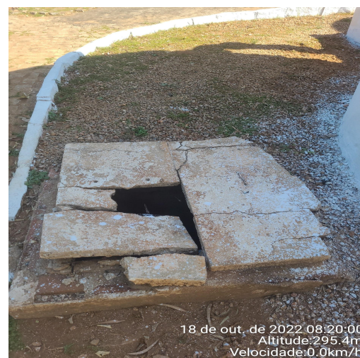
Foto 4 - RAP-01: caixa de inspeção com tampa quebrada.
