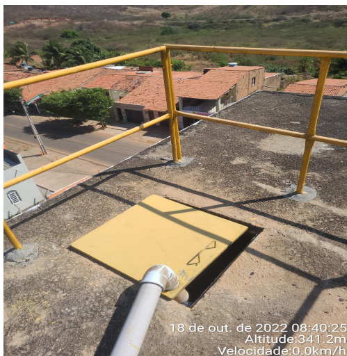
Foto 7 - REL-01: tampa não encaixada.
