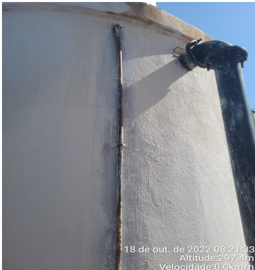
Foto 5 - RAP-01: mangueira sem possibilidade de aferição de nível.
