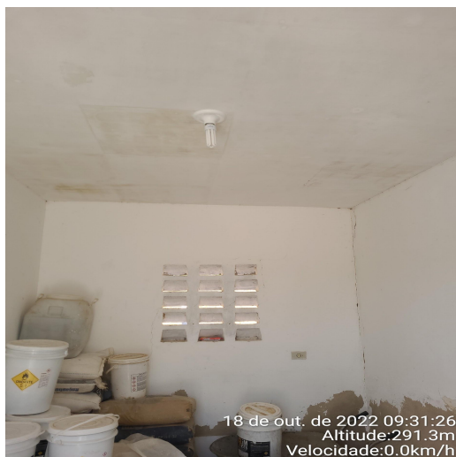
Foto 15 - ETE: almoxarifado sem lâmpada.
