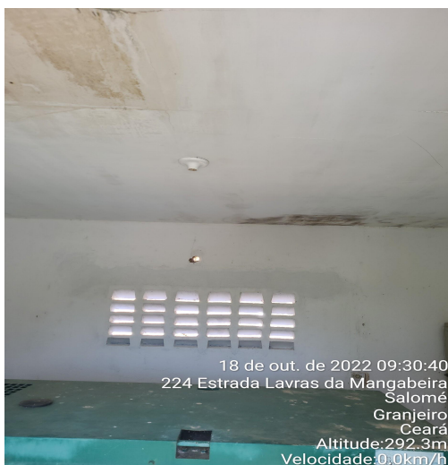
Foto 13 - ETE: casa do gerador sem lâmpada.
