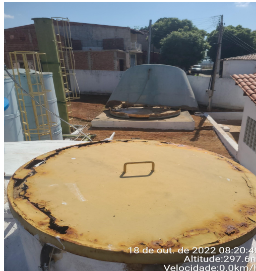
Foto 6 - RAP-01: tampa corroída e sem vedação.
