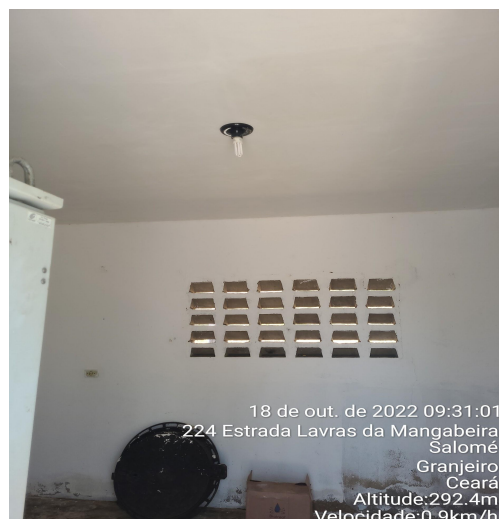
Foto 14 - ETE: casa do quadro de comando com lâmpada queimada.
