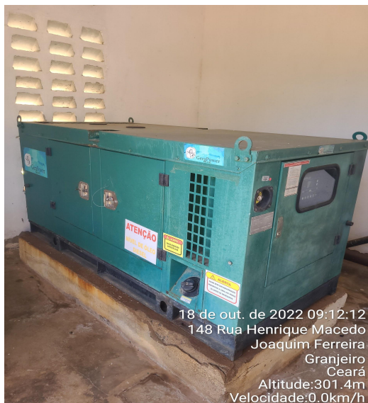
Foto 11 - EEE: gerador sem funcionar.
