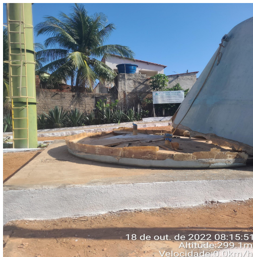
Foto 20 - ETA: decantador destruído.
