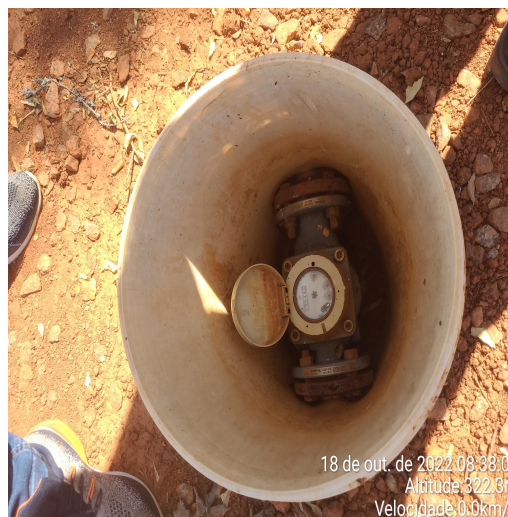
Foto 16 - REL-01: registro sem caixa de proteção.
