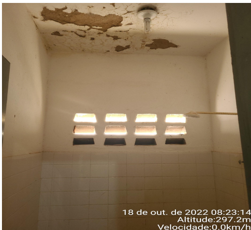
Foto 1 - ETA: teto do banheiro com reboco aparente.
