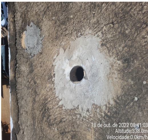
Foto 9 - REL-01: furo na laje.
