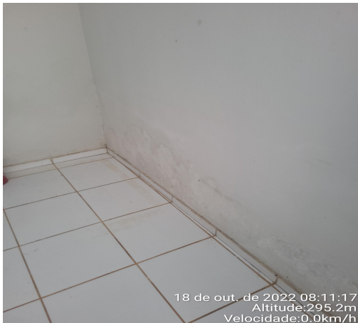
Foto 17 - Escritório ETA: alvenarias com presença de umidade e pintura deteriorada.
