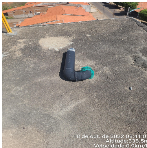
Foto 8 - REL-01: ausência de tubo de ventilação.
