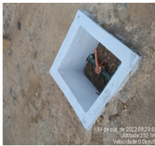
Foto 10 - ETA (Amanituba): caixa de proteção sem tampa/grade.
