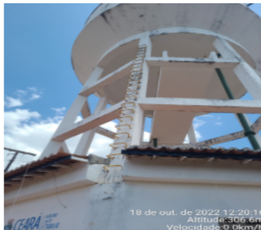
Foto 2 - REL-01 (Mangabeira): escada sem gaiola de proteção e com acesso dificultoso.
