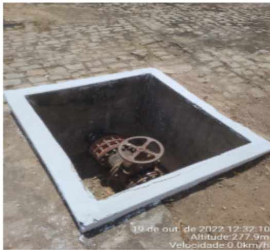
Foto 15 - RAP-01 e REL-02 (Sede): caixa de proteção sem tampa/grade.
