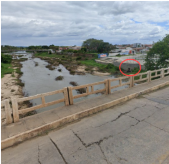
Foto 43 - SES: lançamento de efluentes in natura no Rio Salgado.
