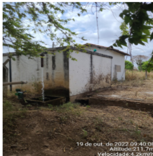
Foto 33 - RAP-01 (Amanitutuba): pintura desgastada.
