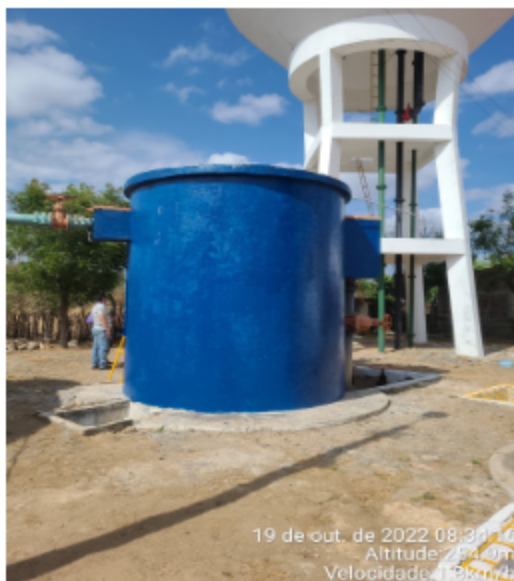
Foto 26 - ETA (Amaniutuba): filtro sem identificação.
