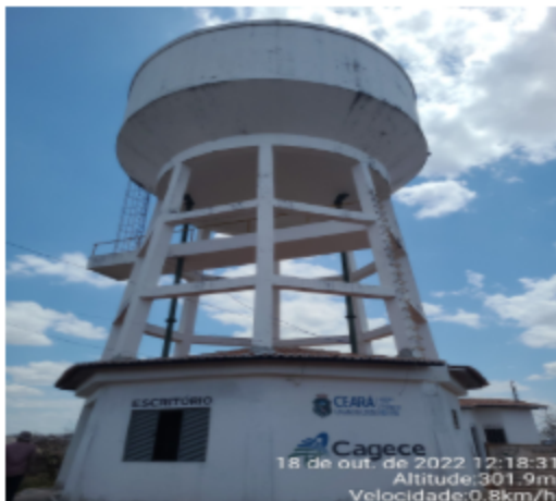
Foto 16 - REL-01 (Mangabeira): pintura desgastada.
