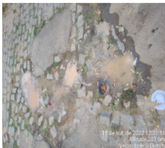
Foto 5 - RDA (Mangabeira): registro sem caixa de proteção e no meio da via.
