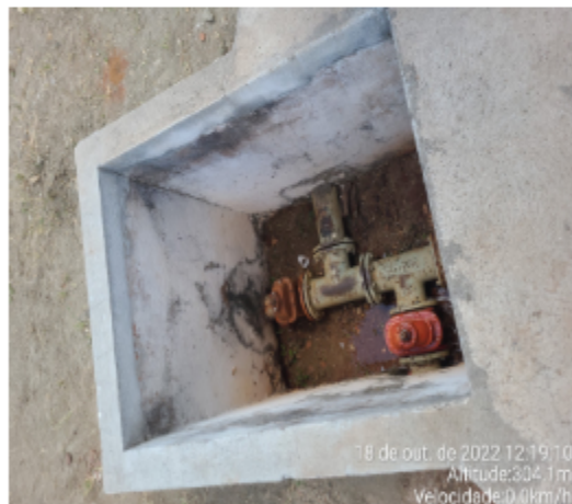
Foto 1 - REL-01 (Mangabeira): caixa sem tampa/grade.
