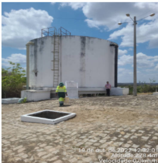
Foto 36 - REL-02 (Sede): pintura desgastada.
