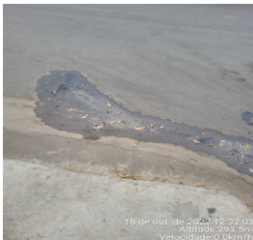
Foto 18 - RDA (Mangabeira): presença de vazamentos.
