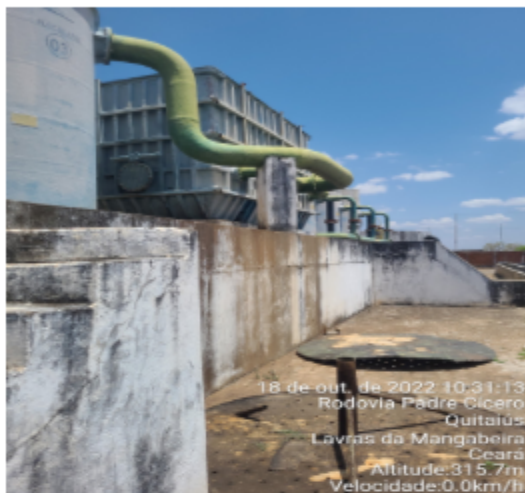
Foto 7 - ETA (Quitaiús): ausência de guarda-corpo.
