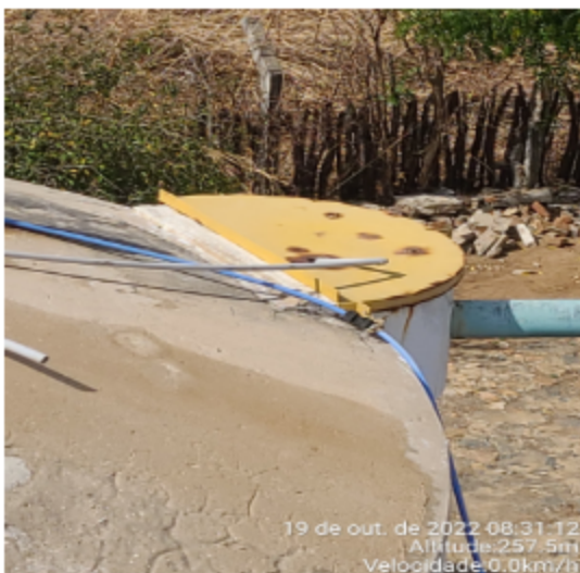
Foto 30 - RAP-02 (Amaniutuba): tampa oxidada, sem vedação.
