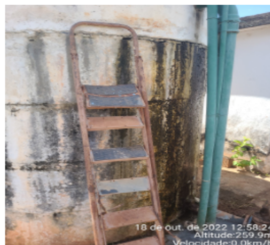
Foto 6 - RAP-01 (Mangabeira): ausência de escada adequada.
