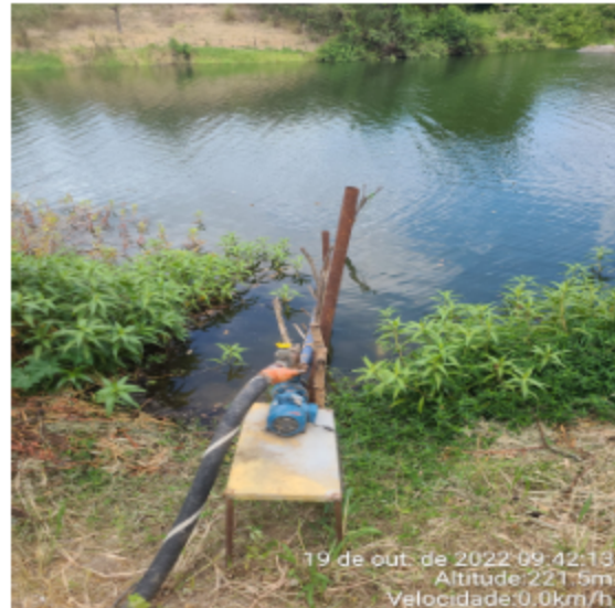
Foto 44 - Captação superficial em Amaniutuba.
