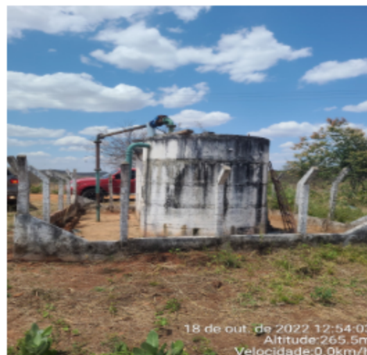
Foto 19 - RAP-01 (Mangabeira): presença de vazamentos e pintura deteriorada.
