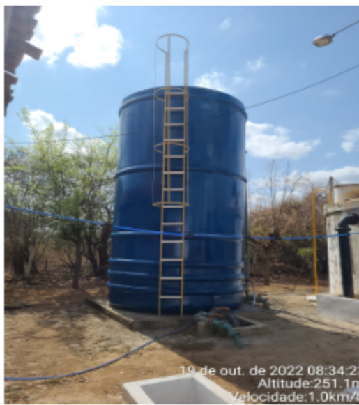
Foto 27 - ETA (Amaniutuba): decantador sem identificação.
