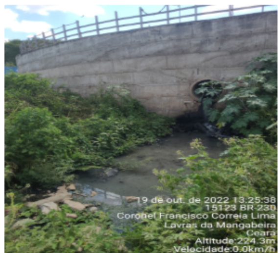
Foto 42 - SES: lançamento de efluentes in natura no Rio Salgado.
