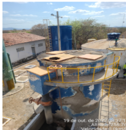
Foto 29 - ETA (Amaniutuba): filtro com pintura deteriorada e tampa oxidada, sem vedação.
