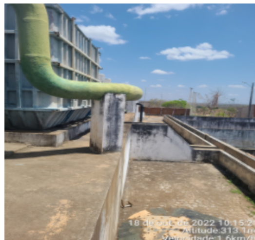
Foto 8 - ETA (Quitaiús): ausência de guarda-corpo.
