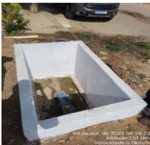
Foto 9 - ETA (Amanituba): caixa de proteção sem tampa/grade na calçada da estação.
