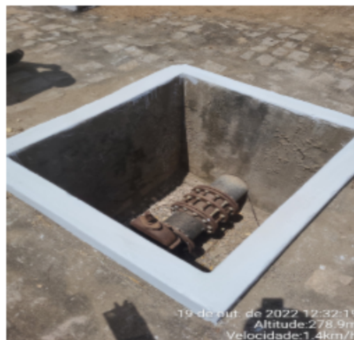
Foto 14 - RAP-01 e REL-02 (Sede): caixa de proteção sem tampa/grade.
