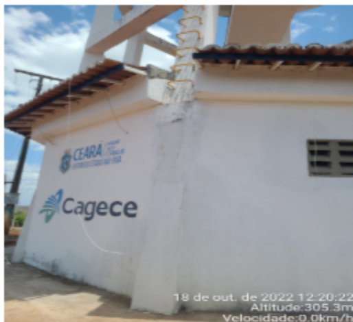
Foto 3 - REL-01 (Mangabeira): escada com acesso dificultoso.
