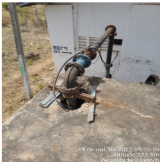
Foto 34 - RAP-01 (Amanitutuba): laje sem vedação.
