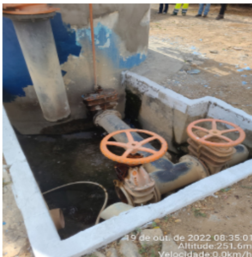
Foto 28 - ETA (Amaniutuba): vazamento no registro de saída do filtro.
