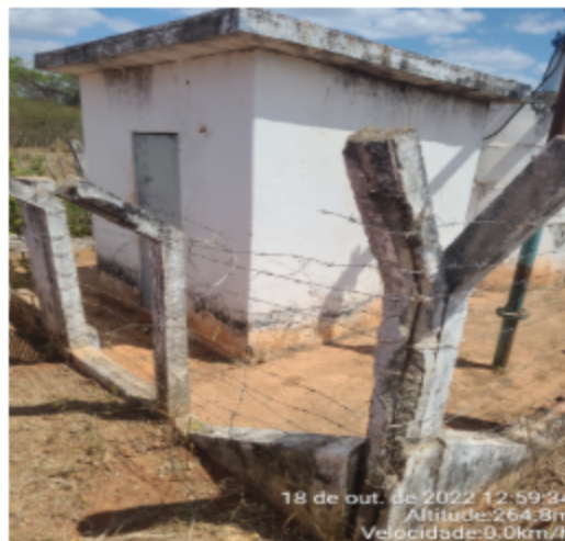
Foto 21 - RAP-01 (Mangabeira): cerca deteriorada.
