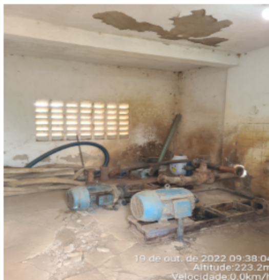
Foto 35 - EEAB-01 (Amanitutuba): mau estado de conservação.
