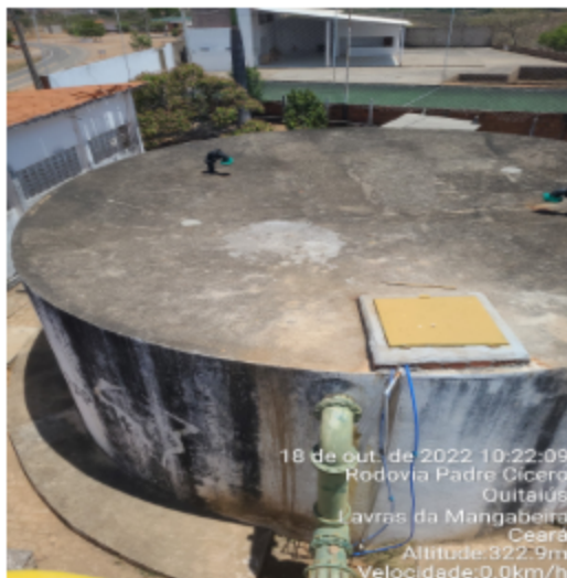
Foto 24 - RAP-03 (Quitaiús): pintura deteriorada.
