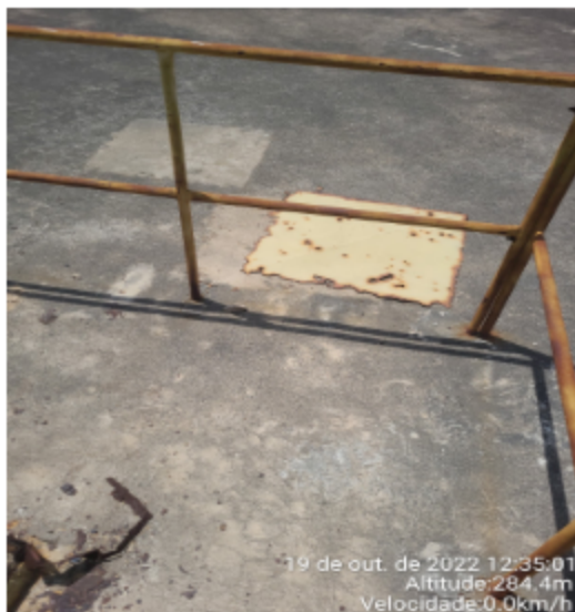
Foto 38 - REL-02 (Sede): tampa corroída.
