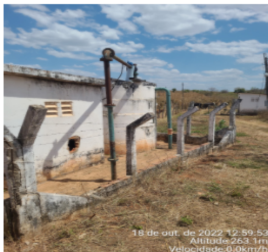
Foto 22 - EEAB-01 (Mangabeira): alvenaria com furo.
