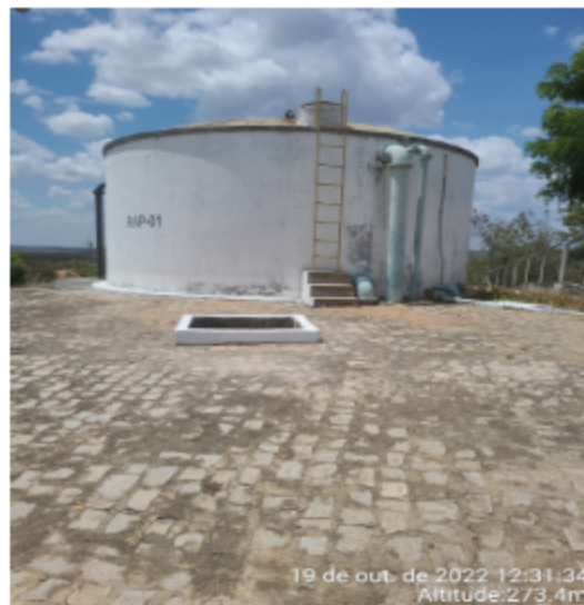
Foto 37 - RAP-01 (Sede): pintura desgastada.
