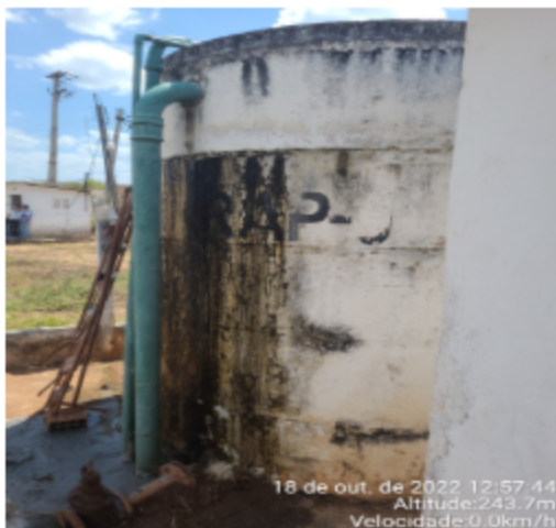
Foto 20 - RAP-01 (Mangabeira): presença de vazamentos e pintura deteriorada.
