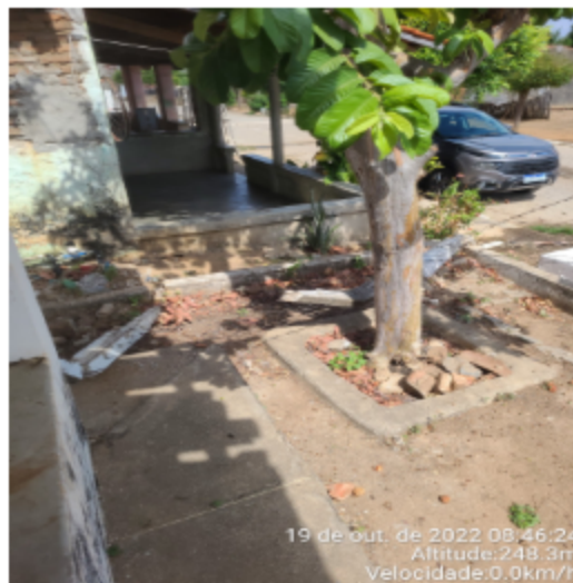
Foto 25 - ETA (Amaniutuba): cerca destruída.
