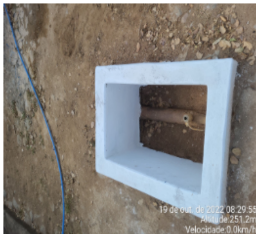
Foto 11 - ETA (Amanituba): caixa de proteção sem tampa/grade.
