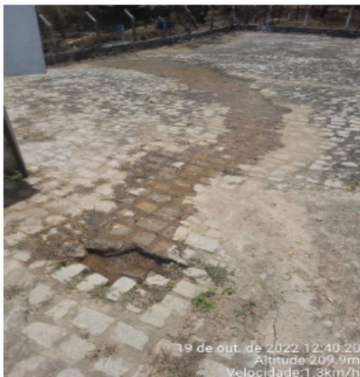
Foto 40 - RAP-01 e REL-02 (Sede): presença de vazamento em tubulação.
