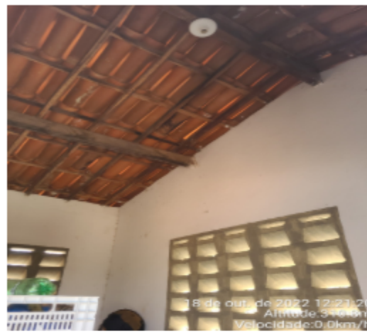
Foto 4 - Escritório (Mangabeira): almoxarifado sem lâmpada.
