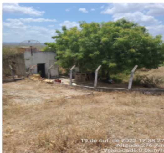
Foto 13 - RAP-01 e REL-02 (Sede): área sem proteção de acesso de pessoas e animais.
