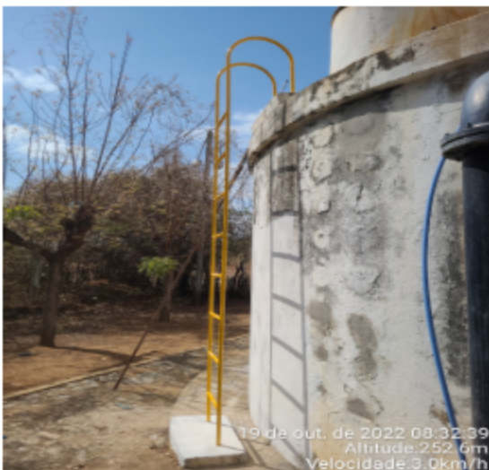
Foto 32 - RAP-02 (Amanitutuba): com pintura deteriorada.
