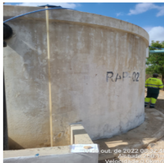
Foto 31 - RAP-02 (Amaniutuba): com pintura deteriorada.
