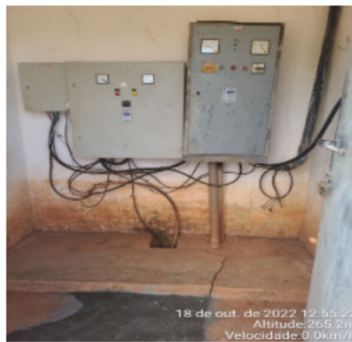
Foto 23 - EEAB-01 (Mangabeira): instalações elétricas inadequadas.
