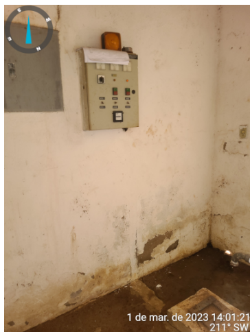
Foto 19 - EERD-02 (Booster 2): Pintura deteriorada.
