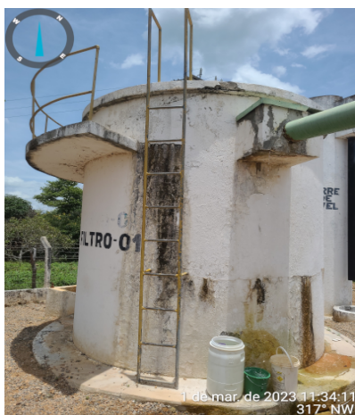
Foto 7 - ETA: Filtro com vazamento na saída para o RAP-01, ausência de gaiola de proteção na escada.
