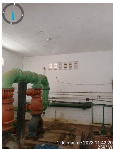
Foto 17 - ETA: EEAT- 01 ausência de lâmpada em área de circulação.
