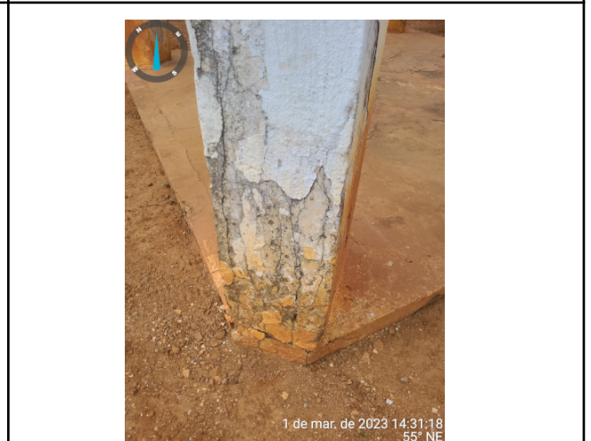
Foto 24 - REL-01: Estrutura com aço aparente no “fuste” do reservatório e pilares.
