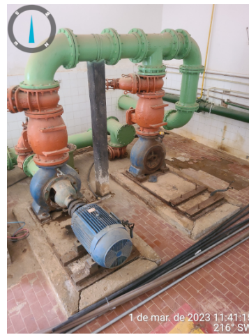
Foto 16 - ETA: EEAT- 01 com vazamento na bomba, piso deteriorado e ausência de bomba reserva in loco .
