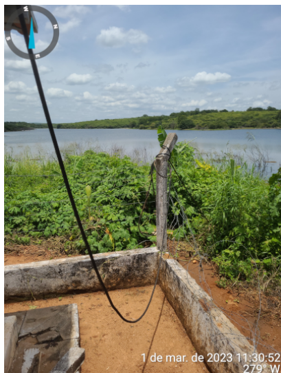
Foto 1 - EECS-01: Cerca de proteção e isolamento danificada.
