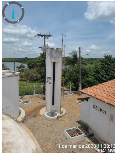
Foto 11 - ETA: Torre de Nível com ausência de gaiola de proteção na escada.
