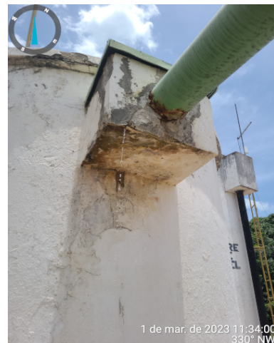
Foto 6 - ETA: Toda infraestrutura está com pintura deteriorada e Filtro com vazamento na saída para o RAP-01.
