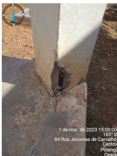
Foto 37 - REL-02: pilar com aço aparente.
