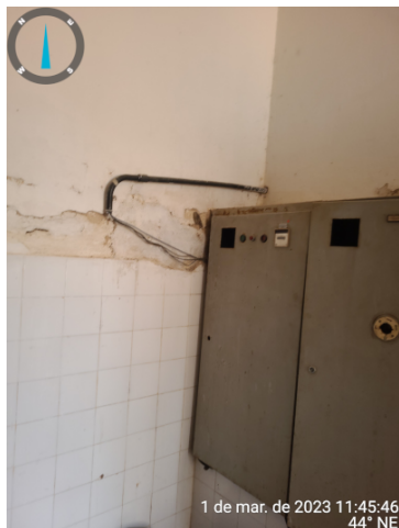
Foto 15 - ETA: EEAT- 01 com instalações elétricas inadequadas.
