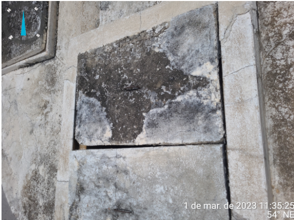
Foto 9 - ETA: Filtro com tampa sem vedação.
