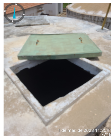
Foto 8 - ETA: Filtro com tampa aberta.
