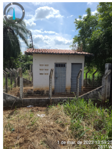
Foto 20 - EERD-02 (Booster 2): Pintura deteriorada.
