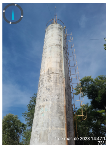
Foto 32 - REL-03: Sem identificação, pintura deteriorada, escada corroída.
