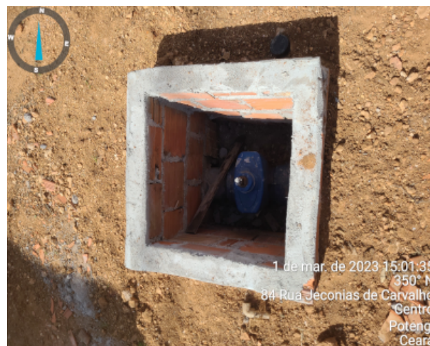
Foto 36 - REL-02: caixa de registro sem tampa.
