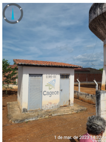
Foto 30 - EERD-01 (Booster 1): Instalações elétricas inadequadas e pintura deteriorada.
