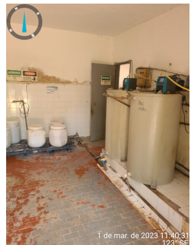
Foto 14 - ETA: Casa de química falta grelha da calha de drenagem, quadro elétrico em estado de corrosão.
