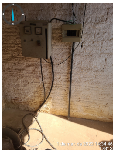
Foto 29 - EERD-01 (Booster 1): Instalações elétricas inadequadas.
