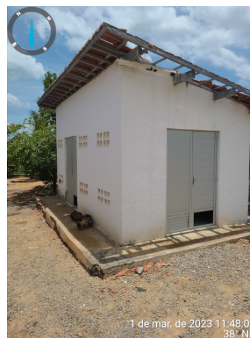
Foto 18 - ETA: EEAT- 01 casa de depósitos com portas danificadas.
