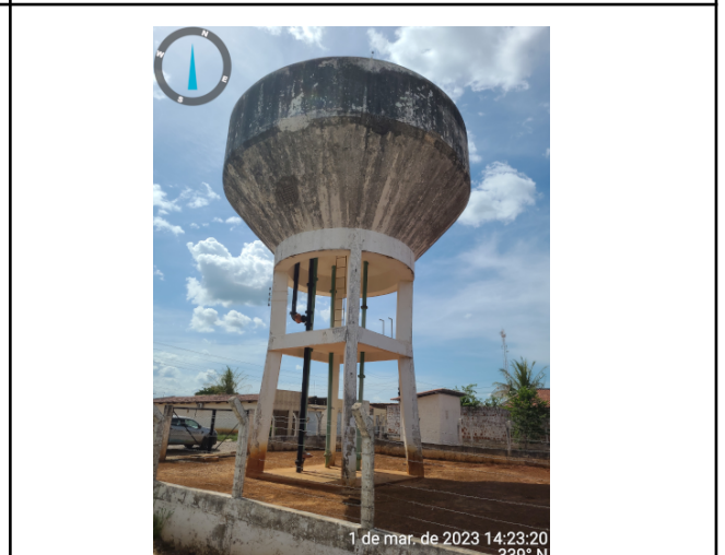
Foto 26 - REL-01: pintura deteriorada.
