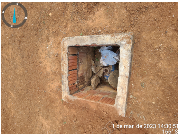
Foto 27 - REL-01: registro sem caixa.
