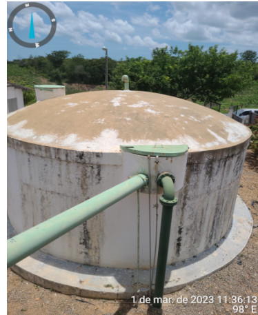
Foto 10 - ETA: RAP-01 com tampa sem vedação hermética.
