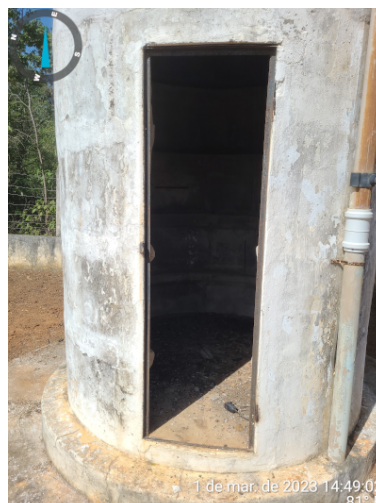
Foto 34 - REL-03: sem portão de acesso.
