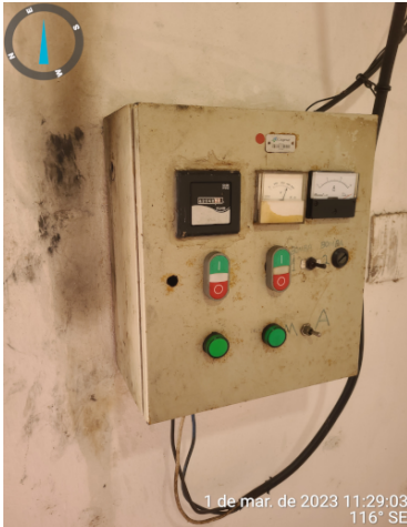
Foto 3 - EECS-01: instalações elétricas inadequadas.
