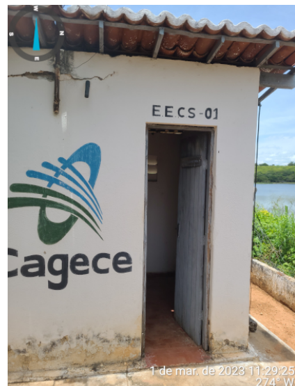
Foto 2 - EECS-01: ausência de iluminação externa.
