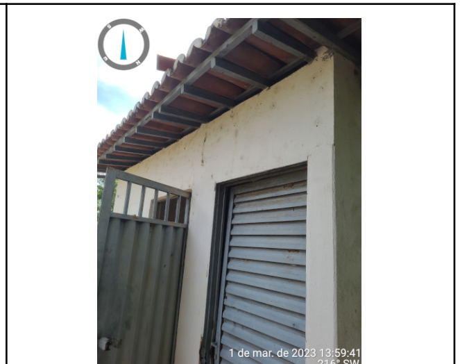
Foto 22 - EERD-02 (Booster 2): ausência de iluminação externa.
