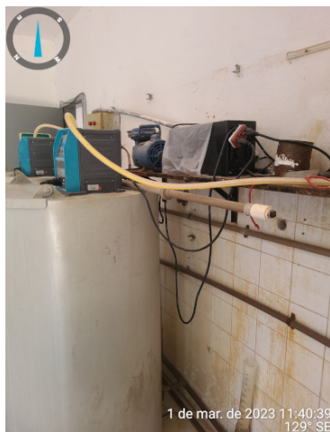
Foto 13 - ETA: Casa de química com instalações elétricas inadequadas.
