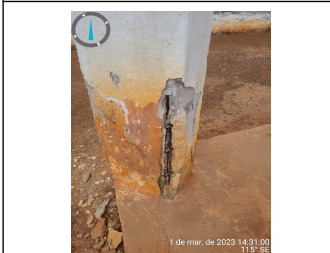
Foto 23 - REL-01: Estrutura com aço aparente no “fuste” do reservatório e pilares.
