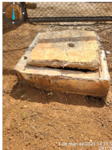
Foto 28 - REL-01: caixa com tampa deteriorada.
