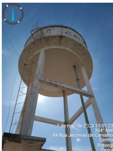
Foto 35 - REL-02: Pintura deteriorada.
