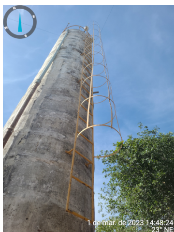
Foto 31 - REL-03: Sem identificação, pintura deteriorada, escada corroída.
