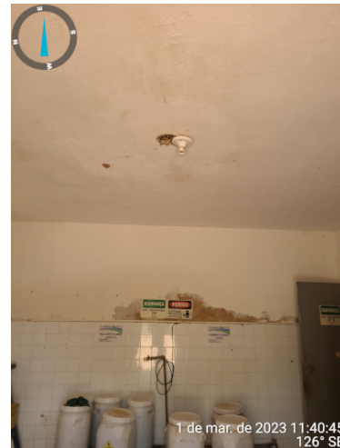
Foto 12 - ETA: Casa de química sem lâmpada e instalações elétricas inadequadas.
