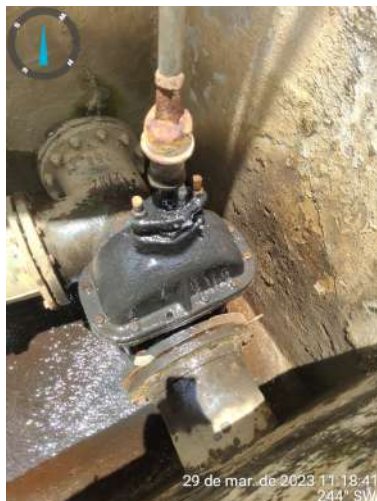
Foto 11 - ETA: Filtros F1, F3 e F5 com vazamento na descarga de rejeito e descarga de fundo.
