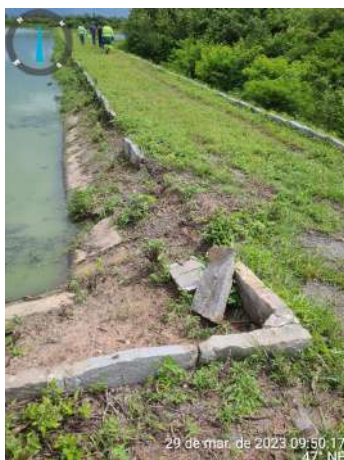
Foto 81 - ETE: Saída da LF para LM obstruída e com vegetação; LF talude com excesso de vegetação e contenção danificada; Vegetação dentro da LF e LM (chincanas).
