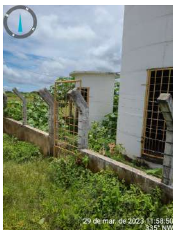
Foto 51 - PT-14: Portão de acesso a área e portão do poço estão corroídos.
