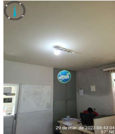
Foto 2 - Escritório: iluminação precária e paredes com infiltração.
