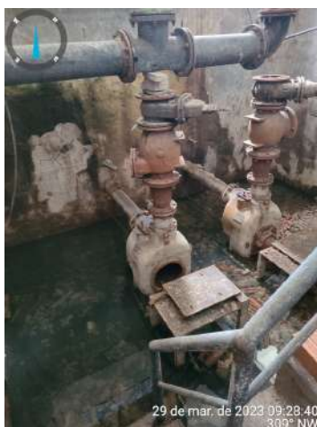
Foto 69 - EEE-2: Área das bombas alagada (inutilizadas há cerca de 3 anos).
