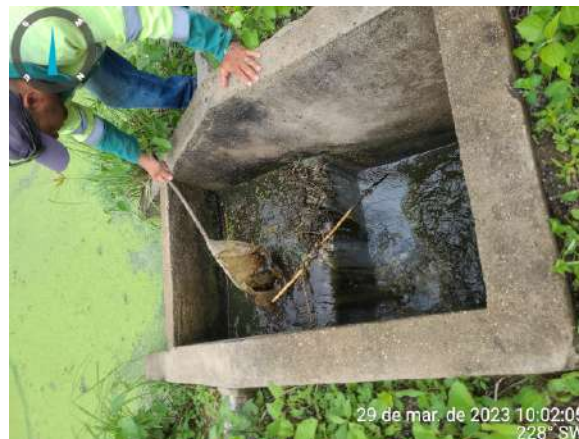
Foto 78 - ETE: Saída da LF para LM obstruída e com vegetação; LF talude com excesso de vegetação e contenção danificada; Vegetação dentro da LF e LM (chincanas).
