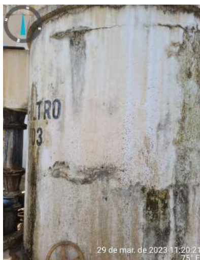
Foto 9 - ETA: Filtro F3 está com pintura deteriorada.
