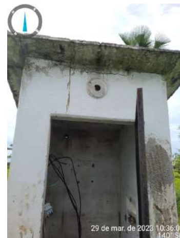
Foto 34 - PT-01: Instalações elétricas inadequadas; Ausência de iluminação interna e externa na casa do quadro de comando.
