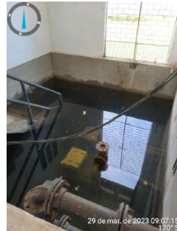
Foto 56 - EEE-1: Área da casa de bombas antigas alagada (inutilizadas há cerca de 3 anos).
