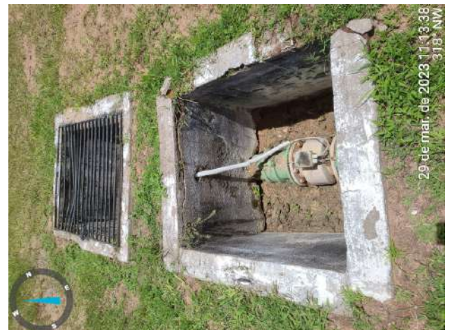
Foto 4 - ETA: caixa de proteção sem tampa/grade.
