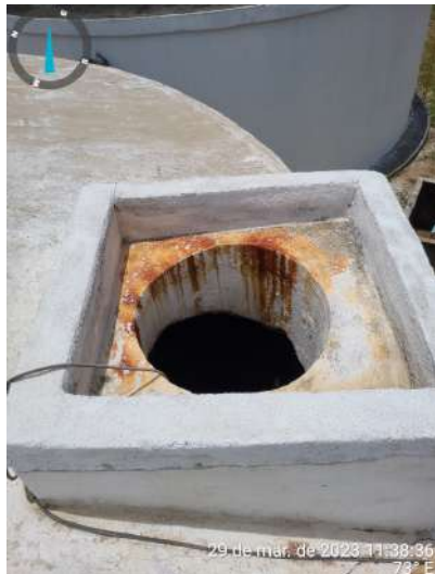
Foto 23 - ETA: Reservatório RAP-3 sem tampa, bem como instalações elétricas inadequadas.
