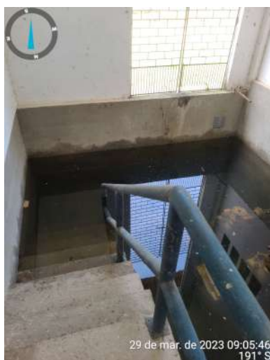
Foto 57 - EEE-1: Área da casa de bombas antigas alagada (inutilizadas há cerca de 3 anos).
