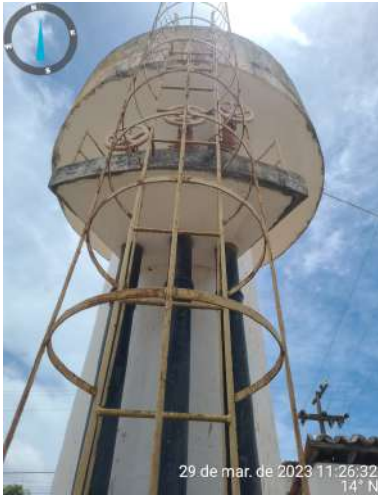
Foto 17 - ETA: Torre de Nível com pintura desgastada e escada corroída.
