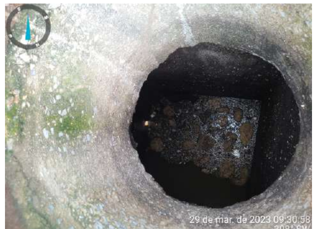
Foto 64 - EEE-2: Acúmulo de materiais sobrenadantes; Ausência de tampa no PV.
