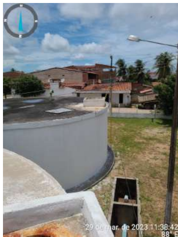
Foto 19 - ETA: Reservatório RAP-2 sem identificação, sem tampa, instalações elétricas inadequadas e com água pluvial acumulada.
