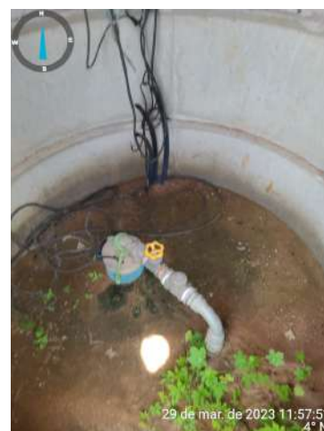
Foto 52 - PT-14: Instalações elétricas inadequadas.
