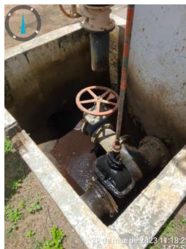
Foto 14 - ETA: Filtro F2 com vazamento na tubulação para RAP e no registro de lavagem.
