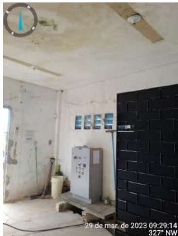
Foto 67 - EEE-2: Não há iluminação interna e instalações elétricas inadequadas.
