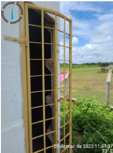
Foto 49 - REL-2: Área com vegetação crescida; Portão corroído.
