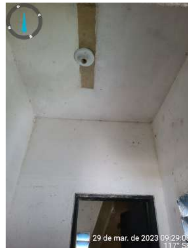
Foto 68- EEE-2: Não há iluminação interna.
