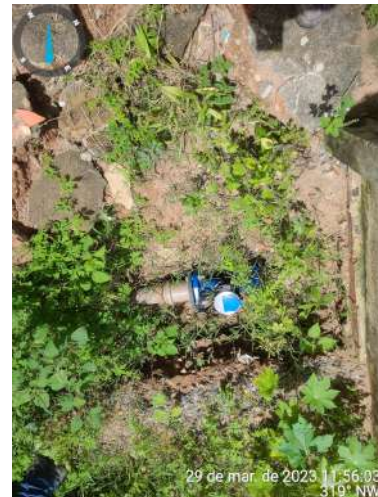
Foto 50 - REL-2: Macromedidor sem caixa de proteção.
