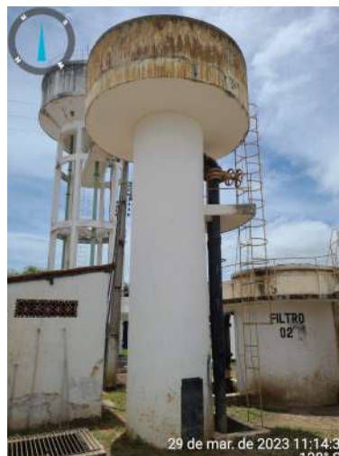
Foto 16 - ETA: Torre de Nível com pintura desgastada e escada corroída.
