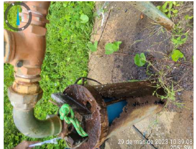
Foto 32 - PT-01: Tubulação de proteção corroída.
