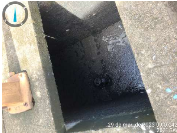
Foto 55 - EEE-1: ausência de tampa no registro de entrada e grade.
