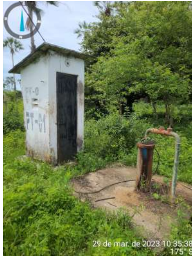
Foto 35 - PT-01: Vazamento; Área tomada pela vegetação crescida.
