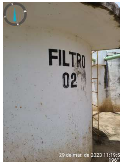
Foto 8 - ETA: Filtro F2 está com pintura deteriorada.
