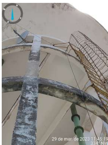
Foto 27 - ETA: Reservatório REL-1 com macromedidor de saída sem tampa, escada corroída e instalação elétrica inadequada.
