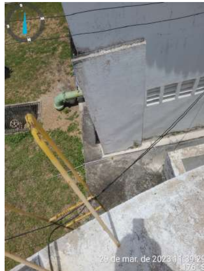
Foto 24 - ETA: Reservatório RAP-3 com instalações elétricas inadequadas.
