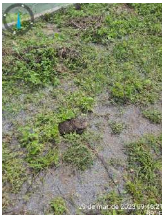
Foto 77 - ETE: Tratamento preliminar sem gradeamento, divisórias de manejo e limpeza das caixas de areia e calha parshall danificada; Sem isolamento da área (fezes indicando acesso de animais de grande porte).
