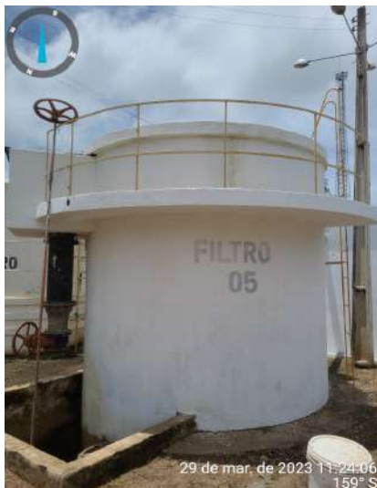
Foto 7 - ETA: filtro F5 identificação ilegível.
