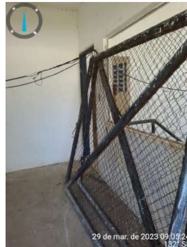
Foto 60 - EEE-1: Instalações elétricas inadequadas; Banheiro deteriorado.
