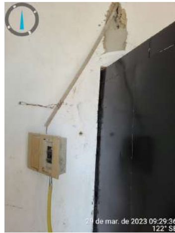
Foto 66 - EEE-2: Instalações elétricas inadequadas.
