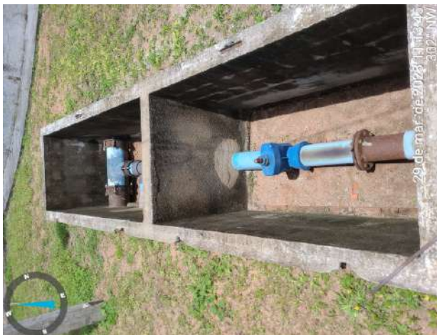
Foto 5 - ETA: caixa de proteção sem tampa/grade.
