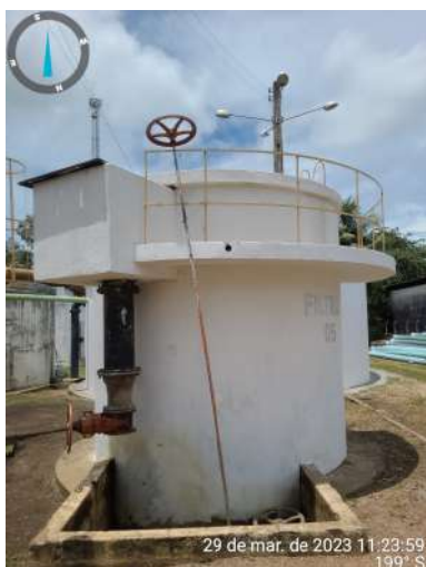
Foto 13 - ETA: Filtros F1, F3 e F5 com vazamento na descarga de rejeito e descarga de fundo.
