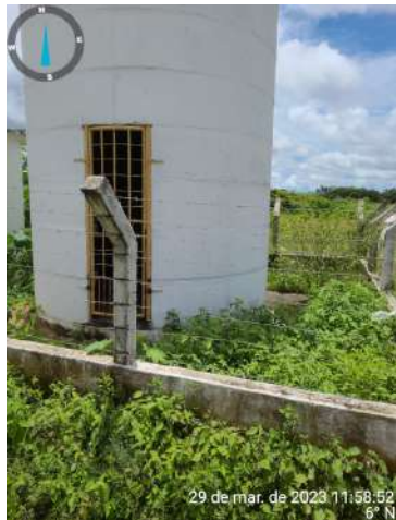
Foto 47 - REL-2: Área com vegetação crescida; Portão corroído.
