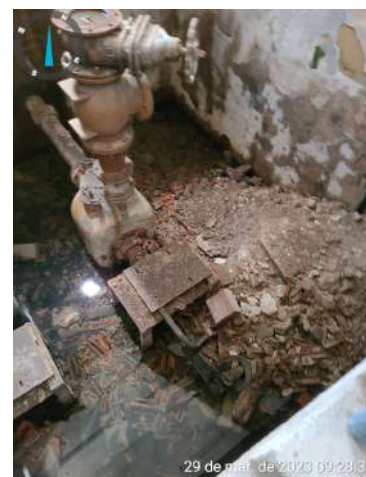
Foto 70 - EEE-2: Área das bombas alagada (inutilizadas há cerca de 3 anos).
