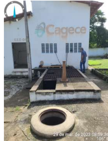
Foto 54 - EEE-1: Ausência de tampa no PV e Ausência de haste e volante e não há iluminação externa.
