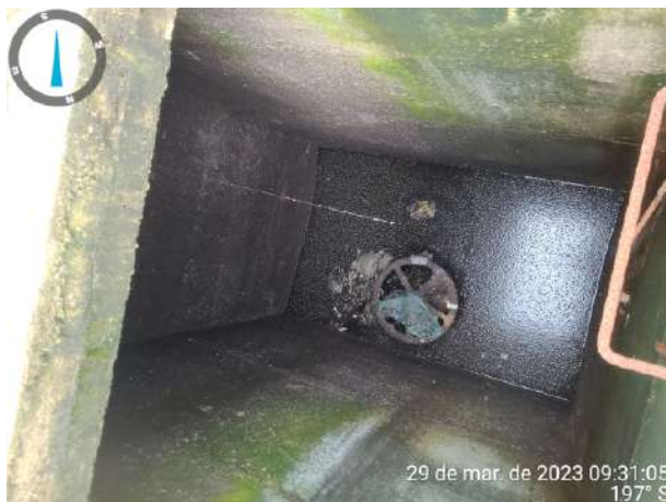
Foto 63 - EEE-2: Caixa de registro de saída para lagoa alagada; Acúmulo de materiais sobrenadantes; Ausência de tampa no registro de entrada e grade.
