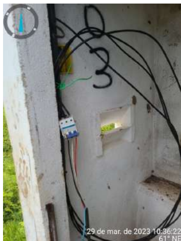
Foto 33 - PT-01: Instalações elétricas inadequadas.
