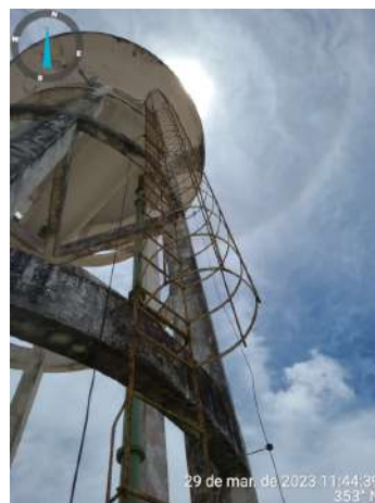
Foto 26 - ETA: Reservatório REL-1 com escada corroída e instalação elétrica inadequada.
