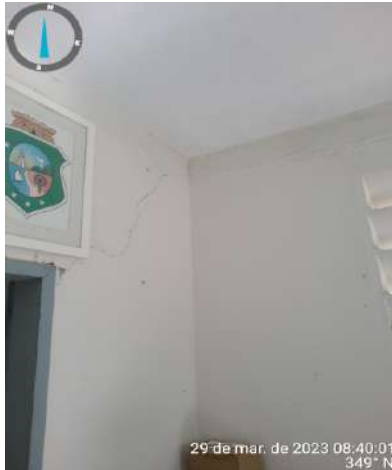
Foto 1 - Escritório: apresenta fissuras na área de espera.
