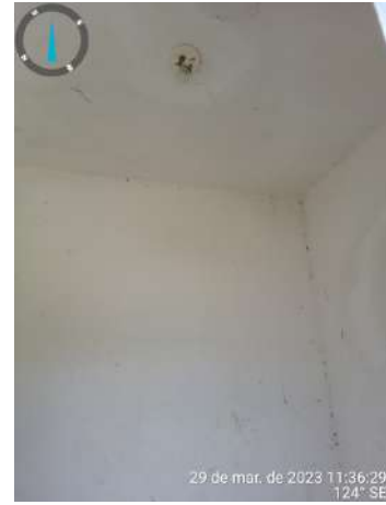
Foto 30 - ETA: Estação Elevatória EEAT-2 com lâmpada sem funcionar.
