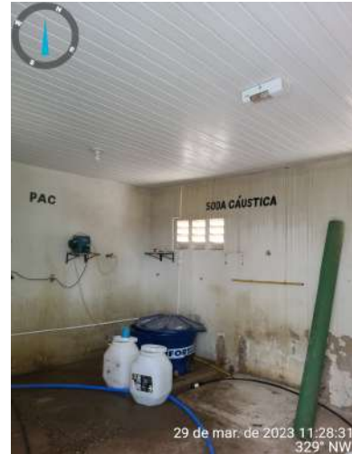
Foto 18 - ETA: Casa de Química com lâmpadas sem funcionar, tubulação sobre o piso e pintura deteriorada.
