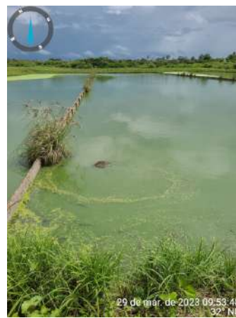
Foto 80 - ETE: Saída da LF para LM obstruída e com vegetação; LF talude com excesso de vegetação e contenção danificada; Vegetação dentro da LF e LM (chincanas).
