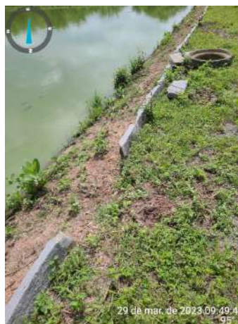
Foto 82 - ETE: Saída da LF para LM obstruída e com vegetação; LF talude com excesso de vegetação e contenção danificada; Vegetação dentro da LF e LM (chincanas).
