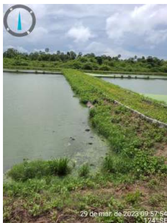
Foto 79 - ETE: Saída da LF para LM obstruída e com vegetação; LF talude com excesso de vegetação e contenção danificada; Vegetação dentro da LF e LM (chincanas).
