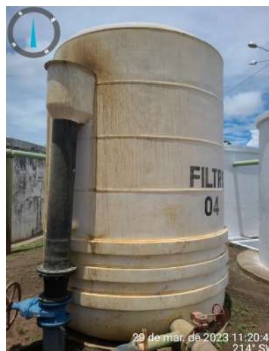
Foto 10 - ETA: Filtro F4 está com pintura deteriorada.
