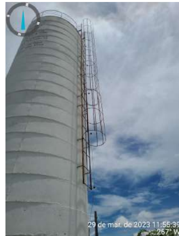
Foto 48 - REL-2: Sem identificação; Escada corroída.
