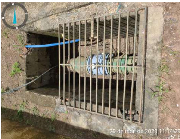
Foto 3 - ETA: caixa do macromedidor de chegada sem tampa.
