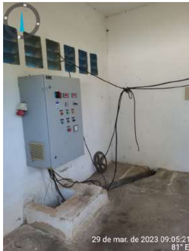
Foto 59 - EEE-1: Instalações elétricas inadequadas; Banheiro deteriorado.
