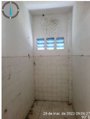
Foto 61 - EEE-1: Banheiro deteriorado.
