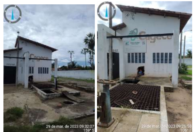
Foto 62 - EEE-2: Alvenaria sem vedação; Ausência de haste e volante; Ausência de tampa no PV, registro de entrada e grade e ausência de iluminação externa.
