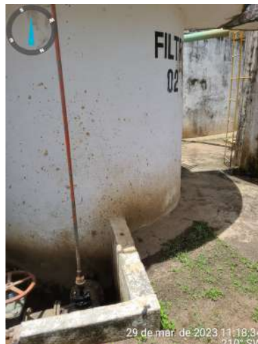
Foto 12 - ETA: Filtros F1, F3 e F5 com vazamento na descarga de rejeito e descarga de fundo.
