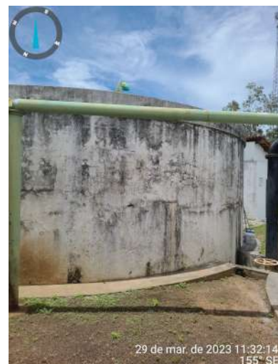
Foto 22 - ETA: Reservatório RAP-3 sem tampa, bem como instalações elétricas inadequadas.
