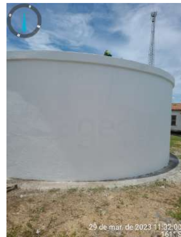
Foto 20 - ETA: Reservatório RAP-4 sem identificação.
