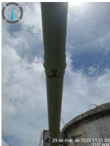
Foto 15 - ETA: Filtro F2 com vazamento na tubulação para RAP e no registro de lavagem.
