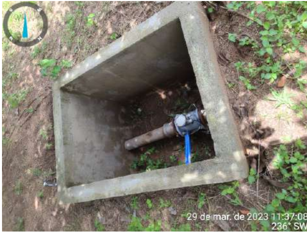
Foto 29 - ETA: Estação Elevatória EEAT-2 com lâmpada sem funcionar e macromedidor de saída sem tampa.
