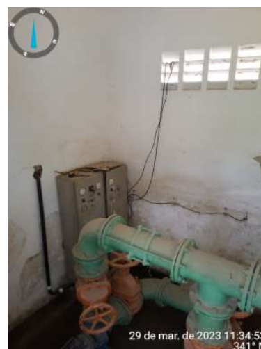
Foto 28 - ETA: Estação Elevatória EAAT-1 com lâmpadas sem funcionar), escada sem guarda corpo (corrimão), pintura deteriorada e instalações elétricas inadequadas.
