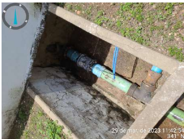
Foto 25 - ETA: Reservatório REL-1 com macromedidor de saída sem tampa, escada corroída e instalação elétrica inadequada.
