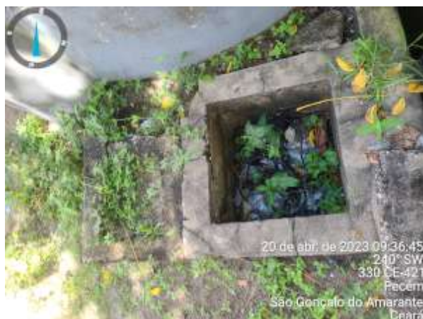
Foto 157 - EEE-04 (Pecém): acúmulo de lixo.
