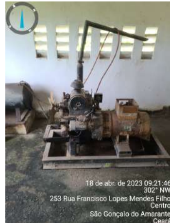
Foto 107 - EEE-01 (Sede): gerador sem funcionar.
