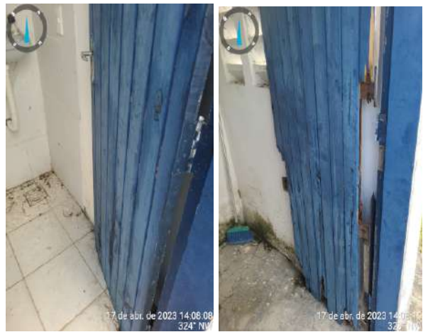
Foto 143 - EEE-05 (Croatá): portas danificadas.
