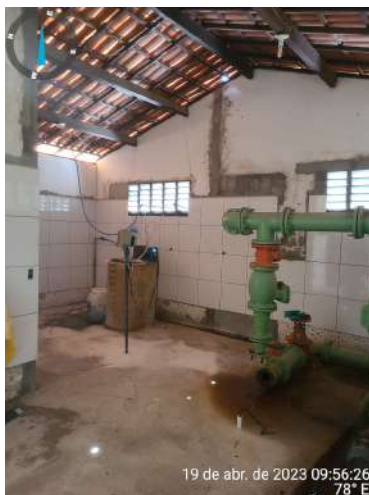
Foto 102 - EEAT e EELF (Siupé): presença de vazamentos.
