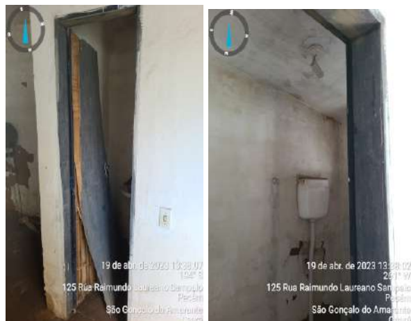
Foto 149 - EEE-01 (Pecém): porta quebrada e lâmpada sem funcionar.
