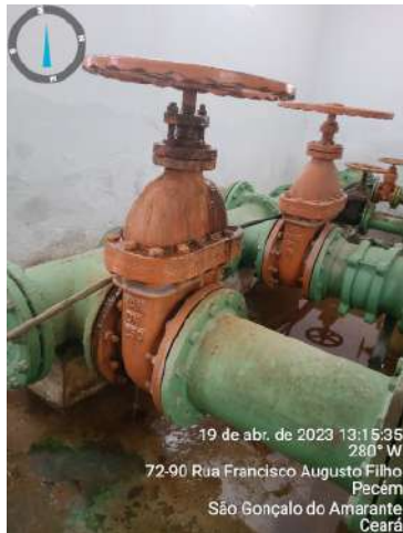
Foto 76 - EEAT/ EELF (Pecém): área alagada e com instalações elétricas inadequadas.
