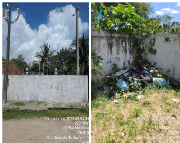
Foto 151 - EEE-02 (Pecém): pintura desgastada e acúmulo de lixo.
