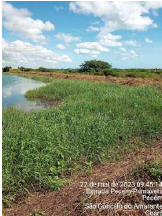
Foto 166 - ETE (Pecém): estação de tratamento abandonada, lodo acumulado, excesso de vegetação (árvores) nos taludes e presença de vegetação dentro das lagoas.
