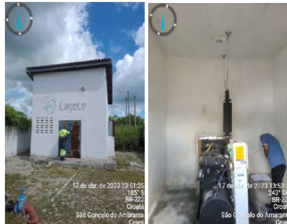
Foto 137 - EEE-04 (Croatá): iluminação externa e interna sem funcionar.
