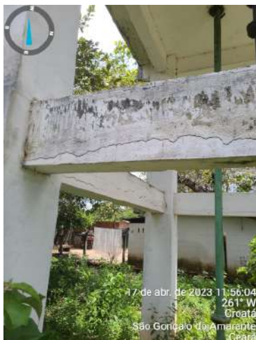
Foto 64 - REL-03 (Violete): fissuras na viga.
