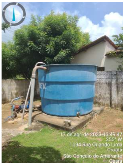
Foto 5 - RAP-02 (Croatá): sem identificação e ausência de tampa.
