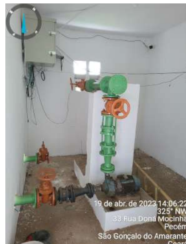
Foto 18 - EEAT-02 (Pecém): sem bomba reserva.
