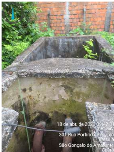
Foto 112 - EEE-02 (Sede): excesso de vegetação e instalações elétricas inadequadas.
