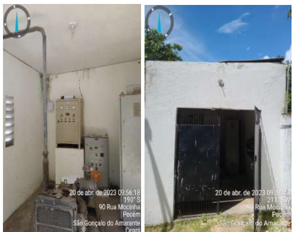
Foto 150 - EEE-02 (Pecém): gerador sem funcionar, lâmpadas interna e externa sem funcionar.
