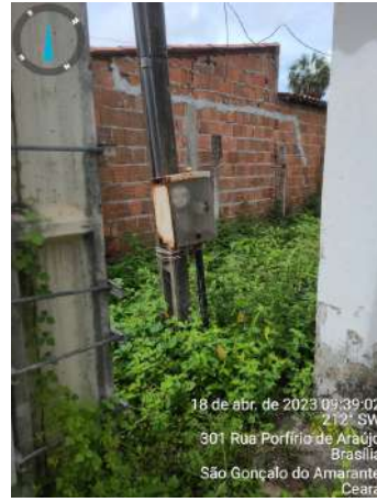
Foto 111 - EEE-02 (Sede): excesso de vegetação e instalações elétricas inadequadas.
