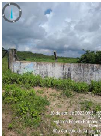
Foto 162 - ETE (Pecém): estação de tratamento abandonada.
