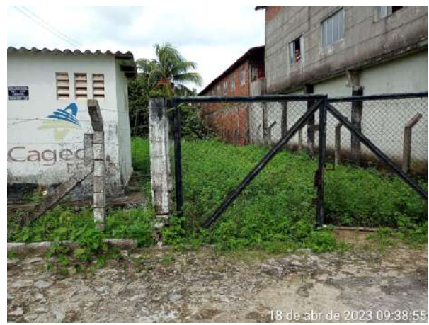
Foto 109 - EEE-02 (Sede): excesso de vegetação e pintura desgastada.
