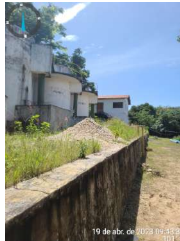
Foto 93 - F-02 e F-03 (Siupé): pintura desgastada.
