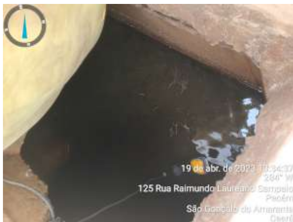
Foto 80 - RSE-01 (Pecém): tampa sem vedação e presença de galhos.
