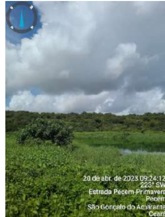
Foto 165 - ETE (Pecém): estação de tratamento abandonada, excesso de vegetação (árvores) nos taludes e presença de vegetação dentro das lagoas.
