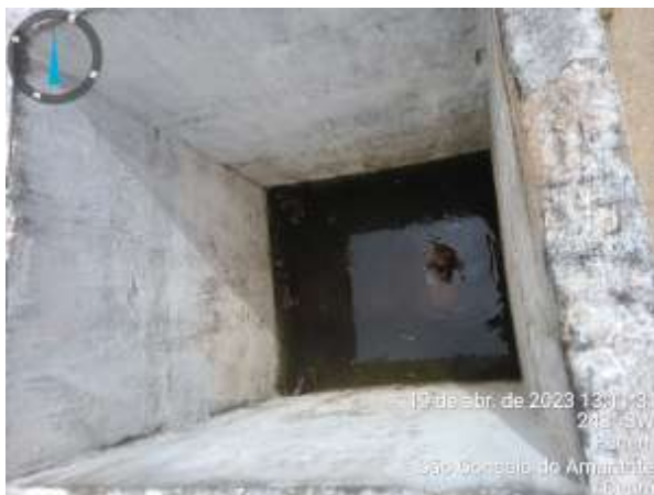
Foto 78 - ETA (Pecém): registro alagado.
