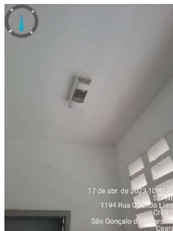
Foto 51 - Escritório (Croatá): ausência de lâmpada no lavabo .
