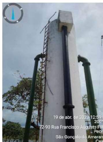
Foto 67 - Torre de Nível (Pecém): escada corroída e sem gaiola.
