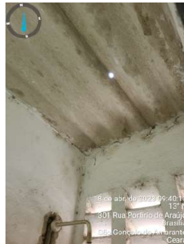
Foto 113 - EEE-02 (Sede): telhado do banheiro com furo.
