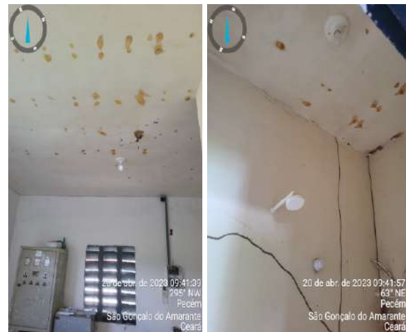
Foto 161 - EEE-04 (Pecém): instalações elétricas inadequadas, lâmpada do banheiro sem funcionar, teto com necessidade de pintura e indícios de infiltração.
