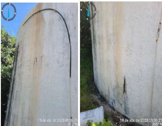
Foto 90 - RAP-01 (Siupé): mangueira de nível sem conexão, aço exposto e pintura desgastada.
