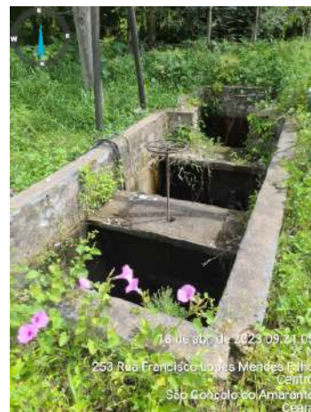
Foto 24 - EEE-01 (Sede): ausência de tampa/grade no poço de sucção.
