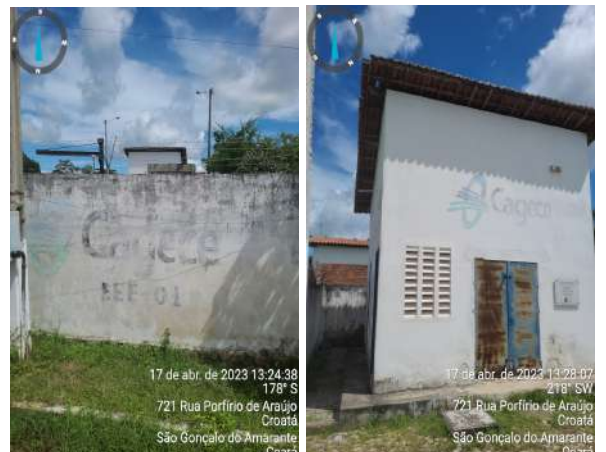
Foto 133 - ETE (Croatá): pintura desgastada, ausência de iluminação externa.
