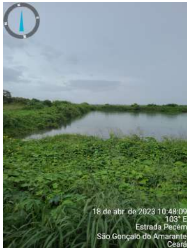
Foto 128 - ETE (Sede): excesso de vegetação nos taludes e dentro da lagoa.
