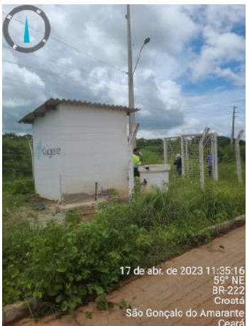
Foto 60 - PT-10 (Croatá): área com excesso de vegetação.
