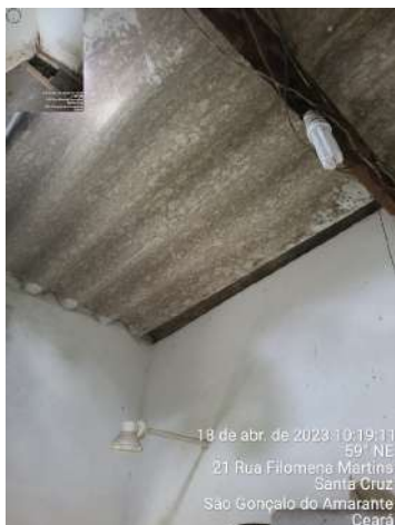
Foto 118 - EEE-04 (Sede): instalações elétricas inadequadas e telhado do banheiro com furo.
