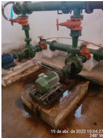
Foto 100 - EEAB-01 (Siupé): vazamento e instalações elétricas inadequadas.
