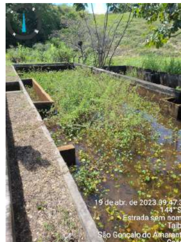
Foto 95 - Leito de secagem (Siupé): excesso de vegetação.
