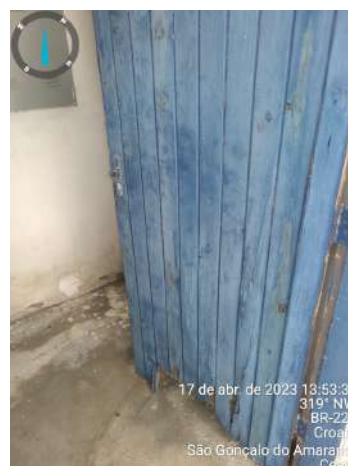
Foto 139 - EEE-04 (Croatá): porta quebrada.
