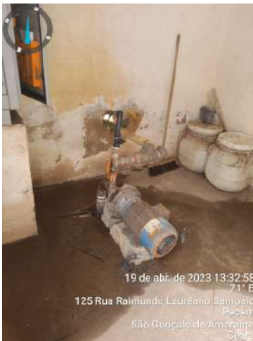
Foto 15 - EEAT-03 (Pecém): sem bomba reserva.
