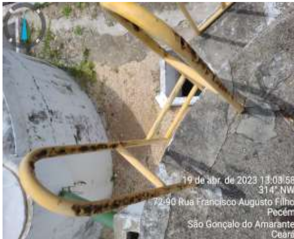
Foto 68 - F-01 (Pecém): escada corroída .
