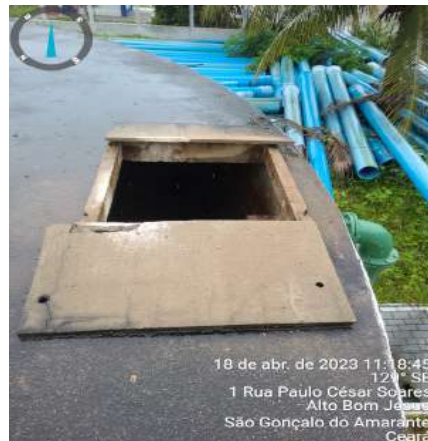
Foto 43 - RAP-01 (Sede): tampas deslocadas.
