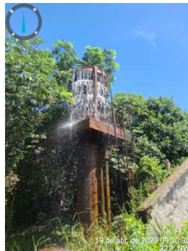
Foto 89 - ETA (Siupé): aerador extravasando, corroído e com escada corroída.
