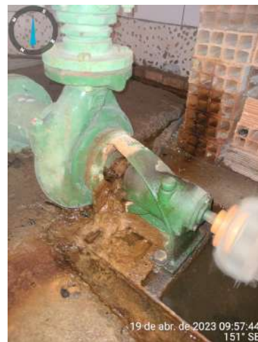
Foto 103 - EEAT e EELF (Siupé): presença de vazamentos.
