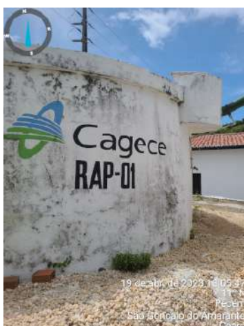
Foto 72 - RAP-01 (Pecém): pintura deteriorada.
