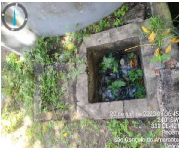
Foto 35 - EEE-04: caixa de inspeção das instalações elétricas sem tampas.
