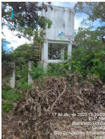
Foto 62 - REL-03 (Violete): excesso de vegetação e pintura desgastada.
