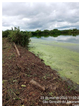
Foto 127 - ETE (Sede): lodo acumulado; excesso de vegetação nos taludes.
