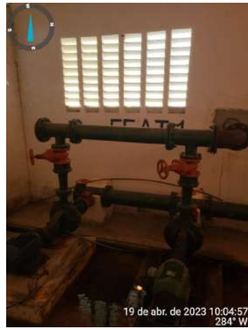
Foto 101 - EEAB-01 (Siupé): vazamento e instalações elétricas inadequadas.
