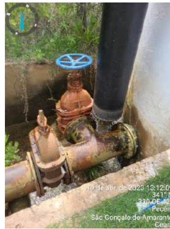
Foto 71 - F-03 (Pecém): vazamento devido à válvula de extravasamento não funcionar.
