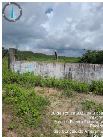
Foto 37 - ETE (Pecém): ausência de identificação na entrada.
