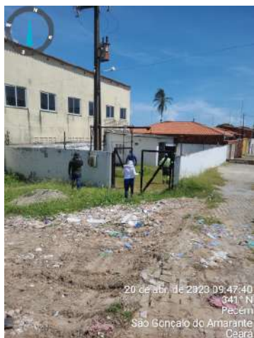
Foto 33 - EEE-03 (Pecém): sem identificação.
