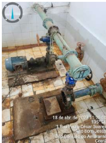
Foto 46 - EEAT-04 (Sede): ausência de bomba reserva.
