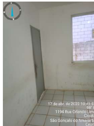
Foto 49 - Escritório (Croata): necessidade de pintura na área interna.
