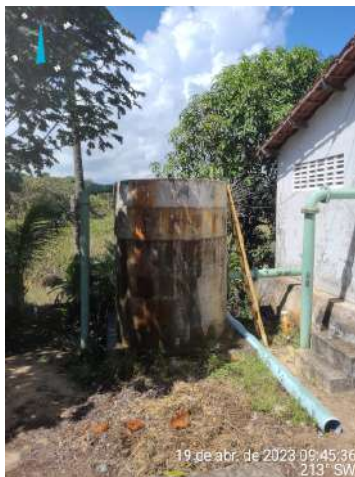
Foto 94 - Poço de Reunião (Siupé): sem escada fixa, pintura deteriorada e identificação precária.
