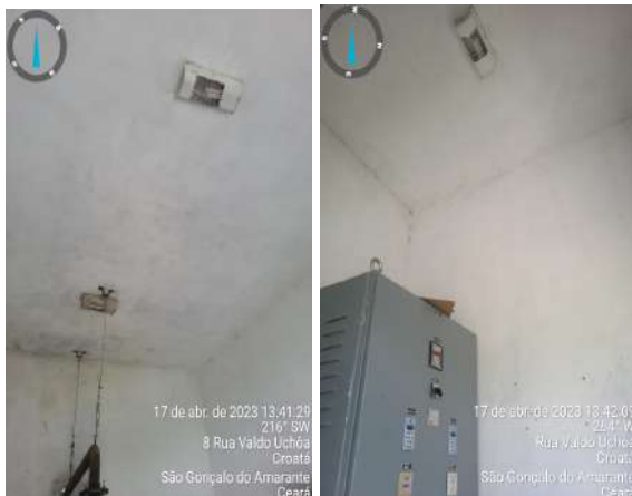
Foto 136 - EEE-03 (Croatá): iluminação externa e interna (ambiente do quadro de comando e banheiro) sem funcionar.
