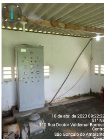
Foto 108 - EEE-01 (Sede): uma das lâmpadas não funciona.
