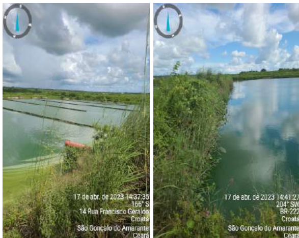
Foto 144 - ETE (Croatá): estação de tratamento abandonada, talude com excesso de vegetação, obstrução de entrada e saída das lagoas.
