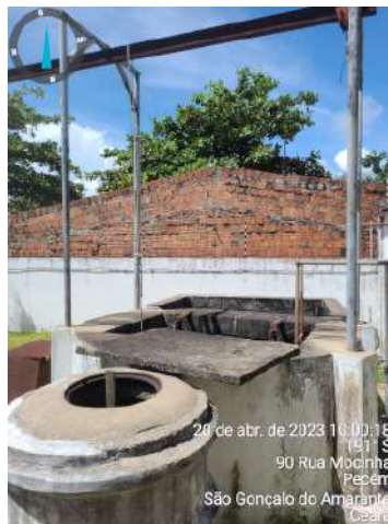
Foto 32 - EEE-02 (Pecém): ausência de tampa/grade no poço de sucção.
