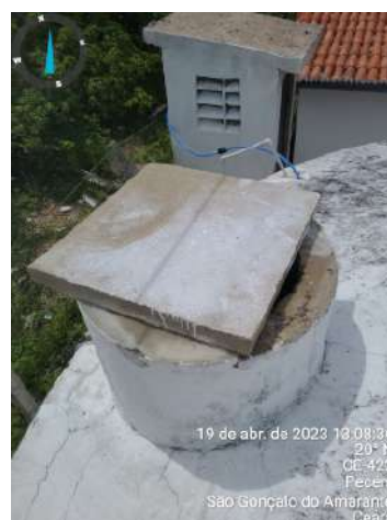
Foto 73 - RAP-01 (Pecém): tampa mal ajustada.
