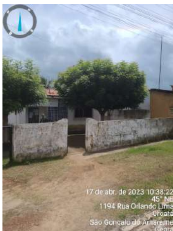
Foto 50 - Escritório (Croatá): pintura desgastada na entrada.
