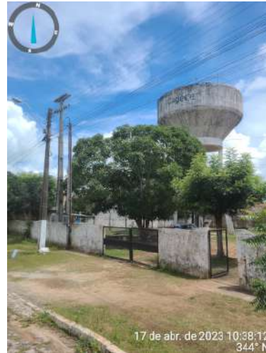
Foto 57 - REL-02 (Croatá): pintura desgastada e identificação precária.
