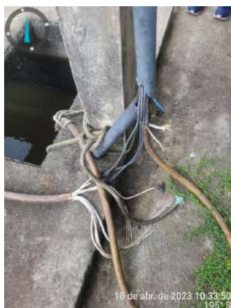
Foto 126 - EEE-05 (Sede): instalações elétricas inadequadas.
