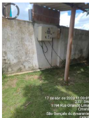
Foto 54 - REL-02 (Croatá): instalações elétricas inadequadas.
