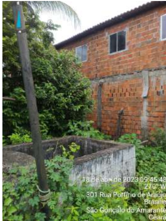
Foto 110 - EEE-02 (Sede): excesso de vegetação.
