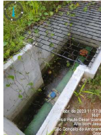
Foto 45 - RAP-01 (Sede): macromedidor de chegada alagado.
