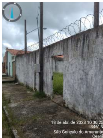
Foto 122 - EEE-05 (Sede): pintura desgastada e identificação precária.
