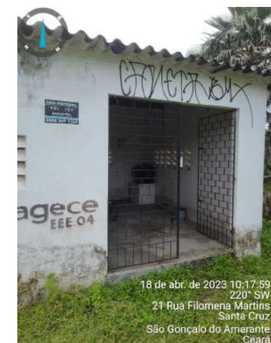
Foto 120 - EEE-04 (Sede): pintura desgastada.
