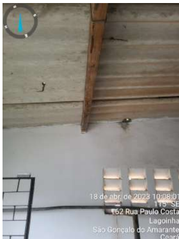
Foto 116 - EEE-03 (Sede): telhado com furo.
