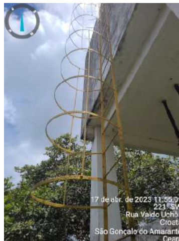
Foto 63 - REL-03 (Violete): pintura desgastada, escada e guarda-corpo corroídos.
