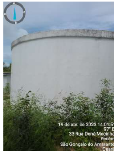
Foto 16 - RAP-02 (Pecém): sem escada e sem mangueira de nível.
