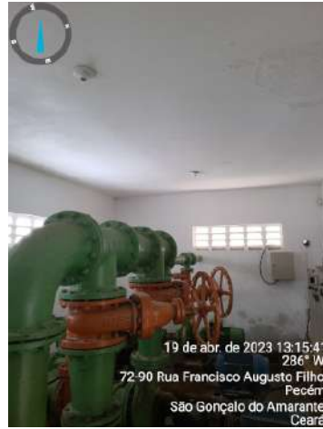
Foto 75 - EEAT/ EELF (Pecém): área sem iluminação, alagada e com instalações elétricas inadequadas.
