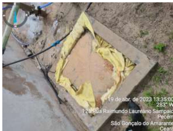
Foto 81 - EEAT-03 (Pecém): instalações elétricas inadequadas.
