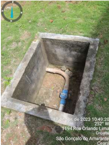
Foto 3 - REL-02 (Croatá): caixas sem tampa.
