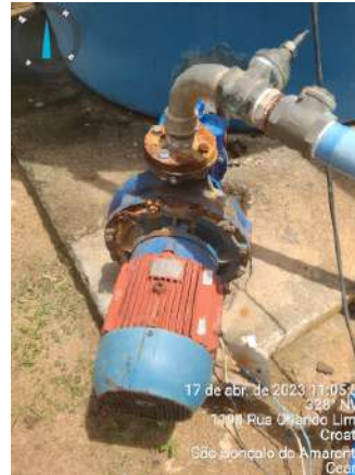
Foto 59 - EERD-01 (Croatá): bomba corroída e exposta a intempéries.
