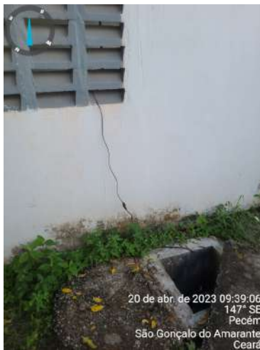
Foto 160 - EEE-04 (Pecém): instalações elétricas inadequadas.
