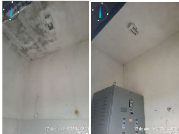
Foto 141 - EEE-05 (Croatá): iluminação interna sem funcionar.
