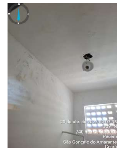
Foto 66 - Escritório (Pecém): ausência de lâmpada no banheiro.
