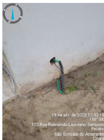
Foto 82 - EEAT-03 (Pecém): instalações elétricas inadequadas.
