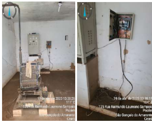
Foto 147 - EEE-01 (Pecém): gerador sem funcionar, instalações elétricas inadequadas e lâmpada sem funcionar.
