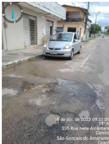
Foto 48 - RDA (Sede): vazamento na ave. Coronel Neco Martins, 506 .
