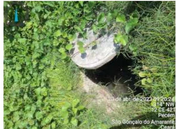
Foto 167 - ETE (Pecém): estação de tratamento abandonada, lodo acumulado, excesso de vegetação (árvores) nos taludes e presença de vegetação dentro das lagoas.
