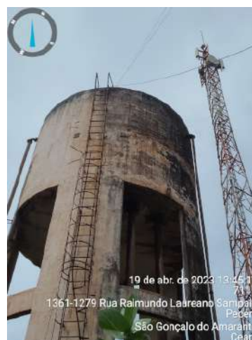
Foto 83 - REL-01 (Pecém): pintura deteriorada, guarda-corpo e escadas corroídos e danificados.
