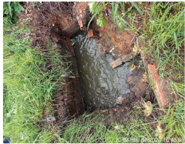
Foto 131 - ETE (Sede): obstrução de caixa de entrada.
