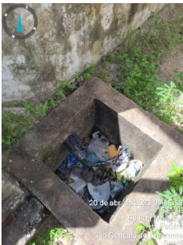
Foto 31 - EEE-02 (Pecém): caixa de inspeção das instalações elétricas sem tampa.
