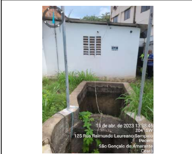
Foto 29 - EEE-01 (Pecém): ausência de tampa/grade no poço de sucção.
