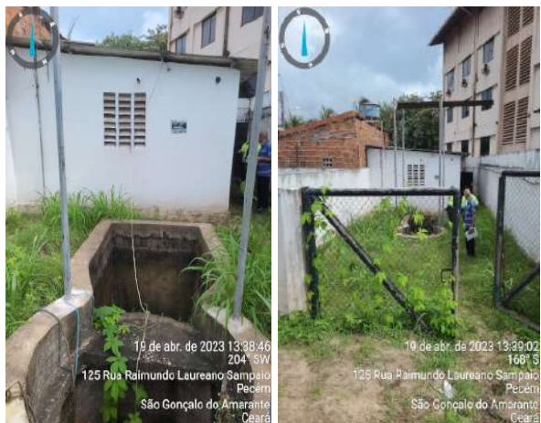
Foto 148 - EEE-01 (Pecém): instalações elétricas inadequadas, excesso de vegetação.
