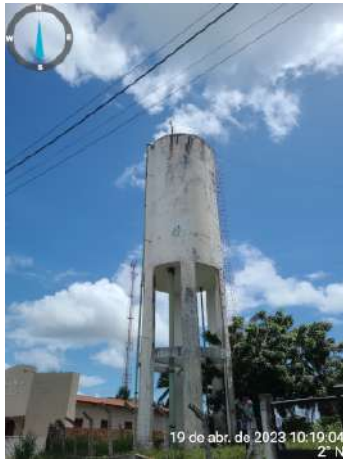
Foto 106 - REL-01 (Siupé): pintura desgastada, escada e guarda-corpo corroídos e identificação precária.
