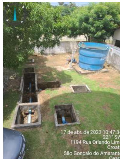
Foto 6 - REL-02 / RAP-02 (Croatá): caixas sem tampas e RAP-02 sem identificação e tampa.
