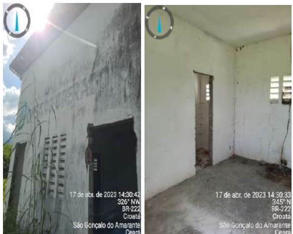
Foto 146 - ETE (Croatá): casa do operador abandonada (ausência no serviço de saneamento).
