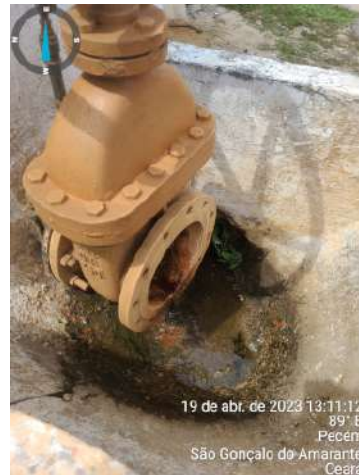
Foto 69 - F-01 (Pecém): válvula de descarga vazando.
