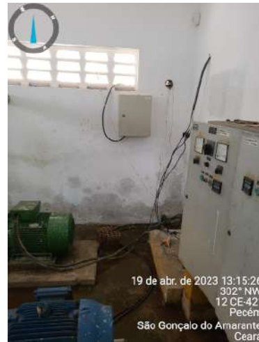
Foto 77 - EEAT/ EELF (Pecém): área alagada e com instalações elétricas inadequadas.
