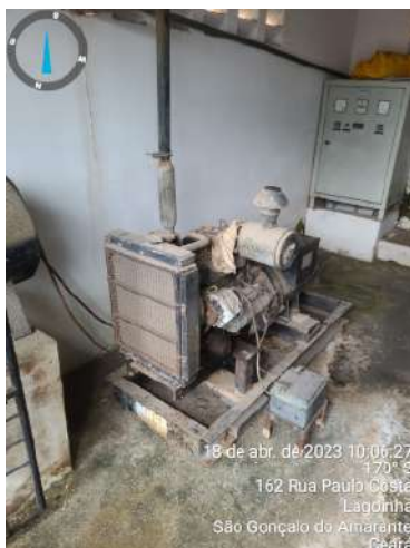
Foto 114 - EEE-03 (Sede): gerador sem funcionar.
