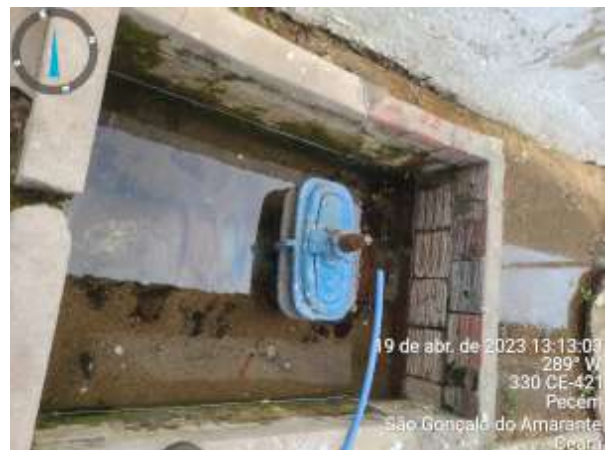
Foto 79 - ETA (Pecém): registro alagado.
