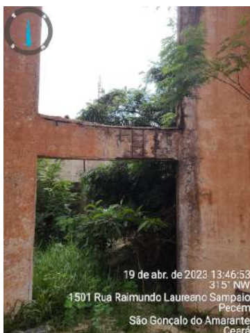
Foto 84 - REL-01 (Pecém): estrutura com aço exposto e excesso de vegetação.
