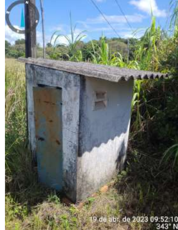
Foto 105 - PT-10 (Siupé): pintura desgastada, área com excesso de vegetação e estação elevatória sem iluminação interna.
