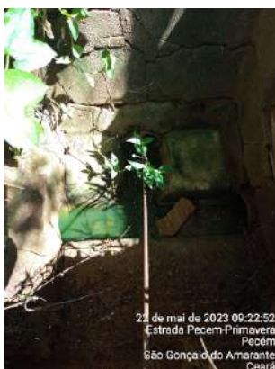
Foto 168 - ETE (Pecém): estação de tratamento abandonada, obstrução de entrada e saída das lagoas.
