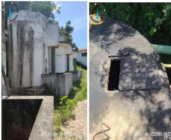
Foto 92 - F-01 (Siupé): pintura desgastada, vazamento na parede e tampa aberta.
