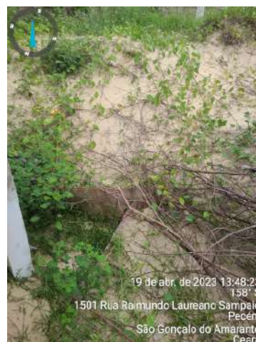
Foto 85 - REL-01 (Pecém): excesso de vegetação e caixa de registro enterrada.
