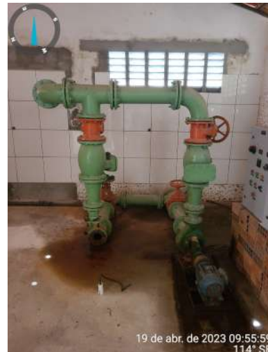
Foto 22 - EEAB-01 (Siupé): ausência de bomba reserva.
