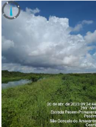
Foto 164 - ETE (Pecém): estação de tratamento abandonada, excesso de vegetação (árvores) nos taludes e presença de vegetação dentro das lagoas.
