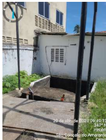
Foto 153 - EEE-03 (Pecém): acúmulo de lixo na entrada, pintura desgastada e instalações elétricas inadequadas.
