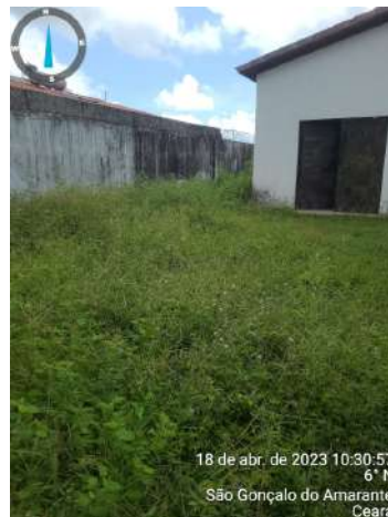
Foto 123 - EEE-05 (Sede): excesso de vegetação.
