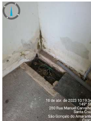
Foto 117 - EEE-04 (Sede): instalações elétricas inadequadas.
