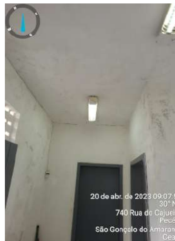
Foto 65 - Escritório (Pecém): necessidade de pintura na copa e banheiro.
