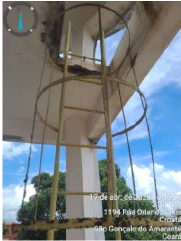
Foto 56 - REL-02 (Croatá): estrutura com aço exposto, escada corroída.
