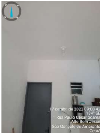
Foto 40 - Escritório (Sede): copa sem iluminação.
