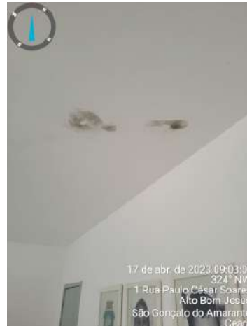
Foto 39 - Escritório (Sede):, pintura desgastada.
