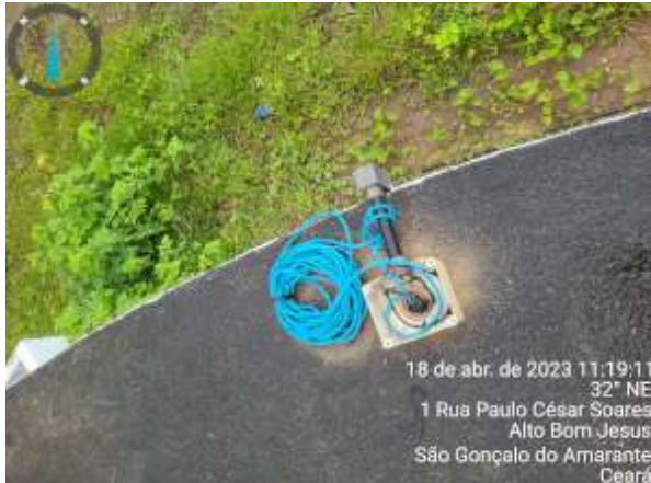
Foto 44 - RAP-01 (Sede): instalações elétricas inadequadas, macromedidor de chegada alagado.
