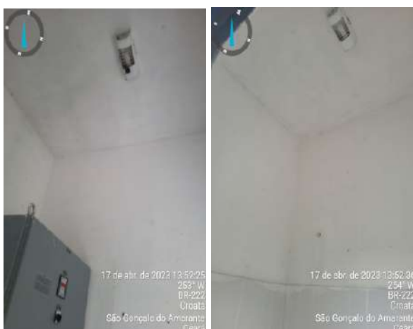
Foto 138 - EEE-04 (Croatá): iluminação externa e interna sem funcionar.
