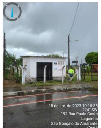
Foto 115 - EEE-03 (Sede): pintura desgastada.
