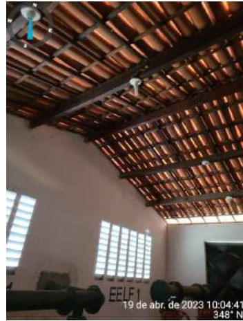
Foto 99 - EEAB-01 (Siupé): necessidade de retelhamento, vazamento e instalações elétricas inadequadas.
