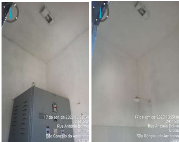
Foto 134 - EEE-01 (Croatá): ausência de iluminação externa e interna (ambiente do quadro de comando e banheiro).
