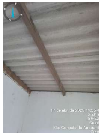
Foto 61 - PT-10 (Croatá): estação elevatória sem iluminação interna.
