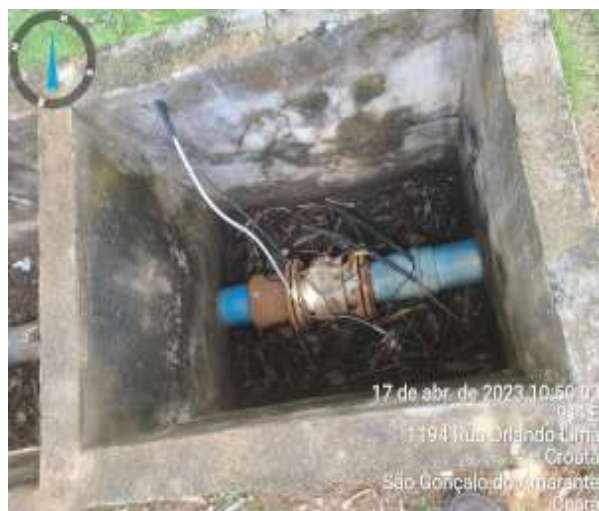
Foto 53 - REL-02 (Croatá): instalações elétricas inadequadas.
