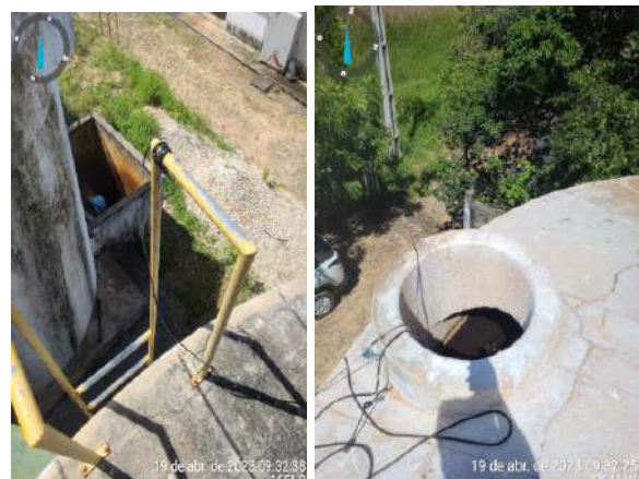
Foto 91 - RAP-01 (Siupé): escada sem estabilidade e instalações elétricas inadequadas.
