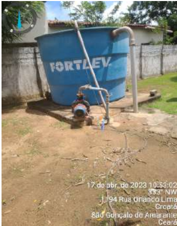
Foto 58 - RAP-02 (Croatá): instalações elétricas inadequadas.
