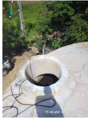
Foto 20 - RAP-01 (Siupé): ausência de tampa.
