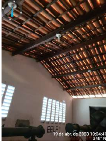
Foto 104 - EEAT e EELF (Siupé): ausência de iluminação.
