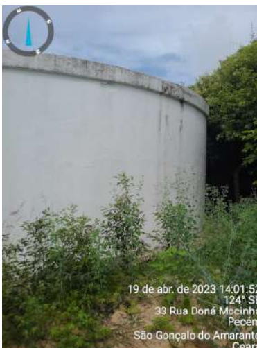
Foto 17 - RAP-03 (Pecém): sem escada e sem mangueira nível.
