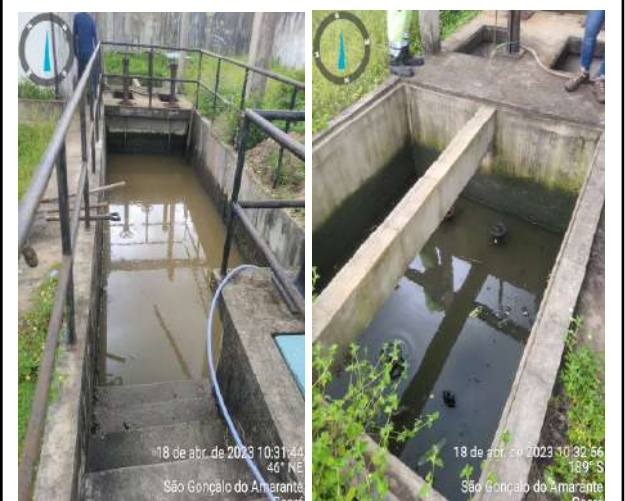
Foto 28 - EEE-05 (Sede): ausência de tampa/grade no poço de sucção.
