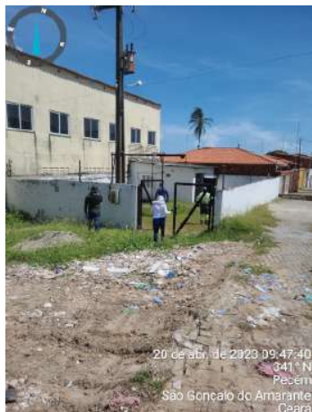
Foto 152 - EEE-03 (Pecém): acúmulo de lixo na entrada e pintura desgastada.
