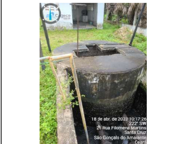
Foto 27 - EEE-04 (Sede): ausência de tampa/grade no poço de sucção.
