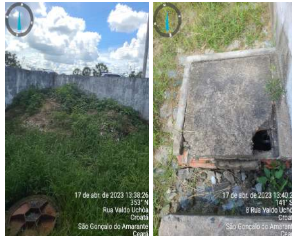
Foto 135 - EEE-03 (Croatá): pintura desgastada, vegetação em excesso e caixa de visita das instalações elétricas danificadas.
