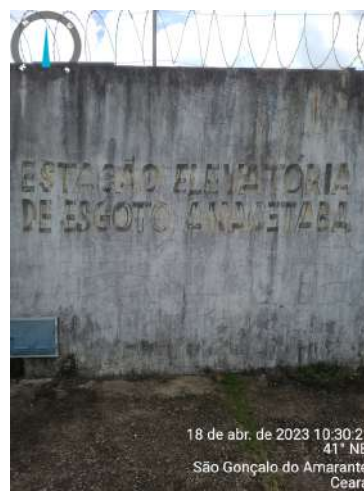
Foto 121 - EEE-05 (Sede): pintura desgastada e identificação precária.
