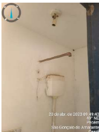
Foto 156 - EEE-03 (Pecém): área do banheiro sem lâmpada.
