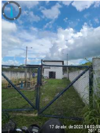
Foto 140 - EEE-05 (Croatá): pintura desgastada, identificação precária.
