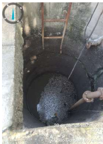
Foto 36 - EEE-04: ausência de tampa/grade no poço de sucção.
