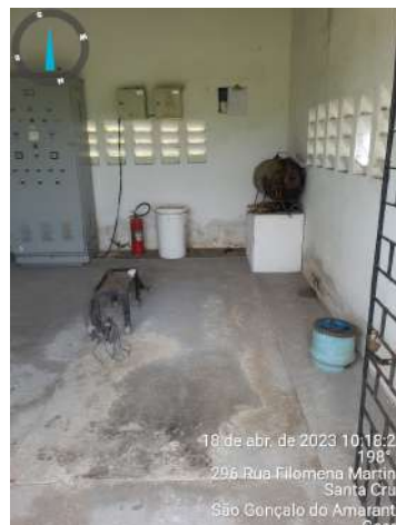
Foto 119 - EEE-04 (Sede): instalações elétricas inadequadas.
