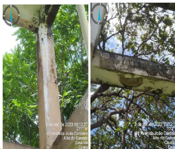
Foto 22 - REL-02 (Capuan): laje e viga com armaduras expostas e pilar com fissuras.
