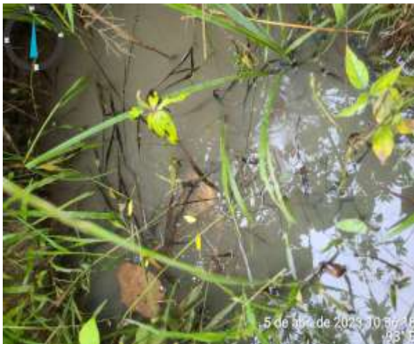
Foto 83 - RAP-01 (Primavera): macromedidor de saída alagado e sem caixa de proteção.
