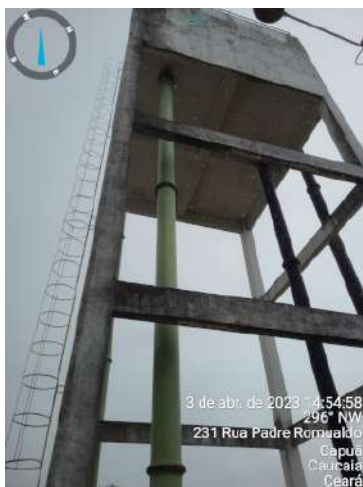
Foto 45 - REL-01 (Capuan): pintura desgastada e identificação pouco visível.
