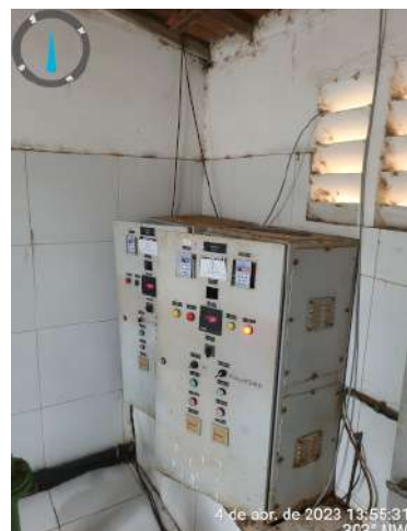
Foto 116 - Casa de bomba (Sítios Novos): instalações elétricas inadequadas e parede sem vedação completa.
