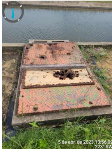
Foto 53 - Captação (Catuana): tampa corroída.
