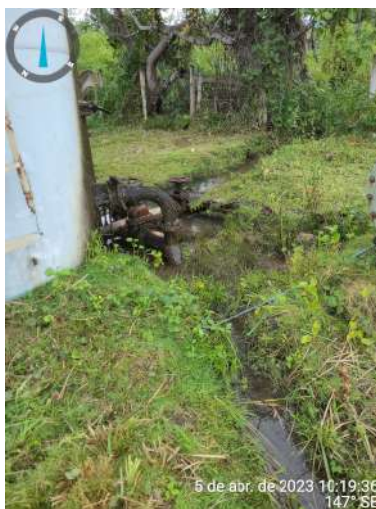
Foto 67 - ETA (Primavera): área alagada, pois a tubulação de descarga despeja na própria ETA.
