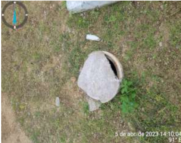
Foto 59 - ETA (Catuana): caixa de passagem de instalações elétricas com tampa quebrada.
