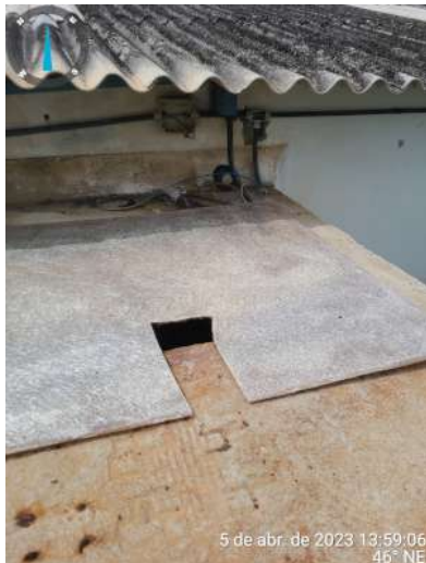
Foto 55 - RSE-01 (Catuana): tampas sem vedação hermética e sem ressalto de proteção e instalações elétricas inadequadas.
