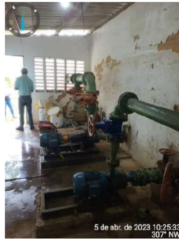
Foto 80 - Estação elevatória (EELF / EEAT) (Primavera): paredes com infiltrações e pinturas deterioradas, bombas com vazamento e mal fixadas e ausência de bomba reserva.
