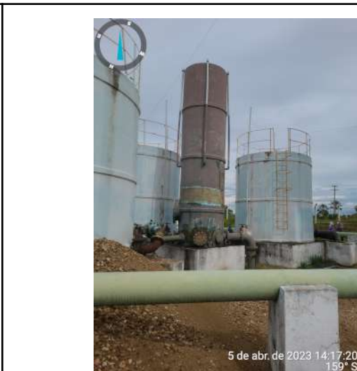
Foto 14 - Torre de Nível (Catuana): sem escada.
