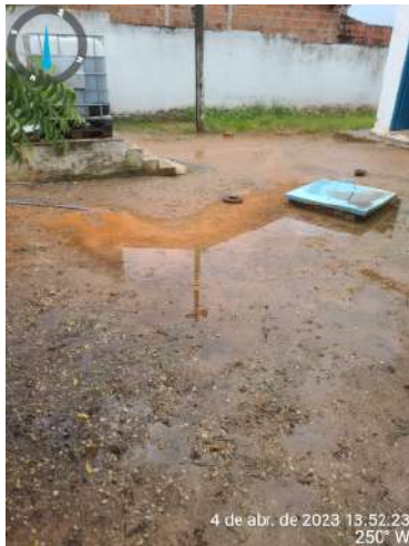
Foto 107 - ETA (Sítios Novos): área alagada, sem drenagem.
