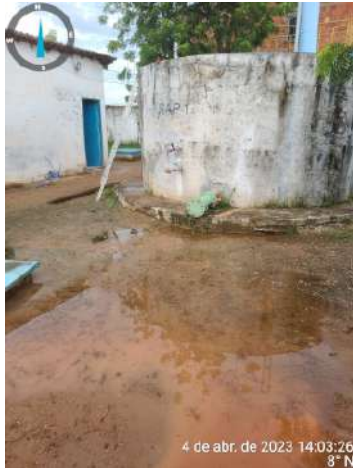
Foto 105 - ETA (Sítios Novos): área alagada, sem drenagem.
