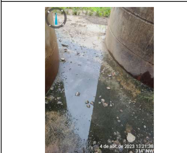
Foto 101 - REL-01 (Sítios Novos): apresenta vazamento, área interna desorganizada e escada corroída.
