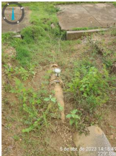
Foto 61 - ETA (Catuana): macromedidor de saída para Catuana sem caixa de proteção.
