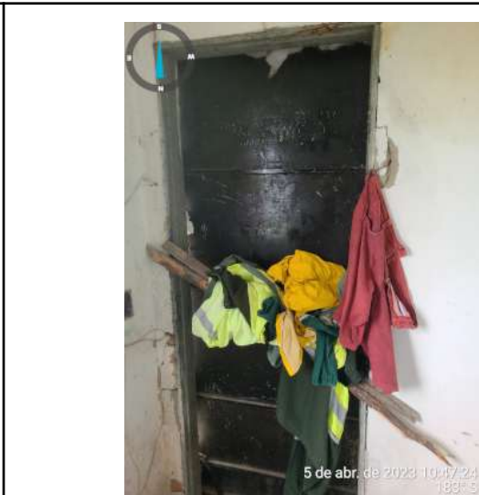
Foto 72 - Casa do operador (Primavera): porta danificada (sem encaixe).
