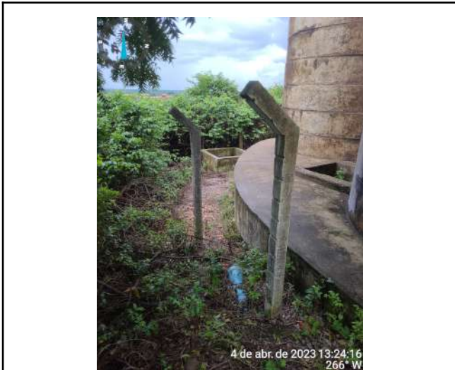
Foto 99 - REL-01/REL-02 e REL-03 (Sítios Novos): área com excesso de vegetação, calçada deteriorada e caixa sem tampa de proteção.
