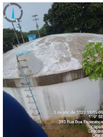
Foto 46 - RAP-02 (Capuan): pintura desgastada e escada inadequada, sem os requisitos mínimos de segurança.
