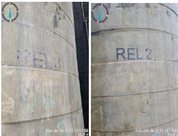
Foto 97 - REL-02 e REL-03 (Sítios Novos): aço das estruturas exposto, identificação pouco visível.
