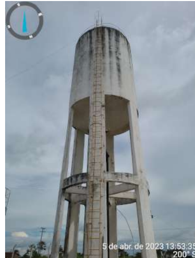
Foto 54 - REL-01 (Catuana): escada corroída e pintura desgastada.
