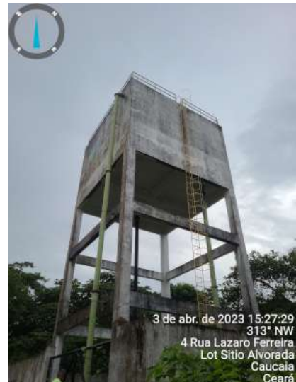
Foto 48 - REL-04 (Capuan): pintura desgastada e identificação pouco visível.
