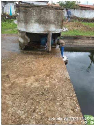
Foto 93 - Captação (Sítios Novos): estrutura de proteção da bomba danificada.
