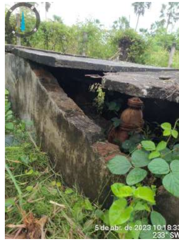
Foto 66 - ETA (Primavera): registro de chegada com caixa danificada e área alagada, pois a tubulação de descarga despeja na própria ETA.
