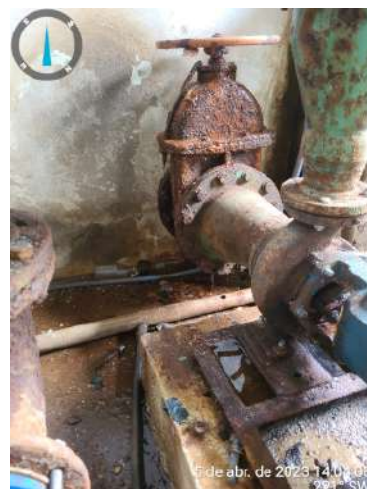
Foto 58 - EEAT-01 e EEAT-02 (Catuana): presença de vazamento.
