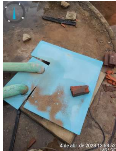
Foto 114 - RAP-01 (Sítios novos): tampa sem vedação hermética e instalações elétricas inadequadas (fiação solta).
