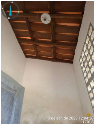
Foto 43 - Casa de Química (Capuan): banheiro sem lâmpada.
