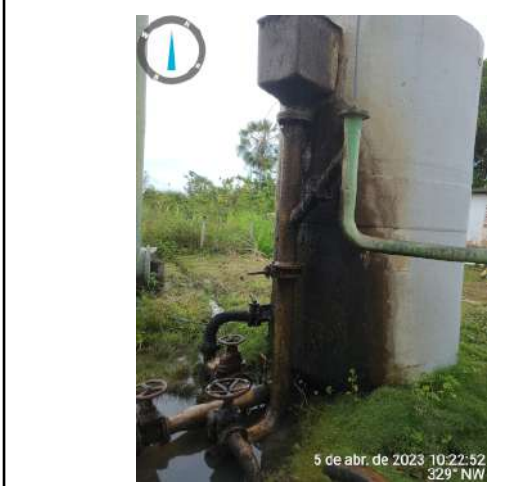
Foto 76 - F-01 (Primavera): escada corroída com gaiola danificada, presença de extravasamento e identificação ilegível.
