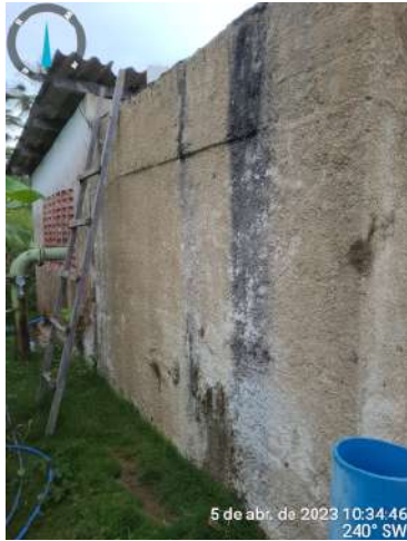
Foto 81 - RAP-01 (Primavera): pintura desgastada, instalações elétricas inadequadas, escada inadequada, sem os requisitos mínimos de segurança.
