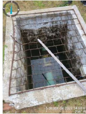
Foto 60 - ETA (Catuana): caixa de saída para São Gonçalo do Amarante com grade danificada e com macromedidor alagado.
