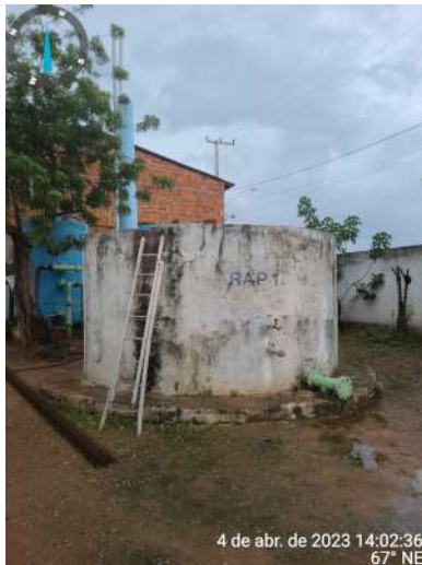
Foto 113 - RAP-01 (Sítios novos): pintura desgastada, escada inadequada, sem os requisitos mínimos de segurança.
