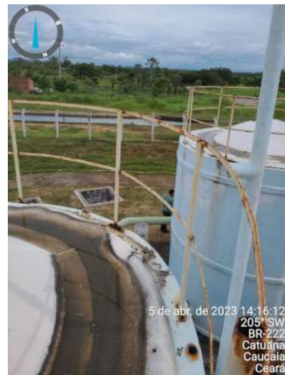
Foto 64 - F-01, F-02 e F-03 (Catuana): escadas e guarda-corpos corroídos.
