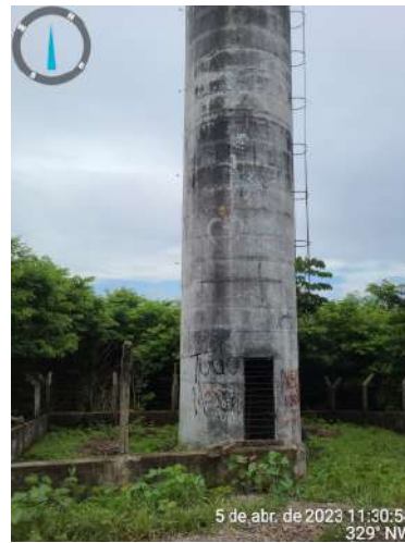
Foto 84 - REL-02 (Primavera): cerca danificada, pintura deteriorada, ausência de fiação do pára-raio.
