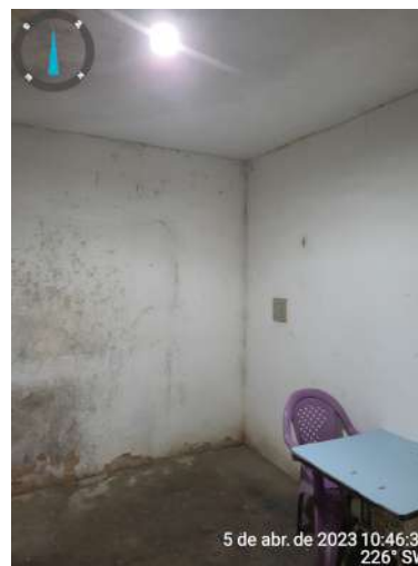
Foto 70 - Casa do operador (Primavera): com infiltração no teto e paredes.
