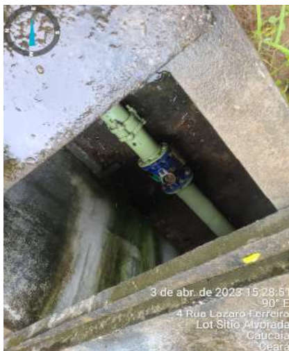
Foto 49 - REL-04 (Capuan): macromedidor sem funcionar.
