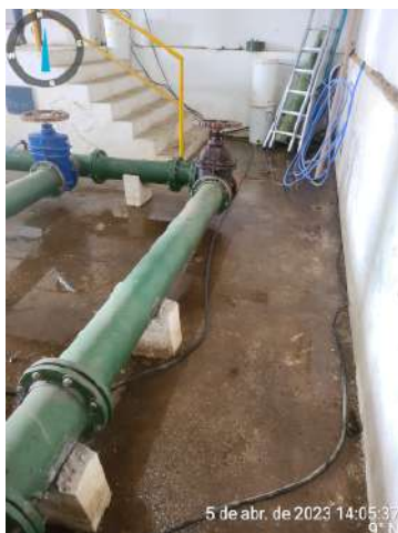
Foto 57 - EEAT-01 e EEAT-02 (Catuana): água acumulada, instalações elétricas inadequadas (fios soltos) e presença de vazamentos.
