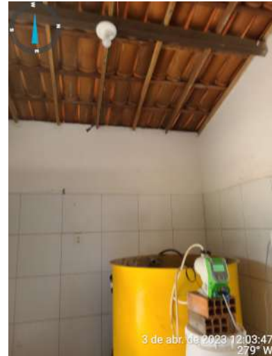
Foto 42 - Casa de Química (Capuan): lâmpada da área de cloração queimada.
