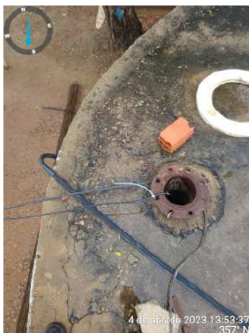
Foto 115 - RAP-01 (Sítios novos): acúmulo de água pluvial, tubulação de respiro inadequada e instalações elétricas inadequadas.
