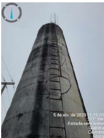
Foto 85 - REL-02 (Primavera): pintura deteriorada, ausência de fiação do para-raio, escada corroída.
