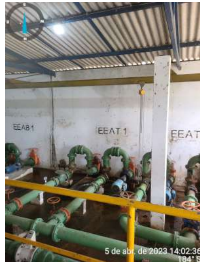
Foto 56 - EEAT-01 e EEAT-02 (Catuana): água acumulada, instalações elétricas inadequadas e presença de vazamentos.
