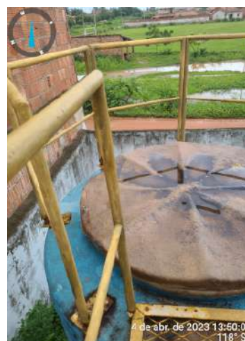
Foto 110 - F-01 e F-02 (Sítios Novos): guarda-corpo, passagem superior e escada sem estabilidade e corroídos.
