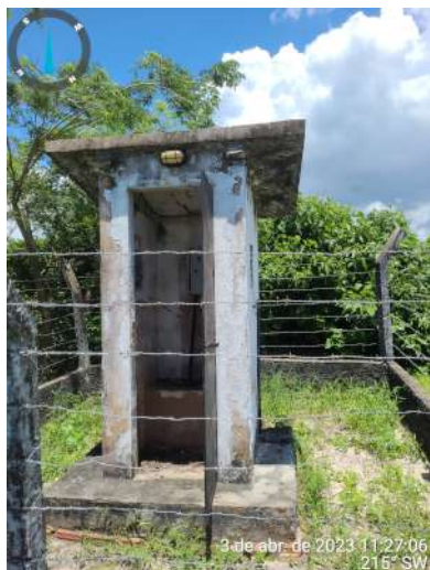
Foto 9 - PT-07 (Capuan): sem identificação e ausência de portão na área do poço.
