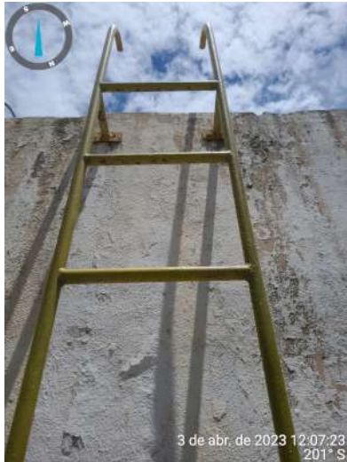
Foto 41 - RAP-01 (Capuan): escada corroída.
