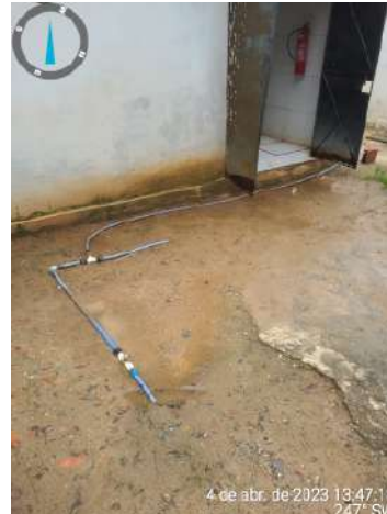
Foto 106 - ETA (Sítios Novos): área alagada, sem drenagem, tubulação de cloro exposta.
