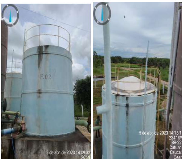
Foto 63 - F-01, F-02 e F-03 (Catuana): escadas e guarda-corpos corroídos.
