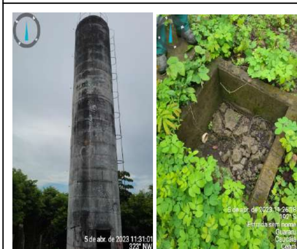
Foto 17 - REL-02 (Primavera): sem identificação e caixa de descarga sem tampa de proteção.
