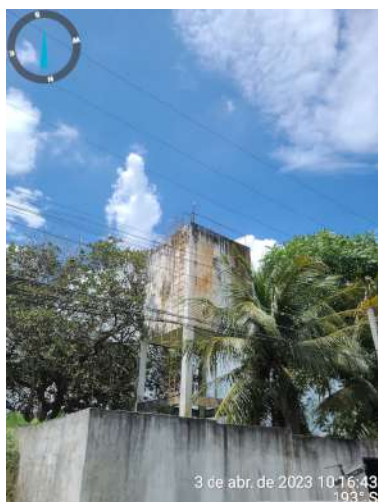
Foto 21 - REL-02 (Capuan): pintura deteriorada, escada e guarda-corpo corroídos.
