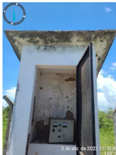
Foto 26 - PT-02 (Capuan): pintura desgastada, ausência de iluminação interna e externa.
