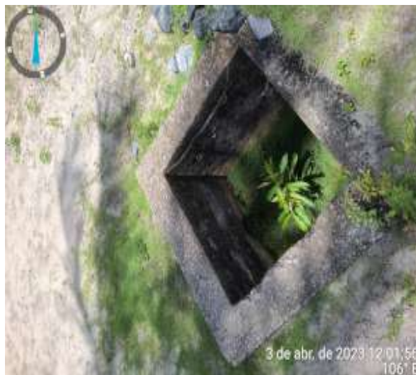
Foto 10 - RAP-01 (Capuan): caixa de descarga sem tampa de proteção.
