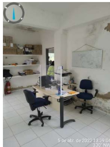
Foto 50 - Escritório (Catuana): pintura desgastada no teto e na parede devido às infiltrações.
