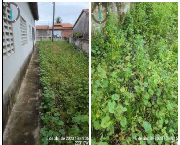
Foto 52 - Escritório (Catuana): excesso de vegetação e ausência de drenagem no entorno.
