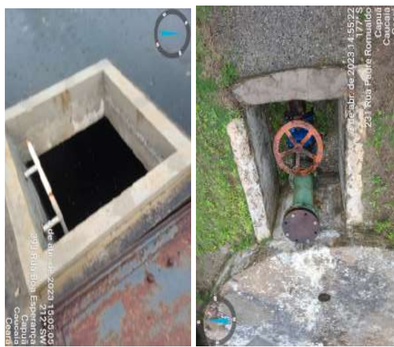
Foto 12 - RSE-01 (Capuan): caixa de inspeção do reservatório sem tampa e caixa de registro sem tampa de proteção.
