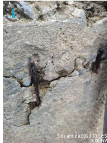
Foto 82 - RAP-01 (Primavera): pintura desgastada, paredes com aço exposto.
