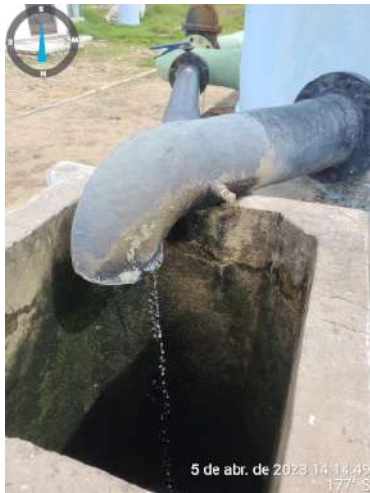
Foto 65 - F-02 (Catuana): presença de vazamento (registro de descarga não veda).
