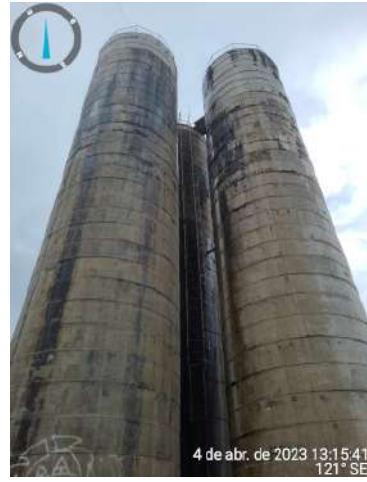
Foto 94 - REL-01/ REL-02 e REL-03 (Sítios Novos): pintura deteriorada e aço das estruturas expostas.
