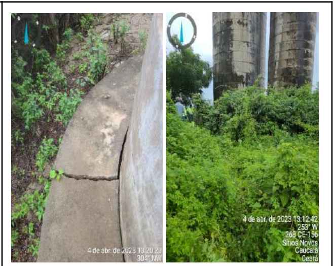
Foto 100 - REL-01/REL-02 e REL-03 (Sítios Novos): área com excesso de vegetação e calçada deteriorada.
