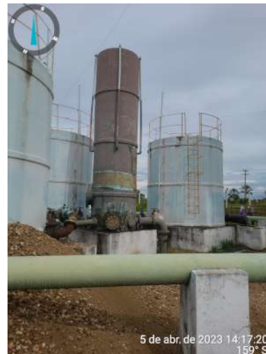
Foto 62 - Torre de Nível (Catuana): pintura desgastada.
