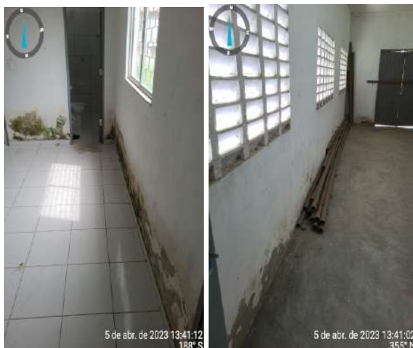
Foto 51 - Escritório (Catuana): pintura desgastada na copa e almoxarifado.
