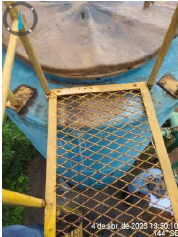
Foto 111 - F-01 e F-02 (Sítios Novos): guarda-corpo, passagem superior e escada sem estabilidade e corroídos.
