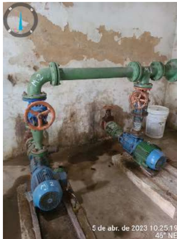
Foto 79 - Estação elevatória (EELF / EEAT) (Primavera): paredes com infiltrações e pinturas deterioradas, bombas com vazamento e mal fixadas.
