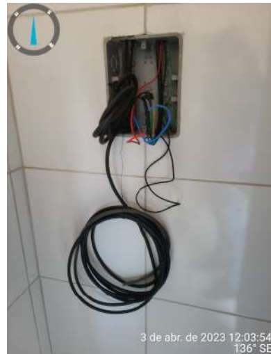
Foto 44 - Casa de Química (Capuan): instalações inadequadas, caixa sem tampa e fios soltos.
