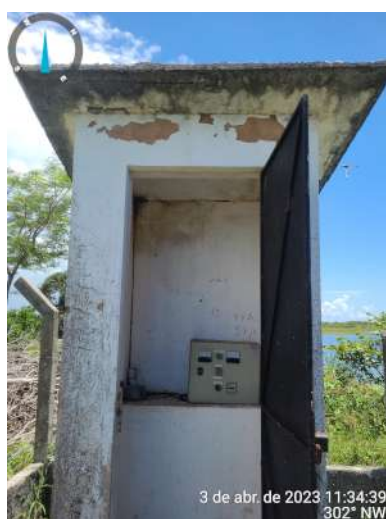
Foto 27 - PT-03 (Capuan): pintura desgastada e instalações elétricas inadequadas.
