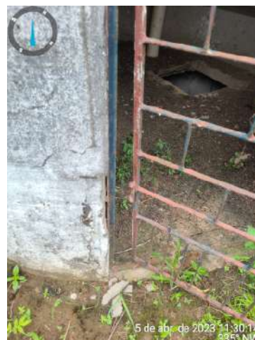
Foto 86 - REL-02 (Primavera): portão interno com fixação danificada.
