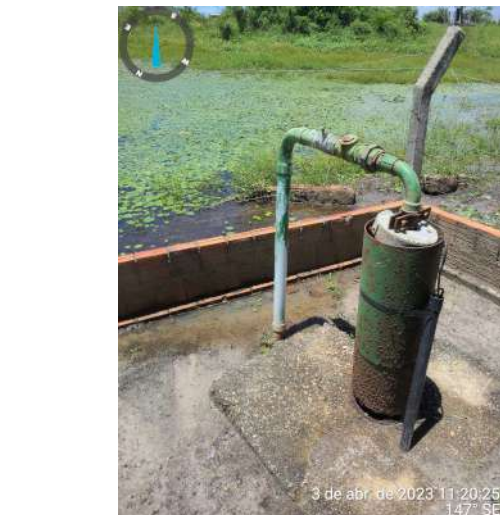
Foto 33 - PT-06 (Capuan): tubulação de proteção corroída, fiação elétrica inadequada.
