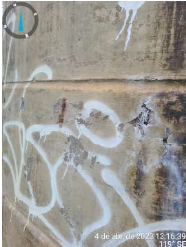
Foto 95 - REL-03 (Sítios Novos): aço das estruturas exposto, identificação pouco visível.
