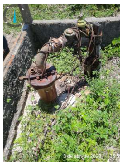
Foto 28 - PT-03 (Capuan): pintura desgastada e instalações elétricas inadequadas.
