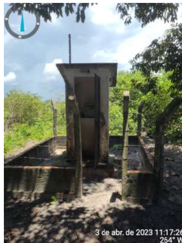
Foto 8 - PT-06 (Capuan): sem identificação e ausência de portão na área do poço.
