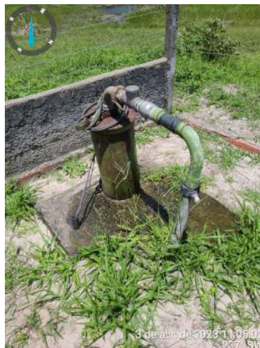
Foto 24 - PT-01 (Capuan): presença de vazamento, laje de proteção quebrada.
