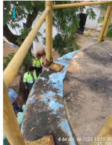
Foto 112 - F-01 e F-02 (Sítios Novos): guarda-corpo, passagem superior e escada sem estabilidade e corroídos.
