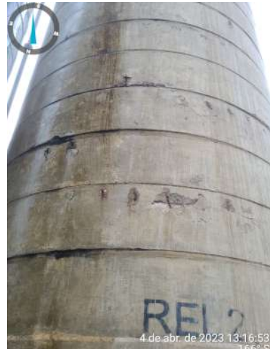
Foto 96 - REL-02 (Sítios Novos): aço das estruturas exposto, identificação pouco visível.
