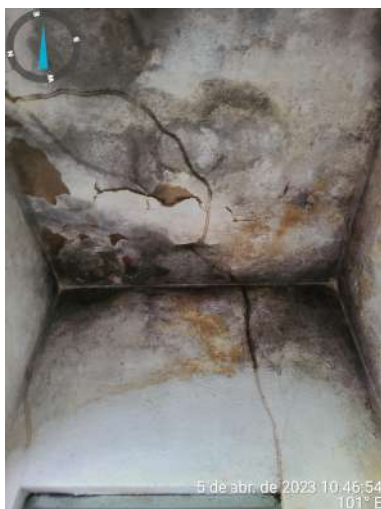
Foto 69 - Casa do operador (Primavera): com infiltração no teto e paredes.
