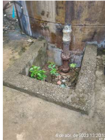
Foto 20 - REL-01/REL-02/REL-03 (Sítios Novos): caixa sem tampa de proteção.
