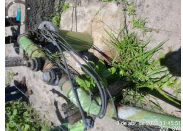
Foto 30 - PT-04 (Capuan): instalações elétricas inadequadas.
