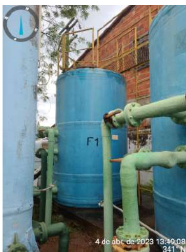
Foto 109 - F-01 e F-02 (Sítios Novos): guarda-corpo, passagem superior e escada sem estabilidade e corroídos.
