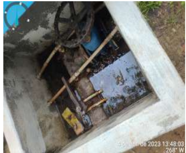
Foto 108 - ETA (Sítios Novos): área alagada, sem drenagem, tubulação de cloro exposta, registro de chegada alagado.
