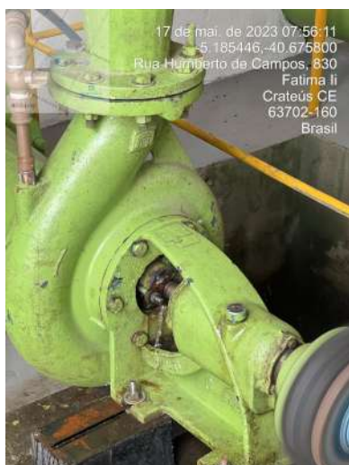
Foto 5 - ETA Poty: vazamento na EEAT.
