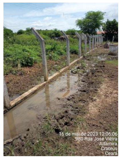
Foto 24 - ETE 13: drenagem inadequada de um córrego na área interna da ETE.
