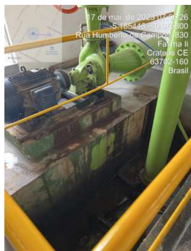
Foto 6 - ETA Poty: vazamento na EEAT.
