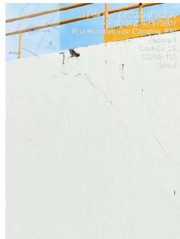
Foto 2 - ETA Poty: problemas na parede do decantador que podem levar ao colapso da estrutura.
