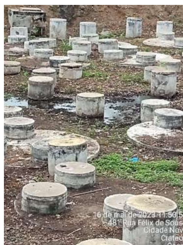
Foto 18 - ETE 05: extravasamento de esgoto
