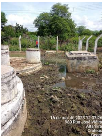
Foto 23 - ETE 13: extravasamento de esgoto.
