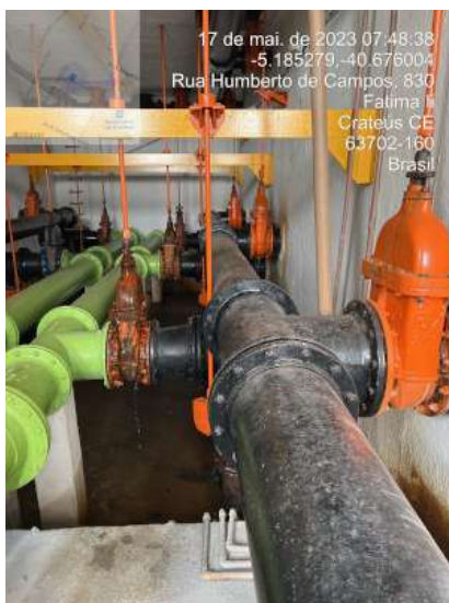
Foto 3 - ETA Poty: vários vazamentos nos registros das saídas dos filtros.
