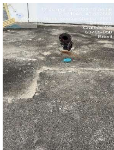
Foto 10 - EEAT e RAP-02 (Dom Frágoso): respiro sem curva.
