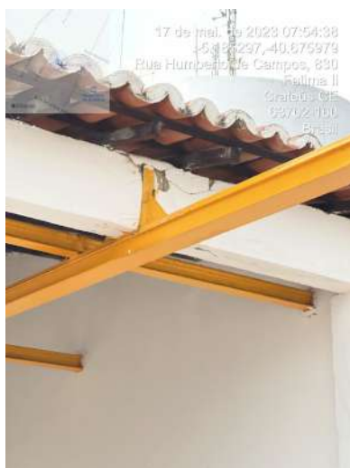
Foto 9 - ETA Poty: rachadura na viga que dá sustentação ao monotrilho dos cilindros de Cloro.
