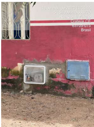
Foto 15 - EPZ: estação piezométrica instalada, porém inoperante.
