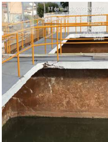
Foto 1 - ETA Poty: problemas na parede do decantador que podem levar ao colapso da estrutura.
