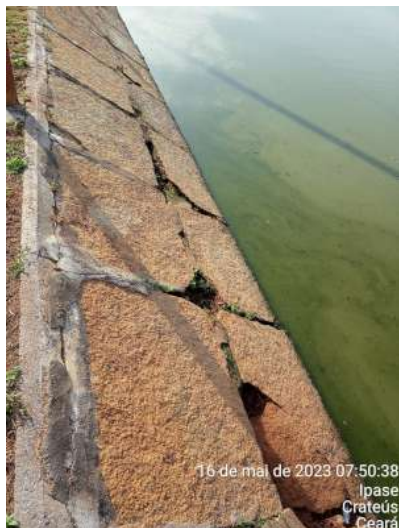
Foto 31 - ETE Maratoan: abertura nas placas de concreto de proteção dos taludes das lagoas.
