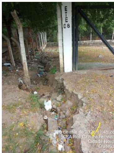
Foto 21 - ETE 08: vala de drenagem interna à ETE.
