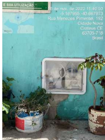
Foto 14 - EPZ: estação piezométrica instalada, porém inoperante.
