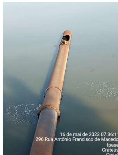
Foto 32 - ETE Maratoan: corrosão na tubulação de entrada da lagoa.
