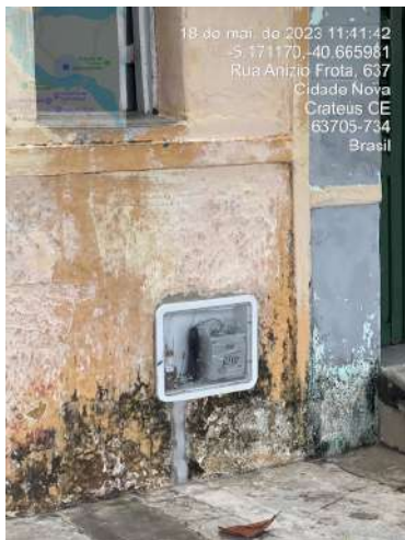
Foto 13 - EPZ: estação piezométrica instalada, porém inoperante.
