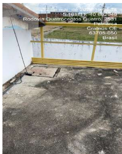
Foto 11 - EEAT e RAP-02 (Dom Frágoso): reservatório com tampa semiaberta.
