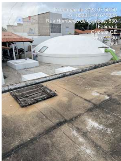
Foto 7 - ETA Poty: reservatório com tampa improvisada.
