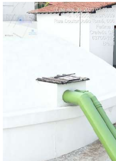
Foto 8 - ETA: reservatório com tampa improvisada.
