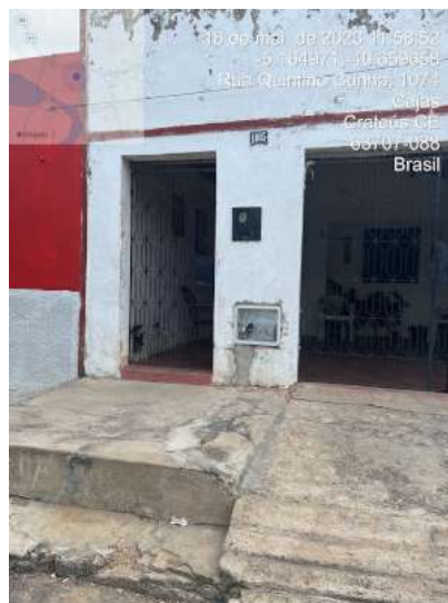
Foto 16 - EPZ: estação piezométrica instalada, porém inoperante.
