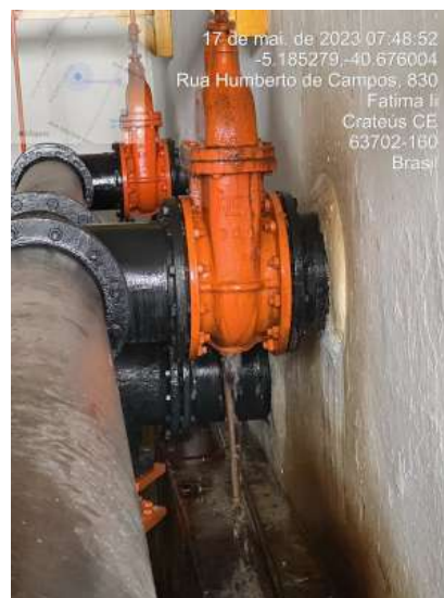
Foto 4 - ETA Poty: vários vazamentos nos registros das saídas dos filtros.
