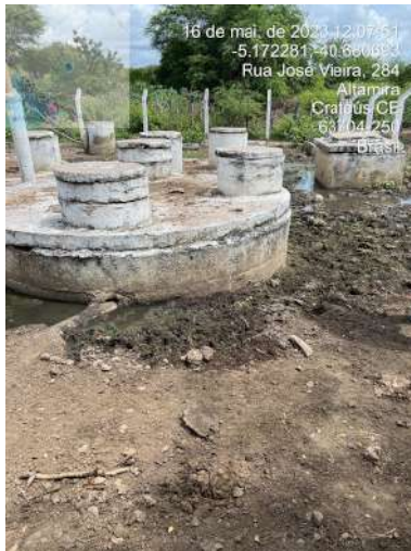
Foto 19 - ETE 05: extravasamento de esgoto.
