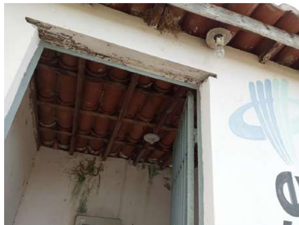
Foto 19 - PT-04 (Sede): Instalações elétricas inadequadas, sem luminárias e/ou luminárias queimadas.
