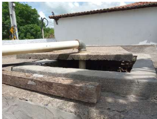
Foto 38 - RAP-01 (Rosário): desativado com tampa aberta no PT-Rosário
