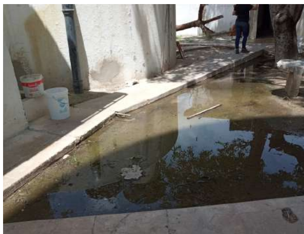
Foto 28 - RAP-01 (Sede): Falha de drenagem e área alagada.
