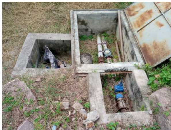
Foto 35 - RAP-02 (Sede): caixa de proteção com componentes soterrados ou semi-soterrados, sem tampa ou com tampas quebradas .
