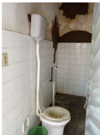
Foto 14 - RAP-01 (Sede): Infraestruturas operando de forma precária, obras em reforma ou recuperação em andamento.
