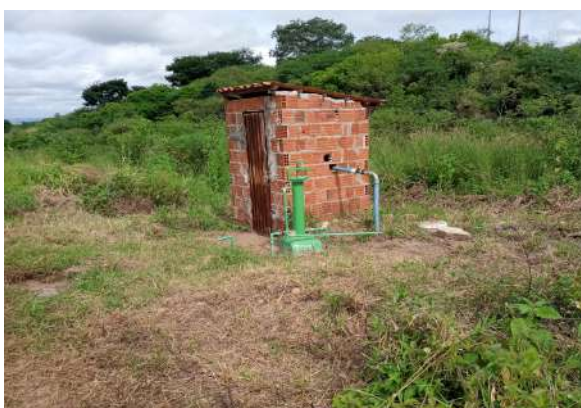
Foto 12 - PT-10 (Sede): Infraestruturas operando de forma precária, obras em reforma ou recuperação em andamento.
