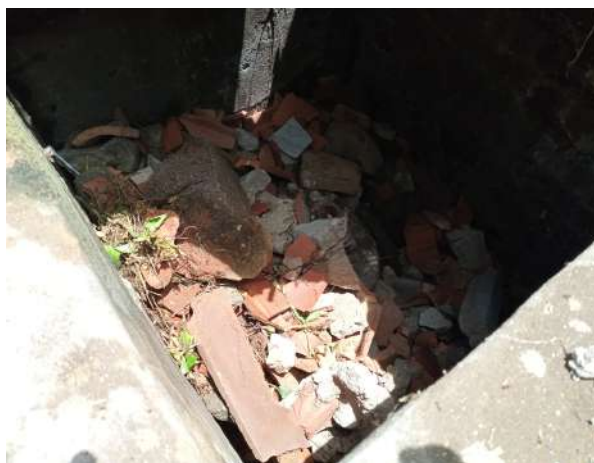
Foto 30 - REL-01 (Sede): caixa de proteção com componentes soterrados ou semi-soterrados
