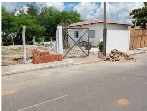
Foto 6 - Escritório (Sede): Infraestruturas operando de forma precária, obras em reforma ou recuperação em andamento.
