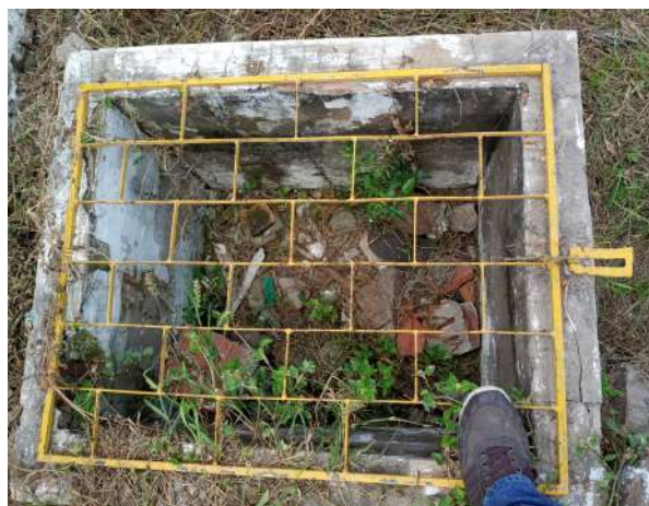
Foto 31 - REL-01 (Sede): caixa de proteção com componentes soterrados ou semi-soterrados.
