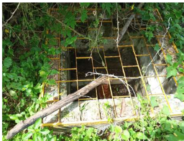
Foto 29 - PT-02 (Sede): caixa de proteção com componentes soterrados ou semi-soterrados.
