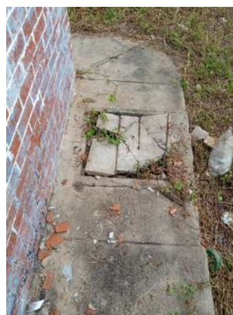
Foto 33 - REL-01 (Sede): caixa de proteção com componentes soterrados ou semi-soterrados, sem tampa ou com tampas quebradas .
