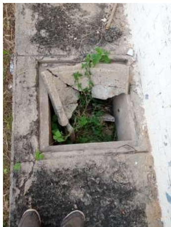
Foto 34 - REL-01 (Sede): caixa de proteção com componentes soterrados ou semi-soterrados, sem tampa ou com tampas quebradas .
