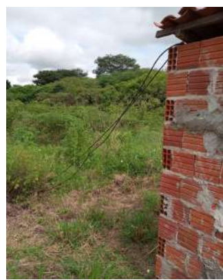
Foto 13 - RAP-01 (Sede): Instalações elétricas inadequadas, componentes danificados e/ou fiação exposta ou improvisada tipo "gambiarra".
