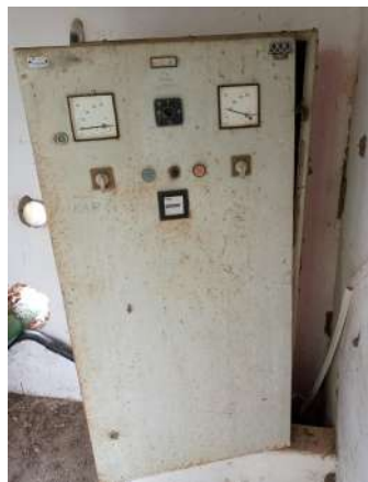
Foto 17 - PT-02 (Sede): Instalações elétricas inadequadas, componentes danificados e/ou fiação exposta ou improvisada tipo “gambiarra”.
