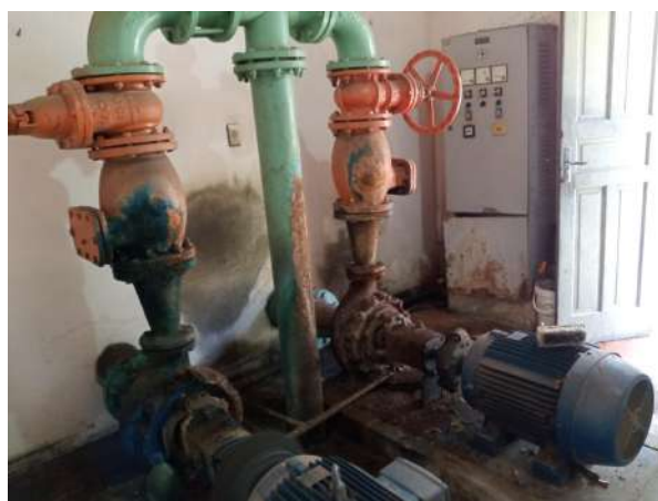
Foto 37 - EEAT-01 (Sede): Manutenção e limpeza precária.
