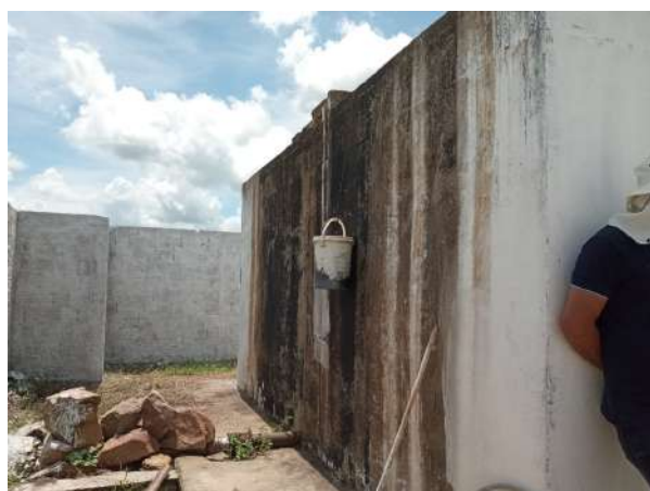
Foto 36 - RAP-02 (Sede): Não há escada e nem controle de nível (sinais de extravasamento).
