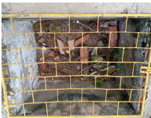
Foto 32 - REL-01 (Sede): caixa de proteção com componentes soterrados ou semi-soterrados, sem tampa ou com tampas quebradas .
