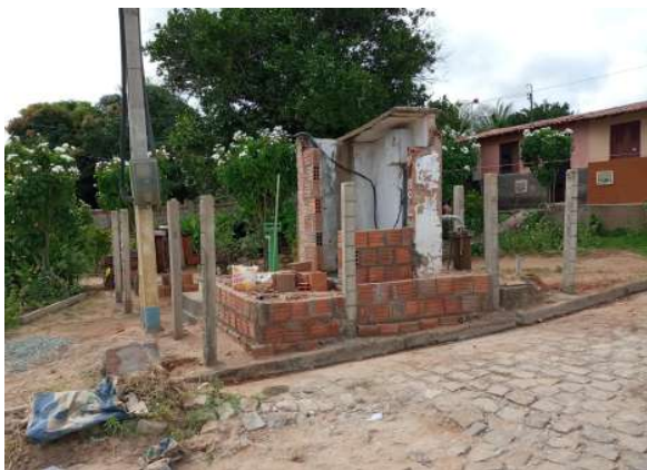
Foto 10 - PT-09 (Sede): Infraestruturas operando de forma precária, obras em reforma ou recuperação em andamento.
