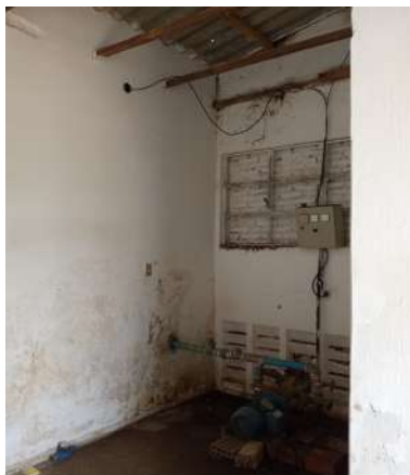
Foto 16 - Booster-01 (Sede): Instalações elétricas inadequadas, falta de manutenção e limpeza.
