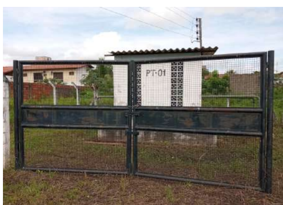
Foto 26 - PT-01 (Sede): Falta manutenção / recuperação ou limpeza interna da casa de abrigo
