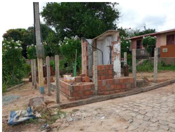
Foto 2 - PT-10 (Sede): ausência de identificação e falta de isolamento da área.
