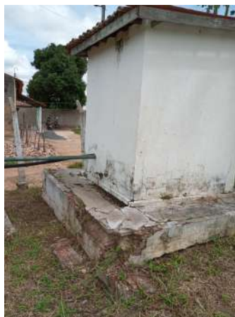
Foto 24 - PT-04 (Sede): Falta manutenção / recuperação da infraestrutura e doo isolamento da área.
