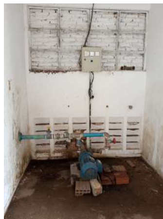
Foto 25 - Booster 01 (Sede): Falta manutenção / recuperação ou limpeza interna da casa de abrigo.
