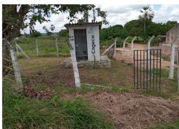
Foto 27 - PT-04 (Sede): Falta manutenção / recuperação ou limpeza interna da casa de abrigo
