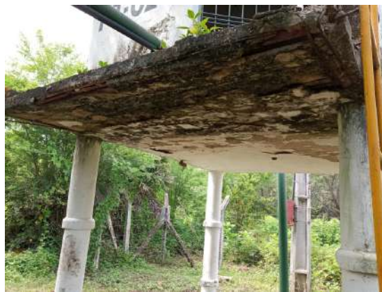
Foto 23 - PT-02 (Sede): Falta manutenção / recuperação da laje.
