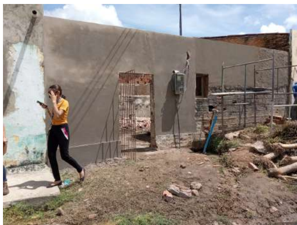
Foto 8 - PT-08 (Sede): Infraestruturas operando de forma precária, obras em reforma ou recuperação em andamento.
