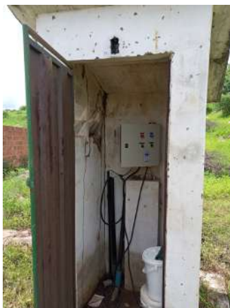
Foto 20 - PT-06 (Sede): Instalações elétricas inadequadas, componentes danificados e/ou fiação exposta ou improvisada tipo “gambiarra”.
