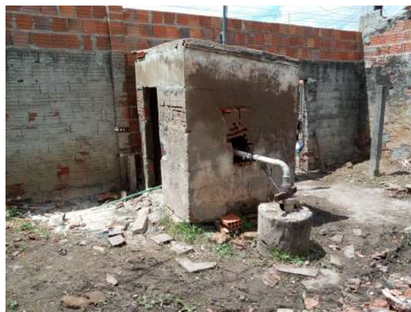
Foto 9 - PT-08 (Sede): Infraestruturas operando de forma precária, obras em reforma ou recuperação em andamento.
