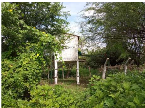
Foto 3 - PT-02 (Sede): Não há parapeito de proteção na sacada de acesso a casa de abrigo.
