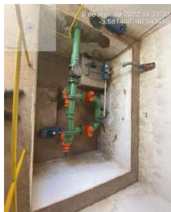
Foto 2 - EEAT: ausência de bomba reserva.
