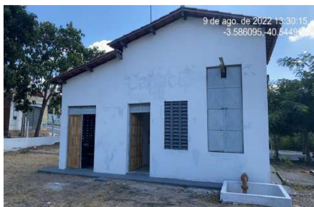
Foto 5 - EEE: não possui identificação.
