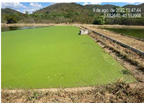
Foto 13 - ETE: LM-02 apresenta curto circuito no fluxo dos esgotos.
