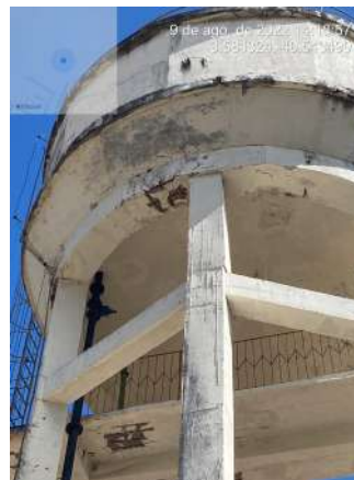
Foto 4 - REL-01: estrutura danificada.
