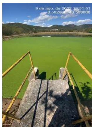
Foto 12 - ETE: LM-01 apresenta curto circuito no fluxo dos esgotos.
