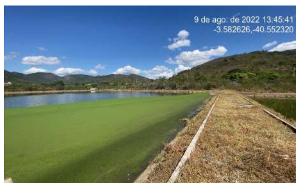
Foto 8 - ETE: LF-01 apresenta restos da limpeza nas bordas das lagoas, bem como há uma crosta de algas.
