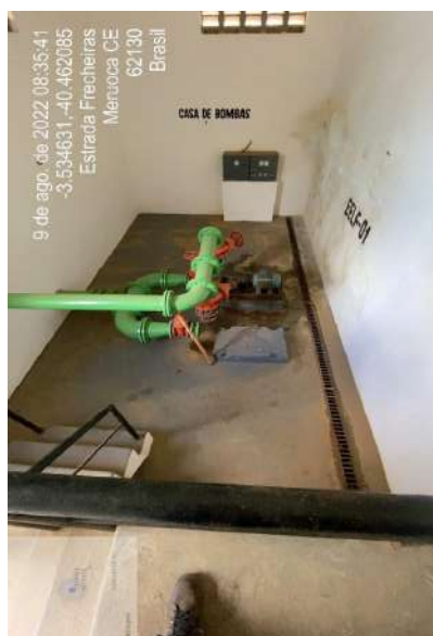
Foto 3 - Ausência de bomba reserva na EELF da ETA.
