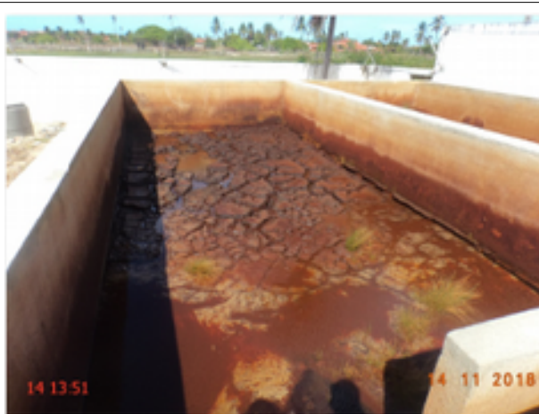
Foto 53 – ETA (Caponga): leito de secagem necessitando de limpeza.
