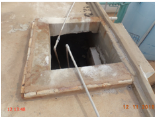
Foto 7 – Reservatório (Sede): RAP-01 sem tampa de inspeção.
