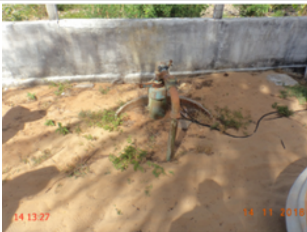
Foto 6 – Captação (Caponga): PT-02 ausência de laje de proteção.
