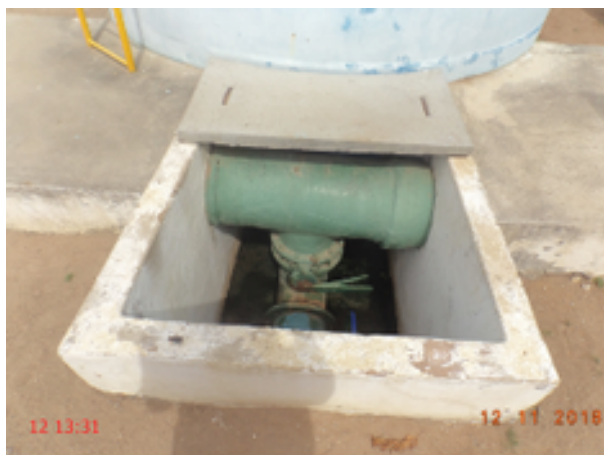
Foto 51 – ETA (Sede): a caixa de inspeção do filtro F-04 não possui tampa ou grade de proteção.
