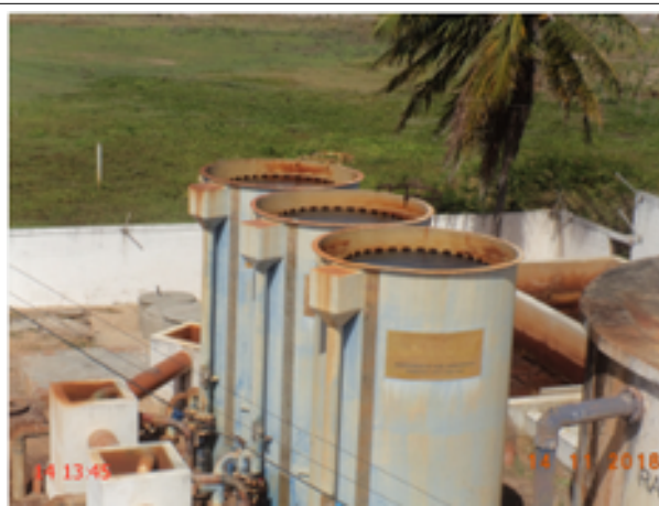
Foto 58 – ETA (Caponga): Os filtros F-01, F-02 e F-03 ausência de tampas.
