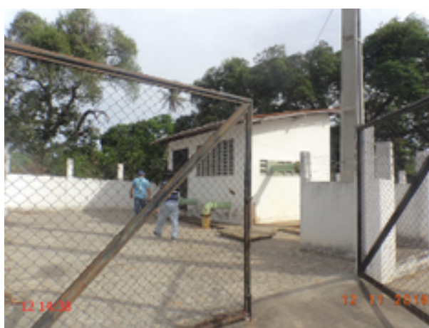
Foto 24 – Elevatória (Sede): EERD-01 não possui identificação.
