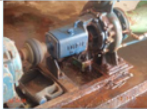
Foto 46 – Elevatória (Sede): a EEAT-01 e EERD-01 apresentam vazamentos.
