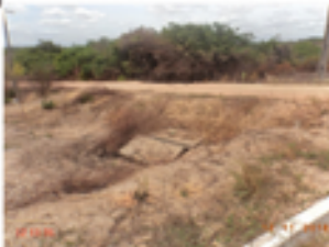
Foto 33 – Adução (Sede): na AAB existem duas tampas abertas.
