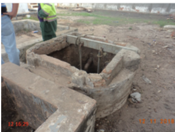
Foto 15 – ETE (Sede): poço de sucção sem tampa.
