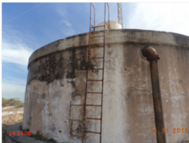
Foto 27 – Reservatório (Caponga): o RAP-02 está com a escada danificada e em processo de corrosão e pintura deteriorada.
