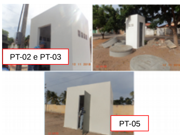
Foto 18 – Captação (Sede): Os poços PT-02, PT-03, PT-05, PT-06 e PT-08 estão sem identificação.
