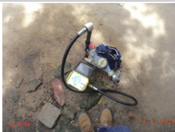
Foto 3 – RDA (Sede): medição contínua de pressão no endereço localizado na Rua SDO 22, s/n.
