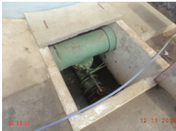
Foto 50 – ETA (Sede): a caixa de inspeção do filtro F-03 não possui tampa ou grade de proteção.
