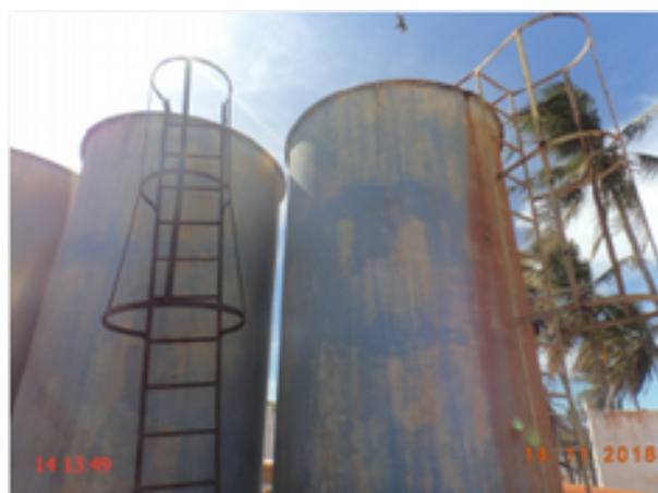
Foto 17 – ETA (Caponga): os filtros F-01 e F-02 estão com as escadas em processo de corrosão.
