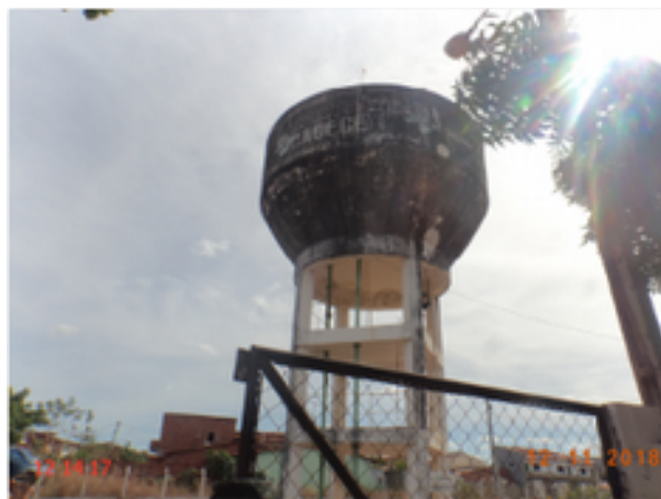
Foto 30 – Reservatório (Sede): o REL-02 está com a pintura deteriorada e não está identificado.
