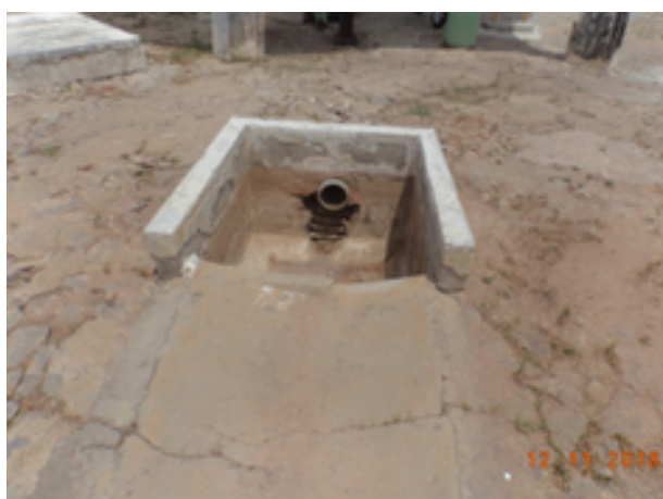
Foto 55 – Reservatório (Sede): existe uma caixa de inspeção sem tampa ou grade no REL-01
