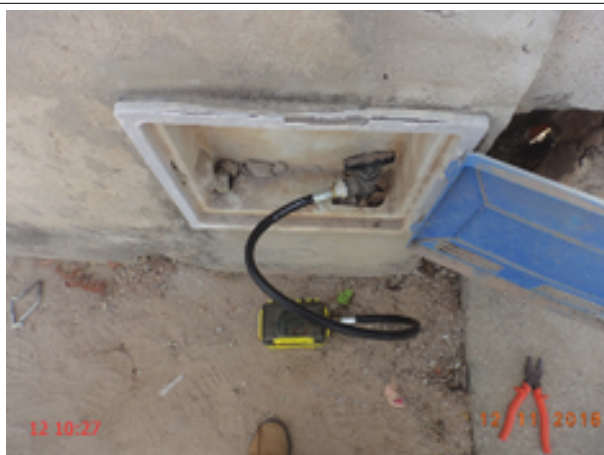
Foto 2 – RDA (Sede): medição contínua de pressão no endereço localizado na Rua Vicente Faustino 1163.
