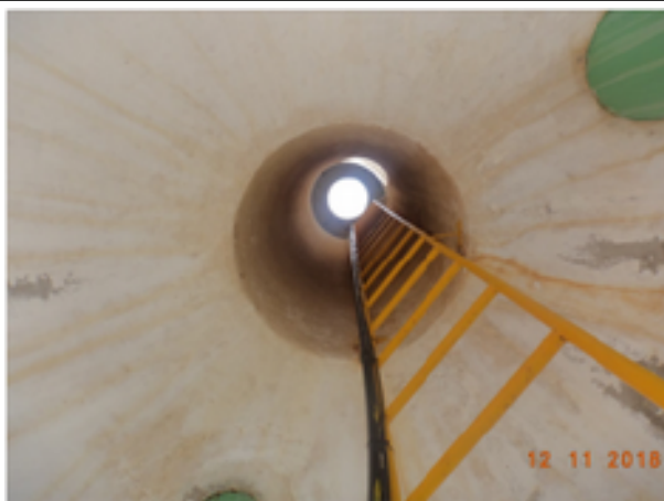
Foto 8 – Reservatório (Sede): REL-01 sem tampa na laje de cobertura.
