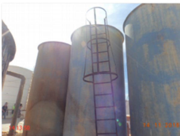
Foto 10 – ETA (Caponga): O Filtro F-03 não possui escada.
