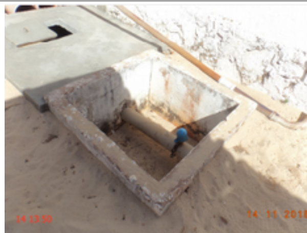
Foto 56 – Reservatório (Caponga): existe uma caixa de inspeção sem tampa ou grade de proteção no RAP-01
