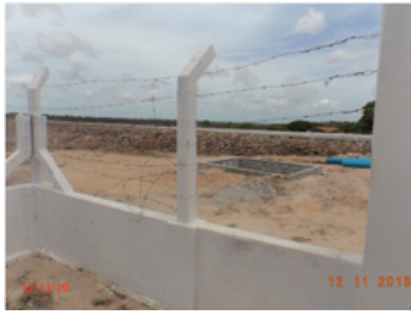
Foto 16 –Elevatória (Sede): EECS-01 está com a cerca danificada.
