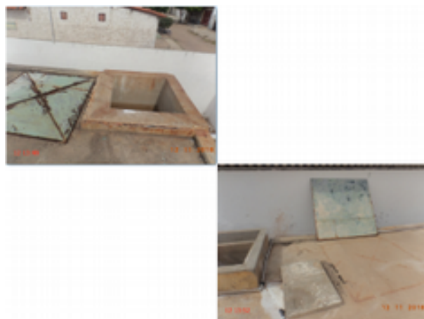
Foto 43 – Reservatório (Sede): no RAP-01 existe tampas abertas e em processo de corrosão.
