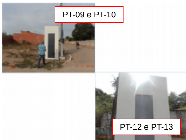
Foto 19 – Captação (Sede): Os poços PT-09, PT-10, PT-12 e PT-13 estão sem identificação.
