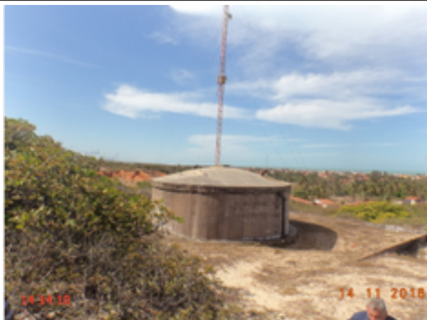
Foto 4 – Reservatório (Caponga): RAP-02 área sem grade de proteção.
