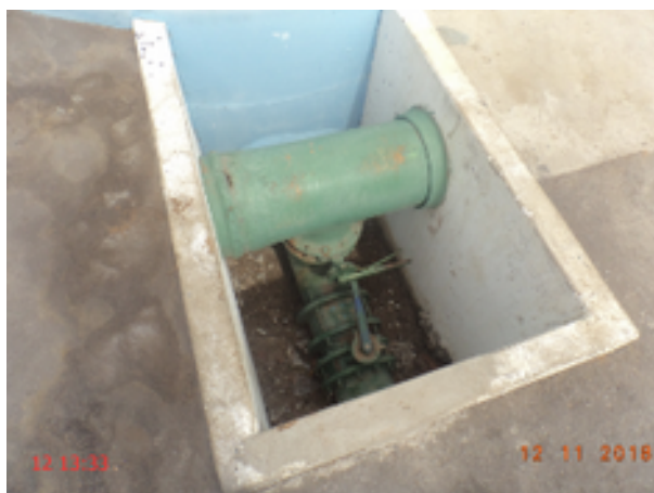
Foto 49 – ETA (Sede): a caixa de inspeção do filtro F-02 não possui tampa ou grade de proteção.
