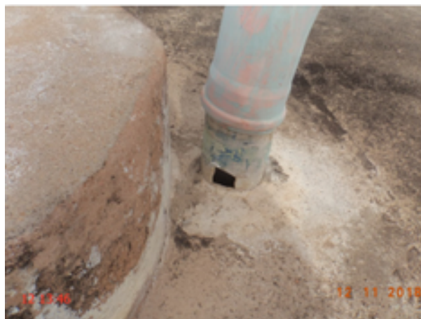
Foto 28 – Reservatório (Sede): no RAP-01 existe uma tubulação de ventilação danificada.
