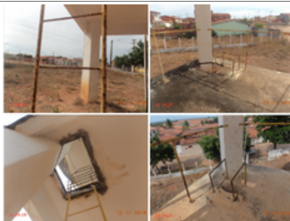
Foto 26 – Reservatório (Sede): o REL-02 está com as escadas e guarda-corpos em processo de corrosão.
