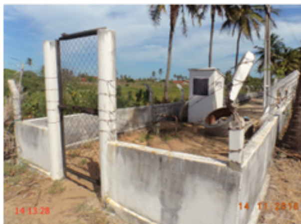
Foto 21 – Captação (Caponga): o poço PT-02 está com o muro, cerca e portão danificados.
