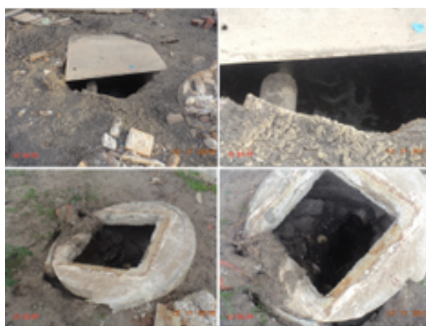
Foto 22 – ETE (Sede): os Pv's dos extravasores danificados.
