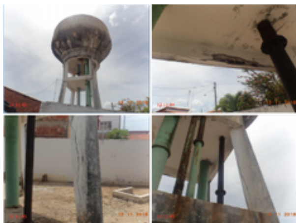
Foto 29 – Reservatório (Sede): o REL-01 está com a pintura deteriorada, armadura exposta, rachaduras e tubulação em processo de corrosão.
