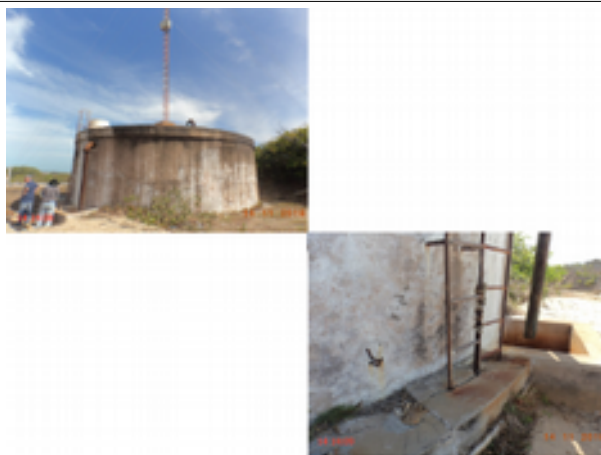
Foto 32 – Reservatório (Caponga): o RAP-02 está sem identificação, com a pintura e estrutura da base deterioradas.
