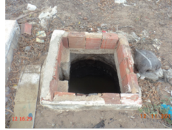
Foto 14 – ETE (Sede): poço de visita sem tampa.
