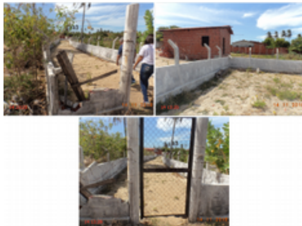
Foto 20 – Captação (Caponga): o poço PT-01 está com o muro, cerca e portão danificados.
