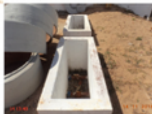
Foto 34 – Adução (Caponga): na AAB existem caixas sem tampas ou grades de proteção.
