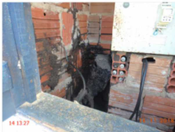
Foto 35 – Captação (Caponga): no PT-02 existe a presença de cupins.
