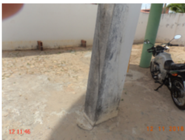
Foto 13 – Reservatório (Sede); REL-01 o para-raios não possui isolamento na parte inferior.
