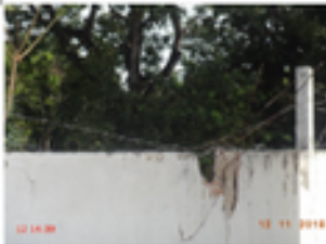
Foto 45 – Elevatória (Sede): a EERD-01 está com a cerca e muro danificados.
