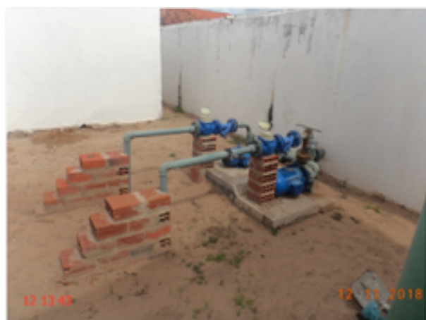
Foto 25 – Elevatória (Sede): EEAT-03 não possui identificação e nem casa de abrigo.
