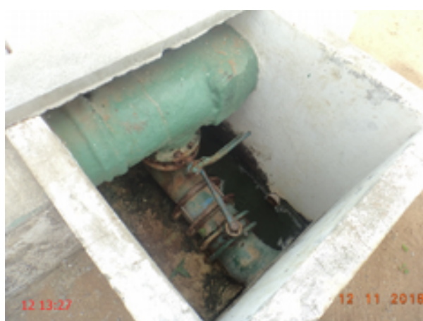
Foto 52 – ETA (Sede): a caixa de inspeção do filtro F-06 não possui tampa ou grade de proteção.
