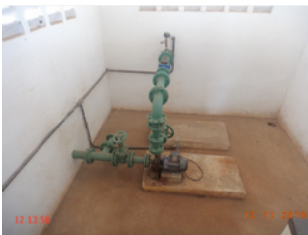
Foto 23 – Elevatória (Sede): EEAT-02 sem identificação e sem de bomba reserva.
