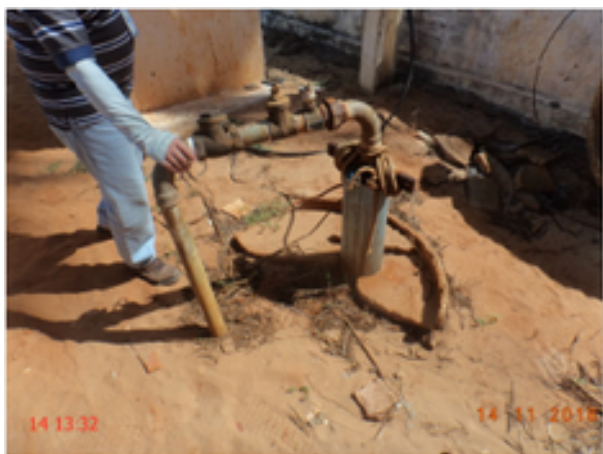
Foto 47 - Captação (Caponga) o PT-04 está com a laje de proteção danificada.
