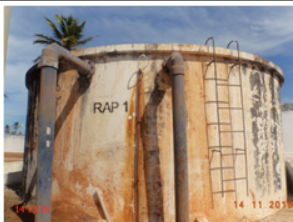
Foto 31 – Reservatório (Caponga): o RAP-01 está com a pintura deteriorada.
