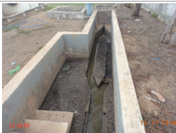
Foto 12 – ETE (Sede): caixa de areia necessita de limpeza.
