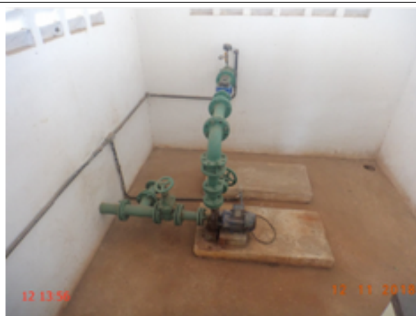
Foto 57 – Elevatória (Sede): EEAT-02 ausência de bomba reserva.
