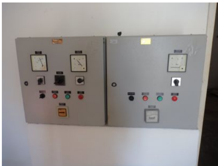
Foto 2 – EEAT-02: quadro de comando com voltímetro.
