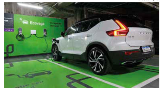
Os equipamentos serão instalados até março
