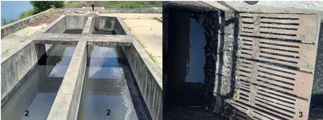
Figura 70 – Unidade de tratamento preliminar: gradeamento, caixa de areia e Calha Parshall.
