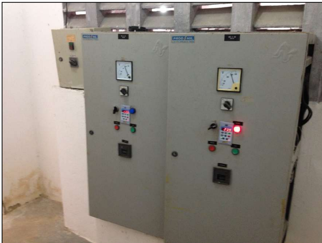
Figura 54 – Quadro de comando EEAT-01.
