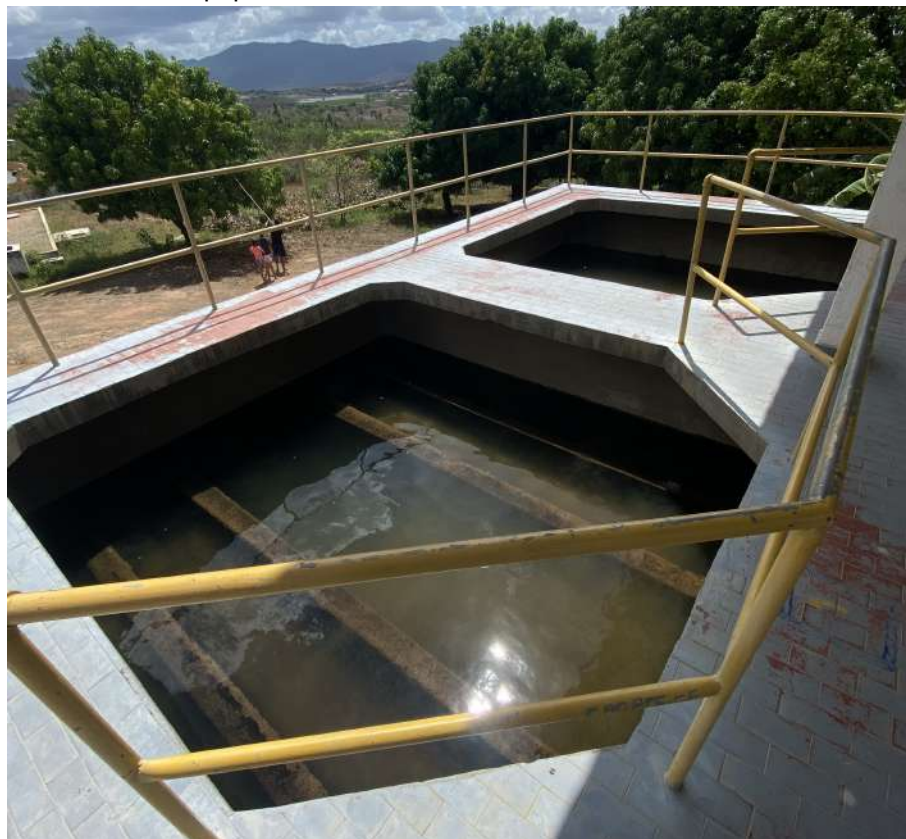
Figura 37 – Filtros da ETA Sapupara.
