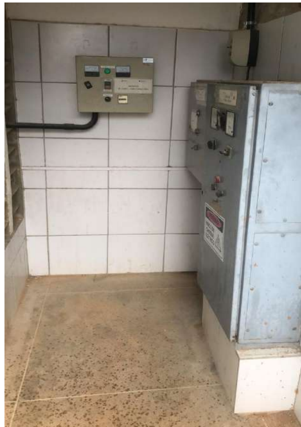
Figura 31 – Quadro Elétrico-EERD-03 (Booster) da ETA Maranguape.
