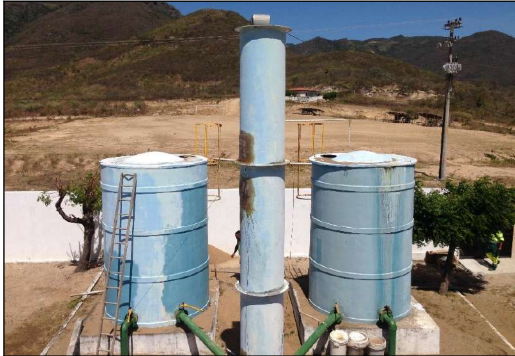
Figura 48 – Torre de Equilíbrio da ETA Itapebussu.
