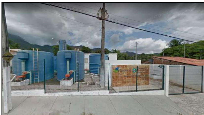
Figura 18 – Vista da ETA do SAA Maranguape.
