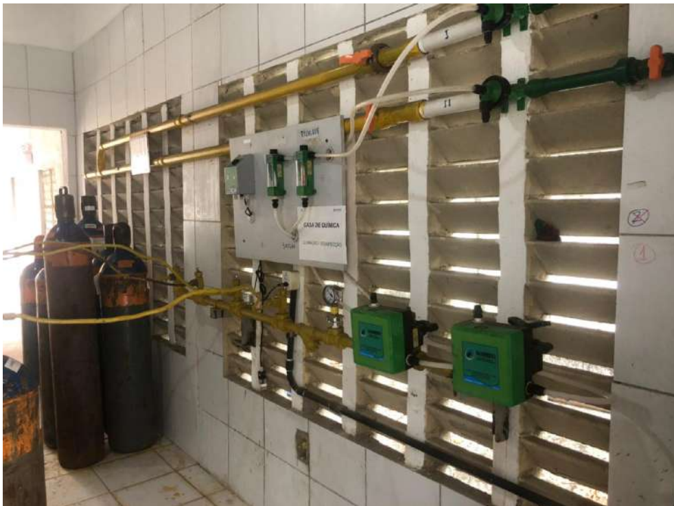
Figura 24 – Casa de Química da ETA Maranguape.
