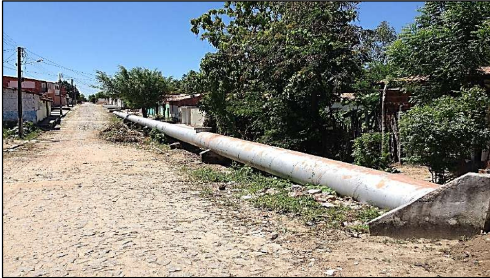
Figura 16 – Adutora de Água Bruta, DN 800.
