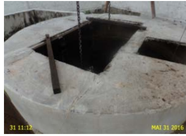
ETE: Poço de Sucção
