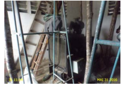
ETE: Gerador de Energia
