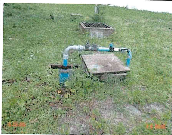
Foto 5 – PT-06: sem identificação e laje de proteção.
