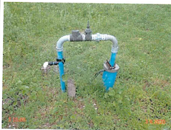
Foto 7 – PT-08: sem identificação e laje de proteção.
