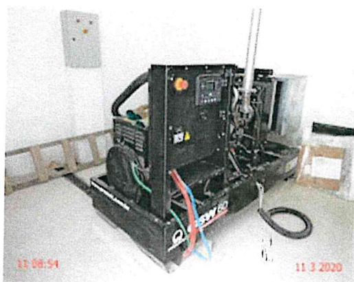
Foto 24 - EEE-02: grupo gerador de energia elétrica com defeito
