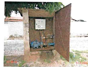
Foto 37 - EERD-01: sem identificação.
