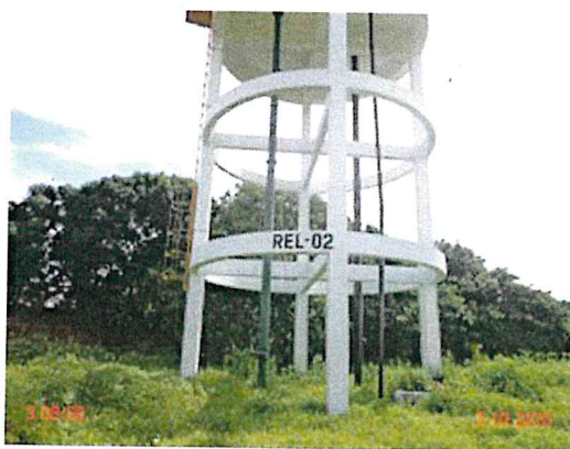
Foto 36 – REL-02: área com vegetação em excesso.
