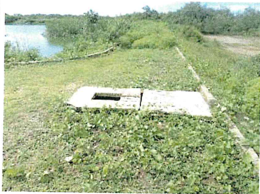
Foto 16 – ETE: A caixa divisora de vazão do SES entre as lagoas está assoreada.
