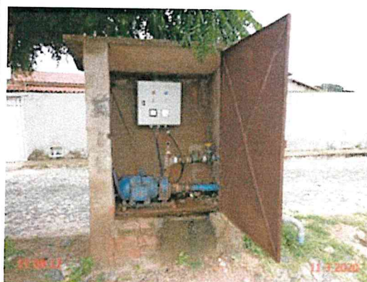
Foto 25 - EERD-01: sem identificação e pintura da casa de abrigo deteriorada
