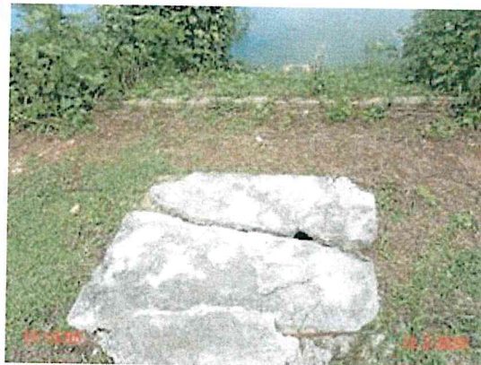
Foto 13 - ETE: saída da LF-02 obstruída.
