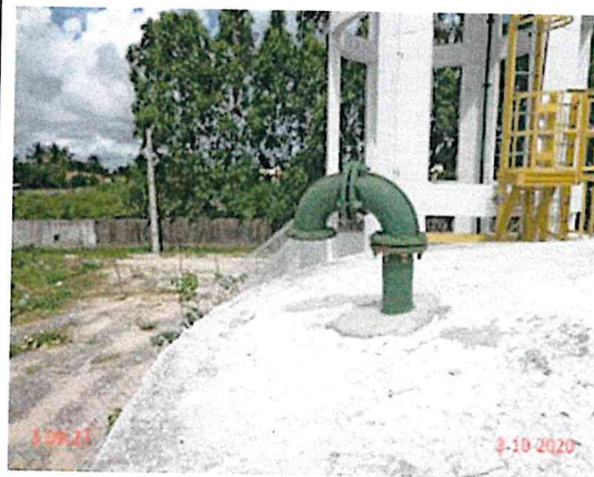
Foto 31 - RAP-03: ausência de tela de proteção na tubulação de ventilação.
