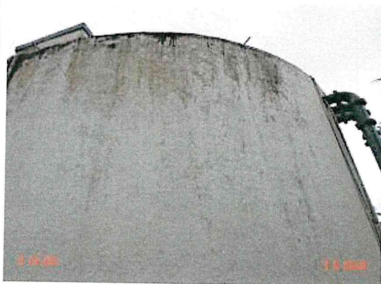
Foto 18 – RAP-02: pintura deteriorada.
