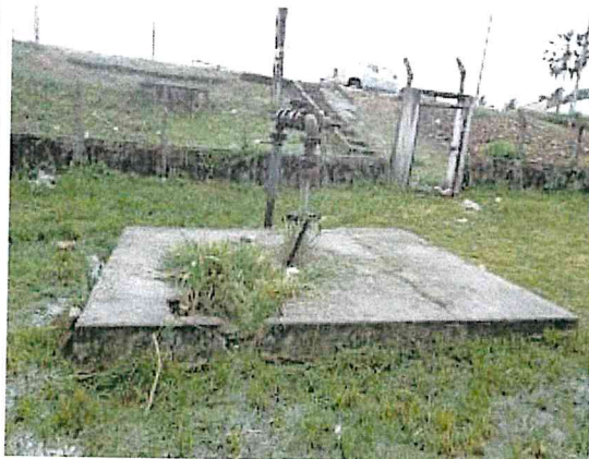
Foto 20 - PT-02: laje de proteção deteriorada.
