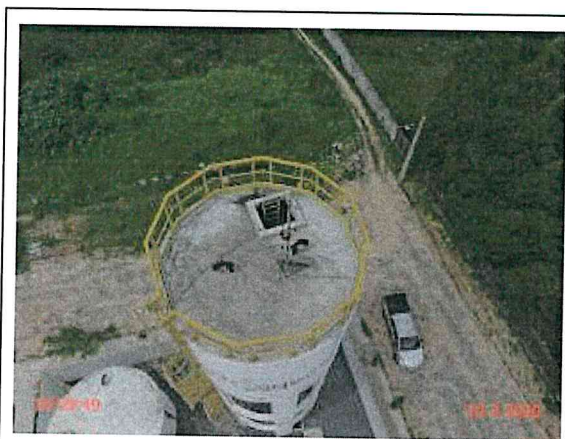
Foto 1 – REL-03: ausência de tampa na abertura de inspeção.
