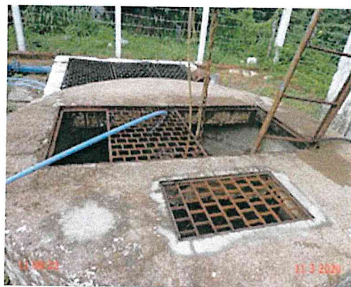
Foto 23 - EEE-01: grade de proteção não cobre toda a abertura de inspeção do poço de sucção
