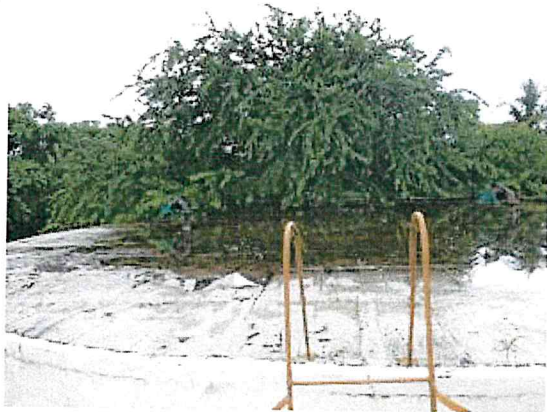
Foto 34 – RAP-02: escada de acesso em processo de corrosão.
