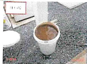
Foto 4 – EEE-01 e EEE-02: ausência de leito de secagem.
