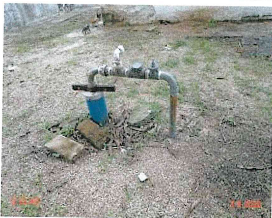
Foto 6 – PT-07: sem identificação e laje de proteção.
