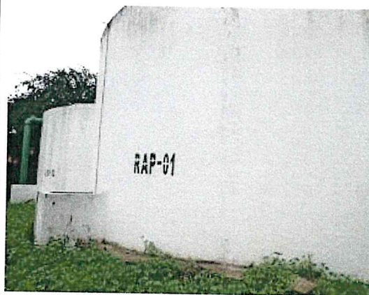
Foto 17 – RAP-01: pintura deteriorada.
