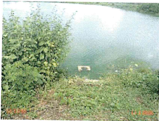
Foto 12 - ETE: saída da LF-02 obstruída.
