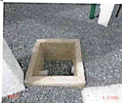
Foto 32 – RAP-03: caixas de inspeção sem tampa.
