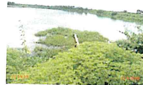
Foto 29 - ETE: entrada da LF-01 assoreada e obstruída.
