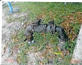
Foto 4 – PT-01: sem identificação e laje de proteção.
