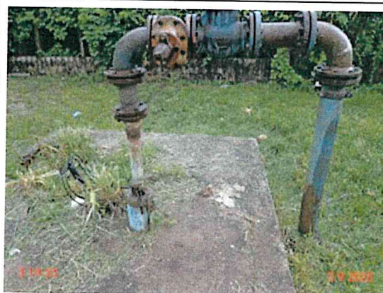
Foto 39 – PT-02: sem identificação.
