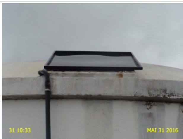
Foto 05 - RAP-09: tampa de inspeção sem vedação.
