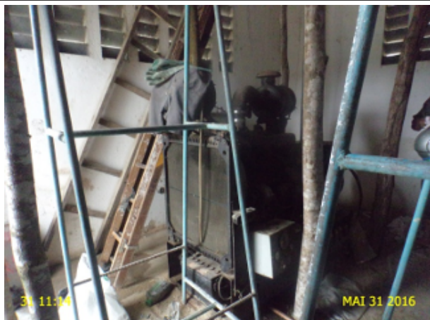
Foto 09 – EEE 01: grupo gerador de energia elétrica com defeito.
