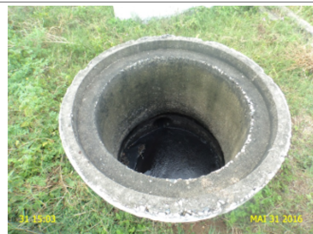
Foto 12 - ETE: poço de visita sem tampa.
