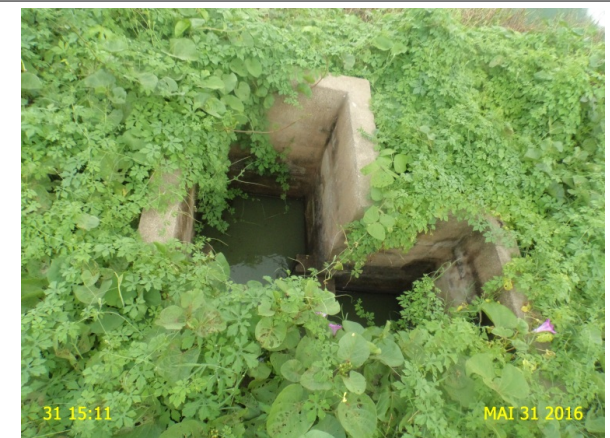
Foto 14 - ETE: vegetação excessiva e acúmulo de sobrenadantes na Lagoa Facultativa.
