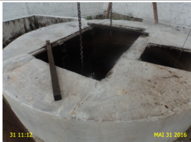
Foto 10 - EEE: poço de sucção sem tampa.
