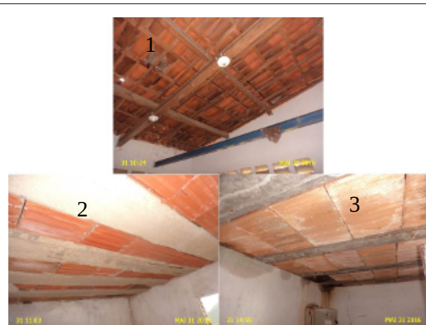
Foto 08 - EAT-05 (1), Booster São Francisco (2) e Booster Tamanduá (3) sem iluminação.
