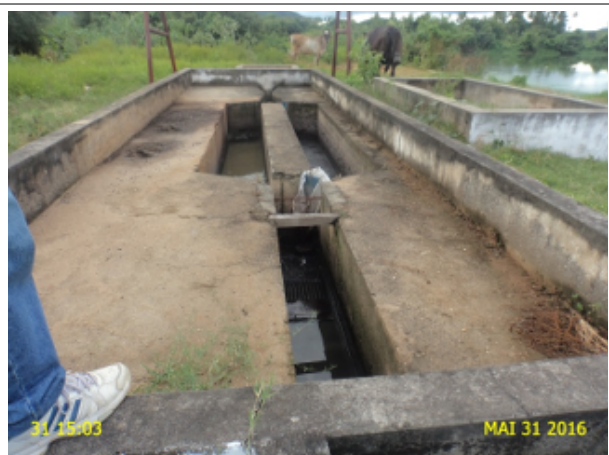
Foto 11 - ETE: gradeamento com defeito.
