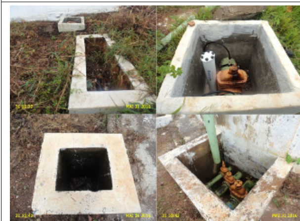
Foto 19 - Caixas de inspeção sem tampas ou grades de proteção nos reservatórios RAP-09 (1) e RAP-10 (2).
