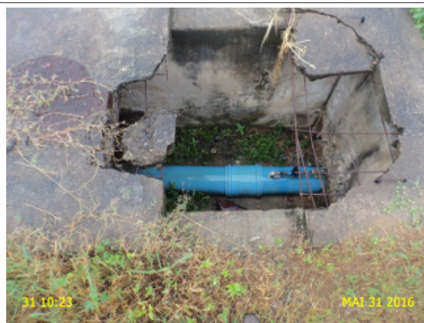
Foto 06 - AAT: caixa do medidor proporcional danificada.
