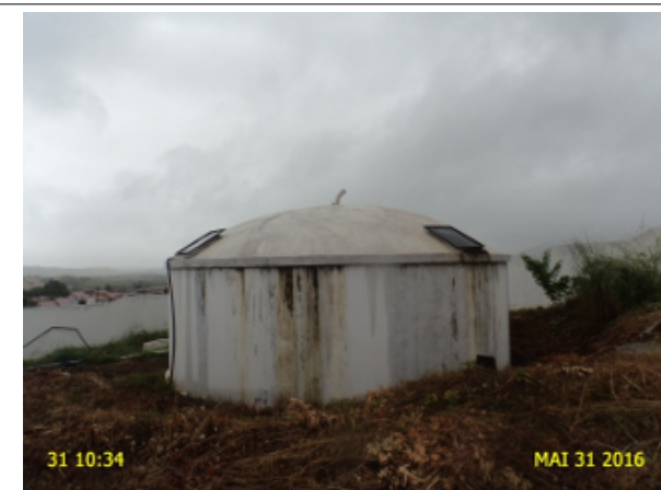
Foto 20 - RAP-09: pintura deteriorada, sem identificação e sem escada de acesso.
