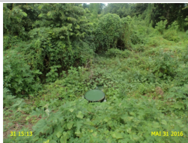
Foto 04 - ETE: PV sem tampa e extravasando no local de descarga do efluente.
