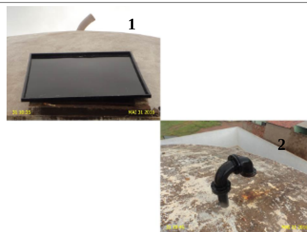
Foto 18 - Tubulação de ventilação sem tela de proteção nos reservatórios RAP-09 e RAP-10.
