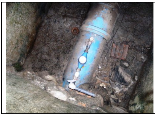
Foto 25 – Medidor proporcional na chegada ao RAP-01.
