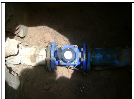
Foto 26 – Macromedidor na chegada do REL-02
