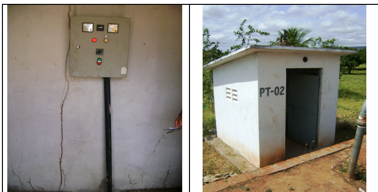
Fotos 17 e 18 – EEAB – 01: Quadro de Comando e casa de proteção
