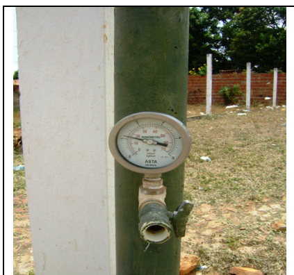
Foto 25 – Medição de nível do REL-01
