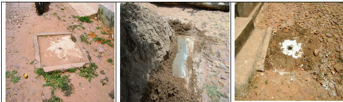
Fotos 28, 29 e 30 – Registros de descarga nas Ruas Clóvis Leite Martins, São Francisco e Av. Pe. Ibiapina
