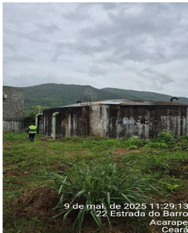
Foto 14 - RAP-10: Pintura deteriorada e excesso de vegetação no entorno.
