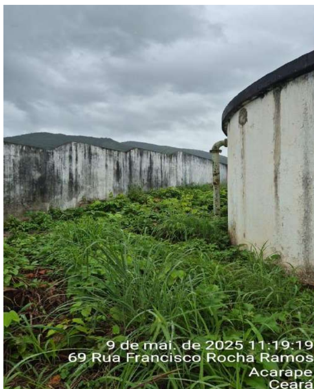
Foto 9 - RAP-09: Excesso de vegetação no entorno.
