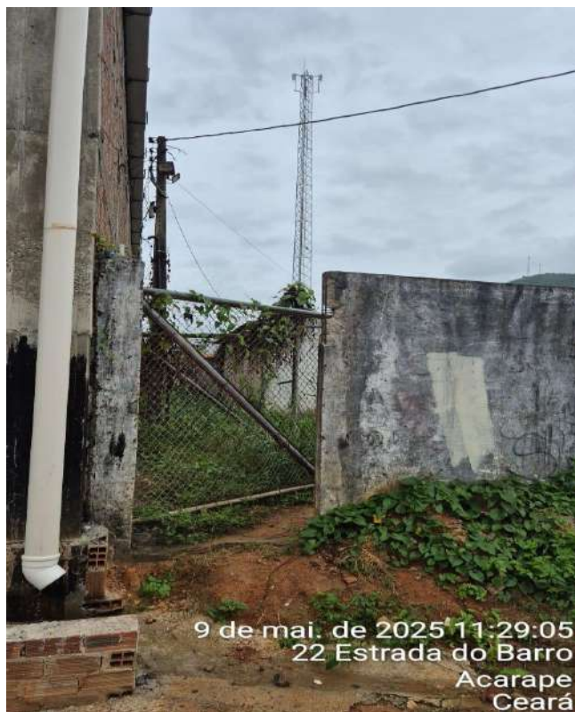
Foto 13 - RAP-10: Portão de acesso inadequado; pintura deteriorada e ausência de identificação.
