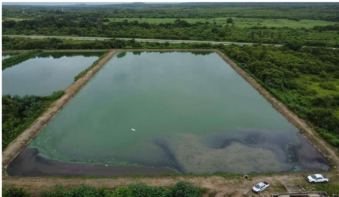
Foto 45 - ETE Acarape: Presença de zonas mortas.
