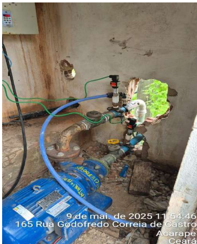
Foto 31 - Booster Tamanduá: Perfurações inadequadas nas paredes e presença de entulho/restos de materiais.
