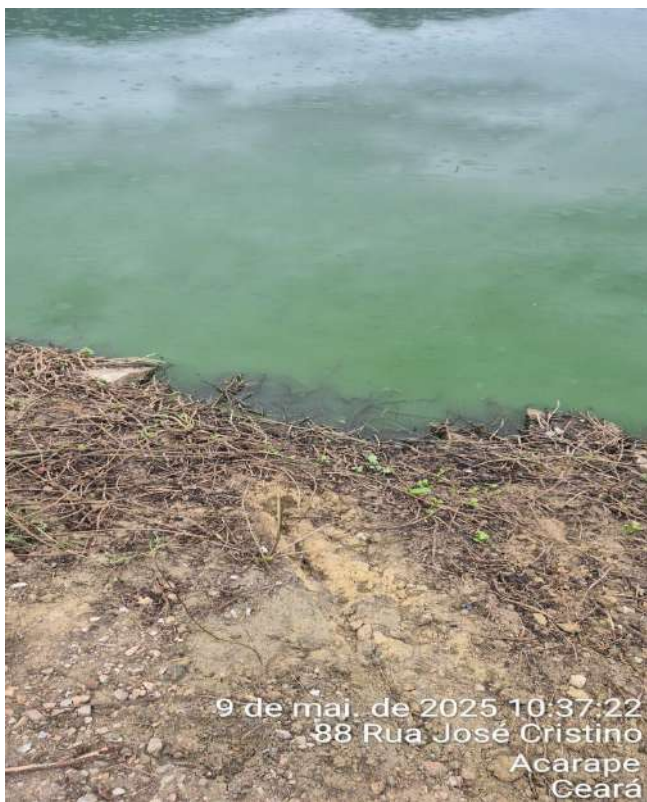
Foto 41 - ETE Acarape: Zonas mortas e ausência de placas de concreto.
