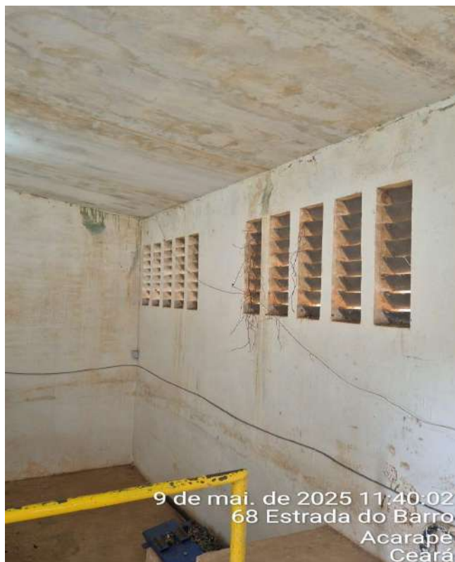
Foto 23 - EEAT-04: Pintura deteriorada; presença de vegetação das paredes; e fiação sem eletroduto de proteção e isolamento.
