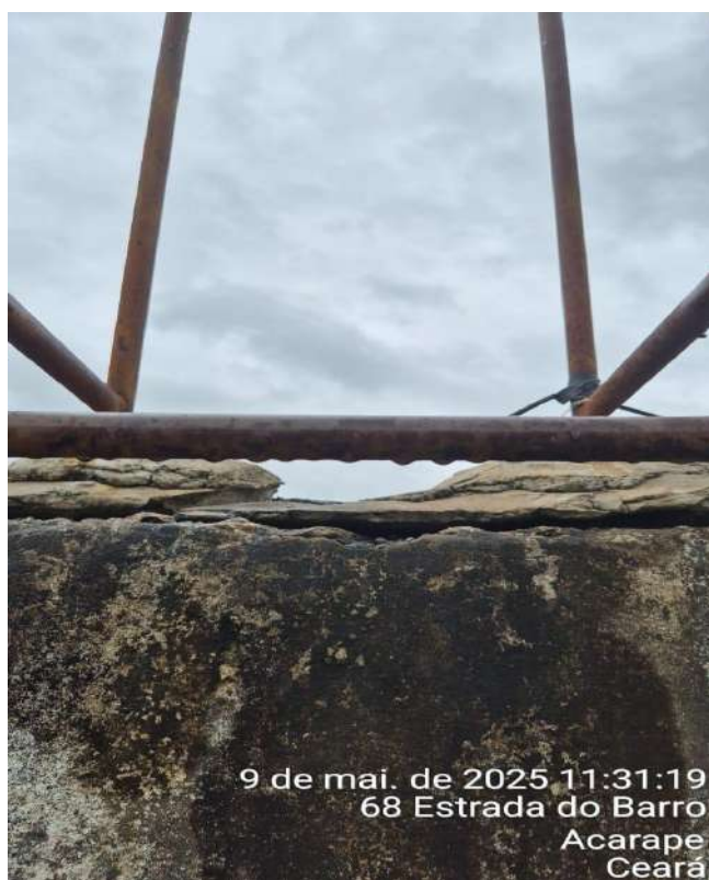
Foto 17 - RAP-10: Escada oxidada e sem fixação adequada.
