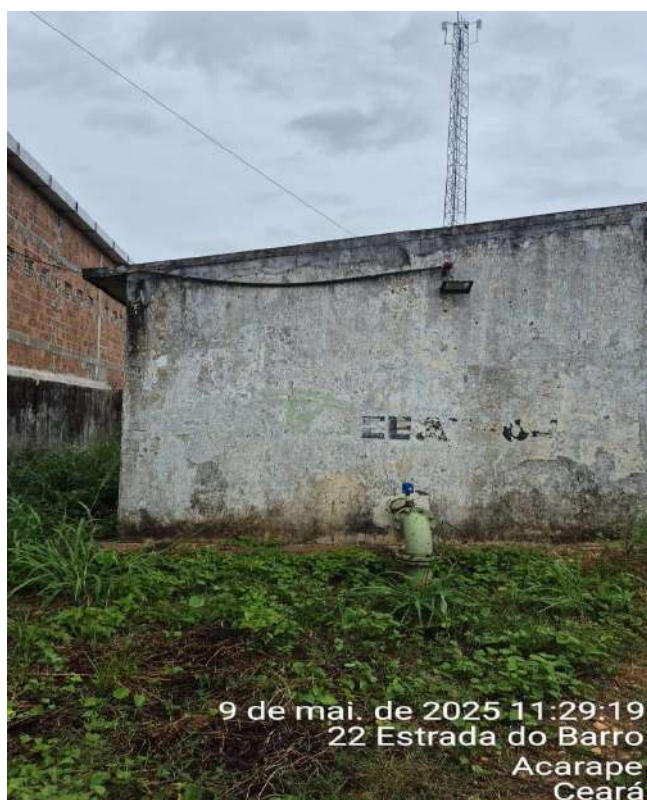
Foto 21 - EEAT-04: Pintura deteriorada.
