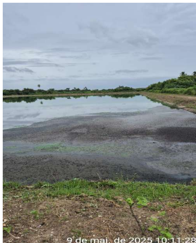
Foto 38 - ETE Acarape: Zonas mortas e ausência de placas de concreto.
