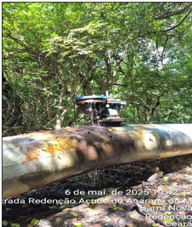
Foto 46 - Captação: vazamento na ventosa.
