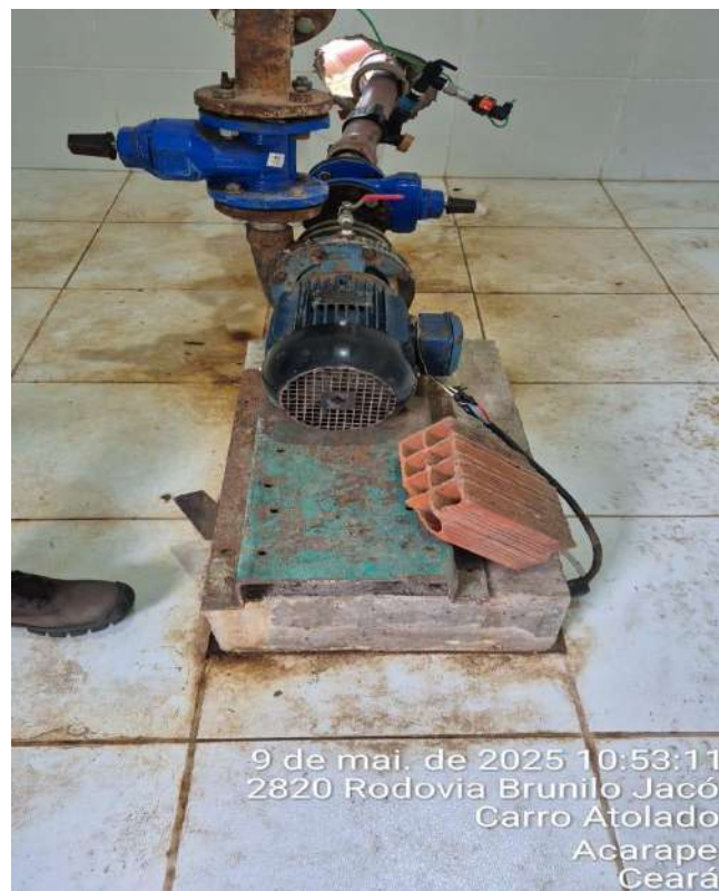
Foto 4 - EERD-04 (Booster): Base da bomba inadequada.
