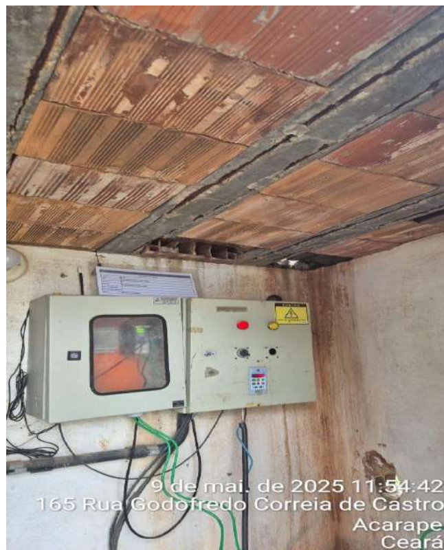
Foto 28 - Booster Tamanduá: Teto sem recobrimento, com tijolos expostos; fiação inadequada.
