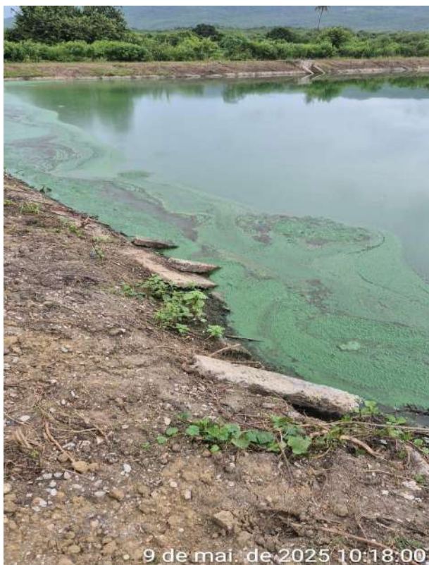
Foto 39 - ETE Acarape: Zonas mortas e ausência de placas de concreto.
