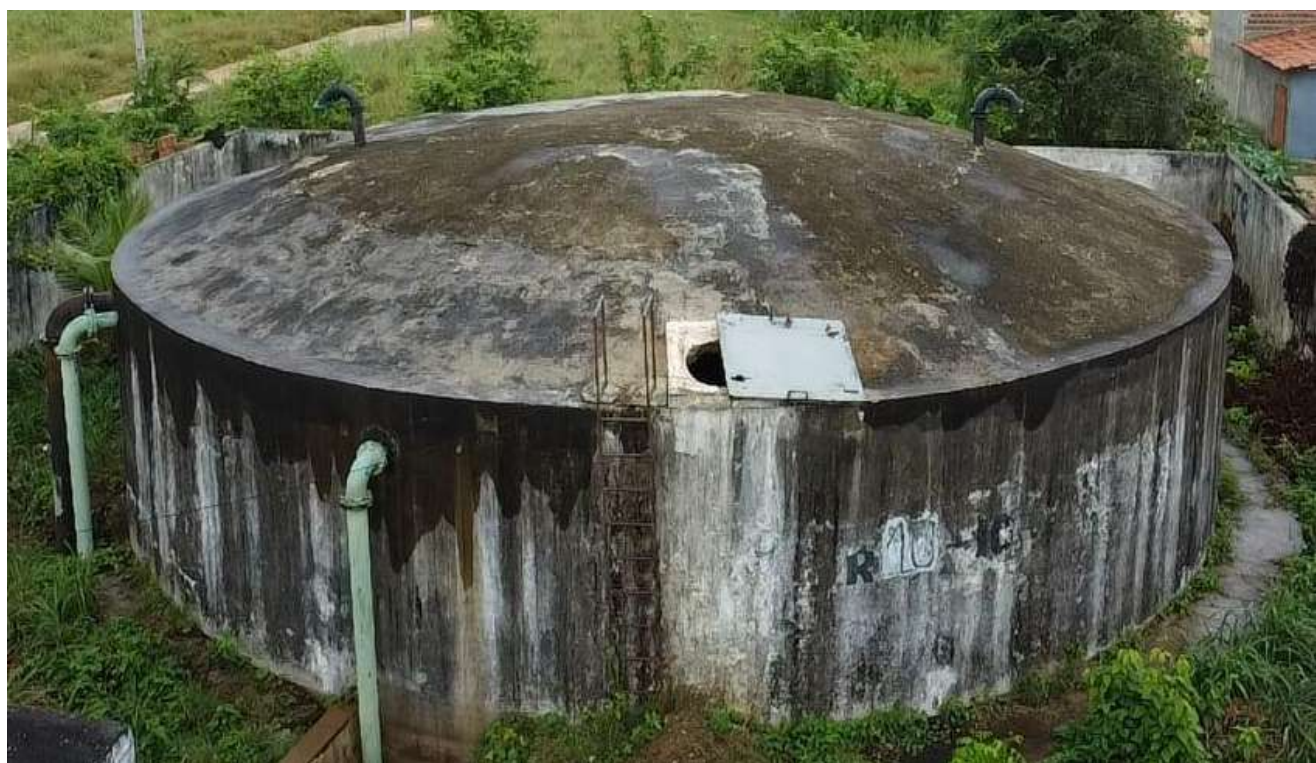
Foto 19 - RAP-10: Tampa de inspeção deslocada.
