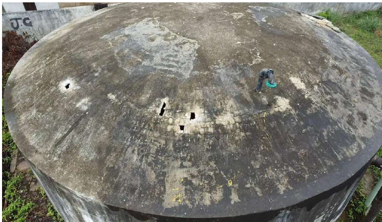
Foto 20 - RAP-10: Laje superior do reservatório com rachaduras e perfurações.
