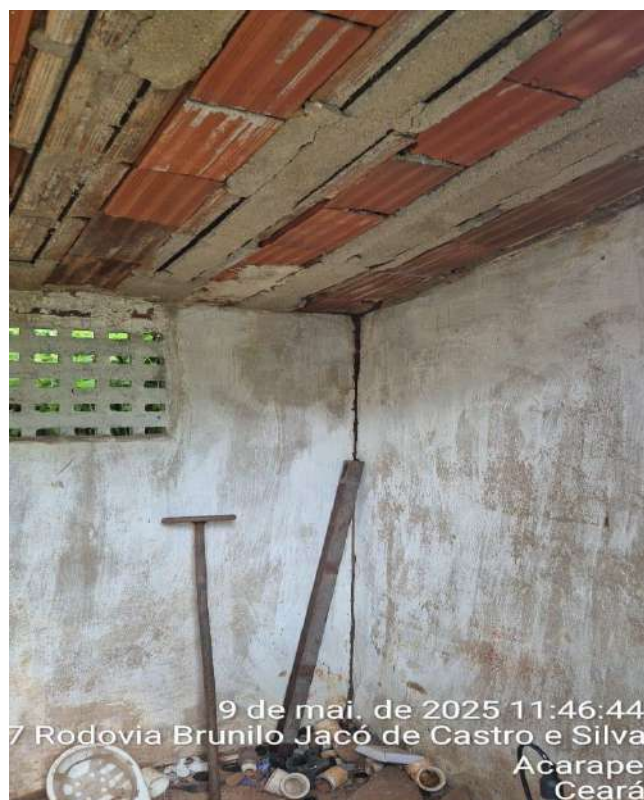
Foto 34 - Booster Riachão: Teto sem recobrimento, com tijolos expostos e presença de cupim nas paredes.
