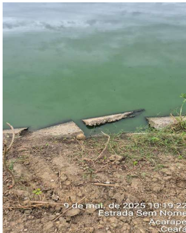
Foto 40 - ETE Acarape: Zonas mortas e ausência de placas de concreto.
