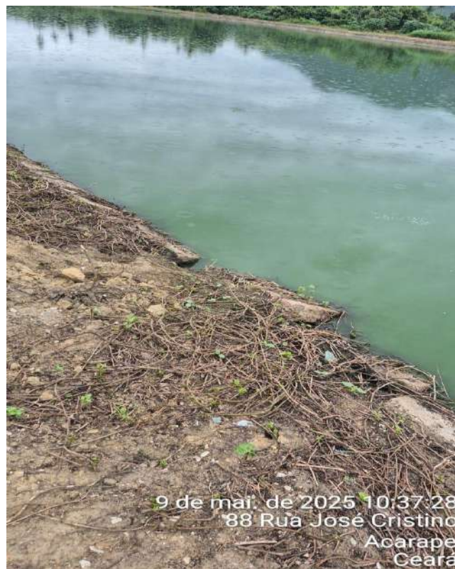
Foto 42 - ETE Acarape: Zonas mortas e ausência de placas de concreto.
