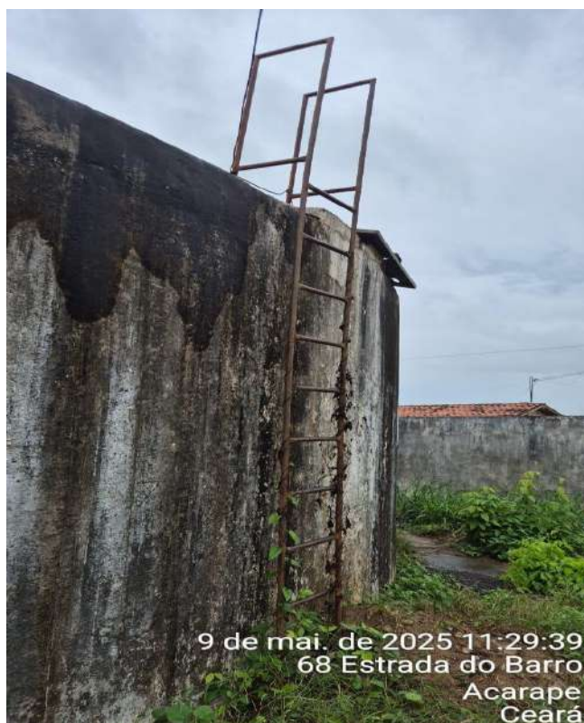
Foto 15 - RAP-10: Escada oxidada e sem fixação adequada.
