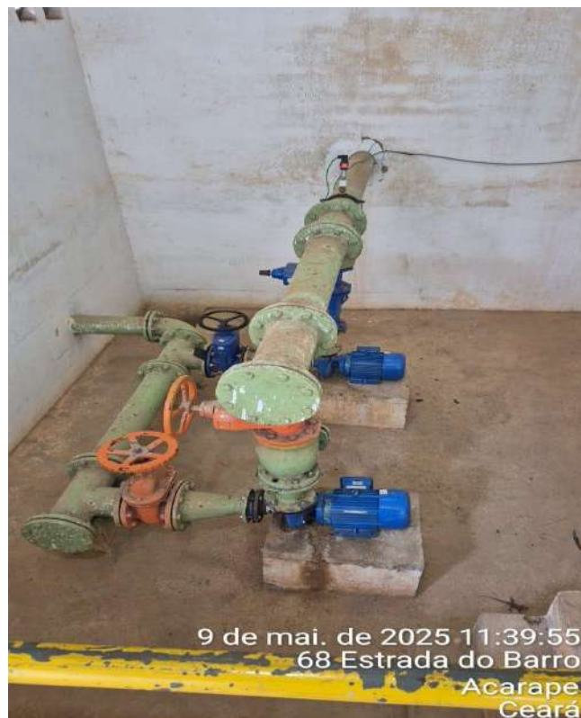
Foto 24 - EEAT-04: Fiação sem eletroduto de proteção e isolamento.
