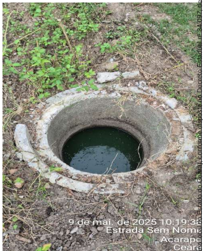
Foto 44 - ETE Acarape: Obstrução na entrada da lagoa.
