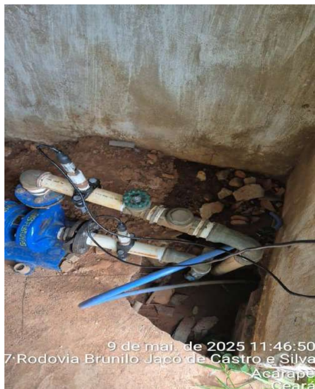
Foto 36 - Booster Riachão: Falha estrutural no piso e fiação inadequada.
