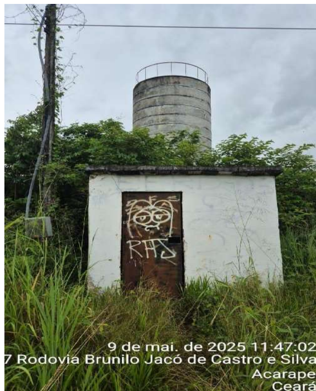
Foto 32 - Booster Riachão: Ausência de identificação; excesso de vegetação no entorno; e portão de acesso oxidado.
