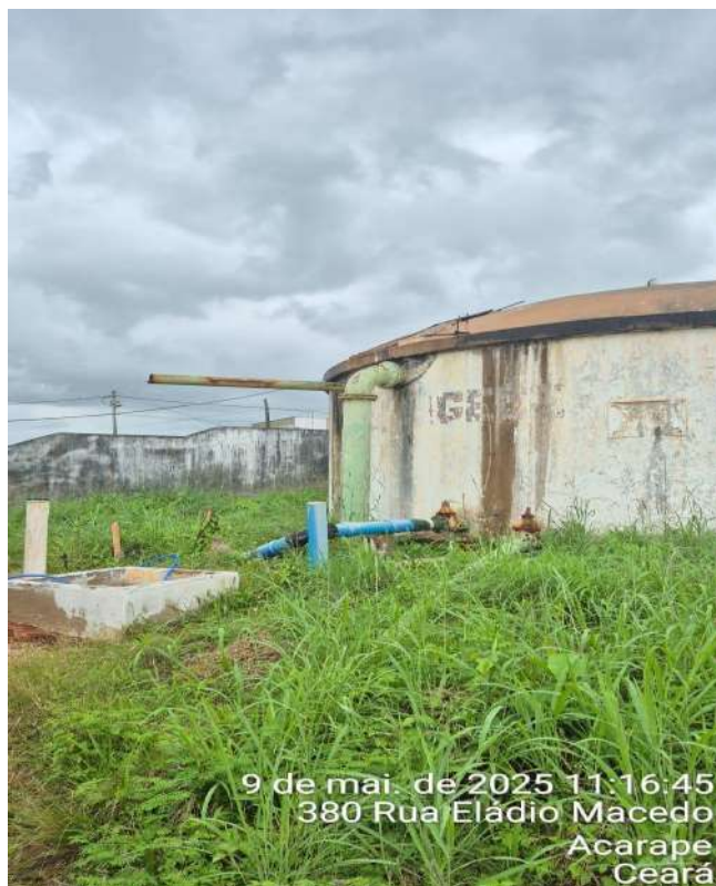
Foto 7 - RAP-09: Pintura deteriorada e excesso de vegetação.
