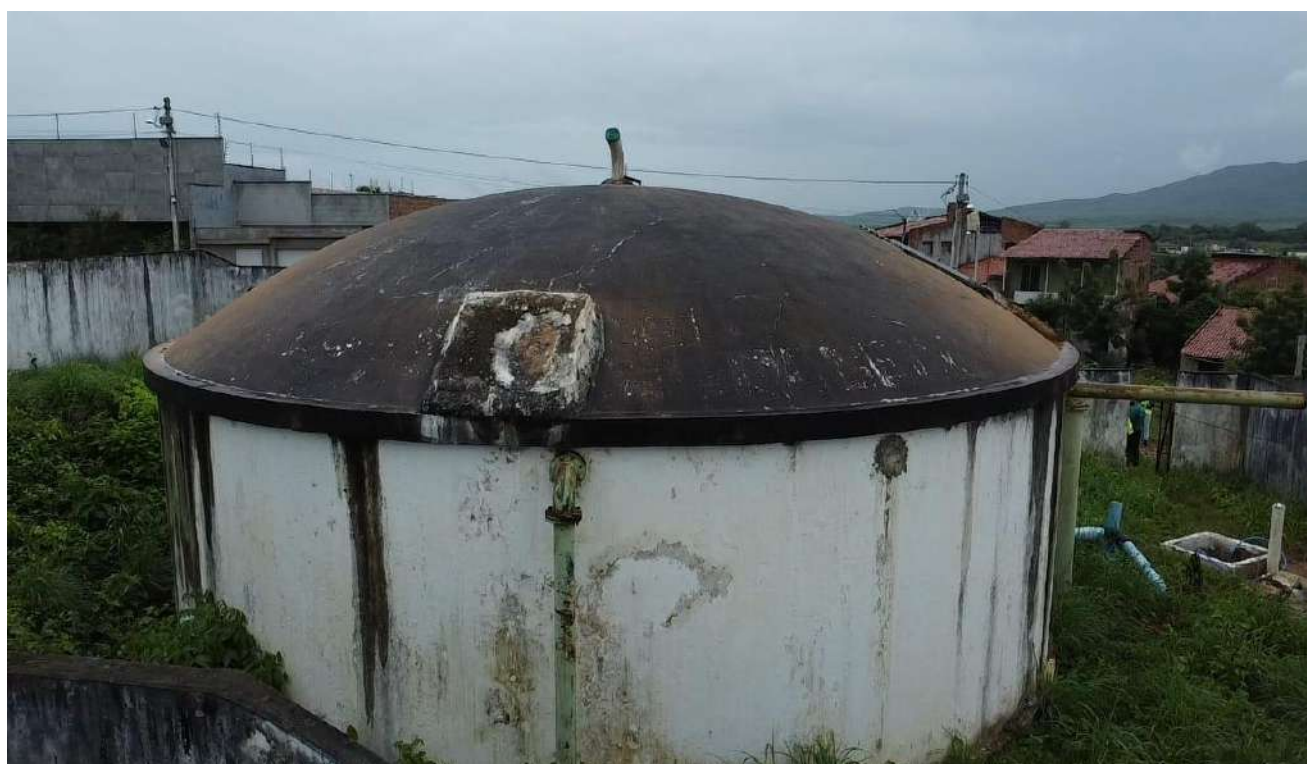
Foto 12 - RAP-09: Pintura deteriorada.
