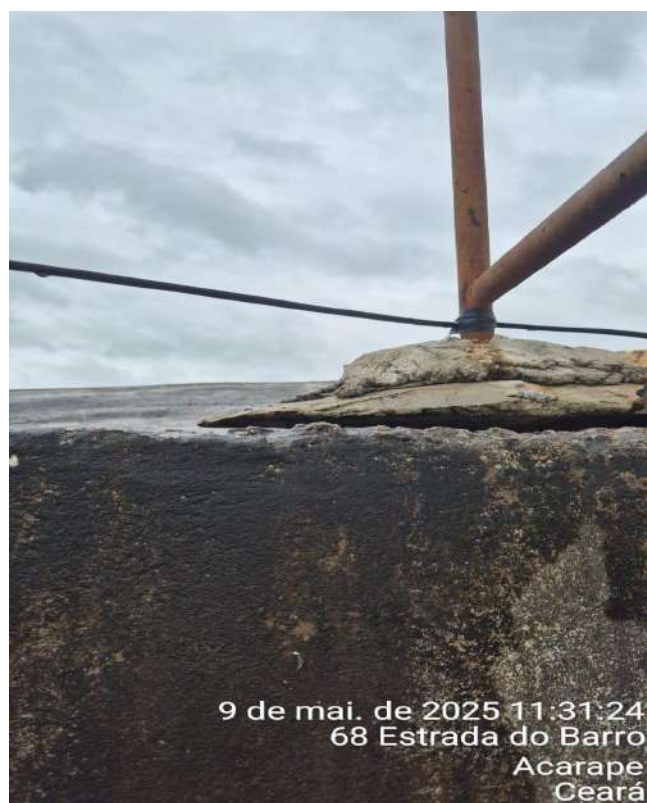
Foto 18 - RAP-10: Escada oxidada e sem fixação adequada.
