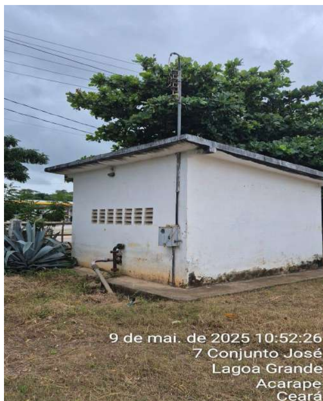
Foto 1 - EERD-04 (Booster): Ausência de identificação; pintura deteriorada.
