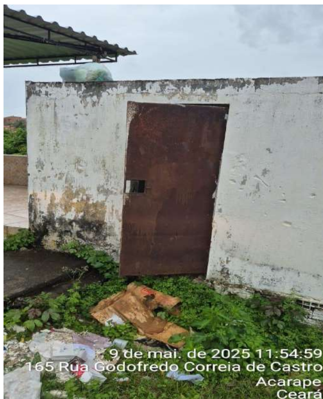
Foto 25 - Booster Tamanduá: Ausência de identificação; portão oxidado e danificado; presença de lixo no entorno.
