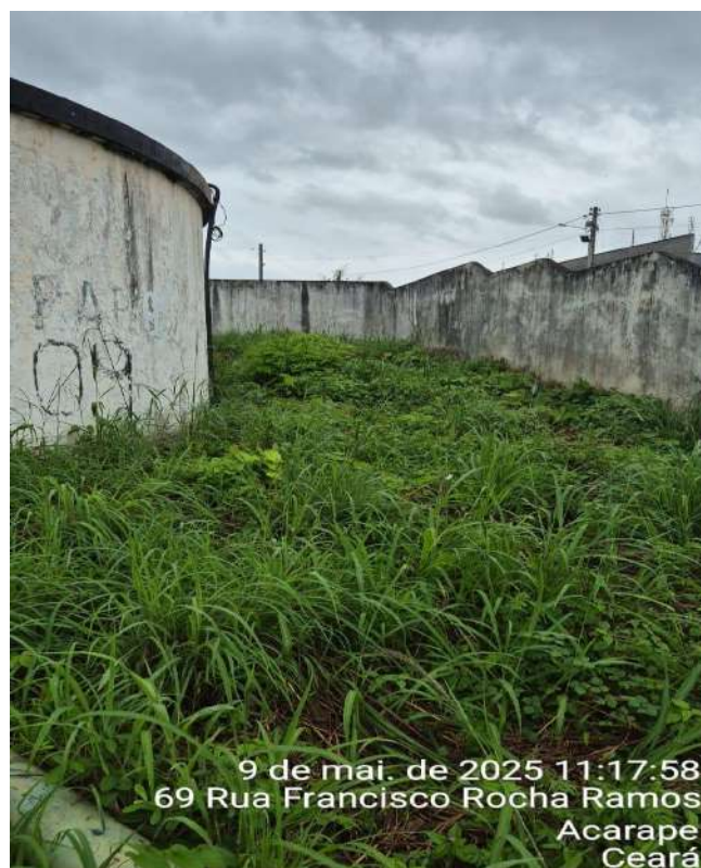
Foto 10 - RAP-09: Excesso de vegetação no entorno.
