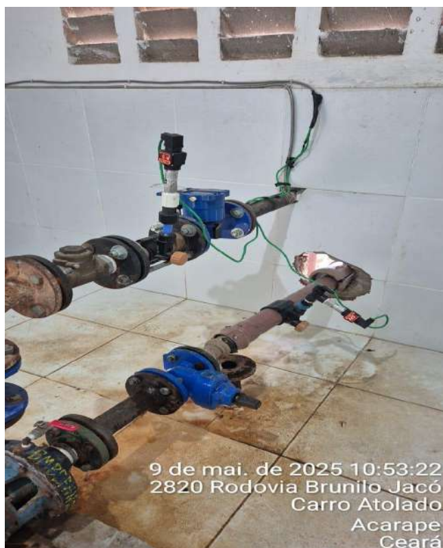
Foto 5 - EERD-04 (Booster): Perfuração inadequada na parede.
