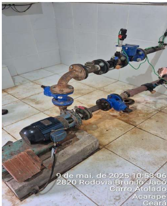
Foto 3 - EERD-04: Ausência de bomba reserva; base da bomba inadequada; equipamentos oxidados.
