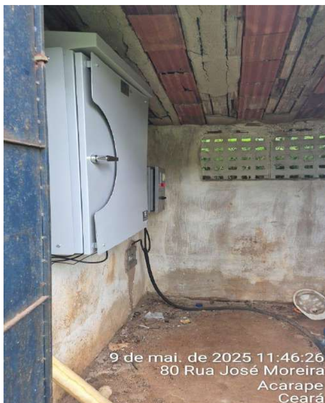
Foto 33 - Booster Riachão: Teto sem recobrimento, com tijolos expostos.
