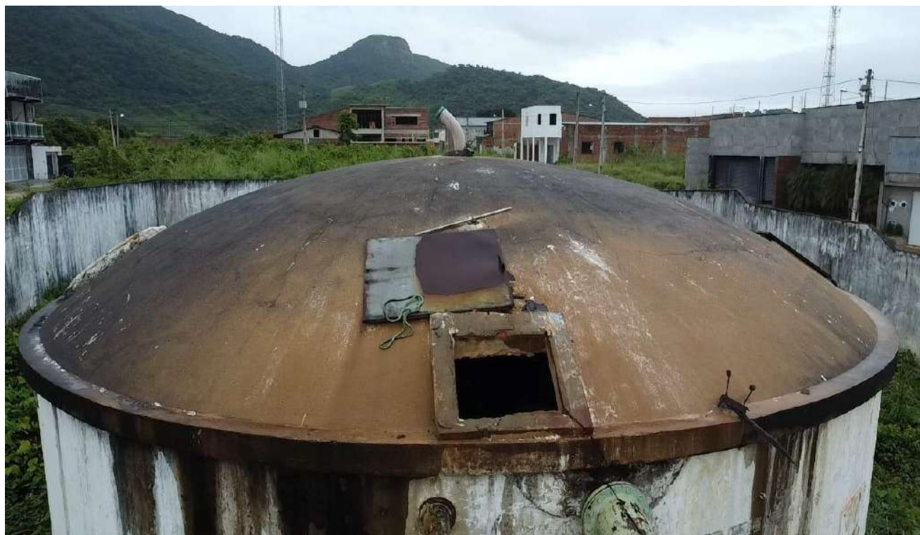
Foto 11 - RAP-09: Tampa de inspeção oxidada e deslocada; e pintura deteriorada.
