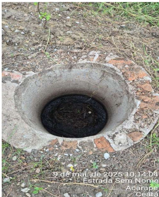
Foto 43 - ETE Acarape: Obstrução na entrada da lagoa.
