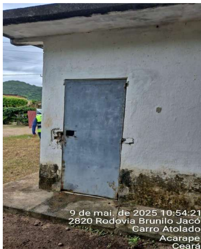
Foto 2 - EERD-04 (Booster): Pintura deteriorada; portão de acesso danificado.
