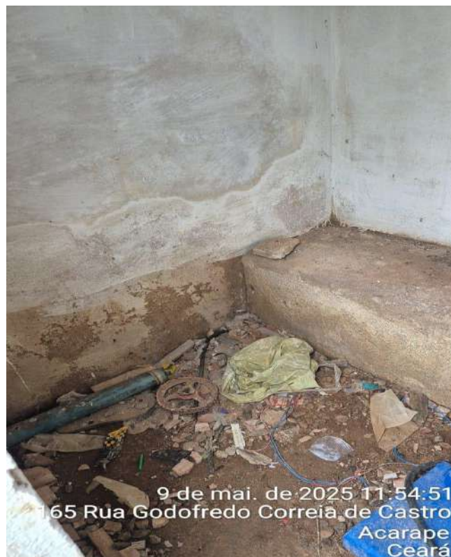
Foto 30 - Booster Tamanduá: Presença de entulho/resto de materiais.
