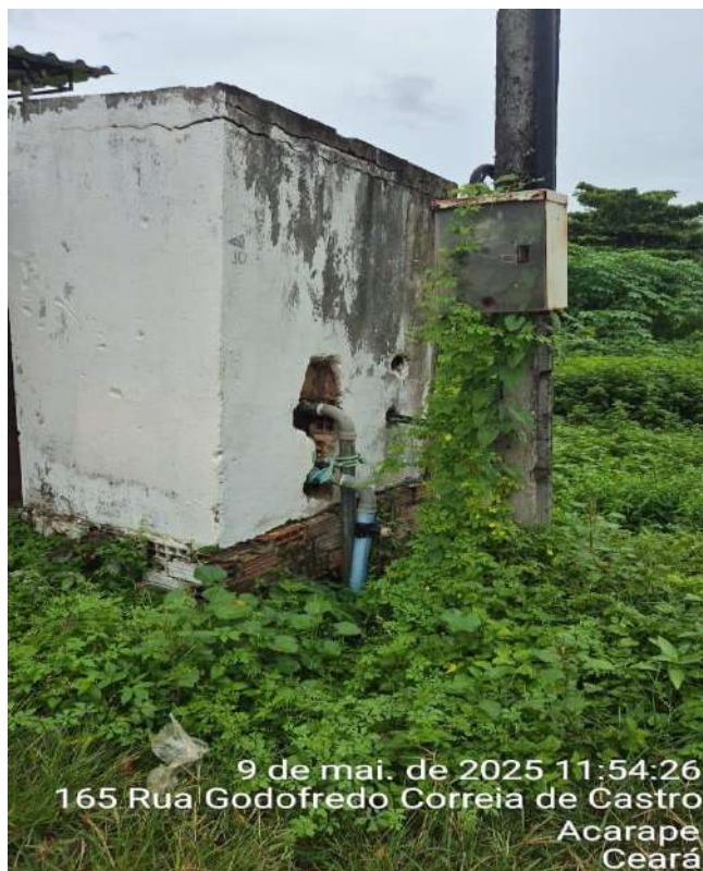
Foto 27 - Booster Tamanduá: Excesso de vegetação no entorno e estrutura apresenta rachaduras.
