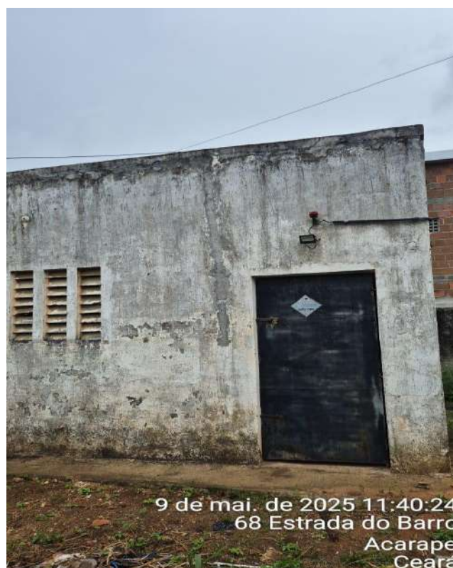
Foto 22 - EEAT-04: Pintura deteriorada.
