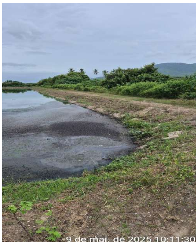
Foto 37 - ETE Acarape: Zonas mortas e ausência de placas de concreto.
