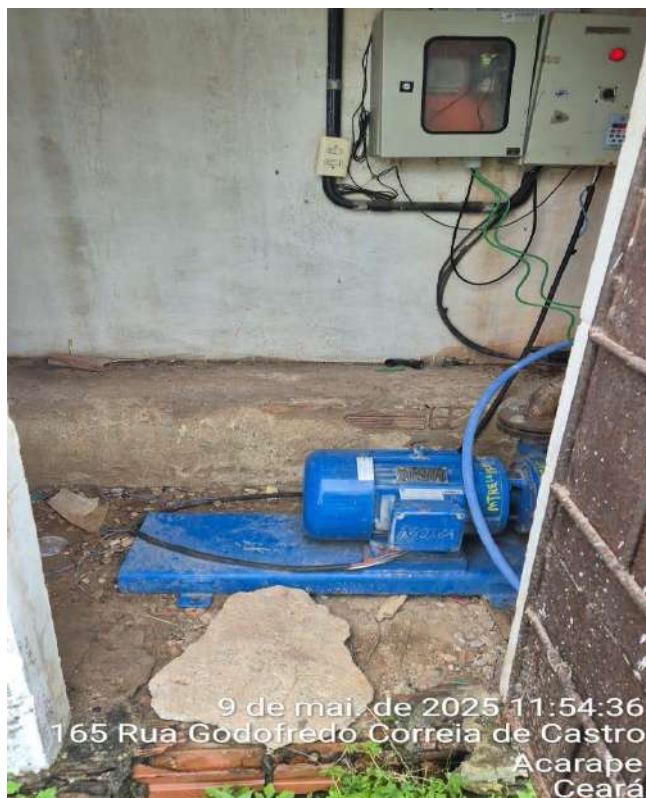
Foto 29 - Booster Tamanduá: Base da bomba inadequada.
