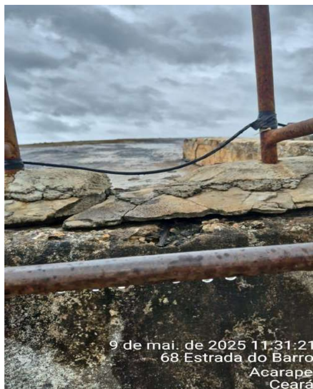
Foto 16 - RAP-10: Escada oxidada e sem fixação adequada.
