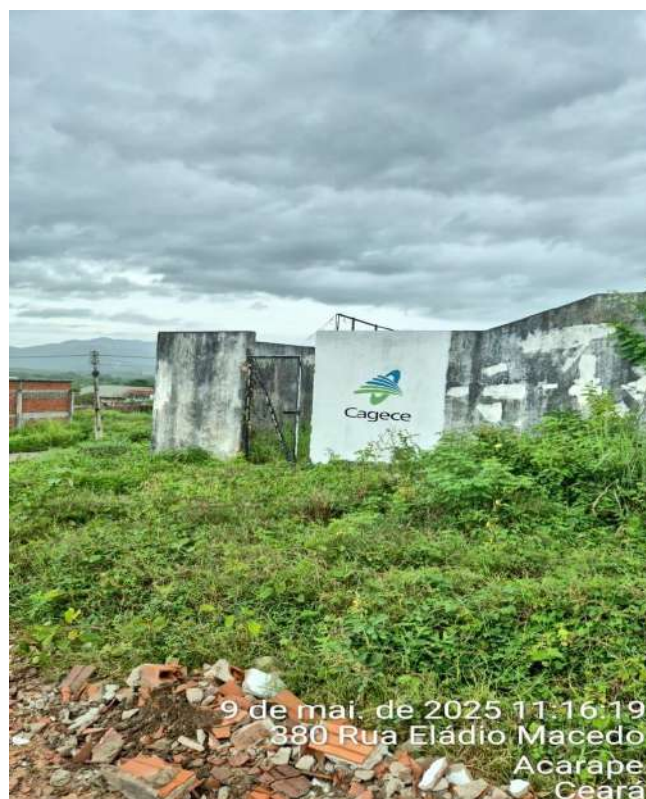
Foto 6 - RAP-09: Pintura deteriorada e excesso de vegetação no entorno.
