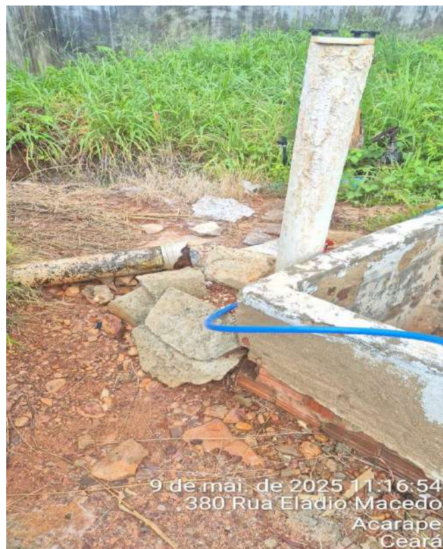
Foto 8 - RAP-09: Acúmulo de resto de material de construção/entulho.
