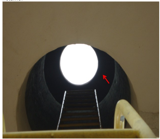
Foto 51 – REL-02: Orifício sem tampa de proteção.
