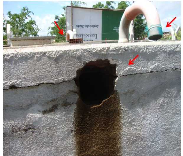
Foto 45 – RSE-03: Tubulação de ventilação adequada, porém com abertura na parede do reservatório.
