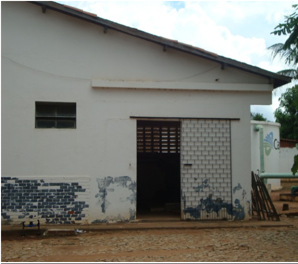
Foto 31 – Vista da EEAT-01/02 e EELF-01 sem identificação.
