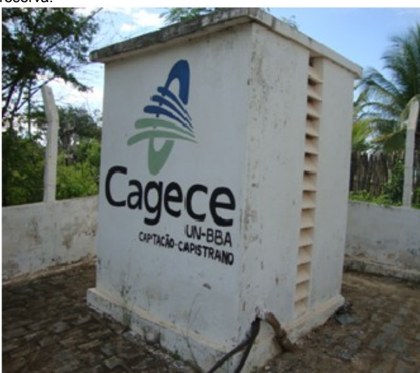
Foto 5 – Casa do quadro de comando da EECS-01.
