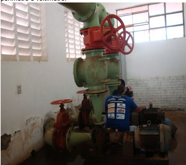
Foto 34 – Conjunto moto-bomba da EEAT-02 com bomba reserva.
