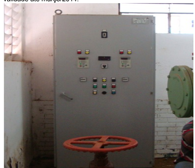
Foto 35 – Quadro de comando da EEAT-02.
