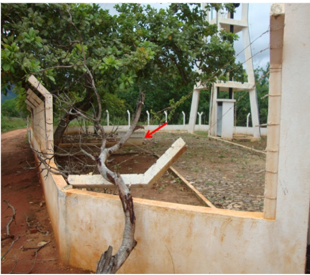
Foto 50 – REL-02: Com cerca danificada.
