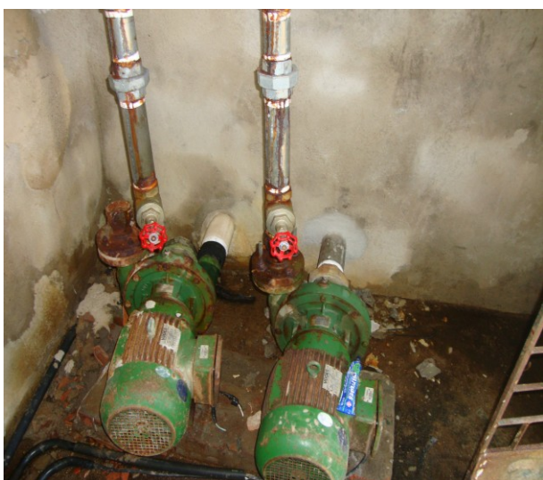
Foto 38 – Conjunto moto-bomba da EEAT-03 com bomba reserva.
