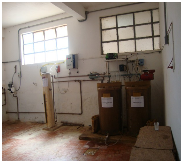
Foto 14 – Vista interna da casa de química apresentado bom estado de conservação, tanques de dosagens e sistema de fluoretação.
