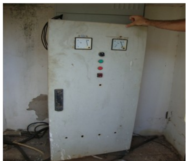
Foto 6 – Quadro de comando da EECS-01 sem horímetro instalado.
