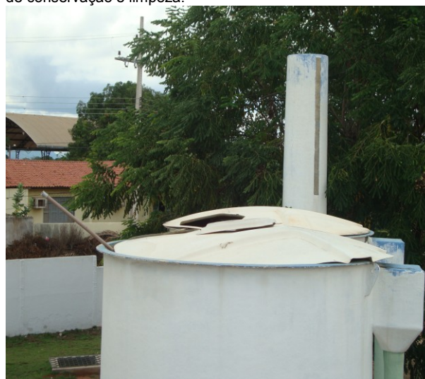
Foto 12 – ETA: Filtros sem tampa.
