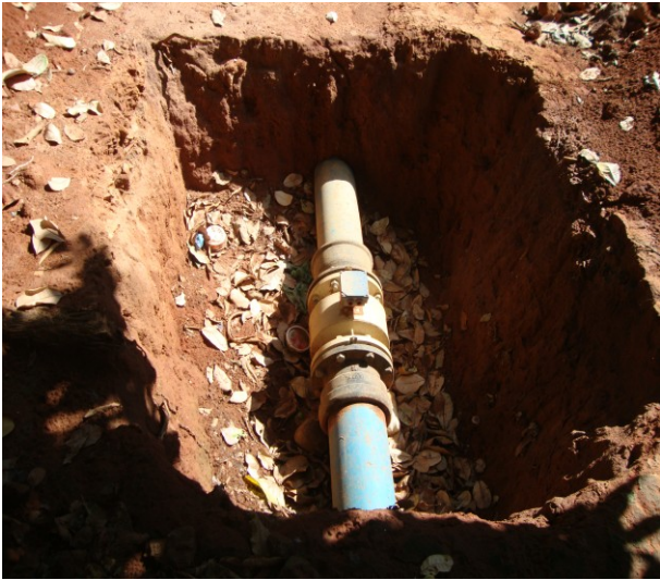
Foto 25 – Macromedidor de água tratada sem grade de proteção no interior da ETA.
