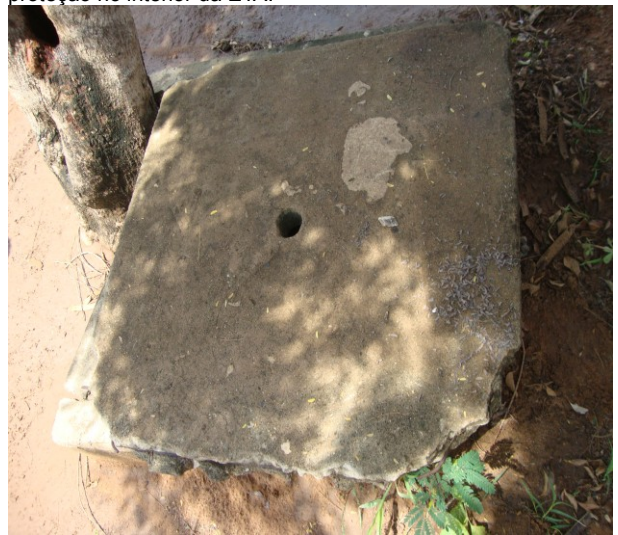
Foto 28 – Caixa de proteção de uma ventosa de água bruta localizada na CE-60.
