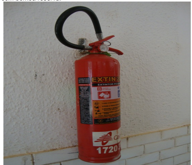
Foto 34 – Extintor de incêndio das EEAT-01 e EELF-01 com validade até março/2014.
