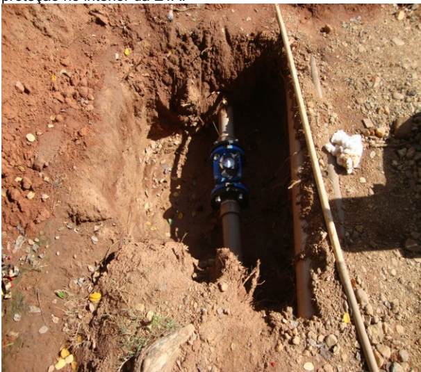
Foto 27 – Macromedidor de água bruta sem grade de proteção no interior da ETA.
