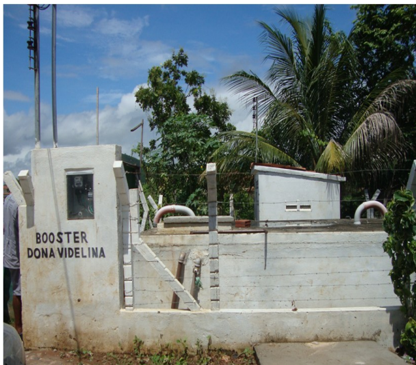
Foto 36 – Vista da EEAT-03 (Booster).
