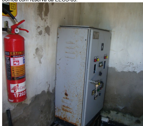
Foto 39 – Quadro de comando da EEAT-03 e extintor de incêndio com validade até março/2014.
