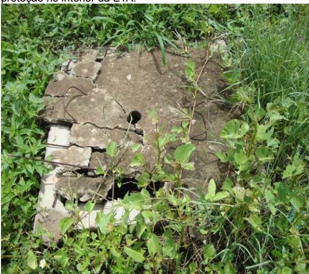
Foto 29 – Caixa de proteção de uma ventosa de água bruta com tampa danificada, localizada na CE-60.
