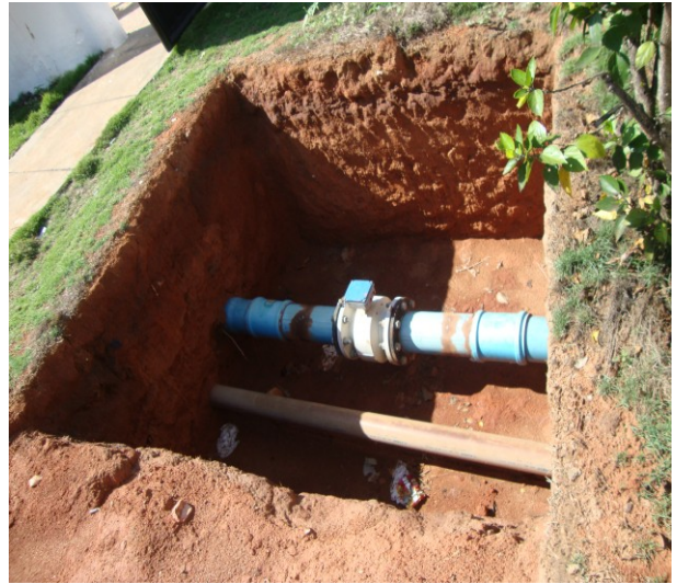
Foto 26 – Macromedidor de água tratada sem grade de proteção no interior da ETA.
