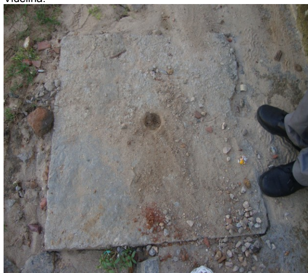
Foto 57 – Registro de descarga localizado no Conjunto Novo Planalto IV.
