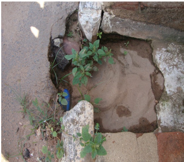
Foto 54 – Registro de descarga sem tampa de proteção localizado na Vila São Francisco.
