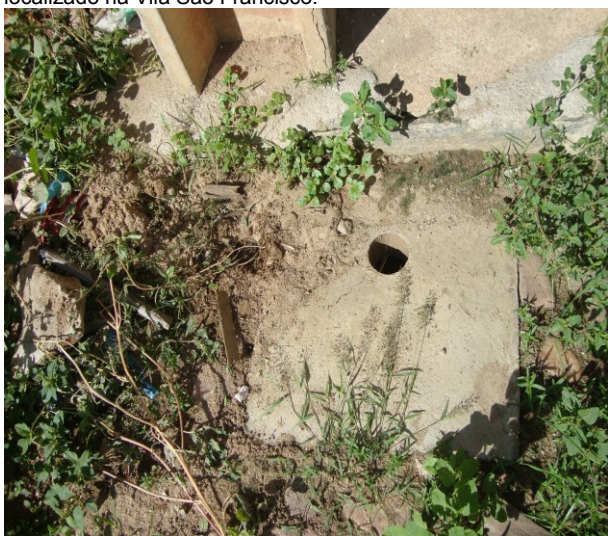
Foto 56 – Registro de descarga localizado na Rua Vereador Francisco N. Cavalcante.
