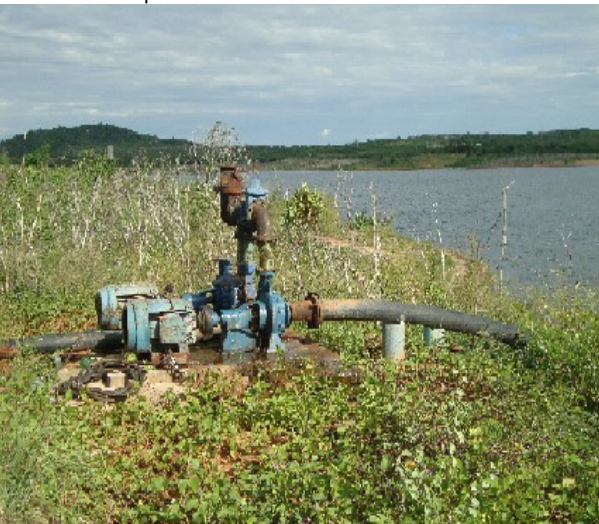
Foto 3 – Conjunto moto-bomba da captação com bomba reserva.
