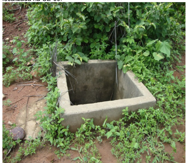
Foto 30 – Caixa de proteção de um registro de descarga de água bruta sem tampa, localizada na CE-60.
