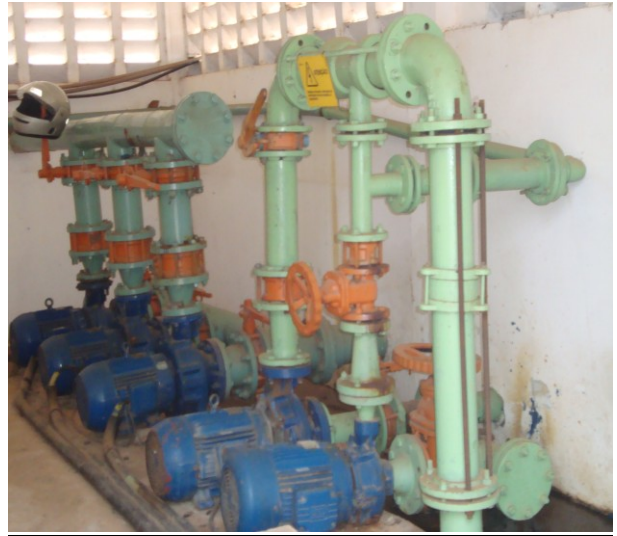
Foto 32 – Conjunto moto-bomba das EEAT-01 e EELF-01 com bomba reserva.
