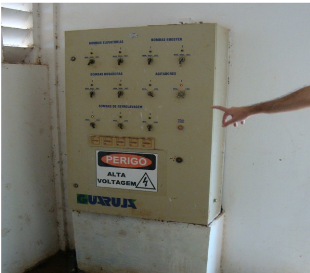
Foto 33 – Quadro de comando das EEAT-01 e EELF-01 sem perímetro e voltímetro.
