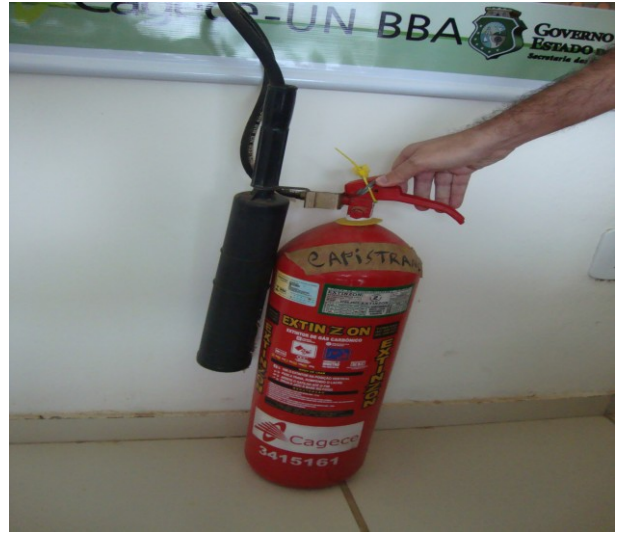
Foto 61 – Extintor de incêndio com prazo de validade expirado em agosto/2012 e disposto em local inadequado.
