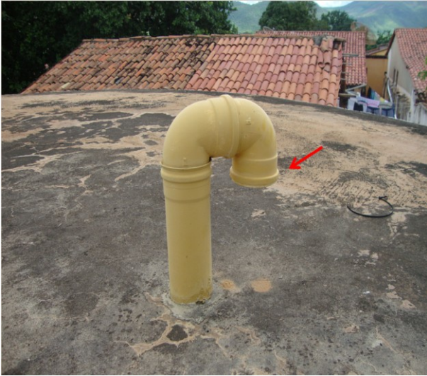
Foto 42 – RSE-01: Uma das tubulações de ventilação sem tela de proteção.
