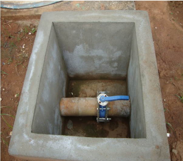
Foto 44 – RSE-01: Caixa de inspeção na área do reservatório sem tampa.
