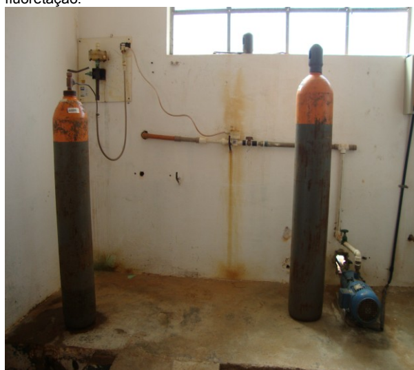
Foto 16 – Dosador de cloro.
