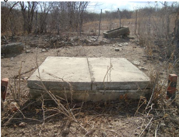
Foto 39 – Caixa de ventosa instalada na adutora de água bruta.
