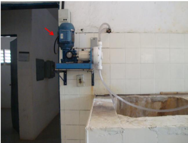
Foto 27 – Bomba dosadora reserva.
