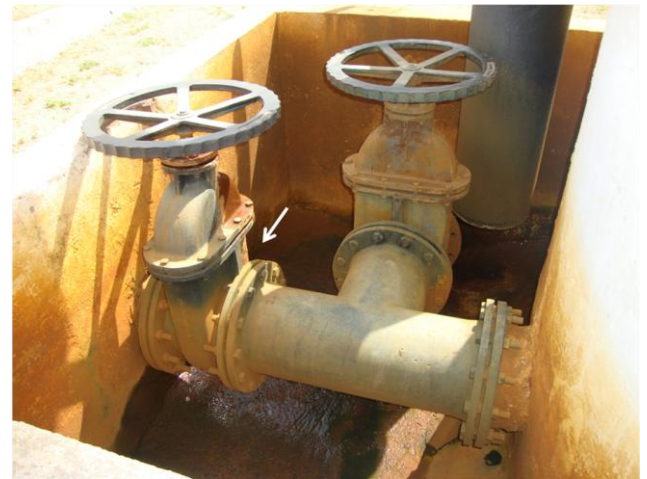
Foto 22 – Filtro F-01 com vazamento no registro.
