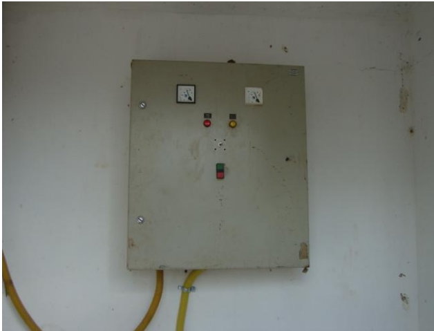
Foto 7 – PT-05: quadro de comando.
