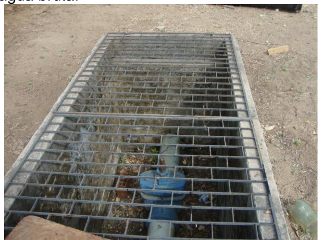
Foto 42 – Registro instalado na adutora de água bruta na área do Poço de Reunião.
