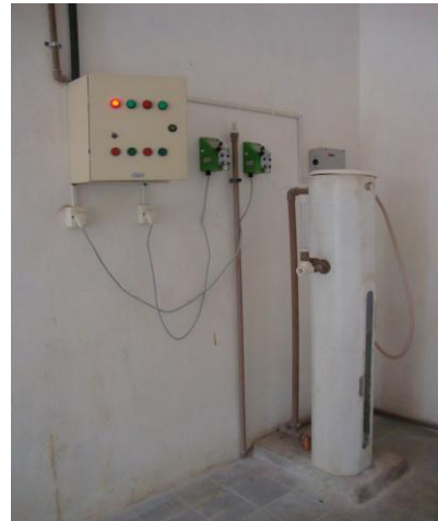
Foto 28 – Dosador de flúor.
