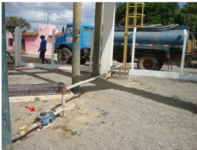
Foto 47 – Macromedidor de água tratada, para abastecer carros-pipa, na saída do REL-01.
