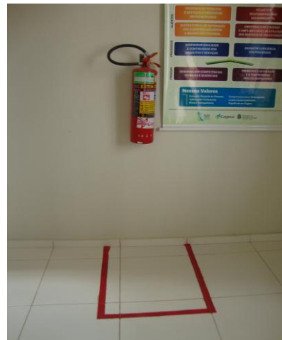
Foto 91 – Extintor de incêndio da loja de atendimento com validade até ago/2014.
