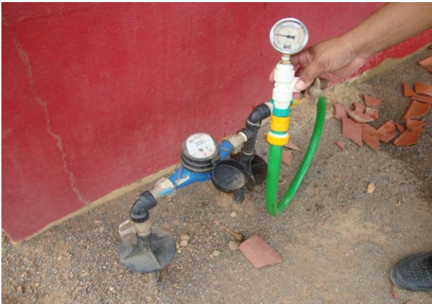
Foto 79 – Medição de pressão na Rua Sebastião Miranda, nº 707 – Posto Leão.
