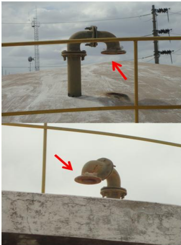
Foto 62 – RAP-01: tubulações de ventilação com tela de proteção.
