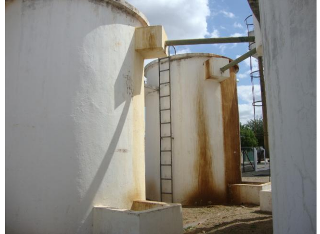
Foto 20 – Vista dos filtros F-01 e F-02.
