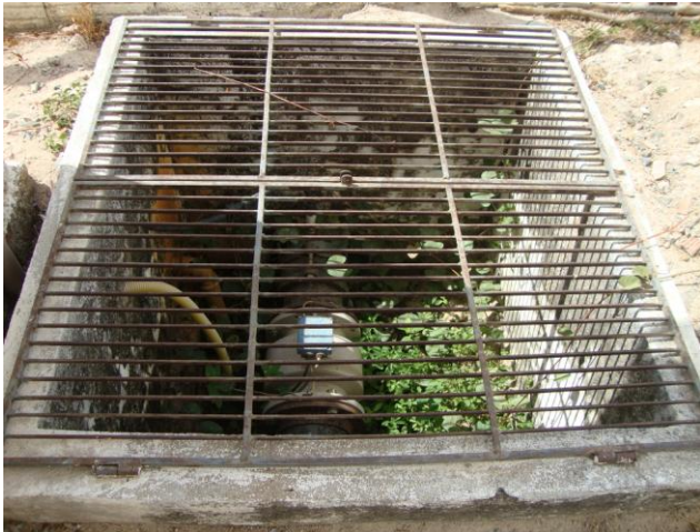
Foto 43 – Macromedidor de água bruta na área da ETA.
