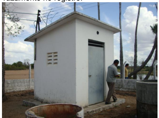
Foto 6 – PT-05: casa de abrigo do quadro de comando.
