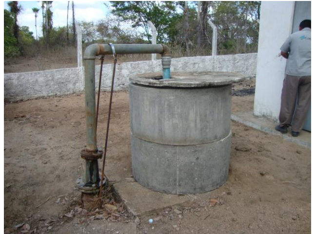
Foto 10 – PT-06: tubulação de recalque.
