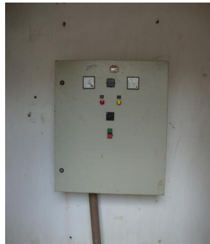
Foto 12 – PT-06: quadro de comando.
