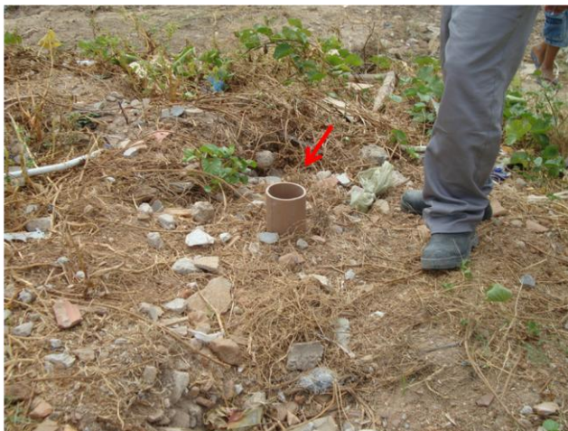
Foto 83 – Registro de descarga na Rua Elmo Roberto – Bairro Campo de aviação.
