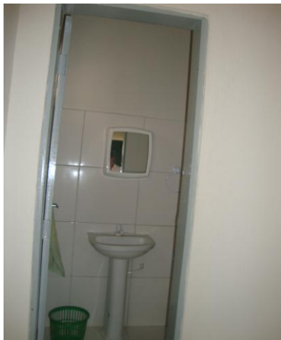
Foto 90 – Instalações sanitárias disponíveis para funcionários e usuários.
