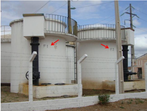
Foto 19 – Vista frontal dos filtros F-01 e F-02.
