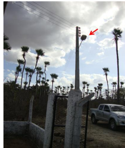
Foto 2 – PT-05: iluminação externa.
