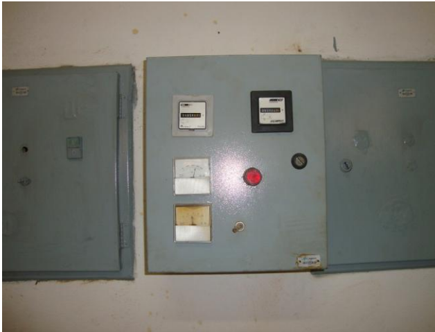
Foto 54 – Quadro de comando da EEAT-01.
