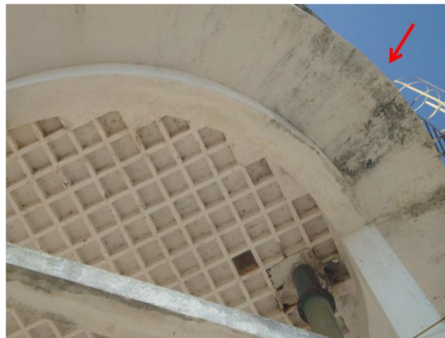
Foto 67 – REL-01: infiltração na laje de fundo.
