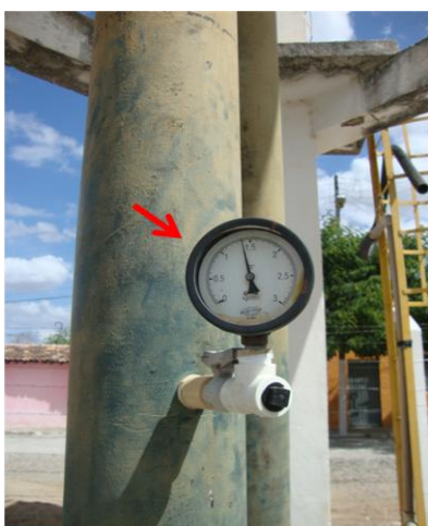
Foto 70 – REL-01: medidor de nível.
