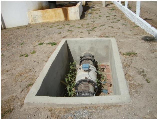
Foto 45 – Macromedidor de água tratada na entrada dos filtros.
