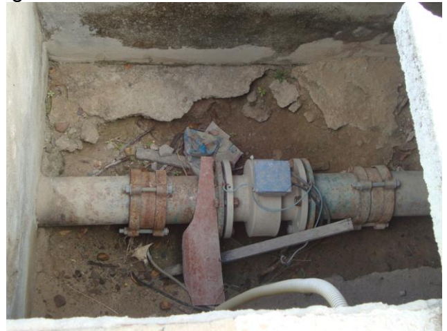
Foto 46 – Macromedidor de água tratada na entrada do REL-01.
