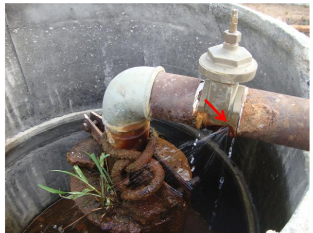
Foto 4 – PT-05: tubulação de recalque com vazamento no registro.
