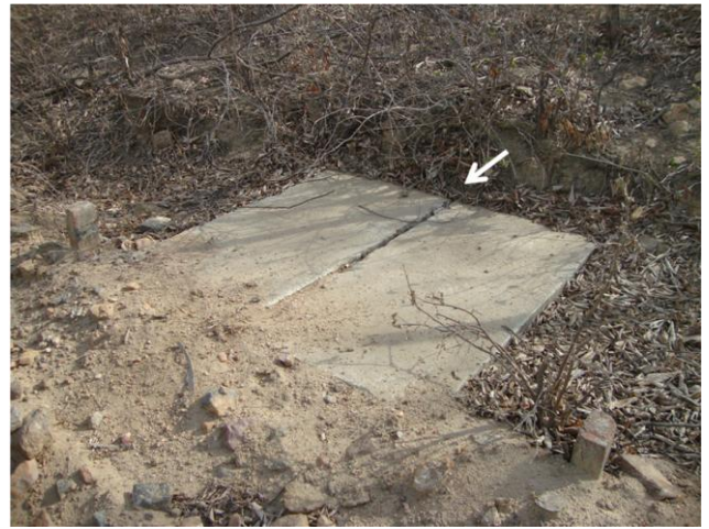
Foto 38 – Caixa de ventosa instalada na adutora de água bruta.
