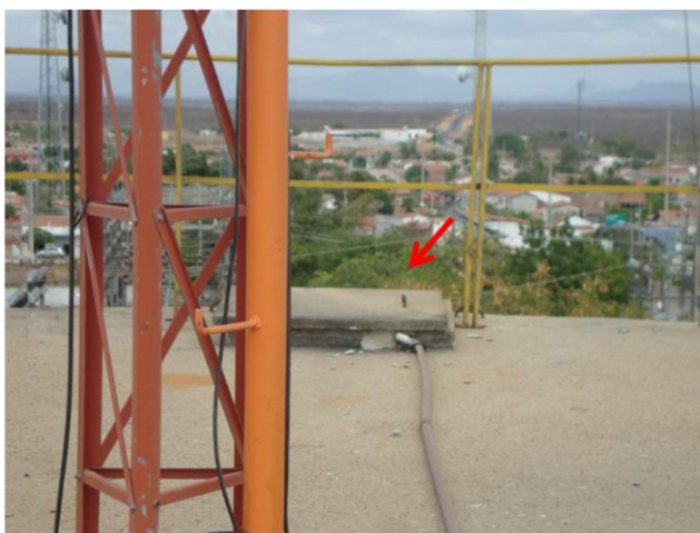
Foto 68 – REL-01: com tampa de inspeção.
