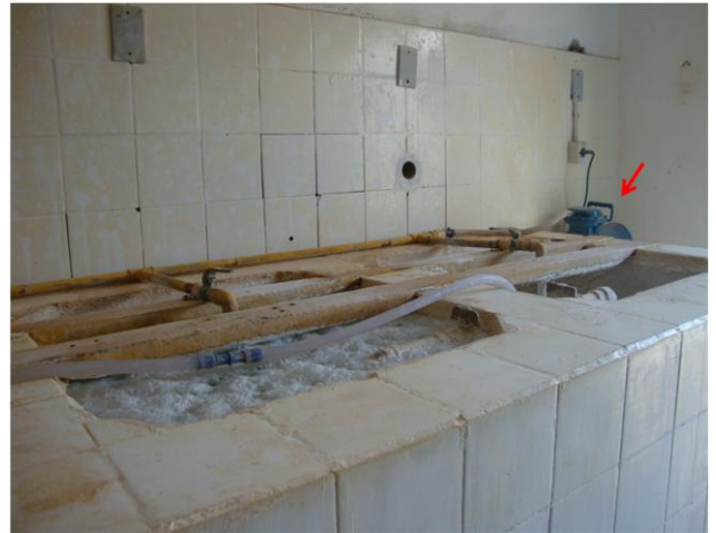
Foto 26 – Vista superior dos dosadores de PAC e polímetro e bomba dosadora.
