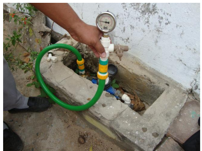
Foto 76 – Medição de pressão na Avenida Paraíso, nº 83 – Centro.
