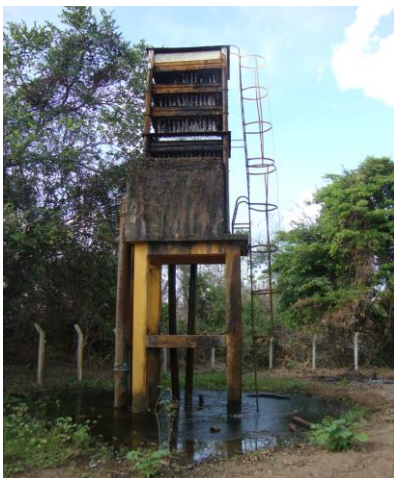
Foto 17 – Vista do aerador.
