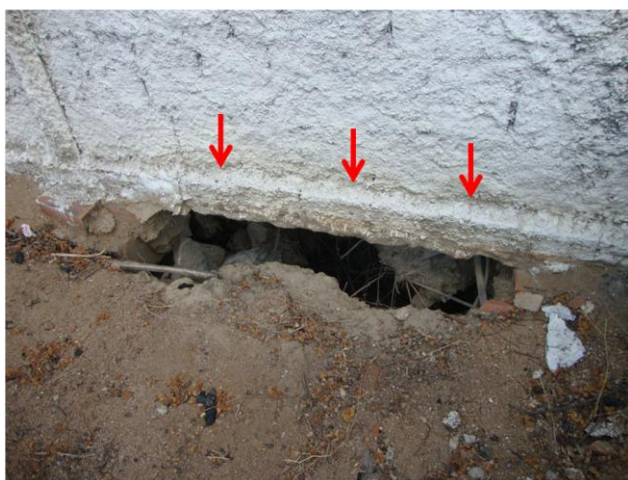
Foto 5 – PT-05: erosão na parede de delimitação, próximo ao Rio Acaraú.
