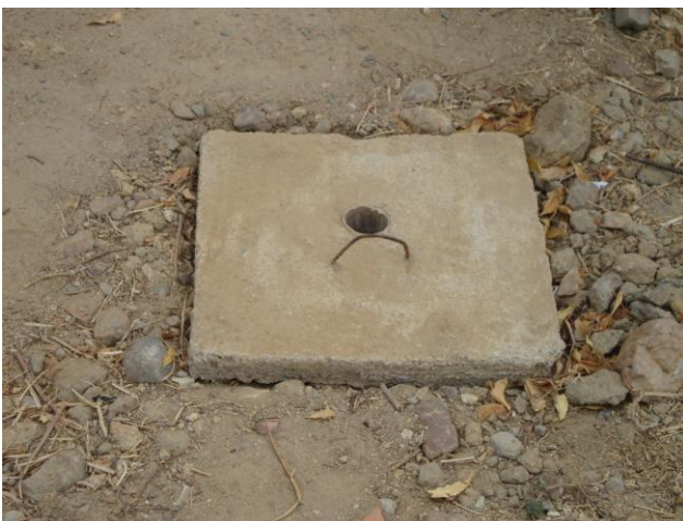
Foto 81 – Registro de descarga na Rua Bela Vista – Bairro Pedrinhas.
