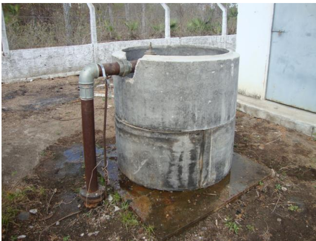
Foto 3 – PT-05: tubulação de recalque
