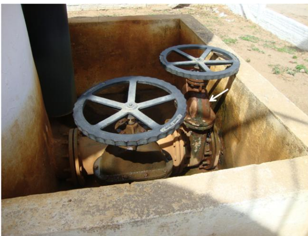
Foto 23 – Filtro F-02 com vazamento no registro.
