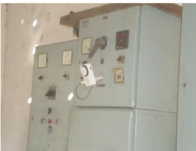
Foto 52 – Quadros de comando da EEAB-01.
