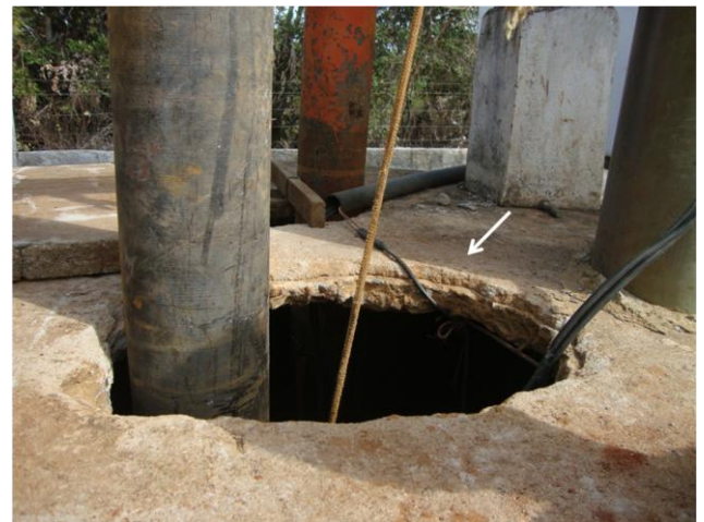
Foto 57 – PR-01 sem tampa de inspeção.
