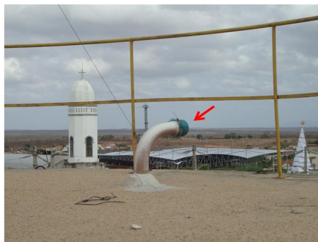
Foto 69 – REL-01: tubulação de ventilação com tela de proteção.
