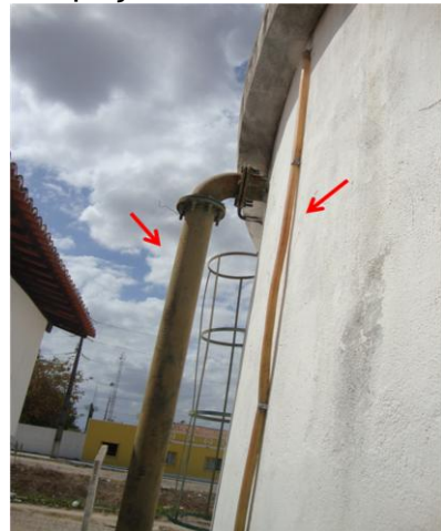
Foto 63 – RAP-01: tubulação de descarga e medidor de nível.
