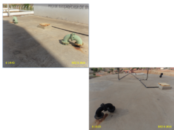
Foto 8 – REN e RAP-04: tubulações de ventilação sem tela de proteção.
