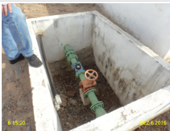
Foto 7 – RAP-04: caixa sem tampa ou grade de proteção..
