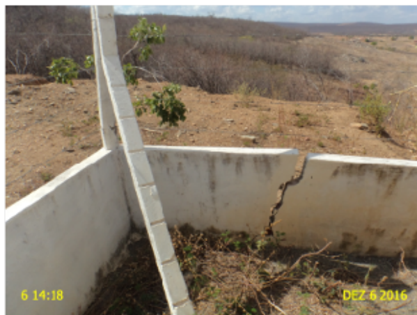
Foto 5 – AAB: muro de proteção da torre de equilíbrio deteriorado.
