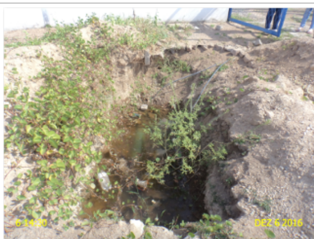
Foto 2 –ETA: medidor sem caixa, tampa ou grade de proteção.
