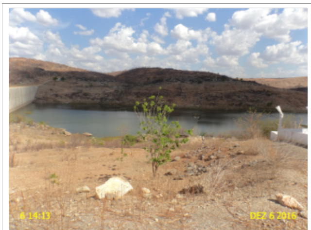
Foto 10 – Captação: ausência de placa de identificação.
