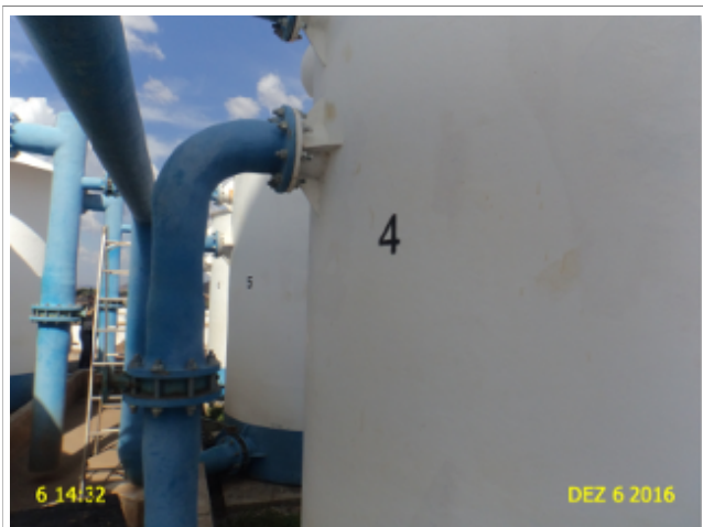
Foto 1 – Filtros: escada inadequada.
