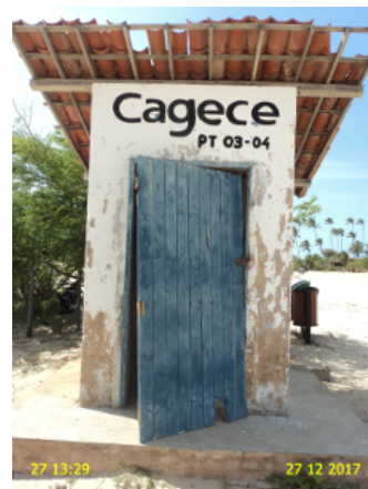
Foto 22 – PT-03 e PT-04 (Jericoacoara): porta da casa de abrigo danificada.
