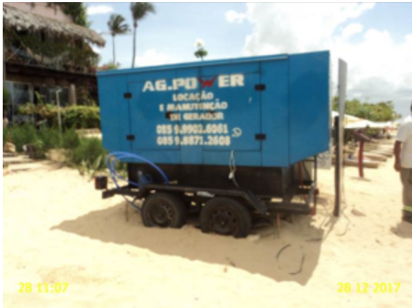
Foto 49 – EEE Provisória (Jericoacoara): grupo gerador de energia.
