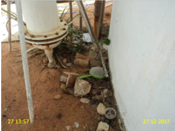
Foto 47 – ETA (Jericoacoara): acúmulo de lixo no pátio externo.
