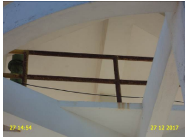
Foto 18 – REL-01 (Jericoacoara): guarda-corpo em processo de corrosão.
