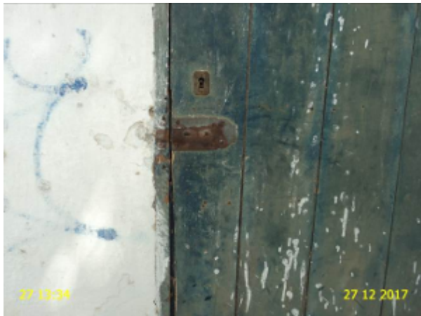
Foto 25 – PT-01 (Jericoacoara): porta da casa de abrigo sem fechadura.
