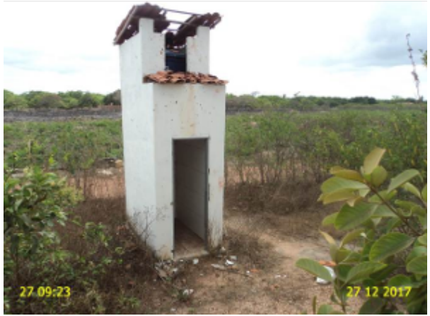
Foto 44 – ETE (Sede): edificação de apoio do operador sem porta e com telhado danificado.
