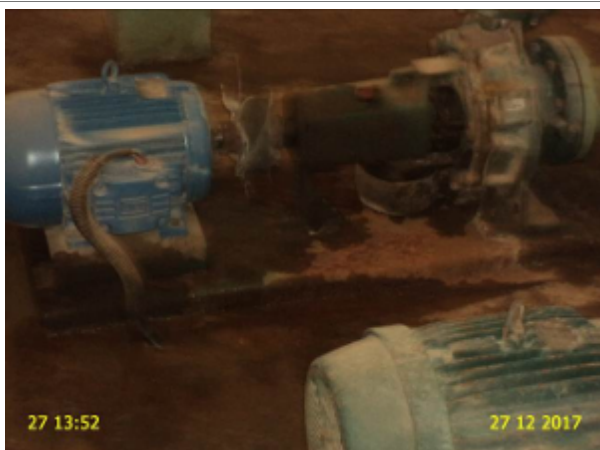
Foto 9 – EEAT-01 (Jericoacoara): vazamento na gaxeta.
