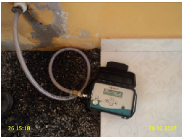
Foto 1 – RDA (Sede): Equipamento datalogger , instalado no endereço Rua João Pessoa, nº 79.
