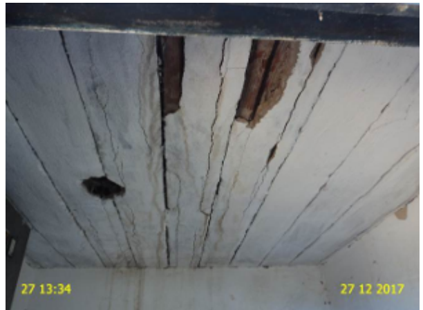
Foto 24 – PT-01 (Jericoacoara): laje de cobertura com armaduras expostas.
