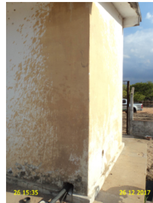
Foto 20 – PT-03 (Sede): pintura deteriorada na casa de abrigo do QC.
