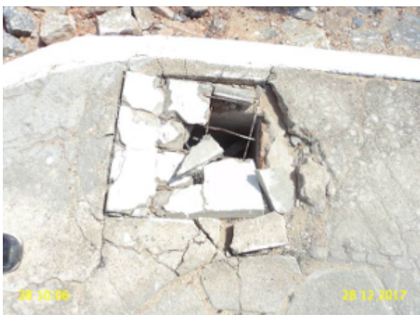
Foto 27 – ETE (Jericoacoara): caixa de inspeção com tampa danificada.
