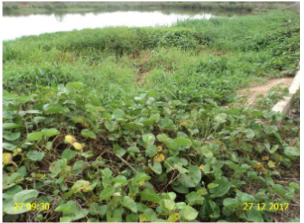
Foto 28 – ETE (Sede): vegetação excessiva na Lagoa Facultativa.
