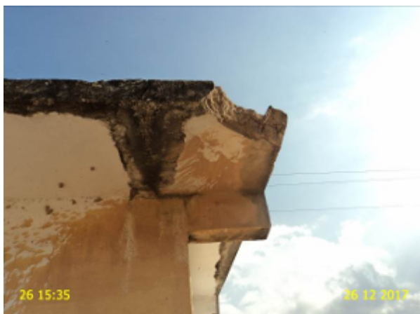
Foto 21 – PT-03 (Sede): laje de cobertura danificada na casa de abrigo do QC.
