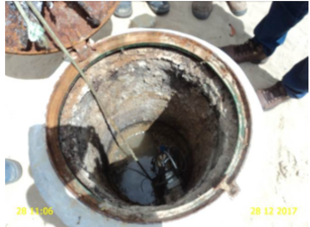
Foto 48 – EEE Provisória (Jericoacoara): Bomba instalada no PV localizado em frente pousada Fateixa .
