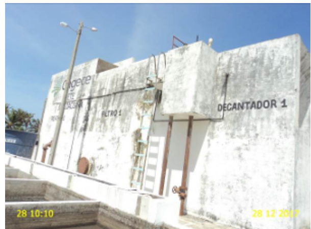
Foto 34 – ETE (Jericoacoara): filtros, decantadores e reatores com pintura deteriorada.
