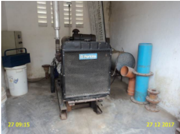
Foto 43 – EEE-02 (Sede): grupo gerador de energia com defeito.
