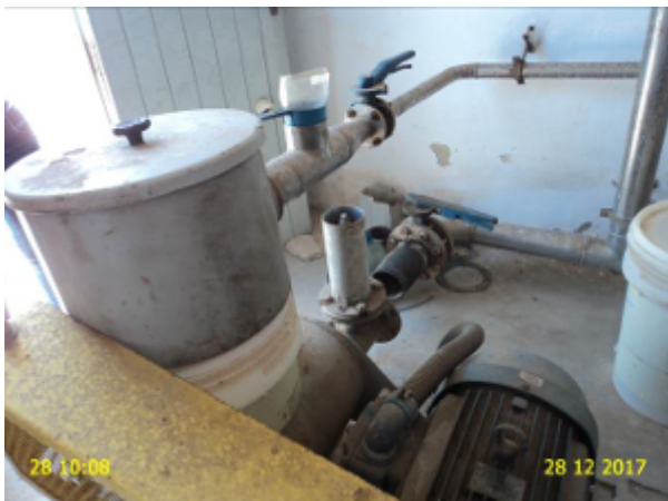
Foto 33 – ETE (Jericoacoara): soprador com defeito.
