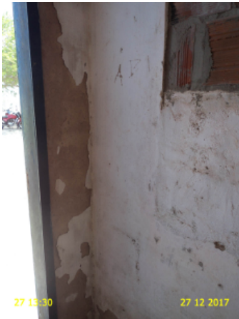
Foto 23 – PT-03 e PT-04 (Jericoacoara): pintura e reboco danificados.
