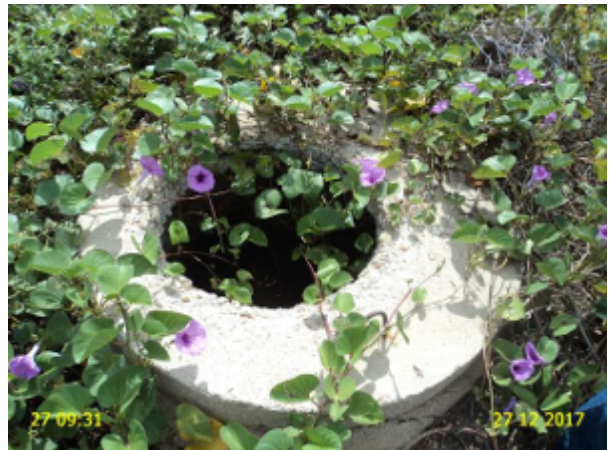
Foto 26 – ETE (Sede): PV sem tampa na lagoa facultativa.
