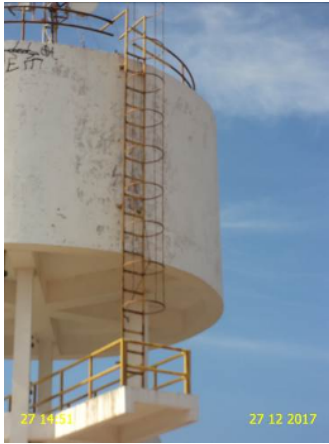
Foto 17 – REL-01 (Jericoacoara): escada de acesso em processo de corrosão.
