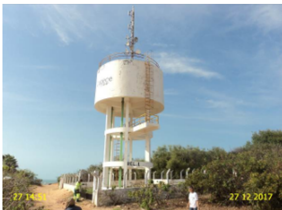
Foto 5 – REL-01 (Jericoacoara): ausência de para-raios.
