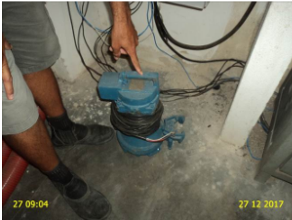
Foto 7 – EEE-01 (Sede): bomba não instalada.
