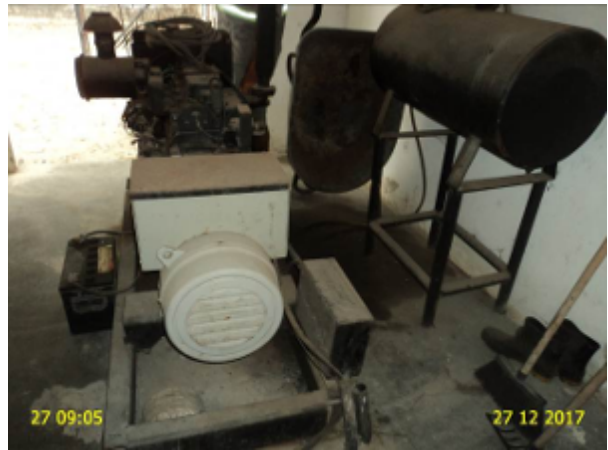
Foto 42 – EEE-01 (Sede): grupo gerador de energia com defeito.
