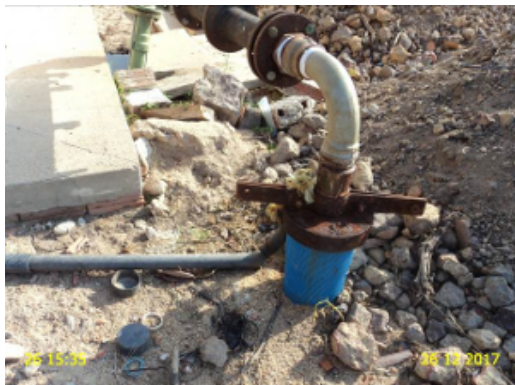
Foto 3 – PT-03 (Sede): sem laje de proteção.
