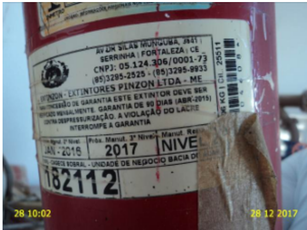
Foto 41 – EEE-02 (Jericoacoara): extintor de incêndio com data de validade da recarga vencida.
