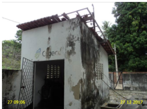
Foto 39 – EEE-01 (Sede): casa de abrigo do grupo gerador de energia com pintura, reboco e telhado deteriorados.
