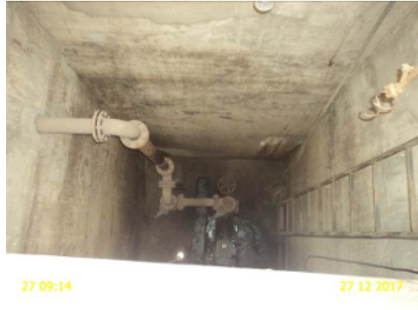
Foto 8 – EEE-02 (Sede): somente uma bomba instalada.
