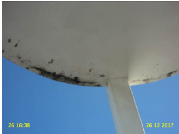
Foto 19 – REL-01 (Sede): armaduras expostas.
