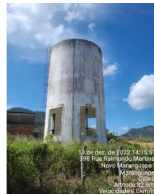
Foto 20 - REL-02: escada corroída e de difícil acesso.
