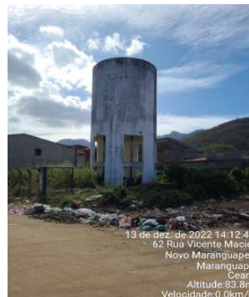
Foto 4 - REL-02: ausência de identificação.
