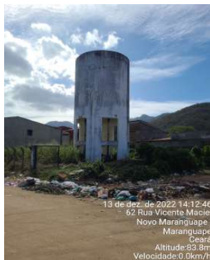
Foto 19 - REL-02: cerca destruída e pintura desgastada.
