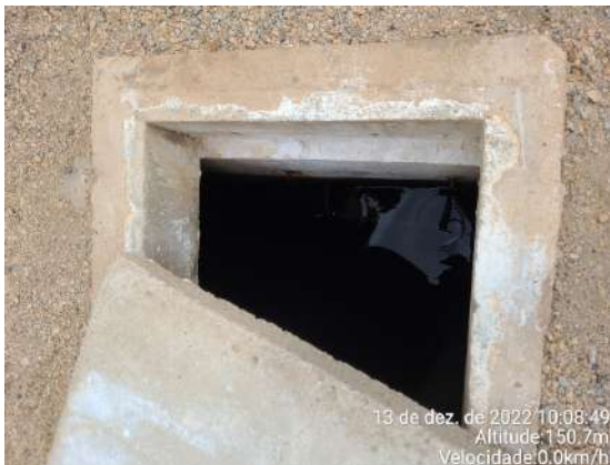
Foto 27 - RAP (ETA Sapupara): tampa deslocada.
