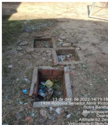
Foto 5 - EERD-04: caixas dos registros sem tampas.
