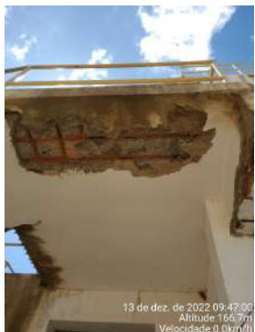
Foto 23 - Filtros (ETA Sapupara): estrutura de concreto armado com aço exposto.
