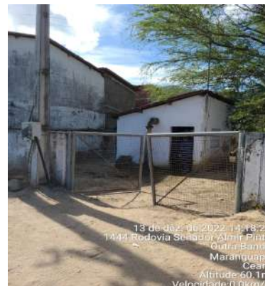
Foto 6 - EERD-04: ausência de identificação.
