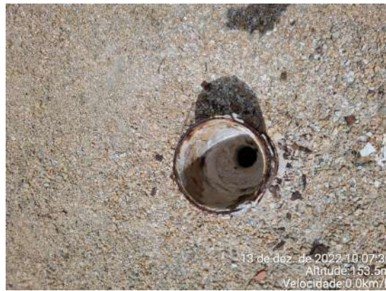
Foto 28 - RAP (ETA Sapupara): tubulação de respiro sem tela de proteção.
