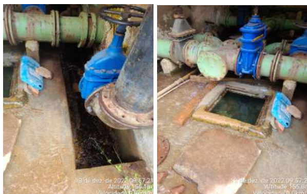
Foto 26 - Filtros (ETA Sapupara): vazamento nas tubulações.
