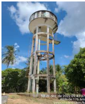
Foto 21 - REL (ETA Sapupara): pintura desgastada e escada oxidada.
