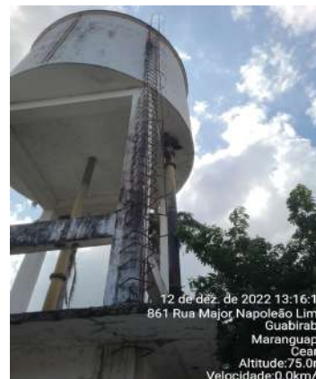
Foto 34 - REL-01: escada oxidada e de difícil acesso, vigas em processo de oxidação e estrutura armada exposta.
