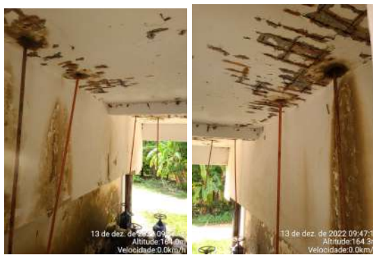
Foto 24 - Filtros (ETA Sapupara): estrutura de concreto armado com aço exposto.
