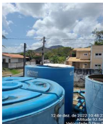
Foto 8 - Filtro F-07: tampa deslocada.
