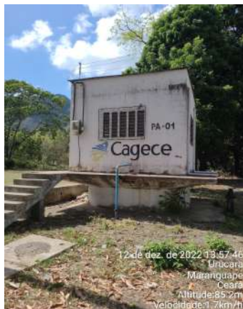
Foto 3 - PA-01: ausência de guarda-corpo e pintura desgastada.
