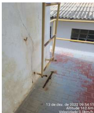
Foto 25 - Filtros (ETA Sapupara): escada sem estabilidade.
