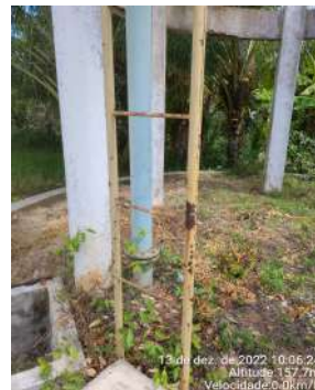
Foto 22 - REL (ETA Sapupara): escada oxidada.
