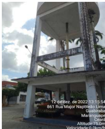
Foto 33 - REL-01: escada oxidada e de difícil acesso, vigas em processo de oxidação e estrutura armada exposta.
