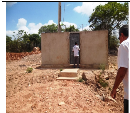
Foto 26 – EECS-01 – casa de abrigo do quadro de comando
