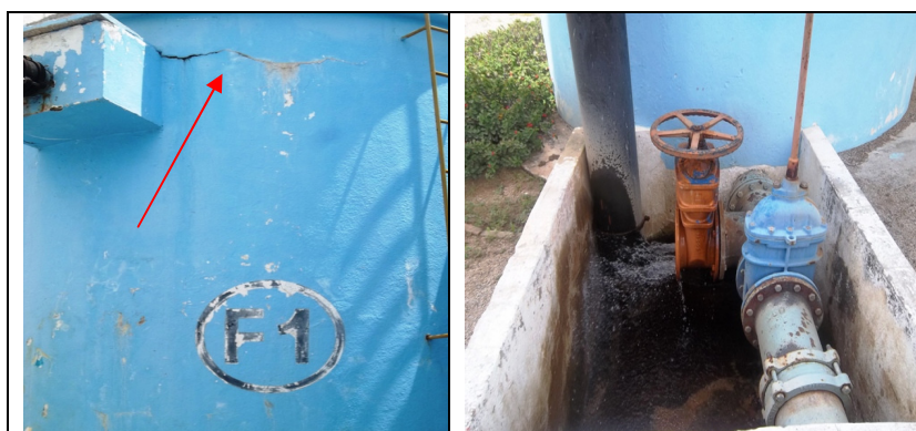
Foto 12 – Rachadura na parede lateral
