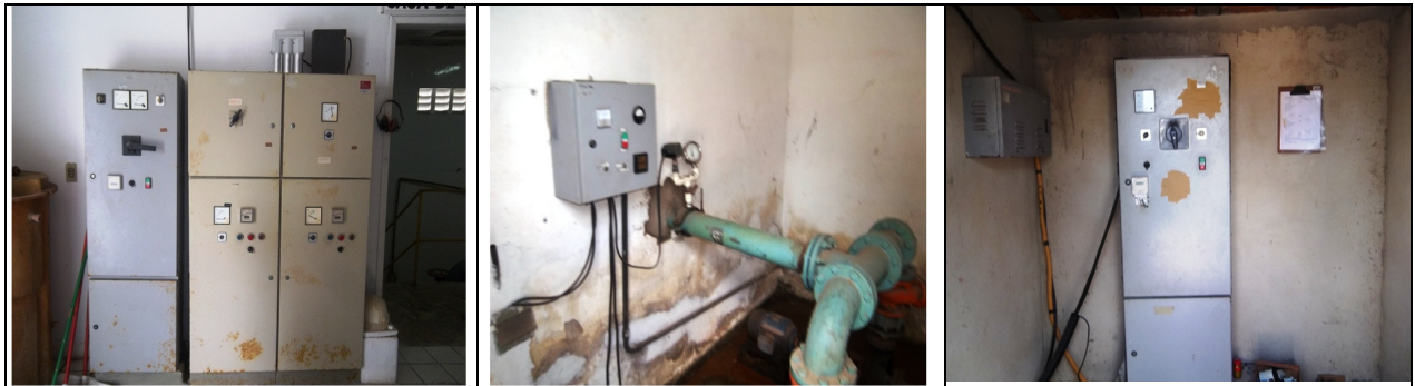
Fotos 23, 24 e 25 – EEAT-01, EEAT-02 e EECS-01 – quadros de comando
