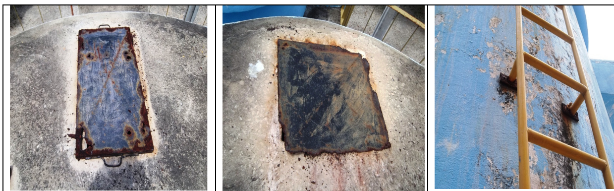
Fotos 9, 10 e 11 – Tampas e escada com corrosão
