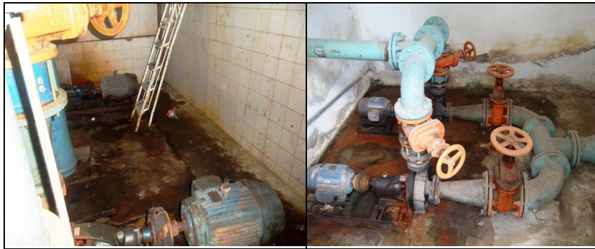
Fotos 21 e 22 – EEAT-01 e EEAT-02 - conjuntos motores-bomba
