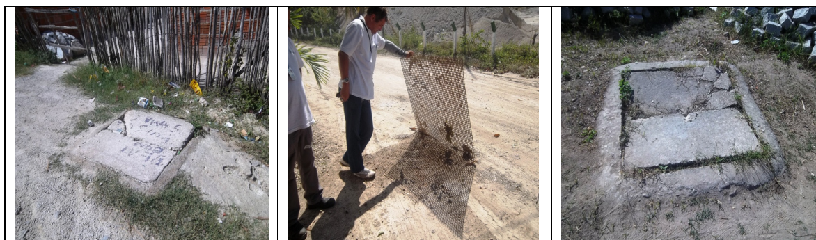
Fotos 43, 44 e 45 – Registros de descarga nas Ruas Cristiano Moreira Cavalcante, Antonio Cavalcante Rangel e Projetada nº 31
