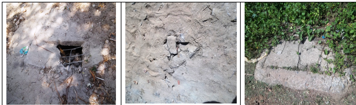
Fotos 46, 47 e 48 – Registros de descarga nas Ruas Inês Coelho Florindo, Joaquim Pereira da Silveira e Projetada nº 82
