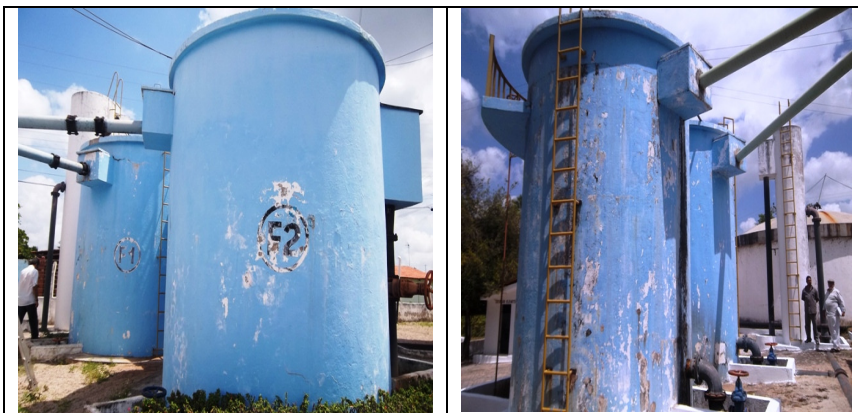
Fotos 7 e 8 – Vistas laterais dos filtros
