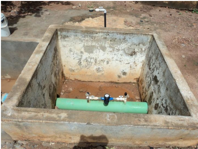
Foto 19 – REL-04: medidor proporcional sem grade de proteção.
