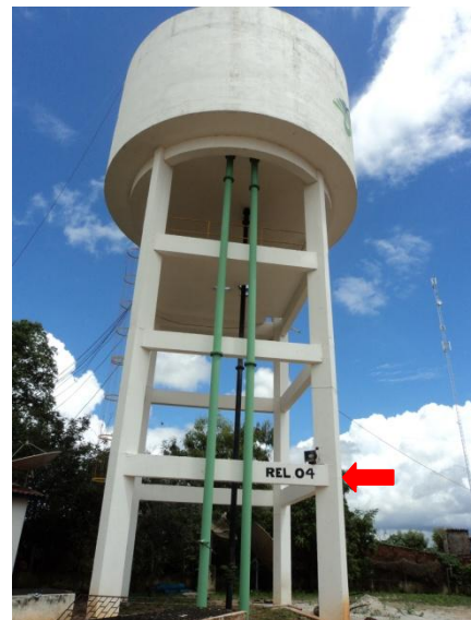
Foto 12 – REL-04: condições adequadas de conservação e identificação.
