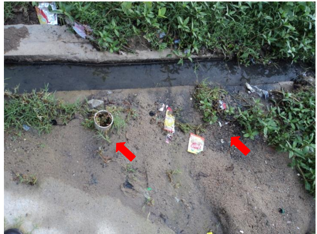
Foto 26 – Rede de Distribuição: registro de descarga na Rua José Rodrigues (saída obstruída)
