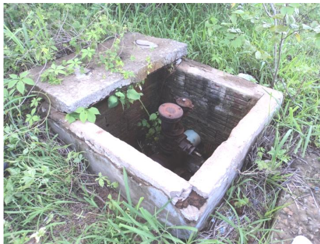
Foto 2 – Caixa de proteção de acessórios instalados na linha de adução de água tratada sem tampa (ventosa).
