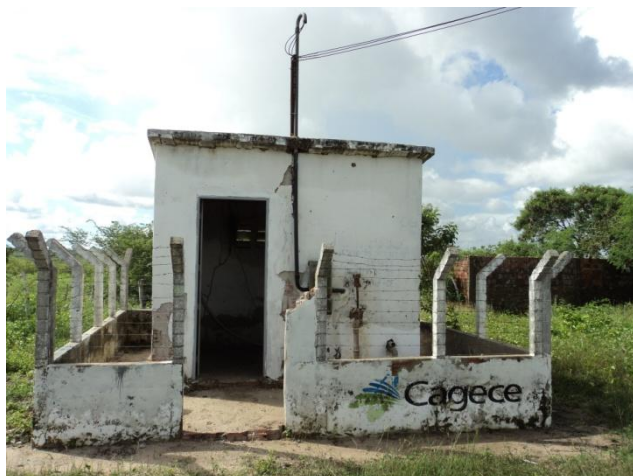
Foto 5 – Booster Sítio Retiro: ausência de portão e pintura deteriorada na casa de comando.
