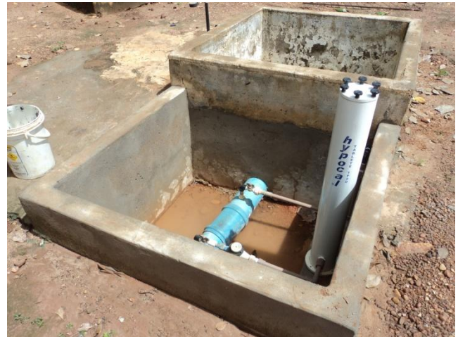
Foto 20 – REL-04: caixa de proteção da estação de hypocal sem grade de proteção.
