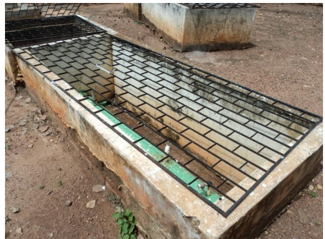
Foto 18 – REL-04: Caixa de proteção com grades.
