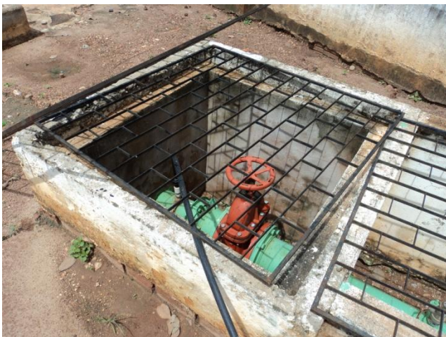
Foto 17 – REL-04: Caixa de proteção com grades.
