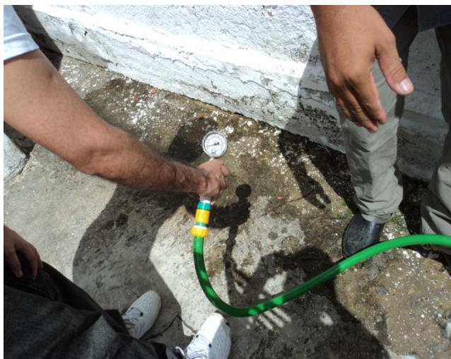
Foto 31 – Medição instantânea de pressão na Rua Dona Felina, nº 16 – Centro.
