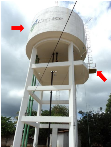
Foto 13 – REL-04: condições adequadas de conservação e identificação, com escada de acesso e guarda corpo.
