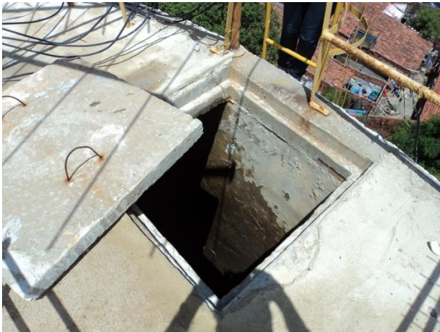
Foto 15 – REL-04: tampa de inspeção inadequada e aberta.
