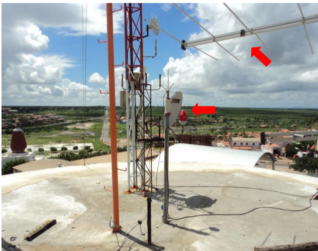
Foto 21 – REL-04: existência de para-raios e sinalização noturna.
