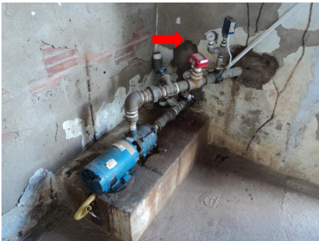
Foto 9 – Booster Sítio Retiro: equipamentos de automação.
