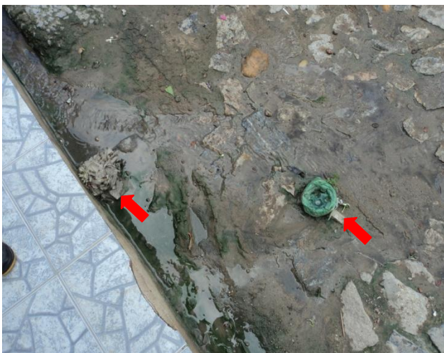
Foto 29 – Rede de Distribuição: registro de descarga na Rua Luiz Félix.
