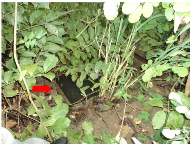
Foto 3 – Caixa de proteção de acessórios instalados na linha de adução de água tratada coberta por vegetação e com acúmulo de água.
