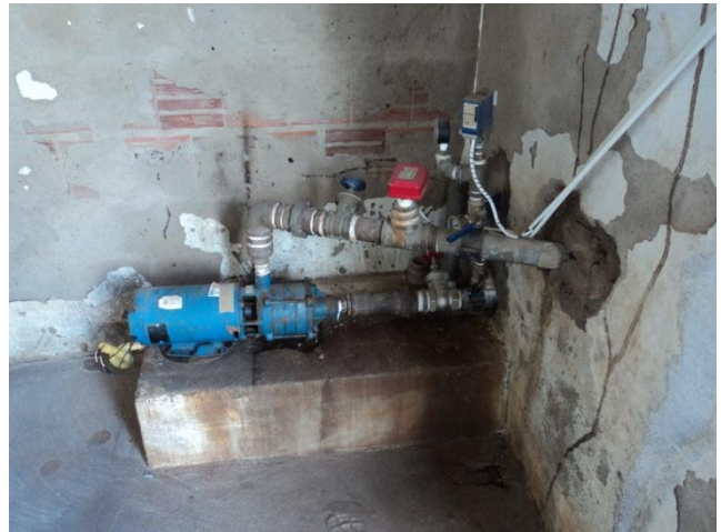
Foto 8 – Booster Sítio Retiro: ausência de bomba reserva e reboco deteriorado na casa de comando.
