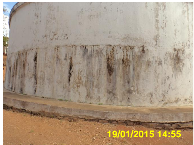
Foto 21 - RAP-01: pintura deteriorada e sinais de vazamento.
