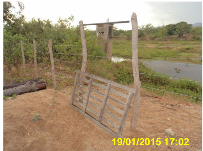
Foto 3 - Captação superficial: cerca delimitadora danificada.
