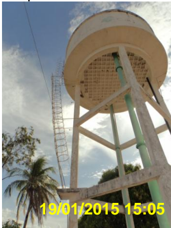
Foto 18 - REL-01: pintura deteriorada e escada empenada.
