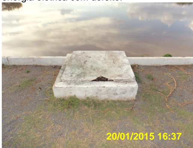
Foto 12 - ETE Forquilha: Tampa da caixa de chegada do esgoto bruto danificada.
