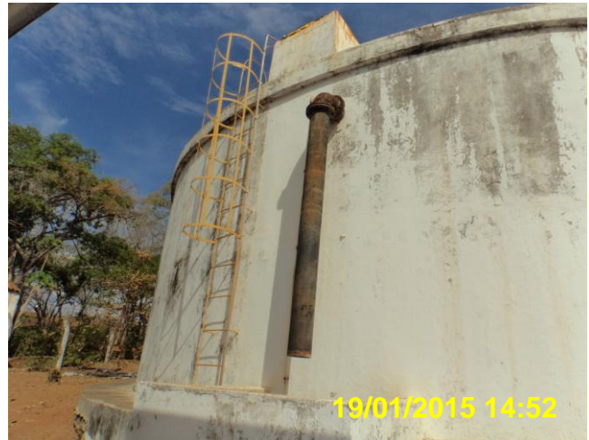
Foto 17 - RAP-01: apoio à tampa de inspeção danificada e tubo extravasador.
