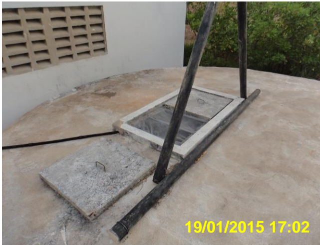
Foto 16 - PRE-01: tampa de inspeção sem vedação adequada.
