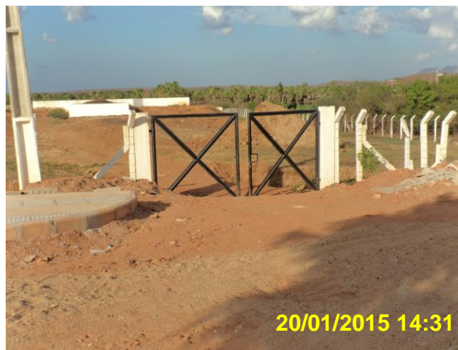
Foto 23 - ETE Forquilha: sem identificação e portão danificado.
