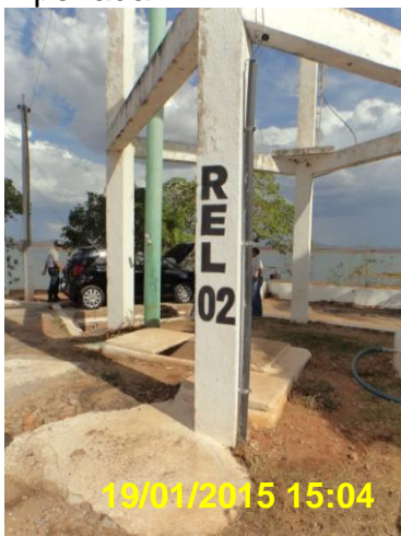
Foto 20 - REL-01: identificação incorreta.
