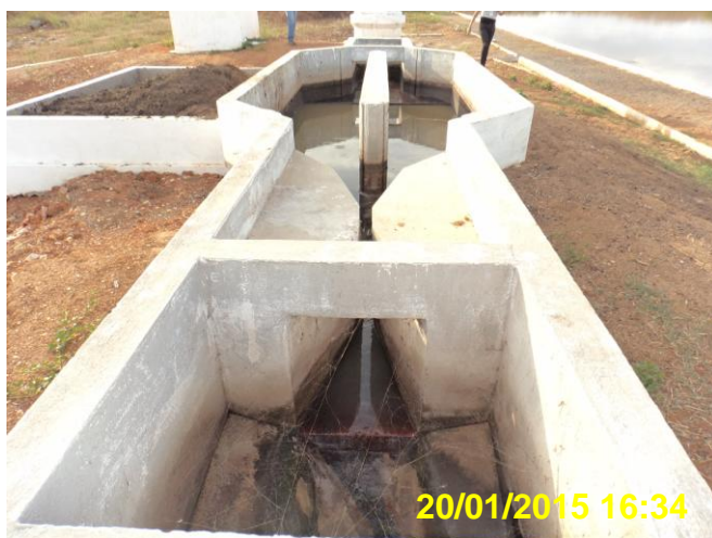
Foto 1 - Tratamento preliminar na ETE Forquilha sem gradeamento.
