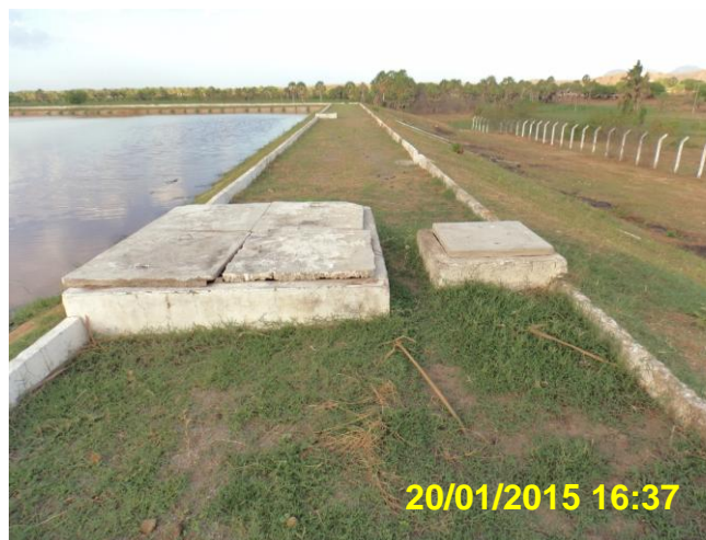
Foto 13 - ETE Forquilha: Tampa da caixa de chegada do esgoto bruto danificada.
