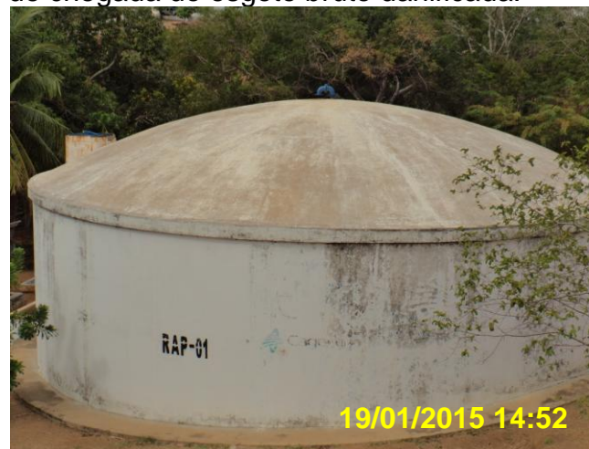
Foto 15 - RAP-01: tubulação de ventilação sem tela de proteção e pintura deteriorada.
