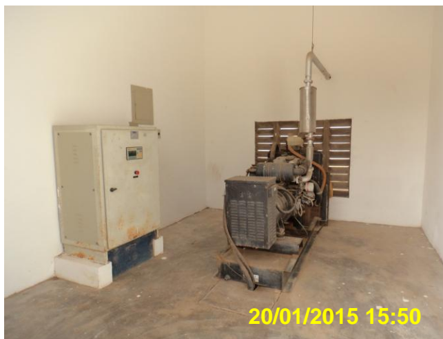
Foto 10 - EEE-02: grupo gerador de energia elétrica com defeito.
