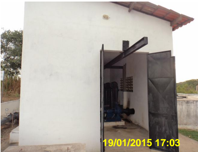
Foto 2 - EEAB-01: ausência de identificação.
