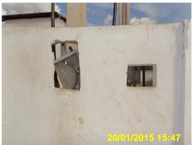
Foto 9 - EEE-02: muro danificado.
