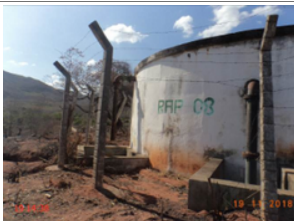
Foto 69 – RAP-08 (Antônio Diogo): cerca de delimitação danificada e pintura deteriorada.
