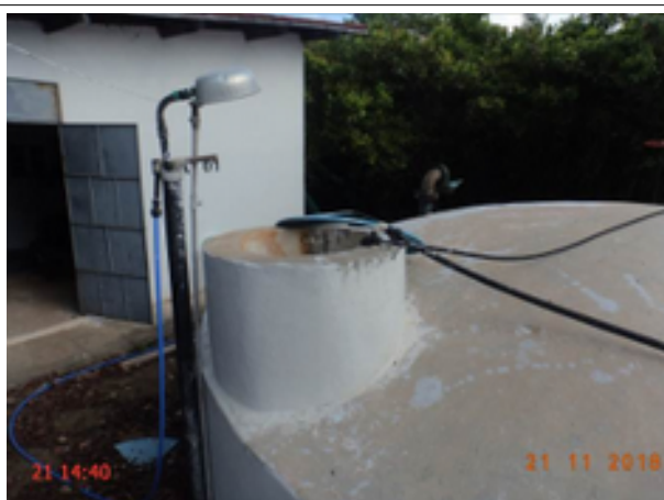
Foto 59 – RSE-01 (Sede): tampa da abertura de inspeção sem vedação.
