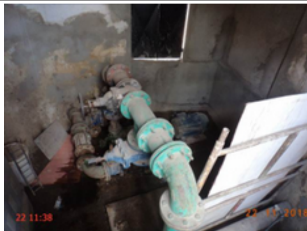
Foto 11 - EERD-02 (Sede): ausência de bomba reserva instalada e vazamento na gaxeta da bomba.
