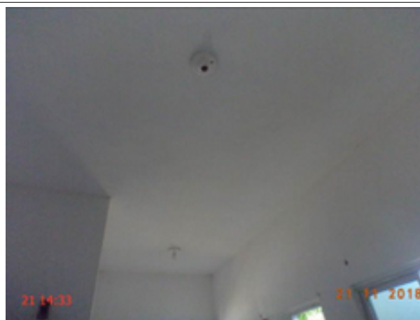
Foto 22 – ETA (Sede): lâmpada do laboratório não acende.
