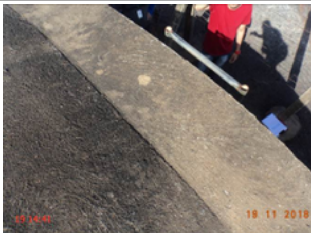
Foto 65 – RAP-08 (Antônio Diogo): escada sem apoio para acessar a laje de cobertura.
