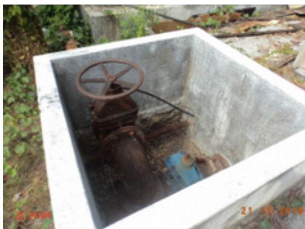
Foto 25 – ETA (Sede): caixas de inspeção sem tampa ou grade de proteção.
