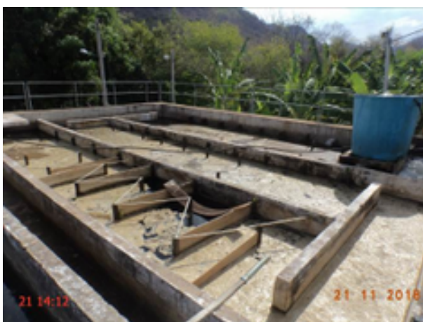
Foto 29 – ETA (Sede): chicanas do floculador estão danificadas.
