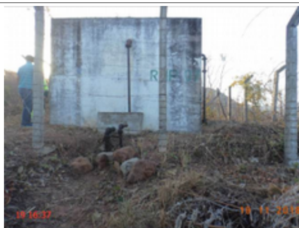
Foto 62 – RAP-07 (Antônio Diogo): cerca de delimitação danificada.
