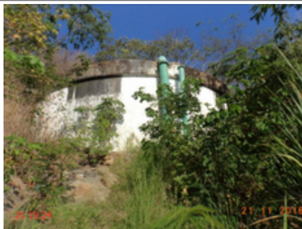
Foto 66 – RAP-02 (Sede): pintura deteriorada e sem identificação.
