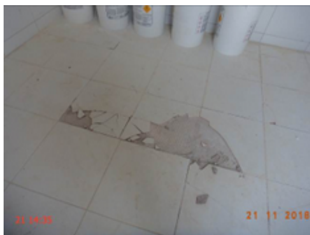
Foto 30 – ETA (Sede): piso danificado no almoxarifado de produtos químicos.
