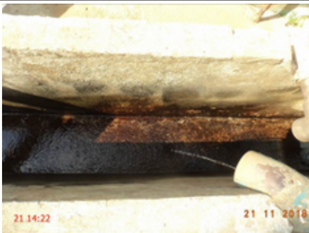
Foto 33 – ETA (Sede): F-09 e F-10 registros sem vedação.
