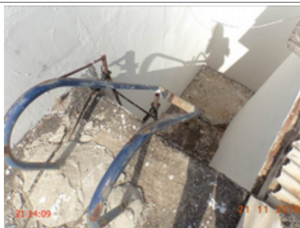
Foto 48 – ETA (Sede): escada de acesso do decantador sem fixação adequada e em processo de corrosão.
