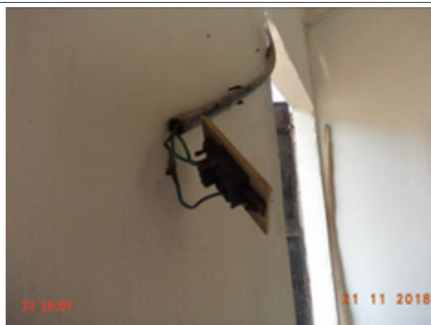
Foto 49 – EEE-01 (Sede): instalações elétricas da casa de abrigo do quadro de comando inadequadas.
