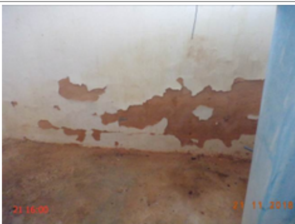
Foto 35 – ETE (Sede): reboco danificado na casa de abrigo do operador.
