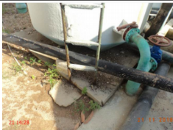
Foto 38 – ETA (Sede): Filtro F-03 escada sem fixação e em processo de corrosão.
