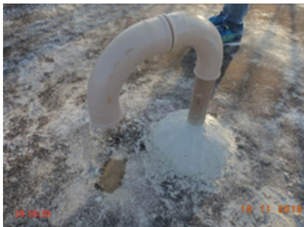
Foto 51 – RAP-07 (Antônio Diogo): ausência de tela de proteção na tubulação de ventilação.
