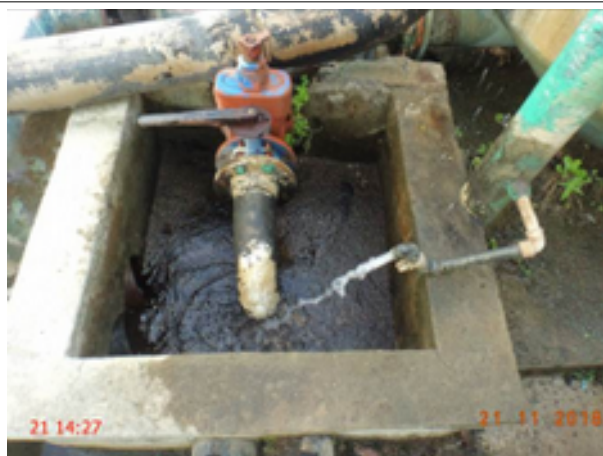
Foto 32 – ETA (Sede): F-02 vazamento no registro e registro sem vedação.
