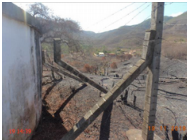
Foto 63 – RAP-08 (Antônio Diogo): cerca de delimitação danificada.
