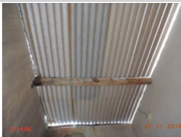
Foto 70 – EEAB-01 (Sede): sem lâmpada instalada na casa de abrigo.
