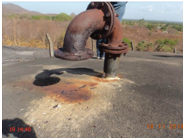
Foto 52 – RAP-08 (Antônio Diogo): ausência de tela de proteção na tubulação de ventilação.
