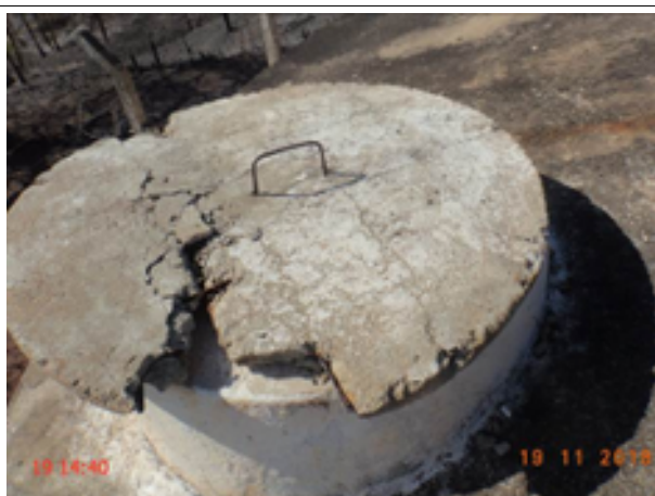
Foto 61 – RAP-08 (Antônio Diogo): tampa de inspeção danificada.
