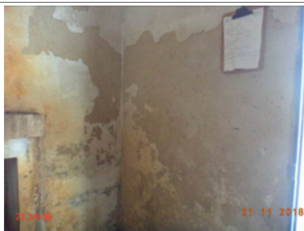
Foto 47 – EEAB-01 (Sede): reboco danificado.
