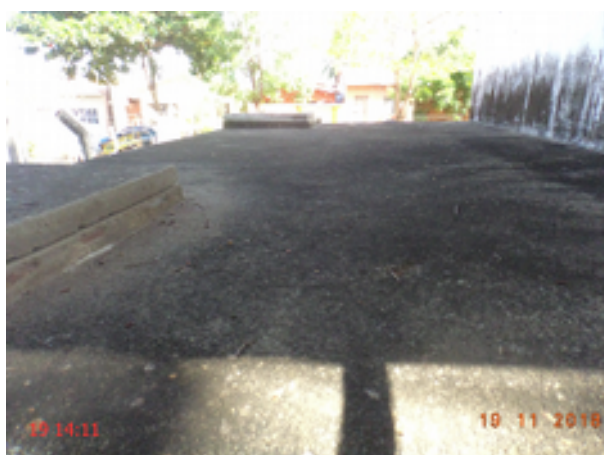
Foto 14 – RAP-06 (Antônio Diogo): laje de cobertura sem tubulação de ventilação.
