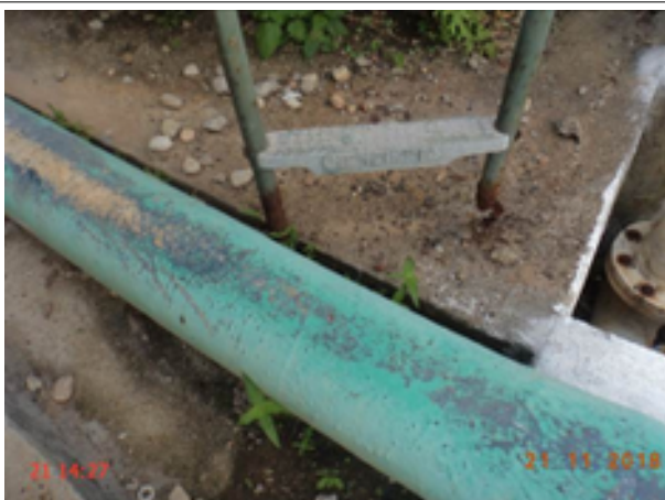
Foto 37 – ETA (Sede): Filtro F-02 escada sem fixação e em processo de corrosão.
