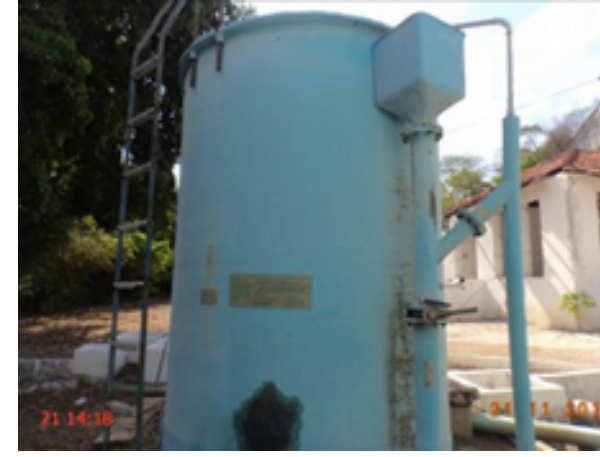
Foto 42 – ETA (Sede): F-12 sem identificação e escada em processo de corrosão e sem fixação.
