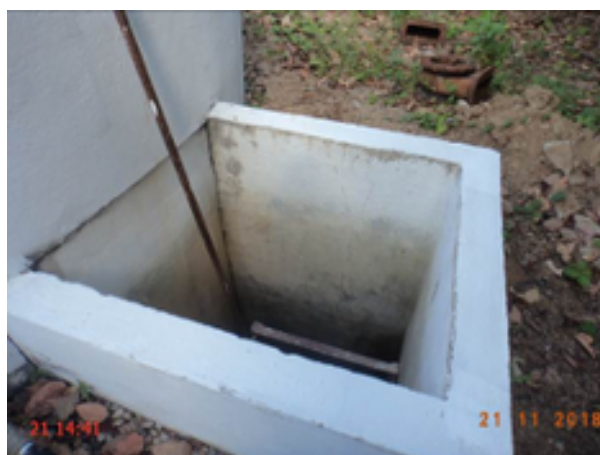
Foto 26 – ETA (RSE-01) (Sede): caixa de inspeção sem tampa ou grade de proteção.
