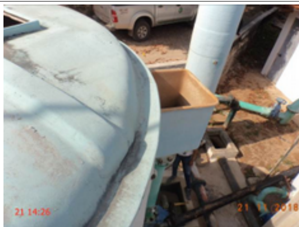
Foto 3 – ETA (Sede): F-01, calha de saída de água sem tampa.
