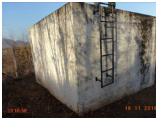
Foto 64 – RAP-07 (Antônio Diogo): escada sem apoio para acessar a laje de cobertura e pintura deteriorada.
