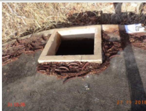
Foto 58 – RAP-02 (Sede): abertura de inspeção sem tampa.
