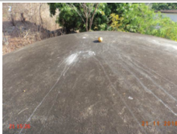
Foto 13 – RAP-02 (Sede): laje de cobertura sem tubulação de ventilação.
