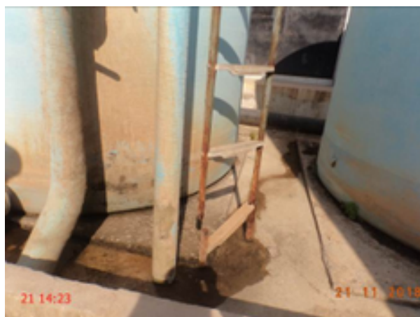
Foto 40 – ETA (Sede): F-09 escada sem fixação e em processo de corrosão.
