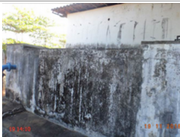
Foto 68 – RAP-06 (Antônio Diogo): pintura deteriorada e sem identificação.
