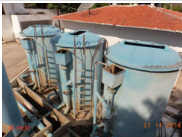
Foto 2 – ETA (Sede): F-10 e F-11 sem tampas na abertura de inspeção. F-09, F-10 e F-11 sem tampa na calha de saída de água dos filtros, sem identificação e escada em processo de corrosão
