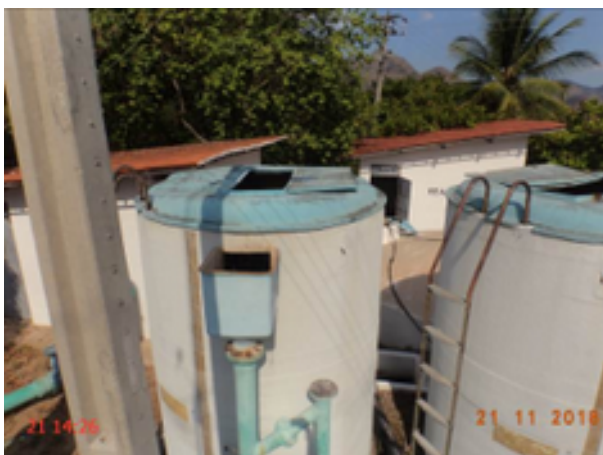
Foto 6 – ETA (Sede): Filtro F-04 sem tampa na calha de saída de água e tampa de inspeção aberta.
