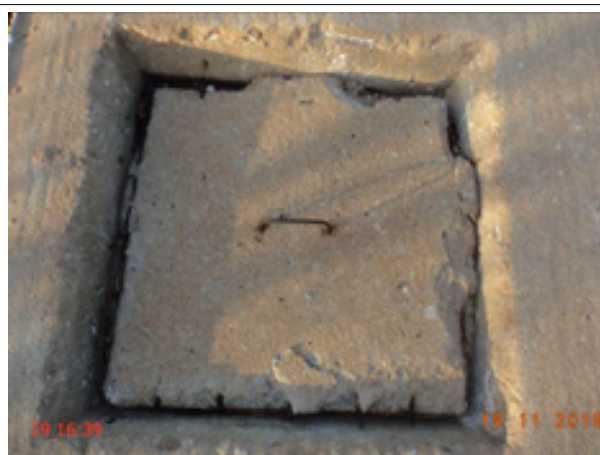
Foto 60 – RAP-07 (Antônio Diogo): tampa de inspeção sem vedação.
