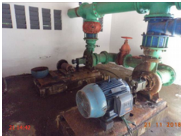
Foto 9 – EEAT-01 (Sede): ausência de bomba reserva instalada.
