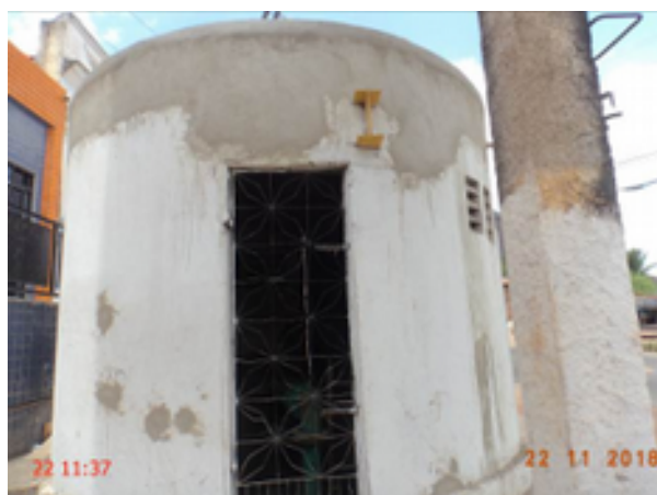
Foto 20 – EERD-02 (Sede): sem identificação.
