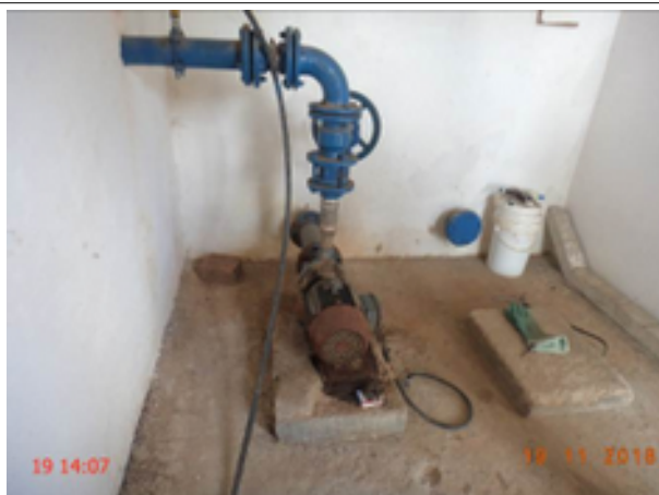
Foto 12 – EERD-02 (Antônio Diogo): ausência de bomba reserva instalada.
