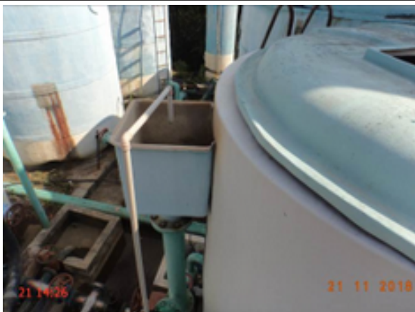
Foto 4 – ETA (Sede): F-02, calha de saída de água sem tampa.
