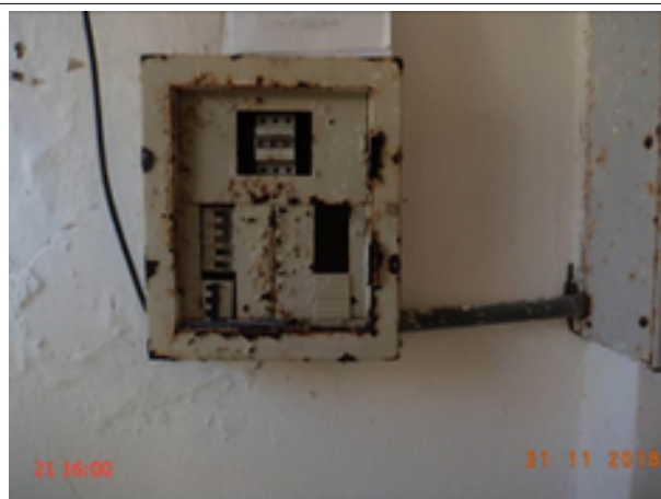
Foto 50 – EEE-01 (Sede) – quadro do disjuntor sem tampa.
