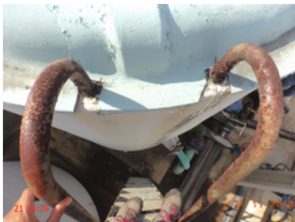
Foto 39 – ETA (Sede): F-04 escada em processo de corrosão.
