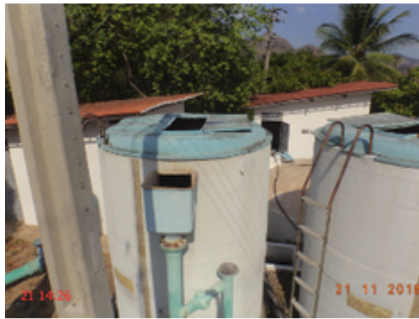
Foto 44 – ETA (Sede): F-01 e F-02 tampas de inspeção abertas.
