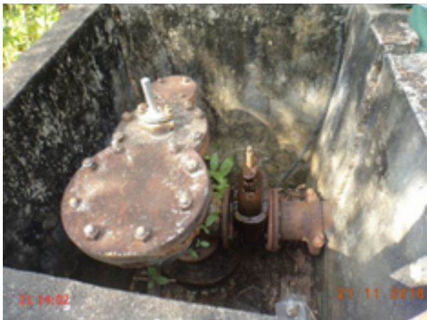
Foto 15 – AAB (Sede): vazamento no registro.
