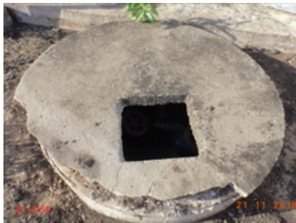
Foto 16 – ETE-Prourb (Sede): PV sem tampa.
