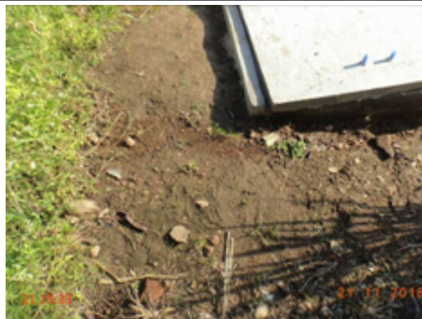
Foto 76 – AAT (Sede): vazamento no registro localizado após o reservatório RAP-02.
