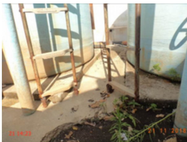
Foto 41 – ETA (Sede): F-10 e F-11 escada sem fixação e em processo de corrosão.
