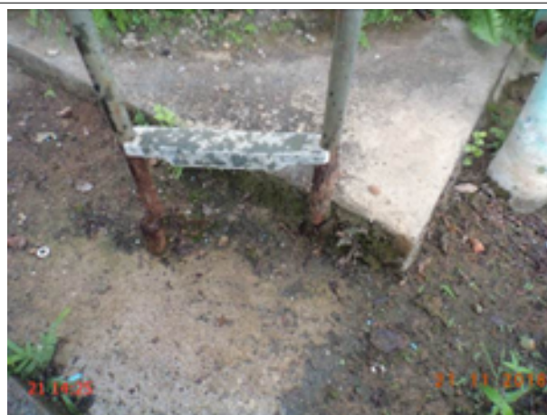
Foto 36 – ETA (Sede): F-01 escada sem fixação e em processo de corrosão
