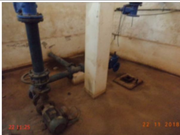
Foto 10 – EERD-01 (Sede): ausência de bomba reserva instalada.
