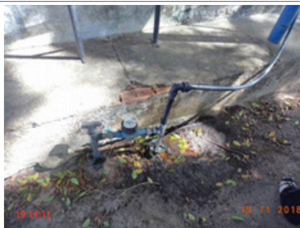
Foto 24 – RAP-06 (Antônio Diogo): vazamento no registro do medidor.
