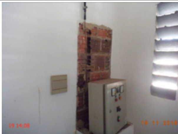
Foto 75 – EERD-02 (Antônio Diogo): instalações elétricas do quadro de comando inadequadas.
