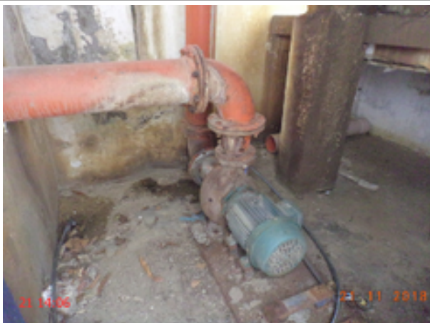
Foto 8 – EEAB-01 (Sede): ausência de bomba reserva instalada.
