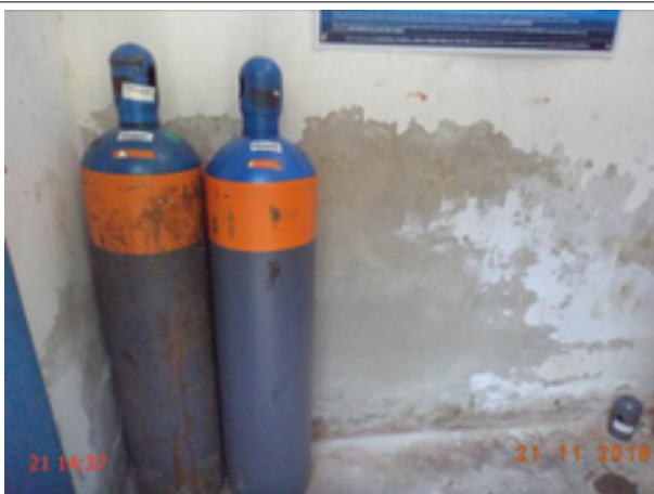
Foto 31 – ETA (Sede): reboco danificado na parede da casa de abrigo do cloro gasoso.
