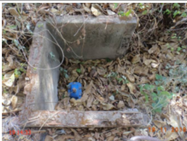
Foto 77 – AAT (Antônio Diogo): caixa danificada.
