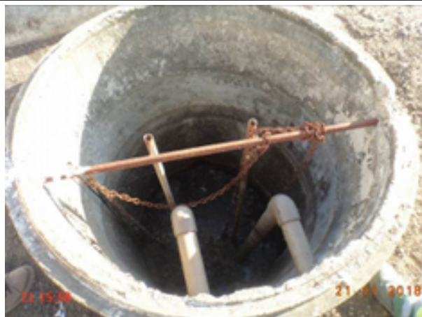
Foto 28 – EEE (Sede): PV das bombas submersíveis sem tampa.
